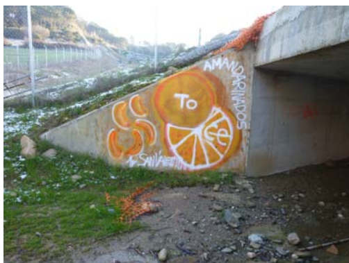
Fotografía nº 7. Pintadas en una aleta
