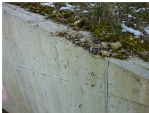
Fotografía nº 8. Desconchón y armadura expuesta en la aleta izquierda del E1
