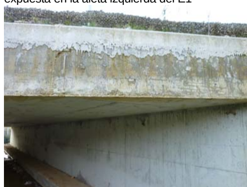
Fotografía nº 10. Nido de grava en la cara lateral de la losa superior
