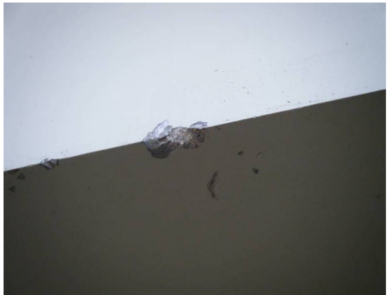
Fotografía N°15: Desconchón en el tablero. Vano 1.
