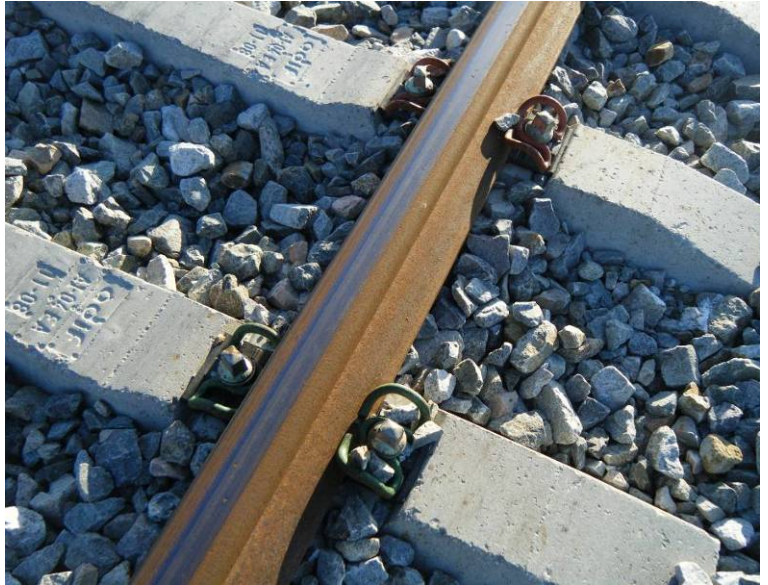
Fotografía N°10: Detalle sujeciones carril.
