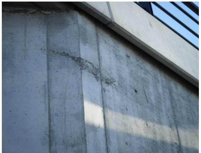
Fotografía N°17: Nido de grava en aleta izda del estribo 1.
