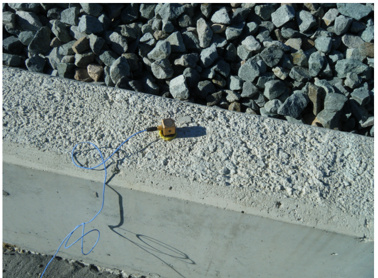
Fotografía N°12: Acelerómetro en vano 3.
