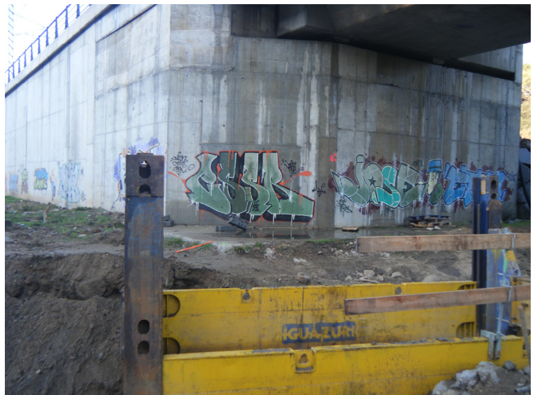
Fotografía N°14: Pintadas en el estribo de entrada.
