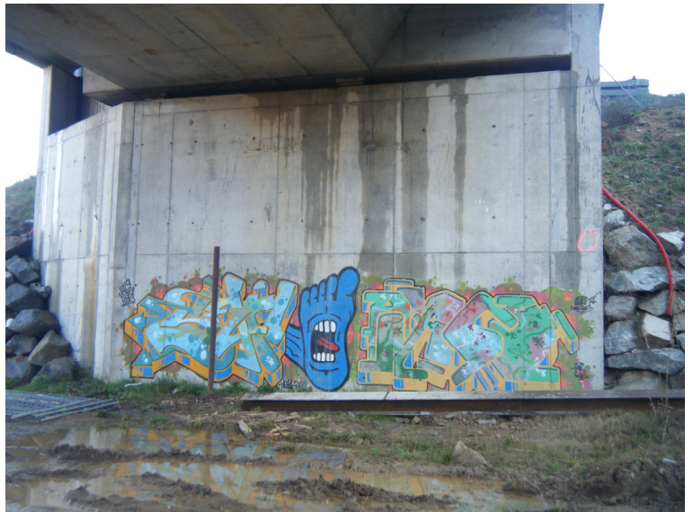
Fotografía N°19: Humedades y filtraciones E-2.
