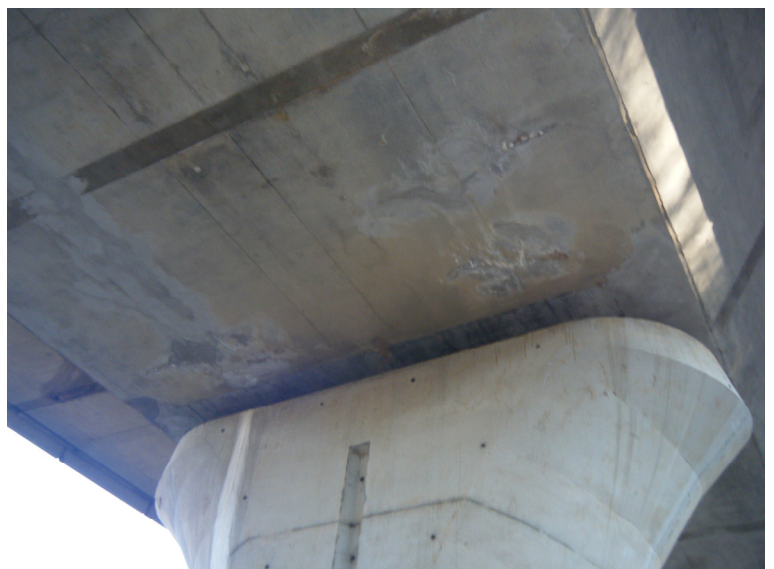
Fotografía N°15: Eflorescencias en el vano 1.
