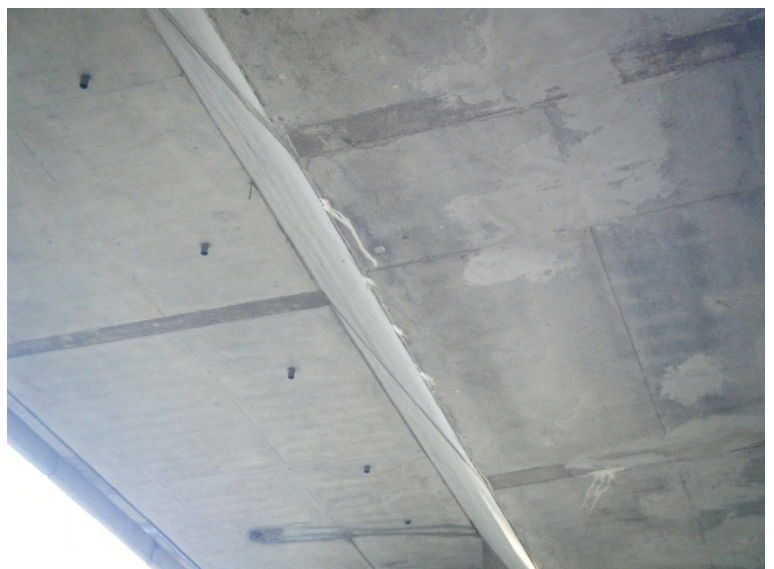
Fotografía N°12: Eflorescencias en el tablero del vano 1.
