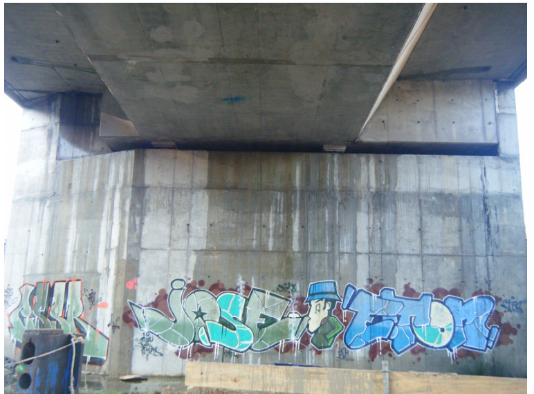
Fotografía N°17: Humedades y filtraciones en el estribo de entrada.
