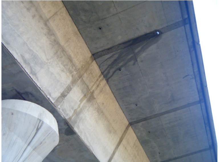
Fotografía N°16: Imbornales con longitud insuficiente.
