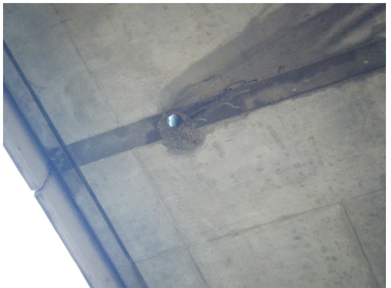
Fotografía N°18: Desconchón en el vano 2.
