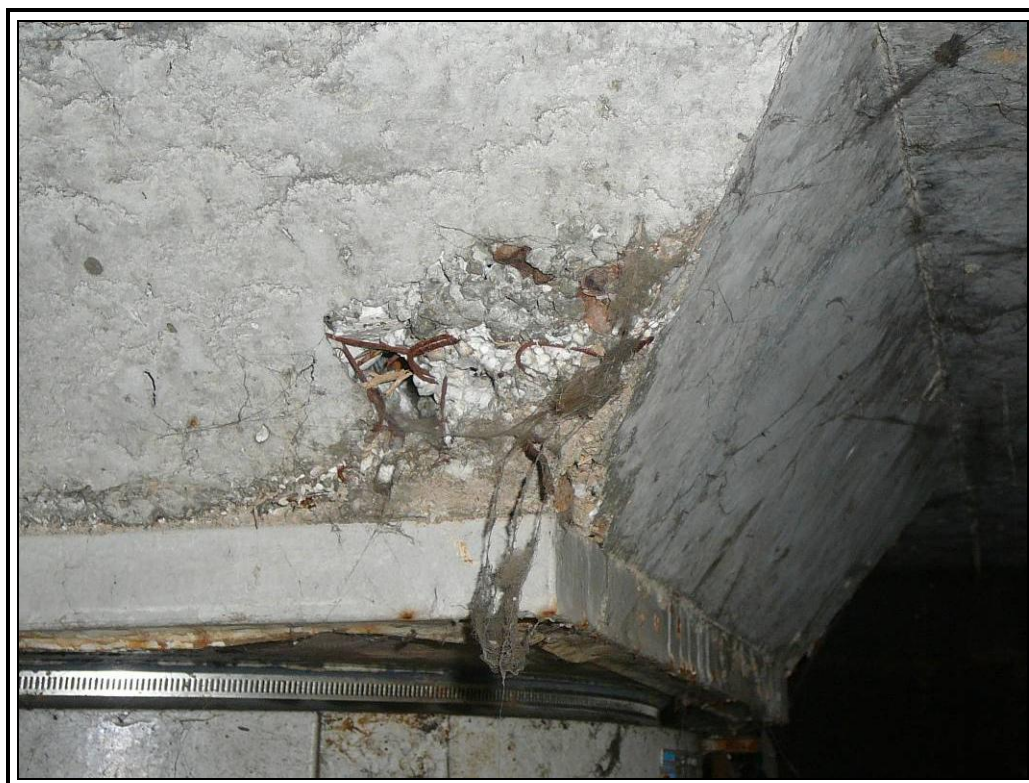
Fisura de retracción en hastial dos
