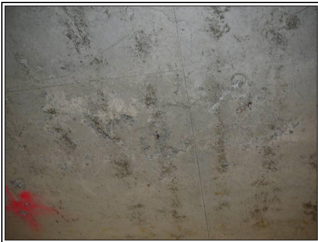
Nidos de grava en sección de centro de vano (centro).
