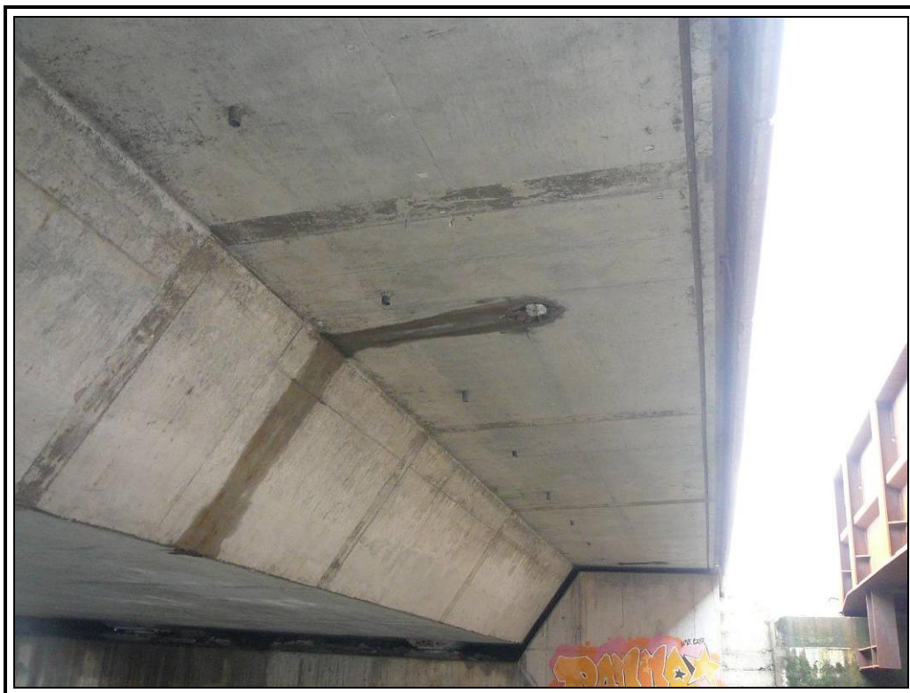
Ausencia de gárgolas bajo sumideros.
