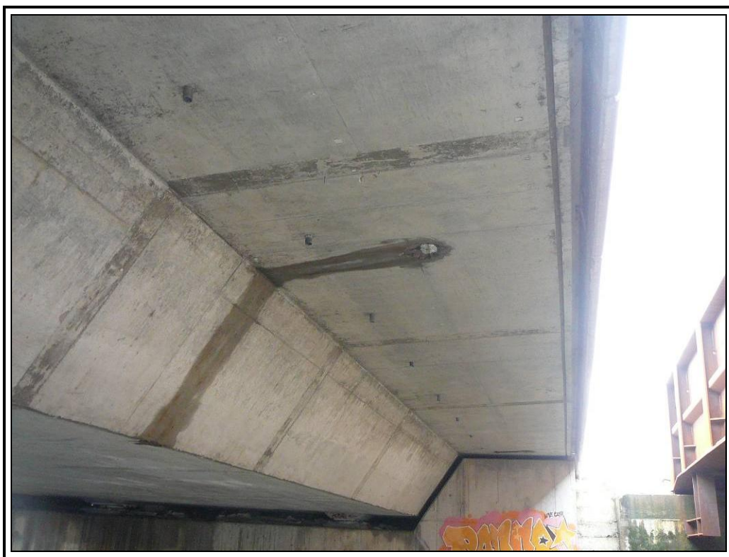
Ausencia de gárgolas bajo sumideros.
