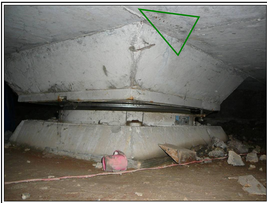
Armadura somera próxima a la cama de nivelación superior del apoyo derecho de E2
