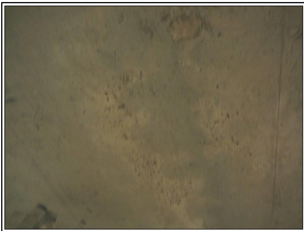
Nidos de grava en sección de centro de vano (cerca del alzado izquierdo).
