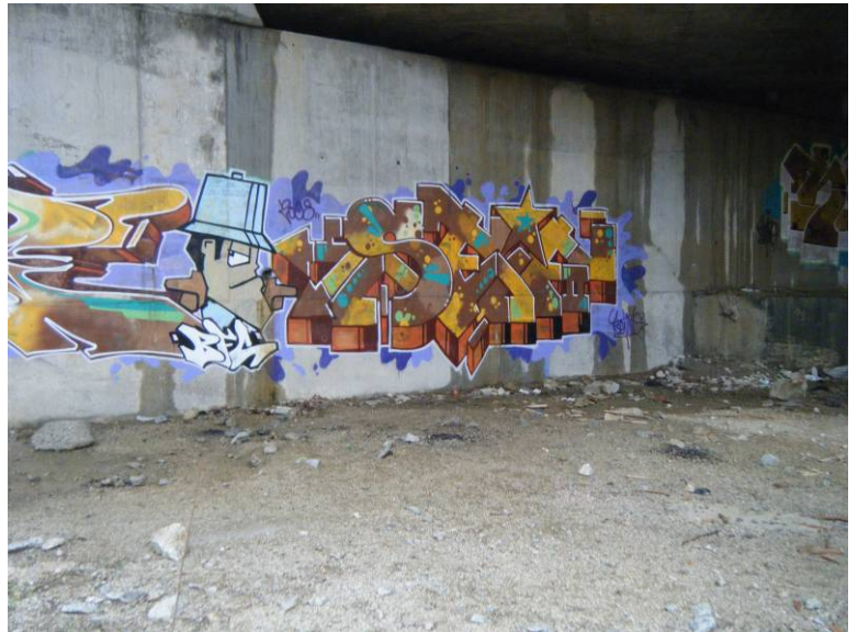
Fotografía N°13: Pintadas en el estribo de entrada.
