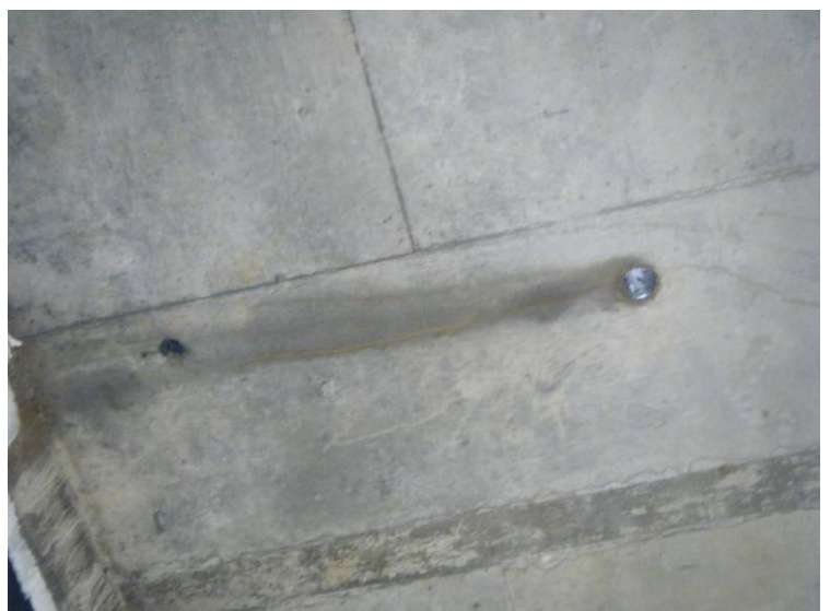
Fotografía N°12: Longitud insuficiente de los imbornales.
