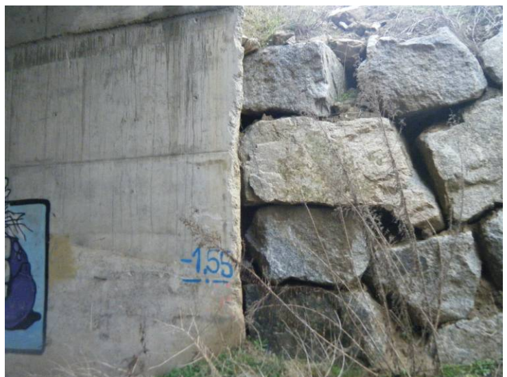
Fotografía N°21: Desconchones en estribo 2.
