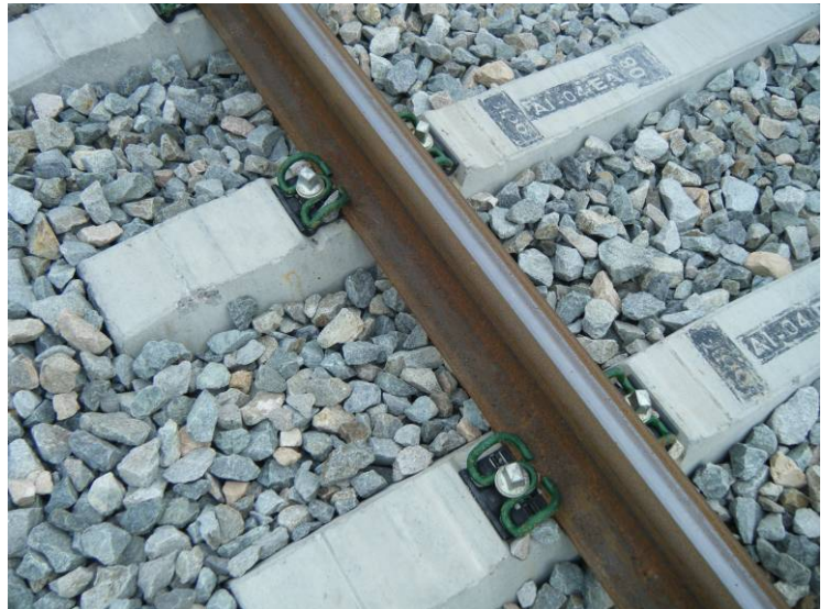
Fotografía N°7: Detalle de sujeción del carril.
