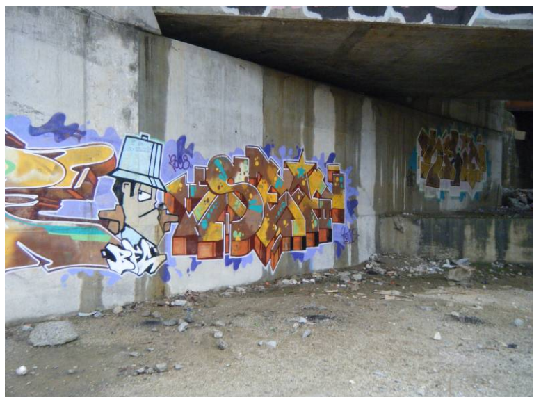
Fotografía N°15: Humedades en el estribo de entrada.
