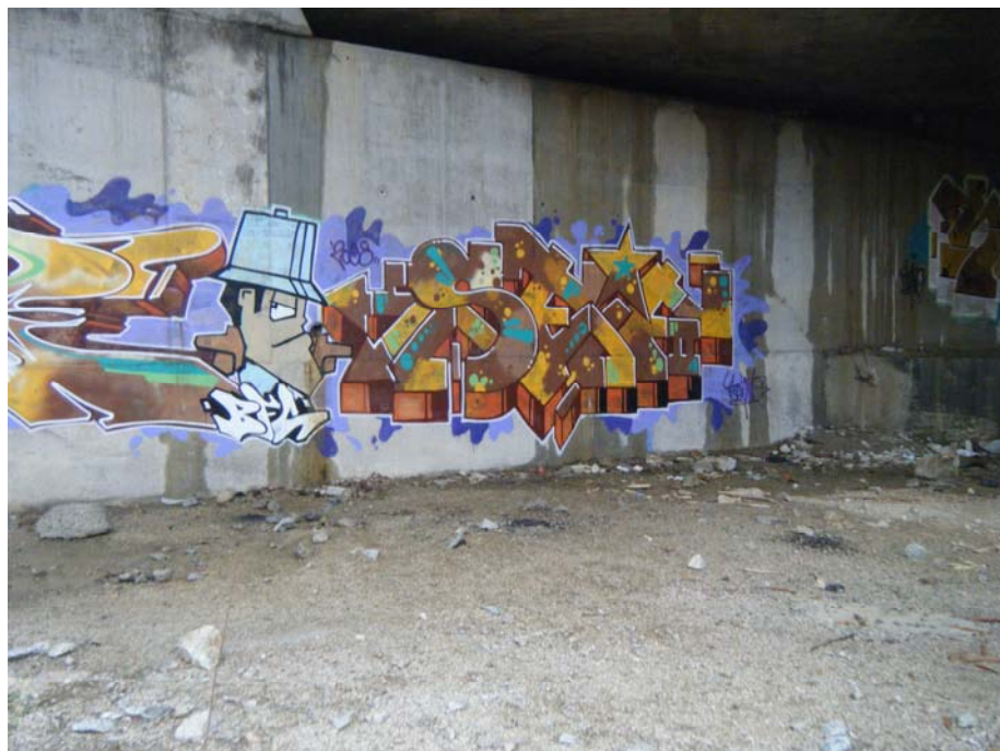
FOTOGRAFIA N° 13: Pintadas en el estribo de entrada
