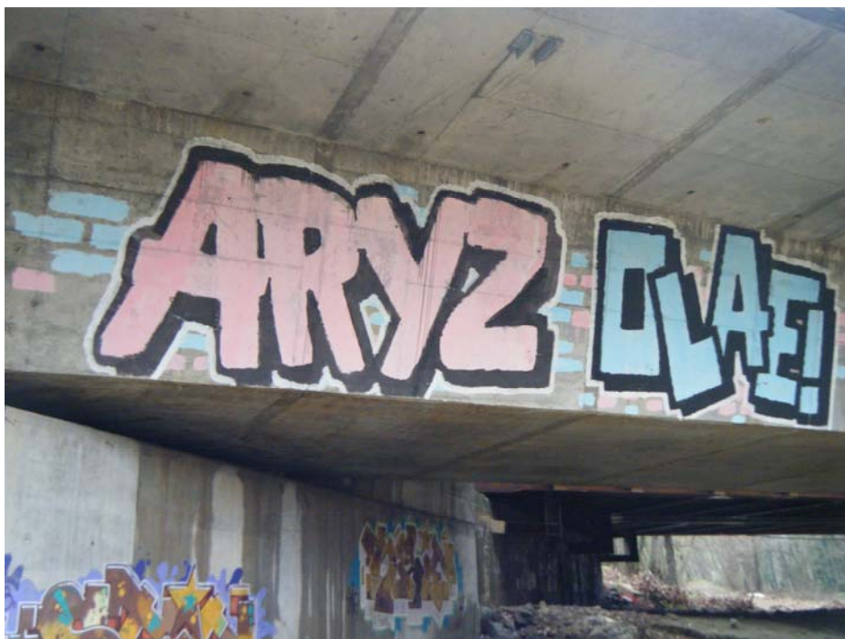
FOTOGRAFIA N° 16: Pintadas en la viga 1
