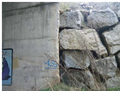
Fotografía nº 8. Desconchones en el estribo 2
