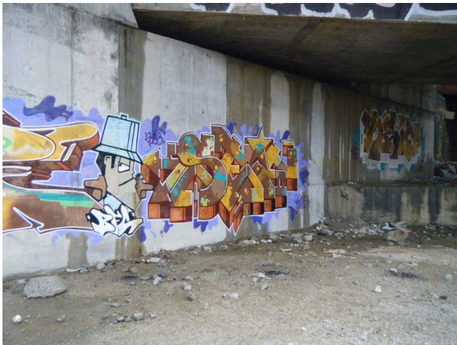
FOTOGRAFIA N° 15: Humedades en el estribo de entrada
