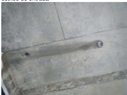
Fotografía nº 9. insuficiente longitud de los tubos de desagüe
