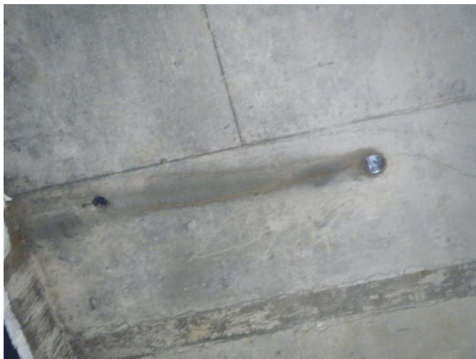
FOTOGRAFIA N° 12: Longitud insuficiente de los imbornales
