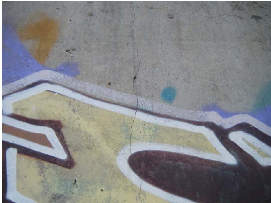
FOTOGRAFIA N° 17: Fisuras en el estribo 1
