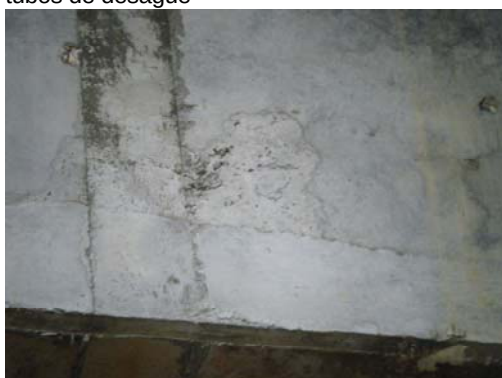
Fotografía nº 8. Nidos de grava en el cajón
