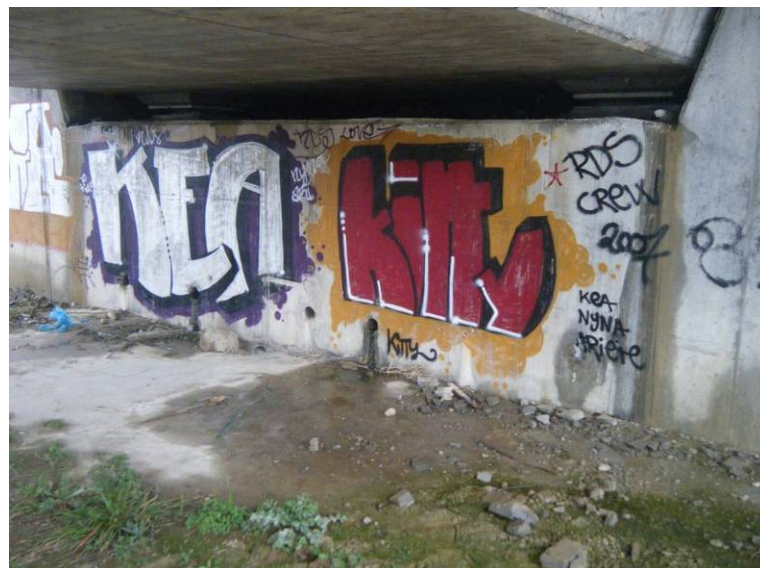
Fotografía N°12: Humedades y drenaje en el estribo 2
