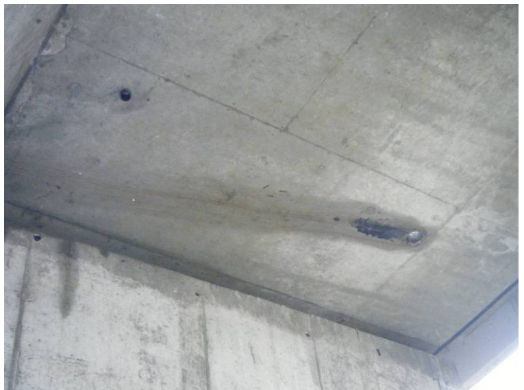
Fotografía N°15: Humedades por la insuficiencia de longitud del imbornal
