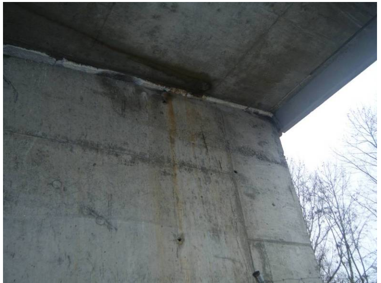
Fotografía N°13: Nido de grava en el muro de frente del estribo 2
