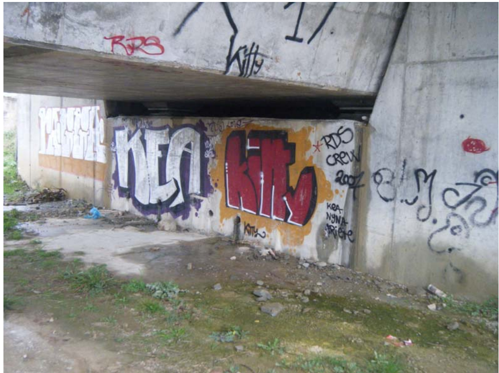
Fotografía nº 9: Humedades en muro de frente. E-2
