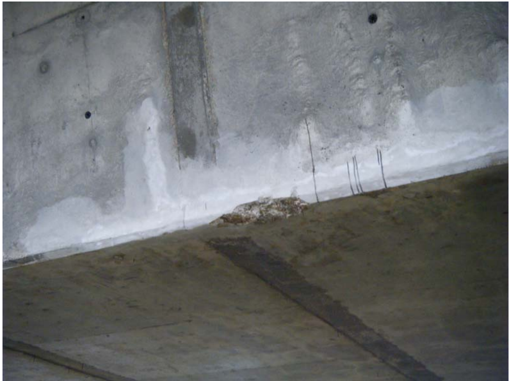
Fotografía n° 1: desconchón en la viga. (Lado derecho)
