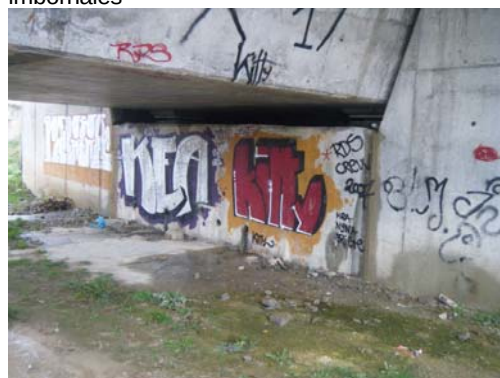
Fotografía nº 10. Pintadas en el estribo de entrada
