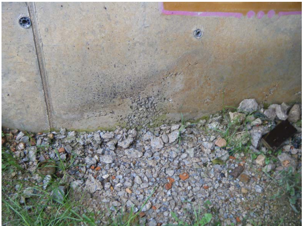
Fotografía n° 14: Nido de grava Muro de Frente E-2 (I)
