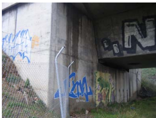
Fotografía nº 7. Humedades y pintadas en el estribo de entrada
