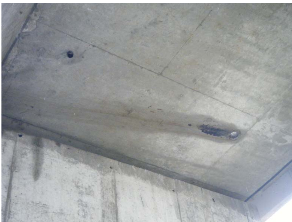
Fotografía n° 26: Humedades por la insuficiencia de longitud del imbornal
