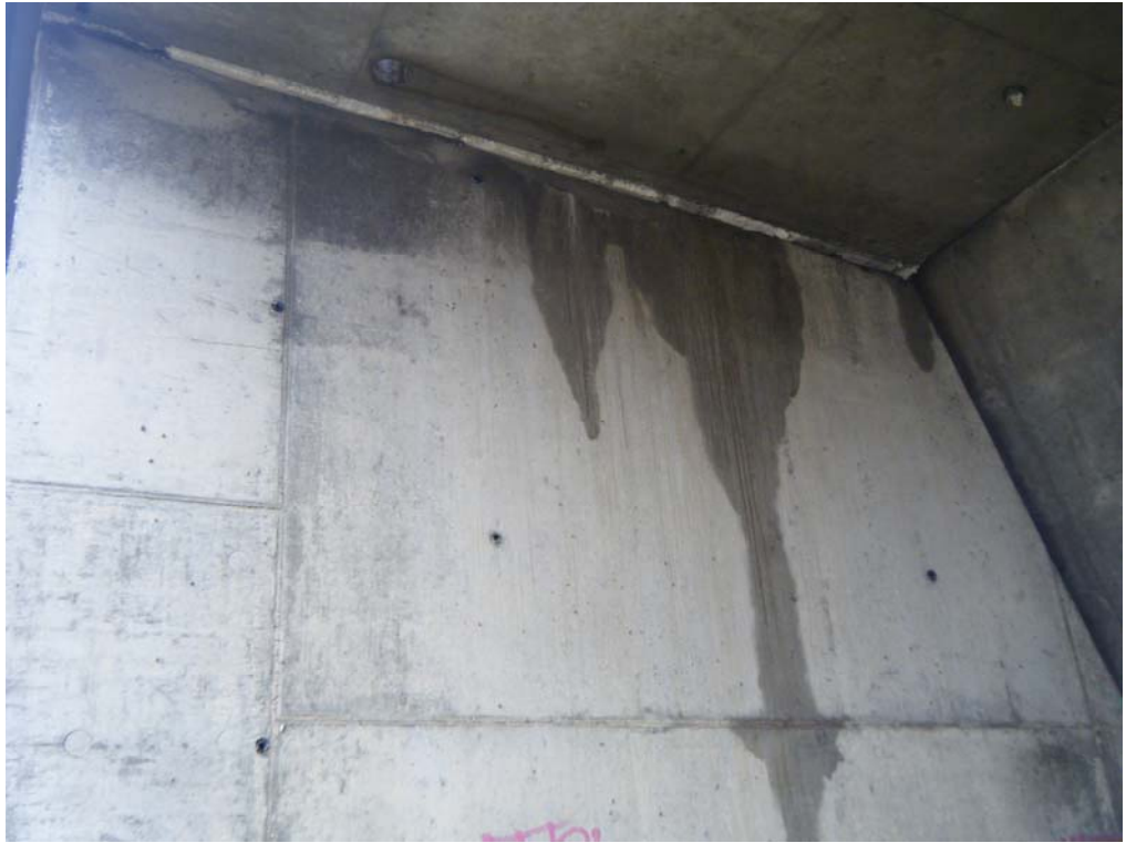
Fotografía n° 13: Humedades Muro de frente E-2 (I)
