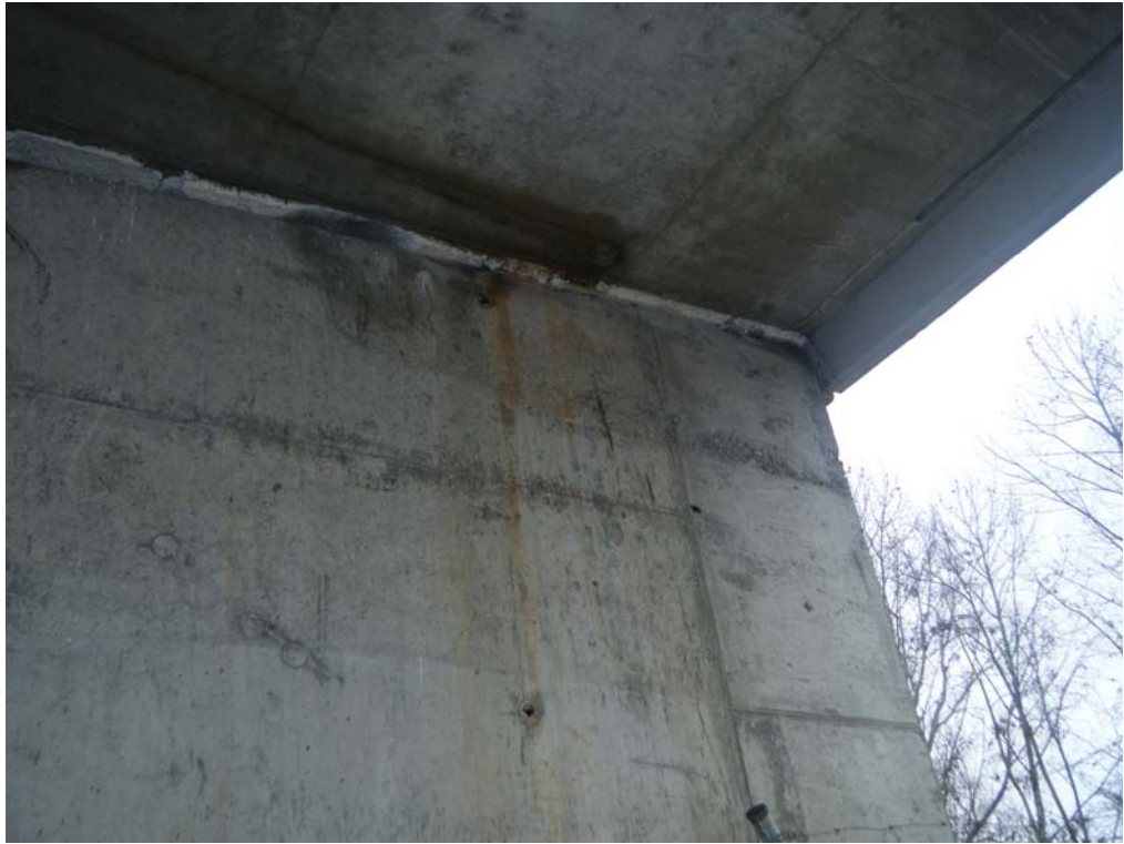
Fotografía n° 11: Nido de grava muro de frente. E-2
