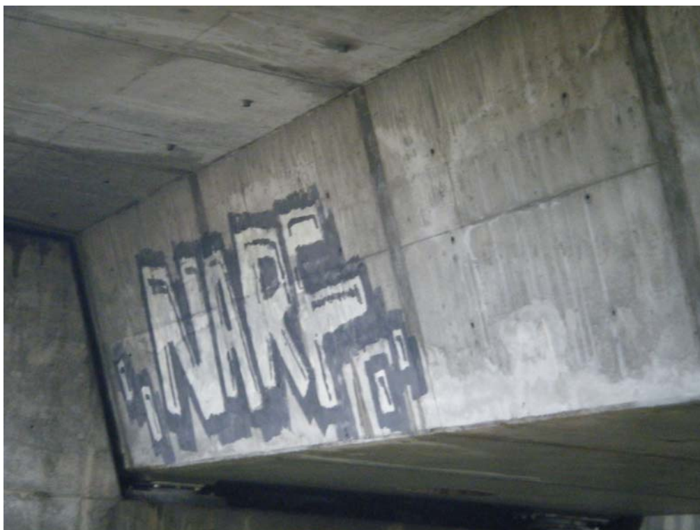
Fotografía nº 16: Pintadas en el tablero (I)
