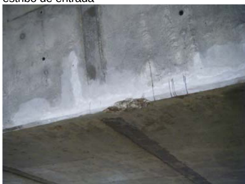
Fotografía nº 9. Desconchón en la cara inferior de la viga en cajón
