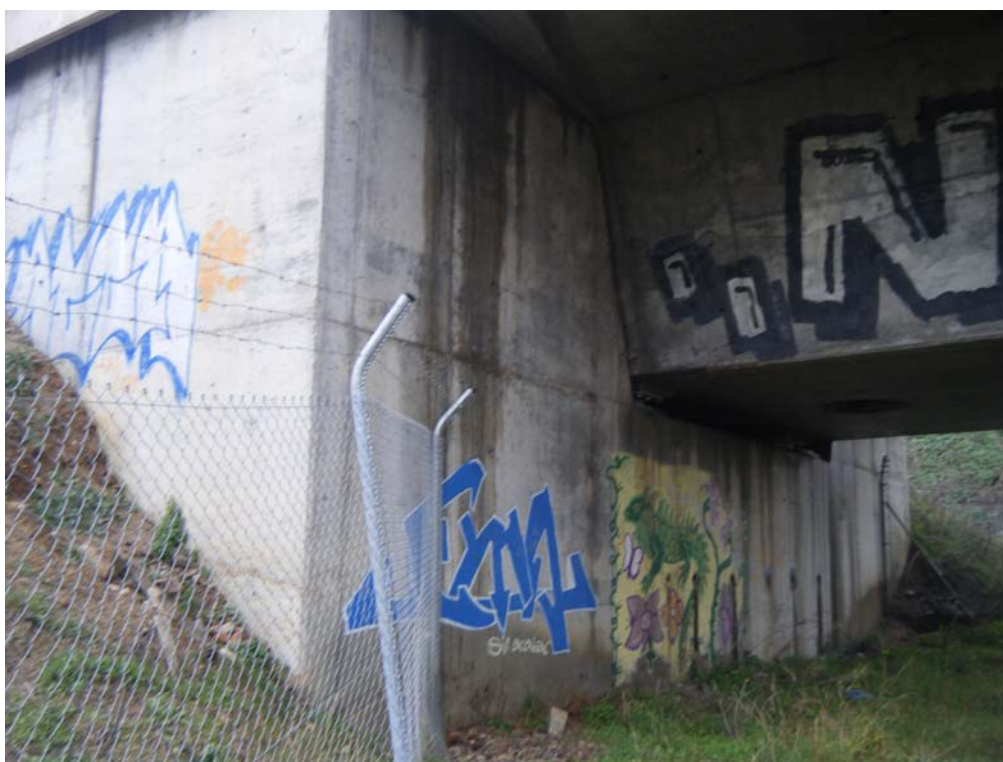
Fotografía n° 24: Pintadas en el estribo de entrada
