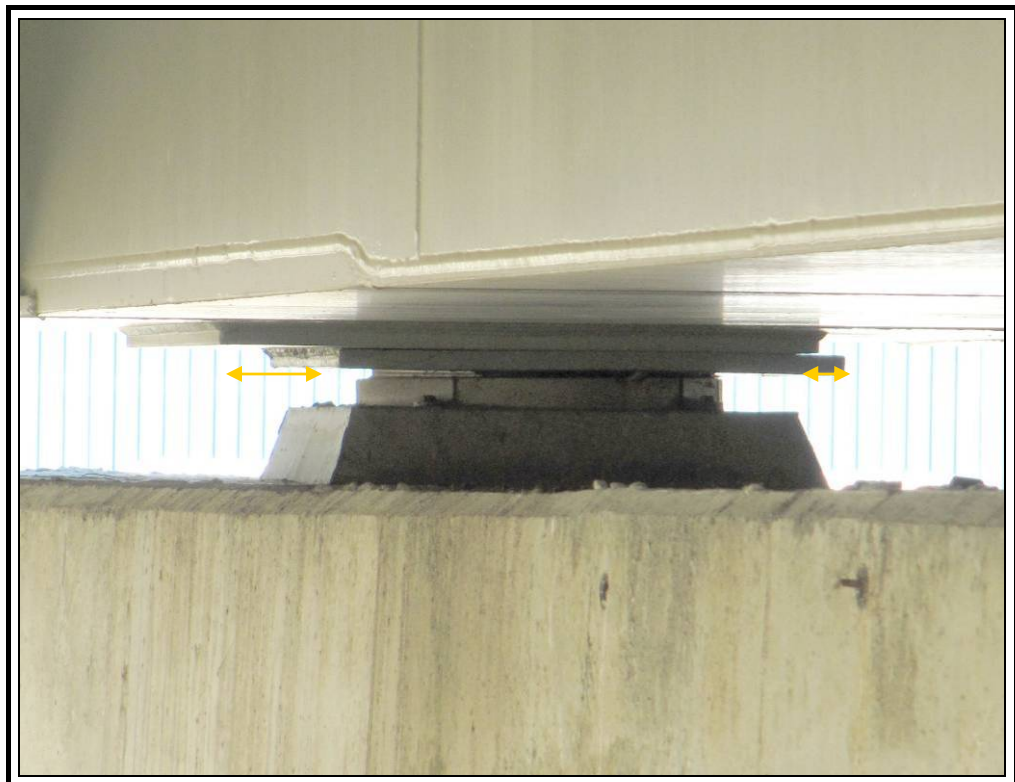
Deficiente ejecución de placas de reparto, apoyo izquierdo de pila-estribo 2
