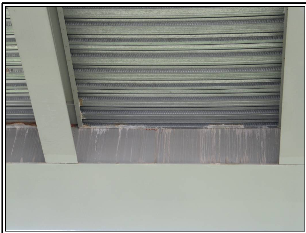
Filtraciones en el encuentro entre las vigas longitudinales y las transversales (vano 5, lado derecho)
