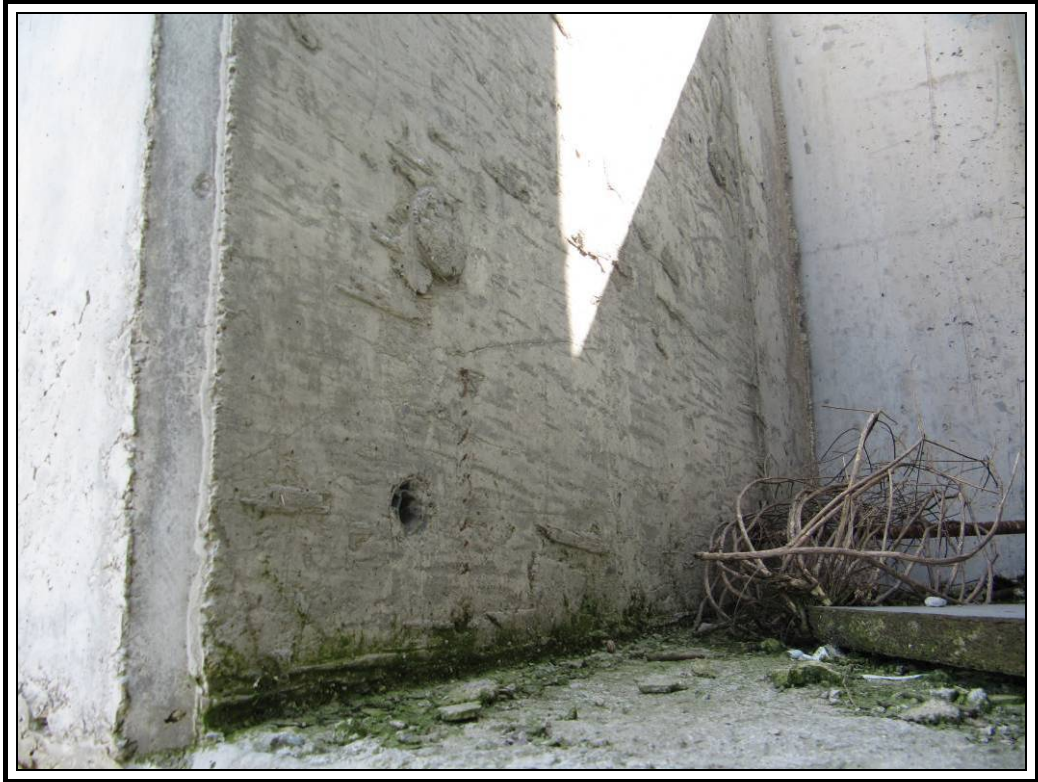
Armadura vista en oreja derecha de estribo uno
