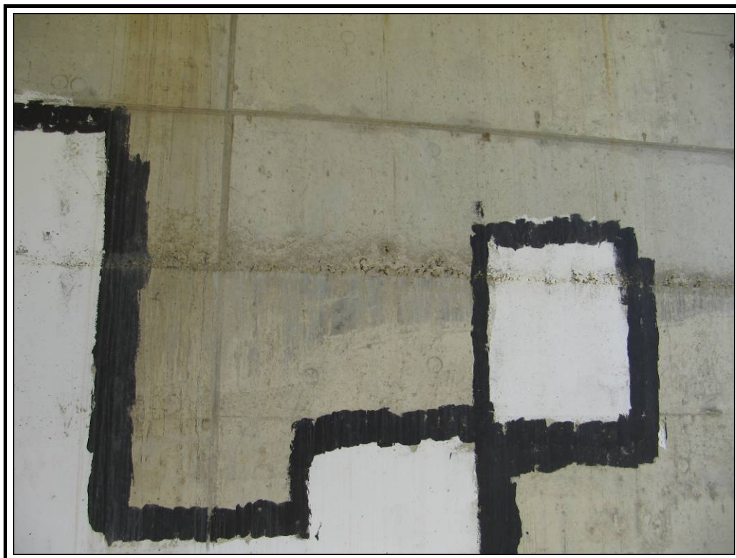
Nidos de grava coincidentes con junta de hormigonado en cargadero de pila-estribo 2
