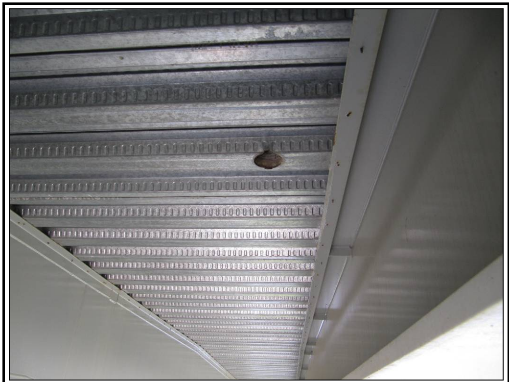
Ausencia de gárgolas bajo los sumideros
