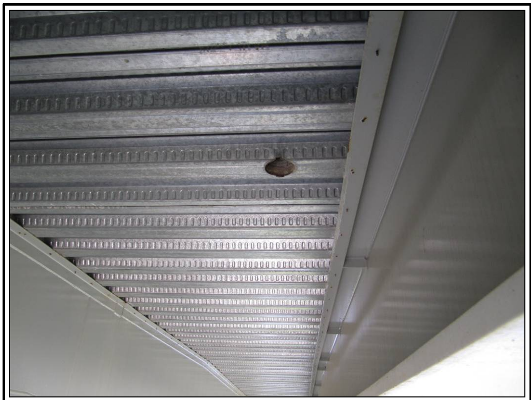
Ausencia de gárgolas bajo los sumideros
