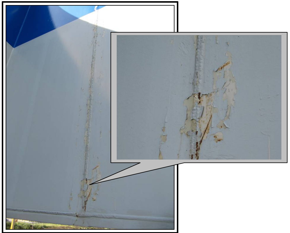
Ménsula en pila 2, lado derecho, con oxidación
