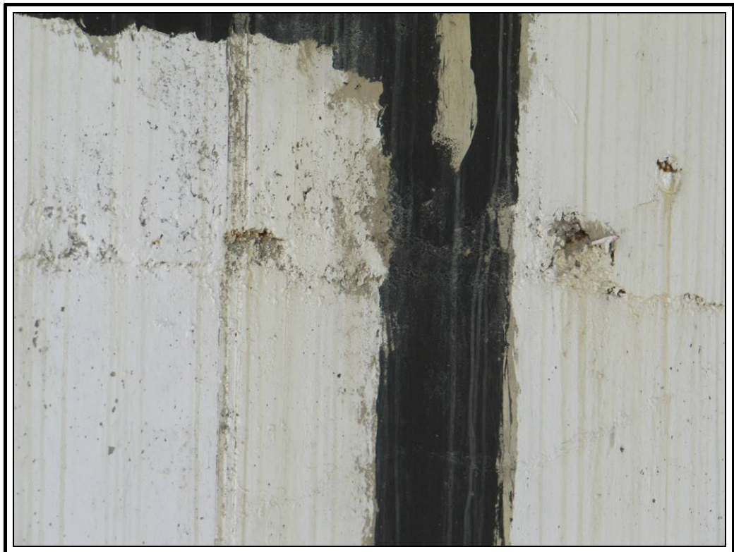
Nidos de grava con armadura implicada en cargadero de pila-estribo 2
