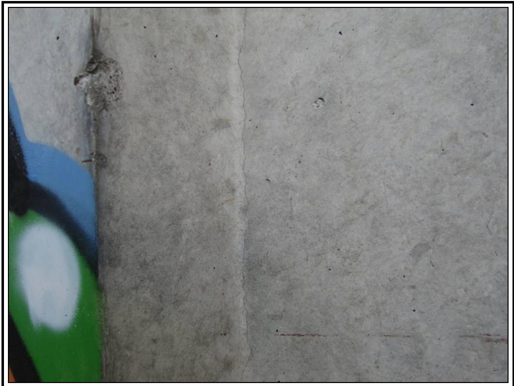
Fisura de retracción en arista de entalladura de fuste izquierdo de pila 4, lado pila 3
