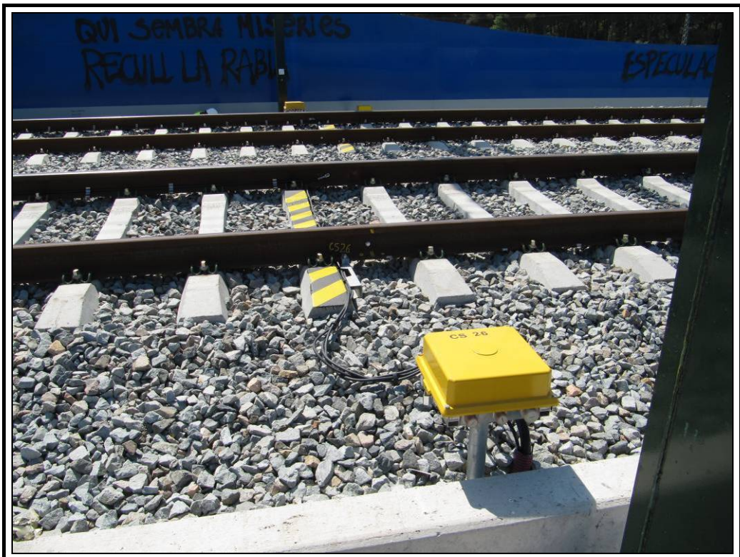
Material de vía (señalización)
