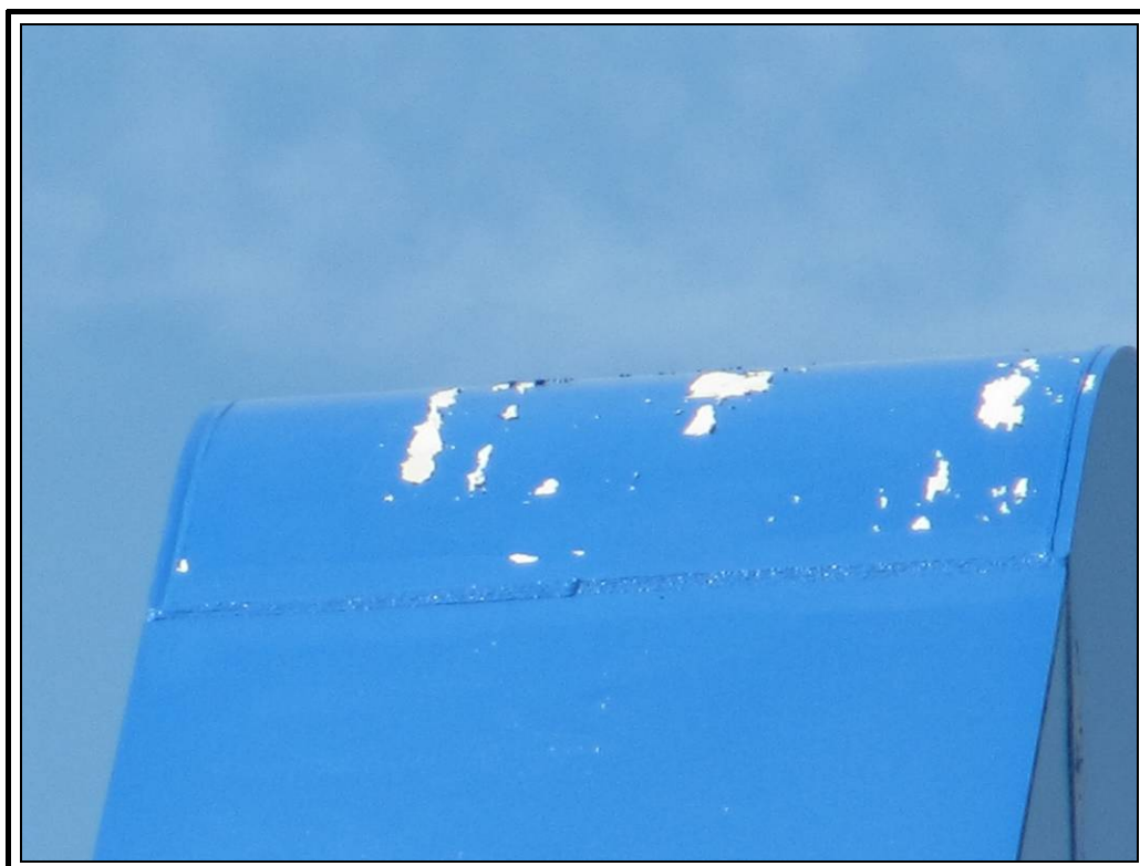
Pintura desprendida deja a la vista capa intermedia de recubrimiento (sobre la pila 2, lado derecho)
