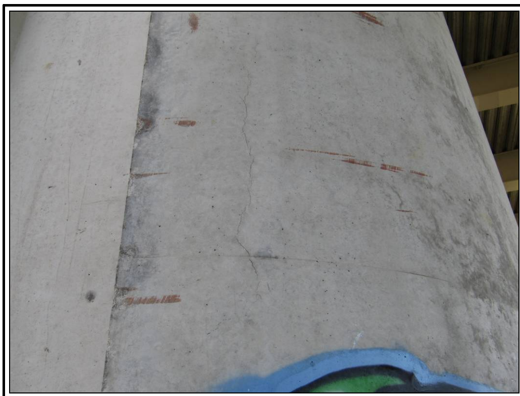
Fisura de retracción en fuste izquierdo de pila 4, lado pila 3
