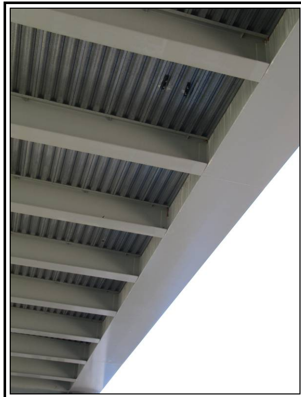
Filtraciones en el encuentro entre las vigas longitudinales y las transversales (vano 5, lado izquierdo)
