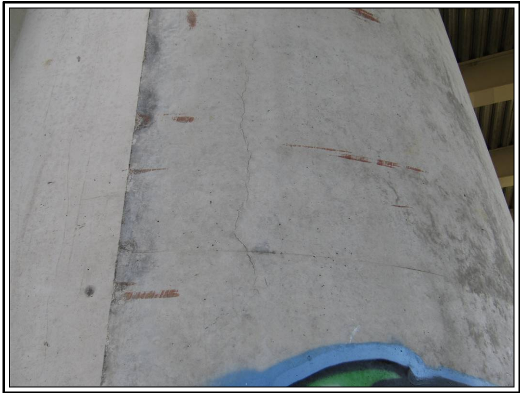
Fisura de retracción en fuste izquierdo de pila 4, lado pila 3
