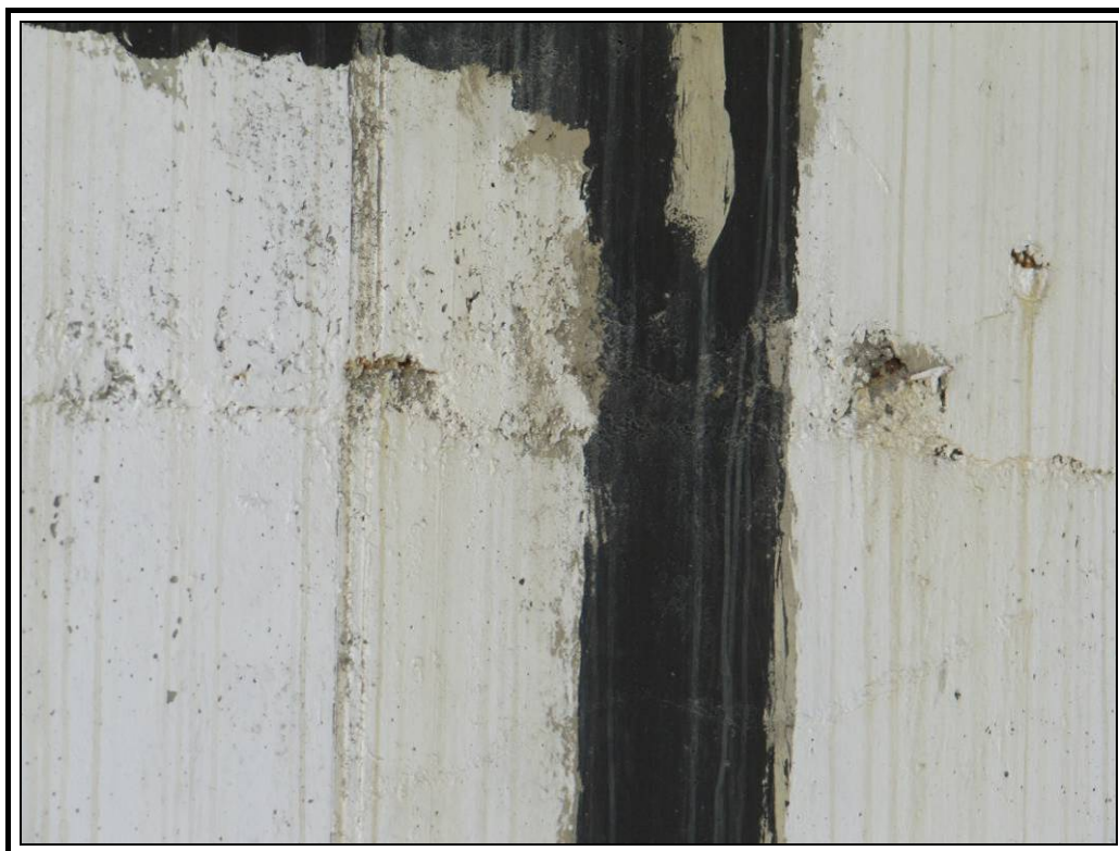
Nidos de grava con armadura implicada en cargadero de pila-estribo 2
