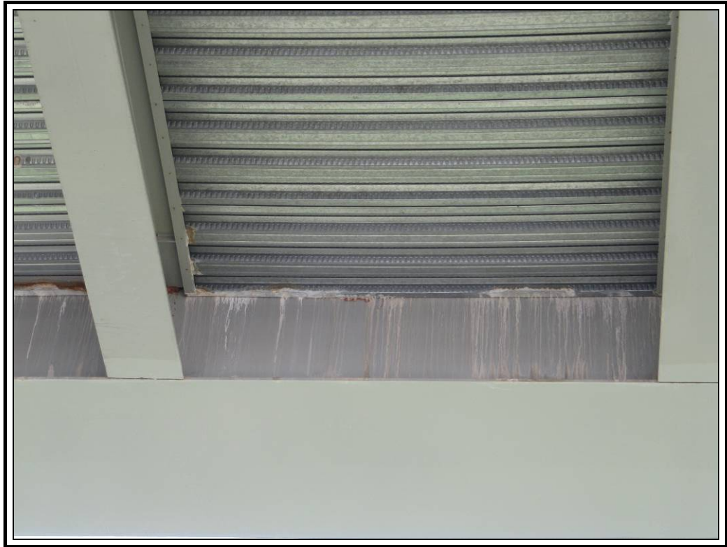
Filtraciones en el encuentro entre las vigas longitudinales y las transversales (vano 5, lado derecho)
