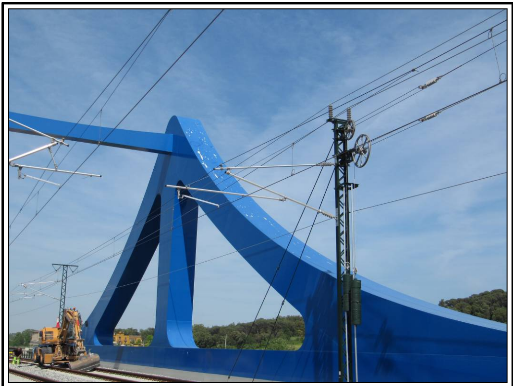
Pintura desprendida deja a la vista capa intermedia de recubrimiento (sobre la pila 4, lado derecho)
