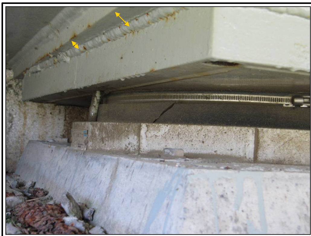
Deficiente ejecución de placas de reparto e inicio de corrosión, apoyo derecho de estribo 1
