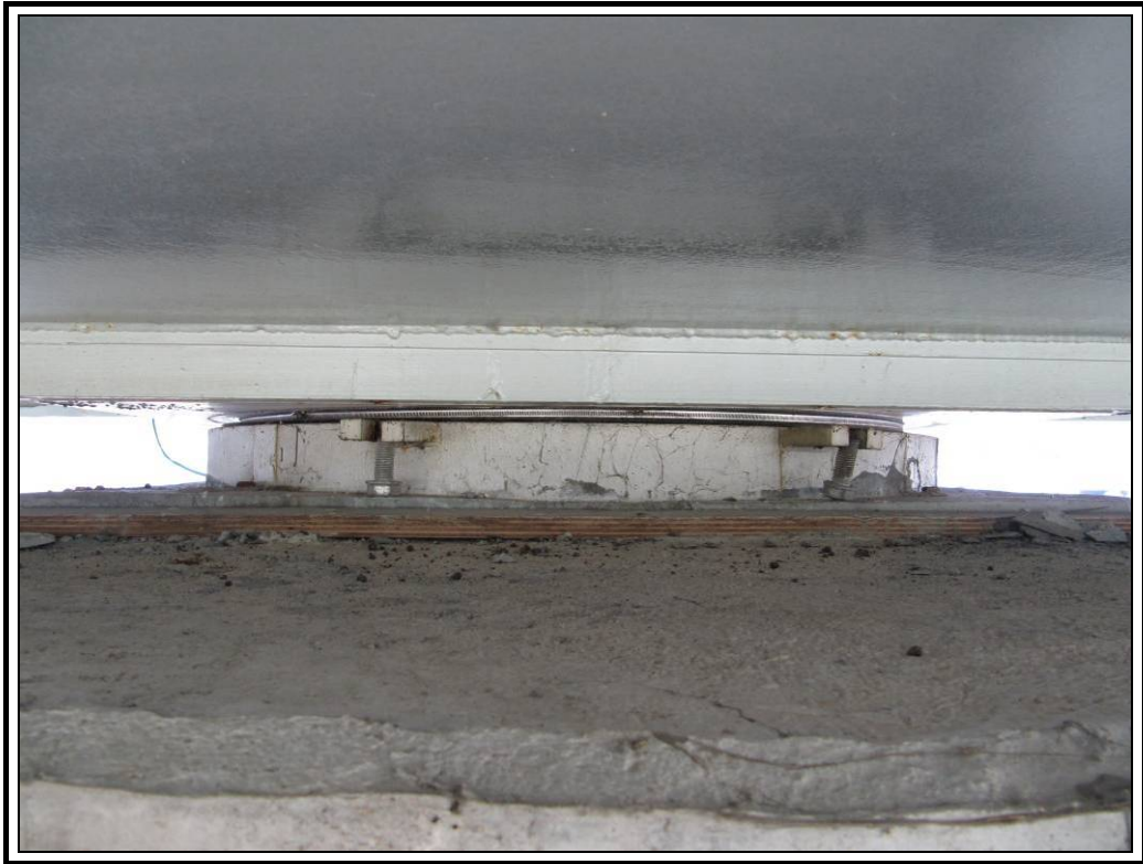
Apoyo izquierdo pila 1
