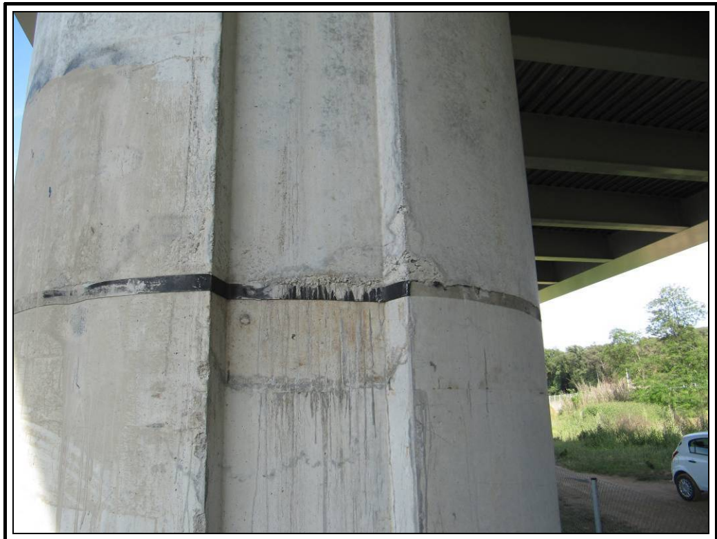
Nido de grava en fuste izquierdo de pila uno (lado estribo 1)
