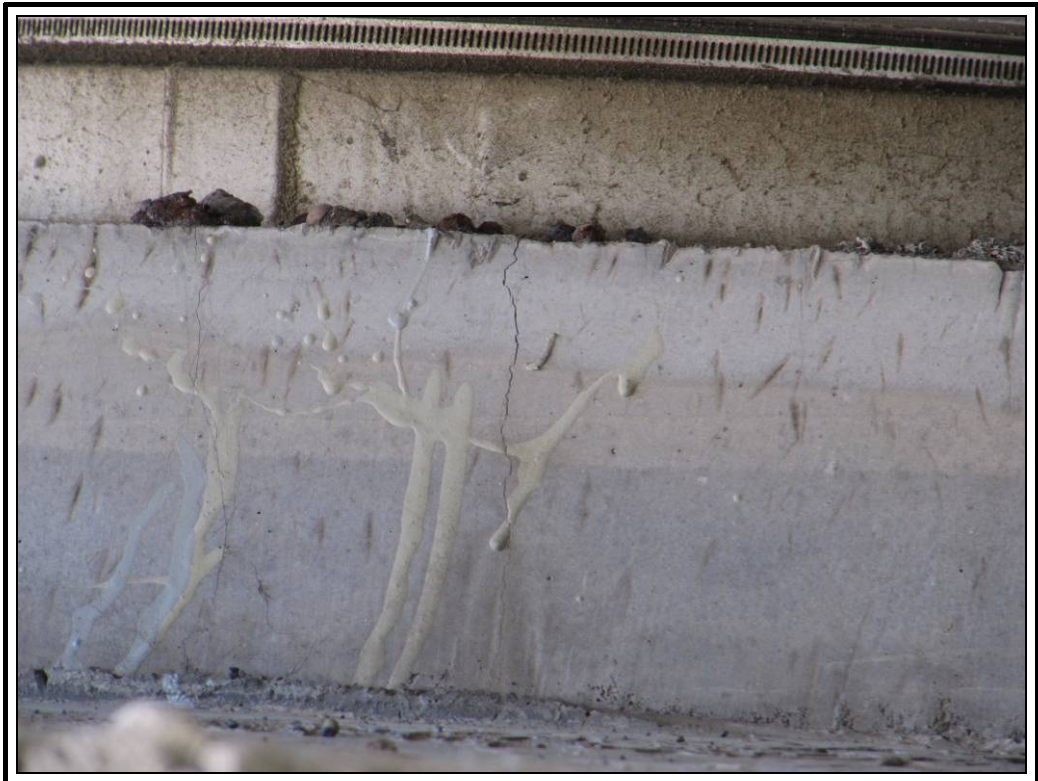
Fisura de retracción en cama de nivelación de apoyo izquierdo de la pila-estribo
