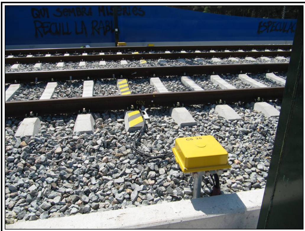
Material de vía (señalización)
