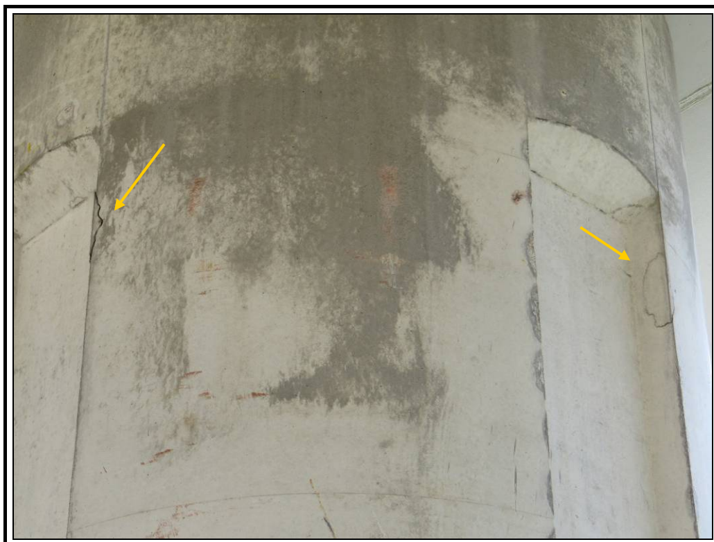
Desconchones en aristas de la entalladura de fuste izquierdo de pila 4
