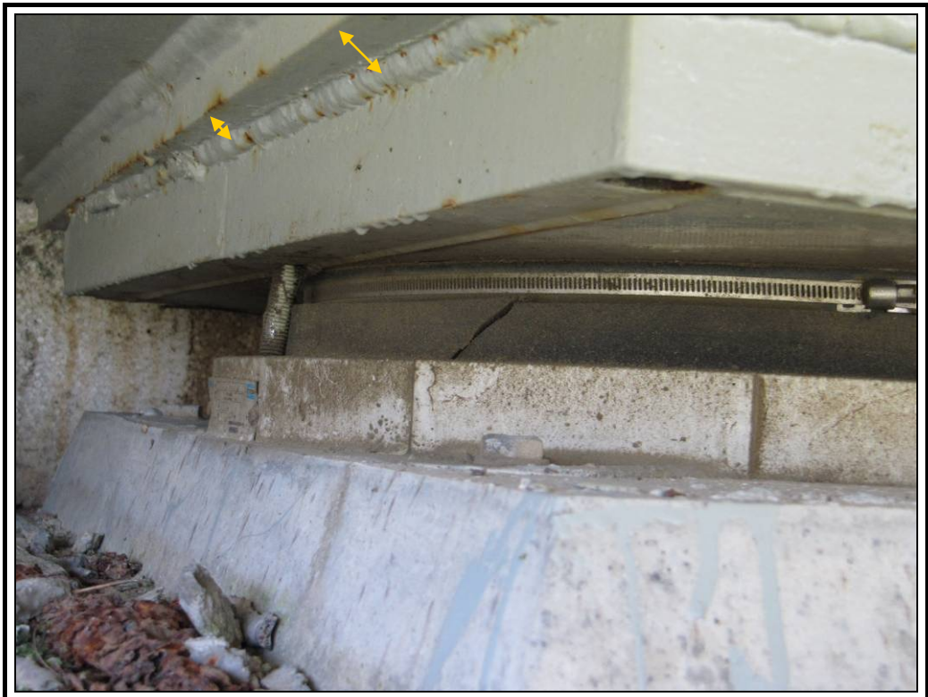
Deficiente ejecución de placas de reparto e inicio de corrosión, apoyo derecho de estribo 1
