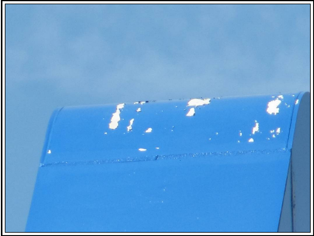
Pintura desprendida deja a la vista capa intermedia de recubrimiento (sobre la pila 2, lado derecho)
