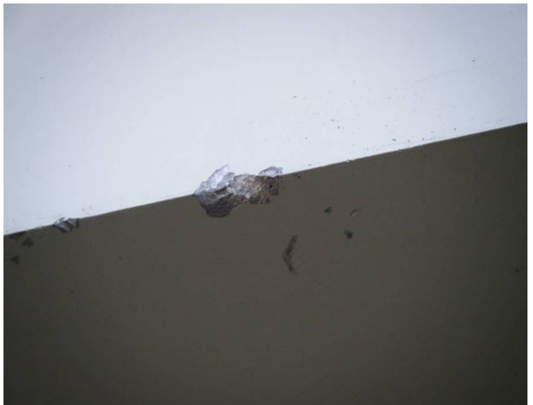
Fotografía N°15: Desconchón en el tablero. Vano 1.
