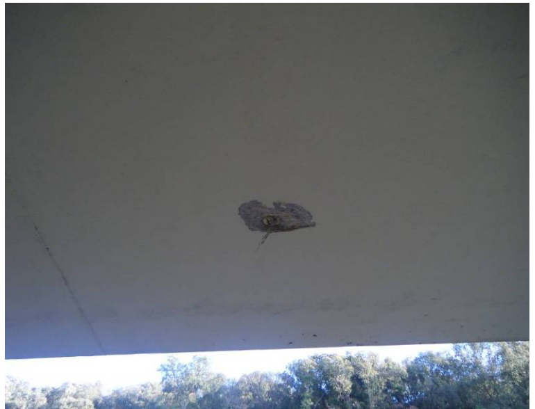
Fotografía N°16: Desconchón en el tablero. Vano 2.
