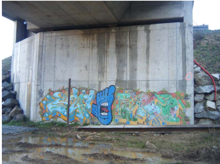
FOTOGRAFIA N° 19: Humedades y filtraciones E-2
