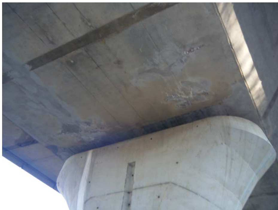
FOTOGRAFIA N° 15: Eflorescencias en el vano 1
