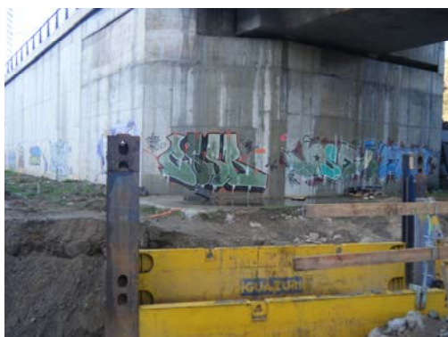
Fotografía nº 9. Pintadas en el estribo de entrada
