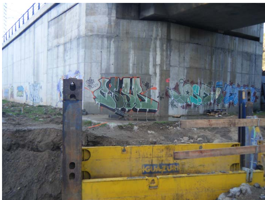
FOTOGRAFIA N° 14: Pintadas en el estribo de entrada
