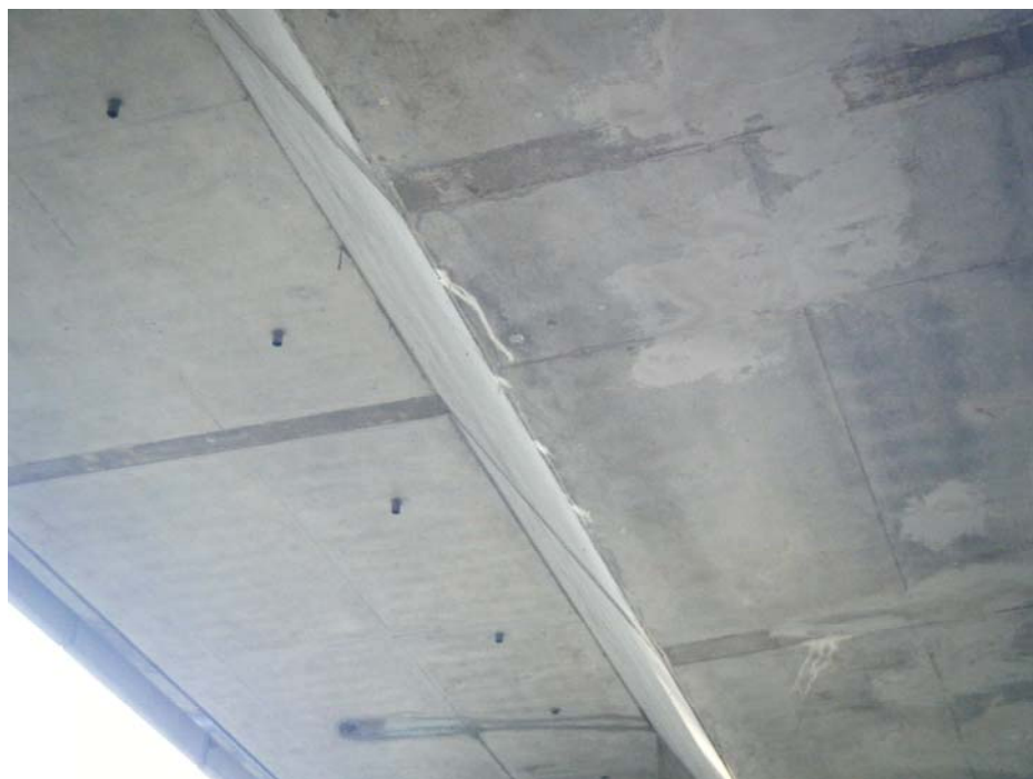
FOTOGRAFIA N° 12: Eflorescencias en el tablero del vano 1
