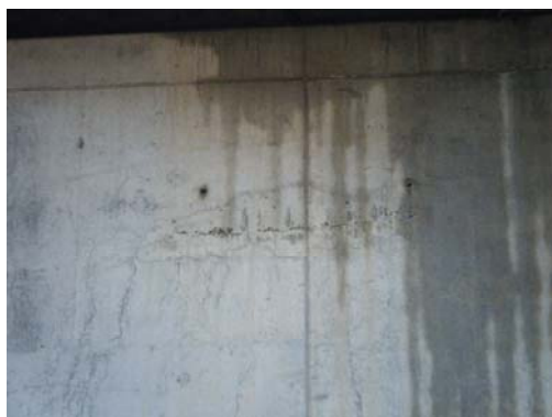
Fotografía nº 7. Nido de grava en el estribo E2
