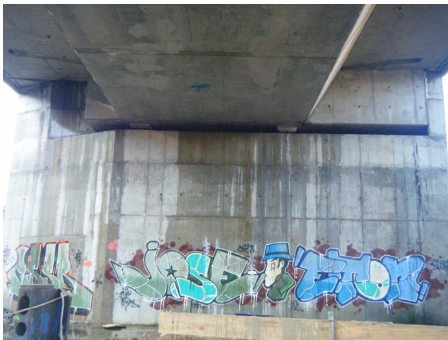
FOTOGRAFIA N° 17: Humedades y filtraciones en el estribo de entrada
