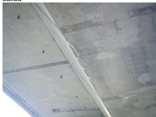
Fotografía nº 10. Eflorescencias en el vano 1
