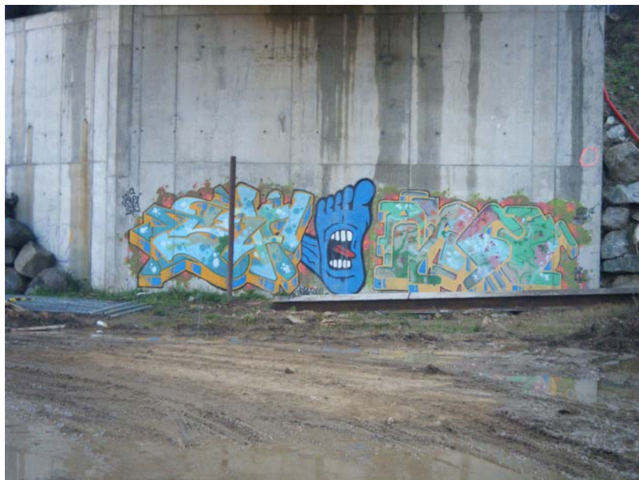
FOTOGRAFIA N° 13: Pintadas en el estribo 2
