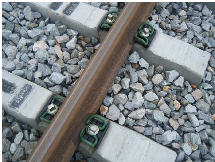
FOTOGRAFIA N° 7: Detalle de sujeción del carril
