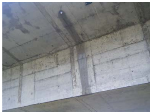
Fotografía nº 8. Insuficiente longitud de los imbornales
