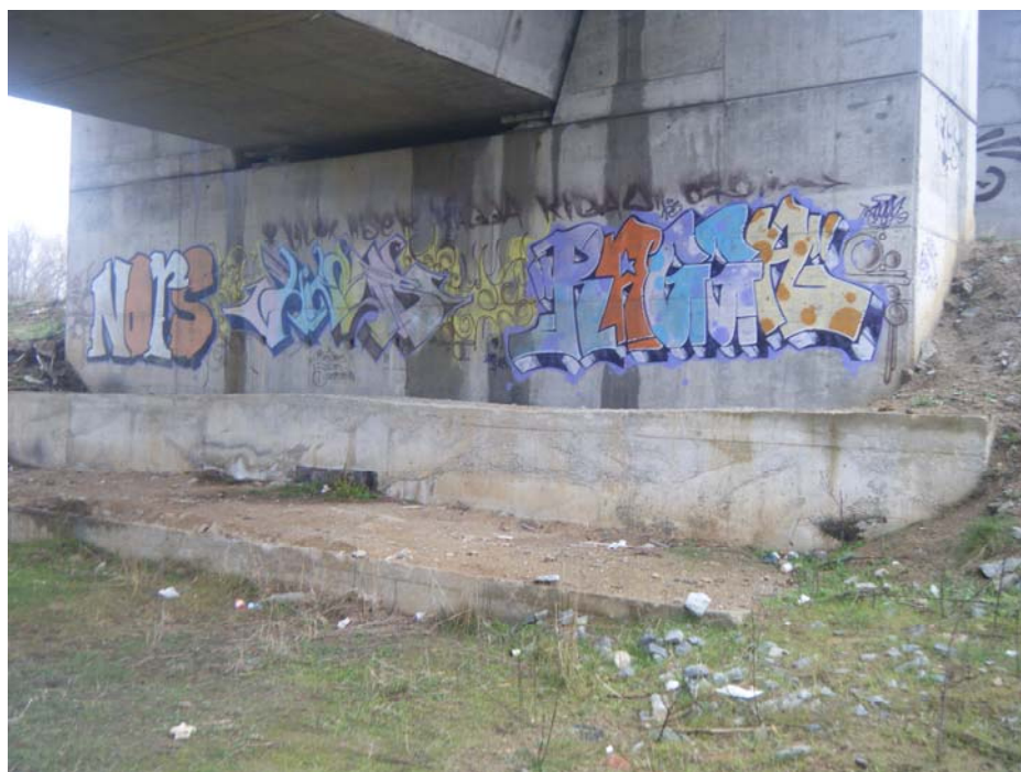
FOTOGRAFIA N° 12: Pintadas en el estribo E-1
