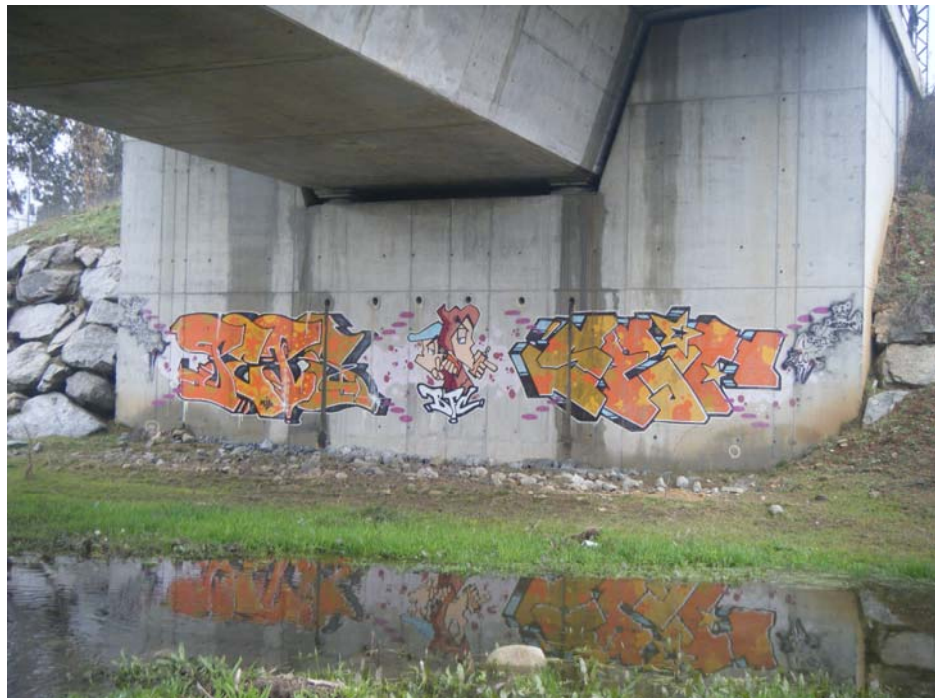
FOTOGRAFIA N° 14: Pintadas y humedades en el estribo E-2
