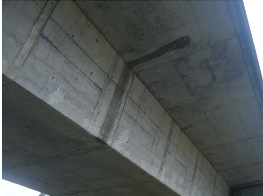
FOTOGRAFIA N° 13: Insuficiente longitud de los imbornales
