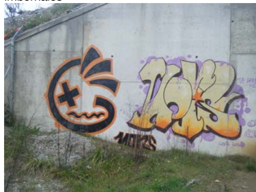
Fotografía nº 10. Pintadas en la aleta izquierda del estribo de entrada
