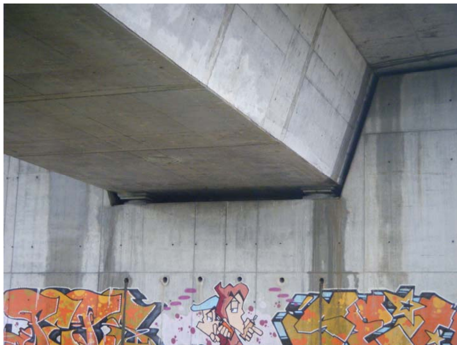
FOTOGRAFIA N° 15: Humedades en el estribo 2
