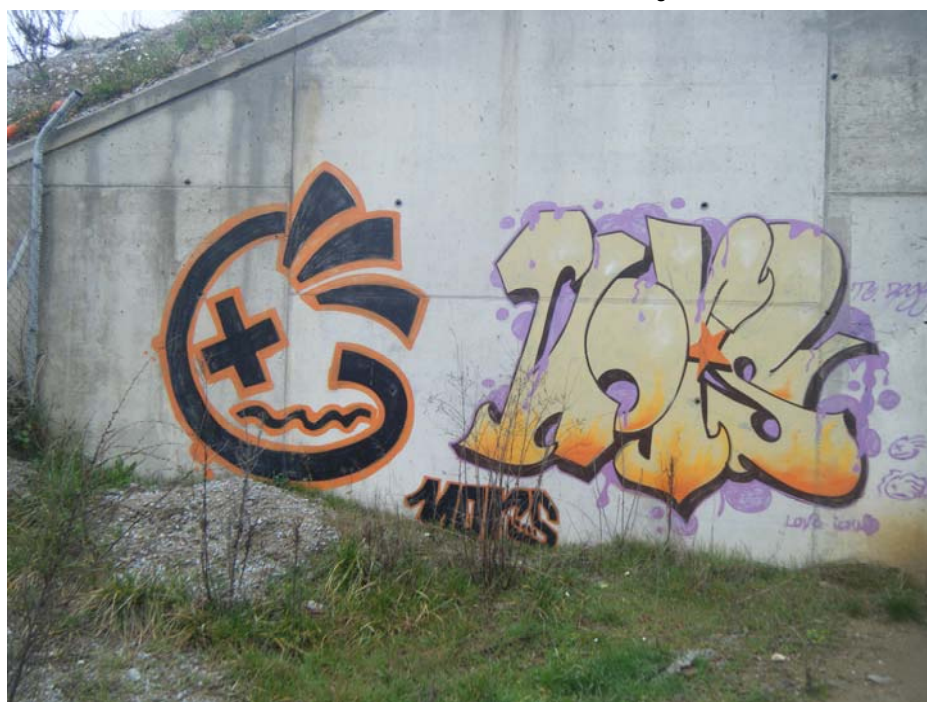
FOTOGRAFIA N° 18: Pintadas en la aleta del estribo de entrada
