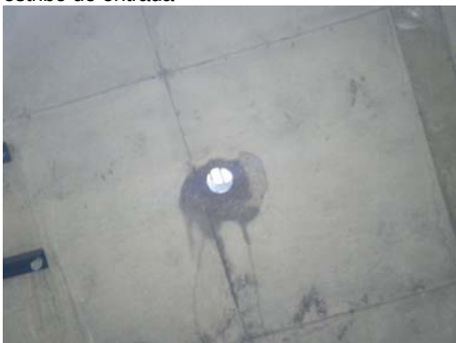
Fotografía nº 9. Desconchón en la cara inferior del voladizo derecho
