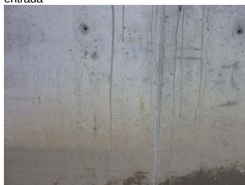
Fotografía nº 10. Fisura en el hastial de salida
