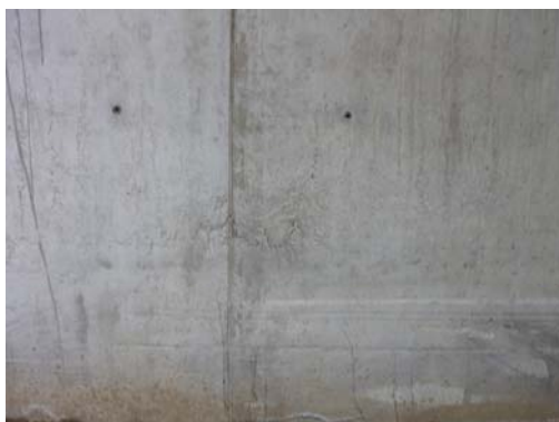
Fotografía nº 7. Nido de grava en el estribo E2
