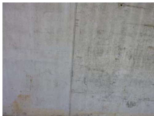
Fotografía nº 12. Fisura en el hastial de entrada
