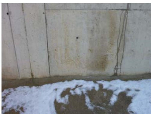
Fotografía nº 9. Nido de grava en la aleta izquierda del estribo de entrada
