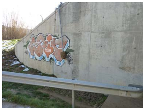
Fotografía nº 8. Pintadas en el estribo de entrada
