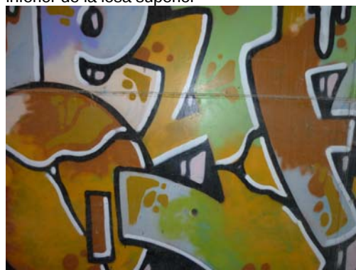
Fotografía nº 12. Fisura en le hastial de entrada
