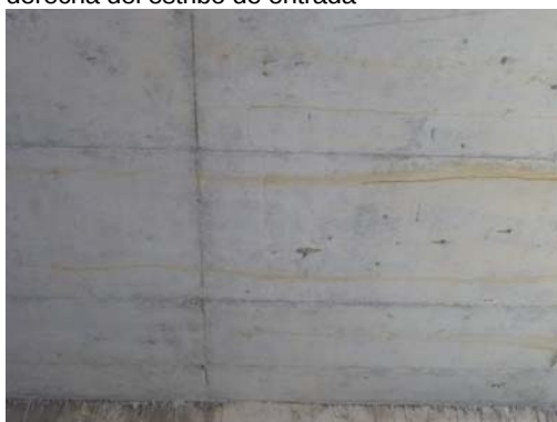
Fotografía nº 11. Fisura en el paramento inferior de la losa superior
