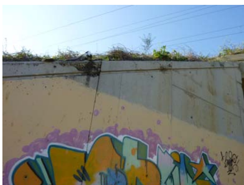
Fotografía nº 9. Nido de grava en la aleta derecha del estribo de entrada
