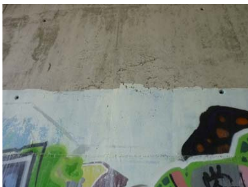
Fotografía nº 7. Nido de grava en el estribo E2
