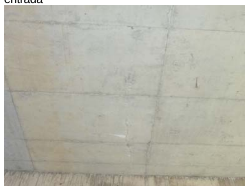
Fotografía nº 10. Eflorescencia en la cara inferior de la losa superior
