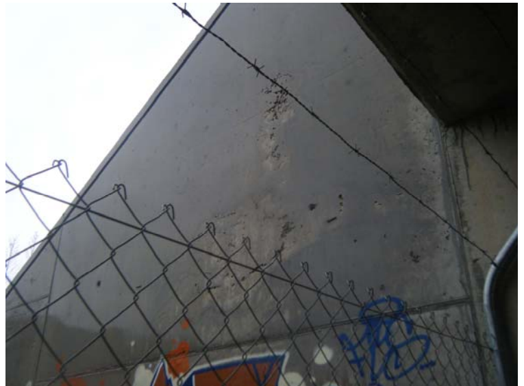
Fotografía N°11: Nidos de grava aleta derecha de estribo 1
