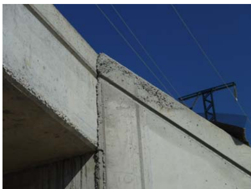
Fotografía nº 7. Nido de grava en la aleta derecha del estribo de salida
