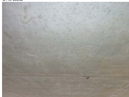
Fotografía nº 10. Fisuras en el paramento inferior de la losa superior
