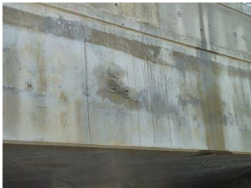
Fotografía nº 7. Nido de grava en la embocadura izquierda
