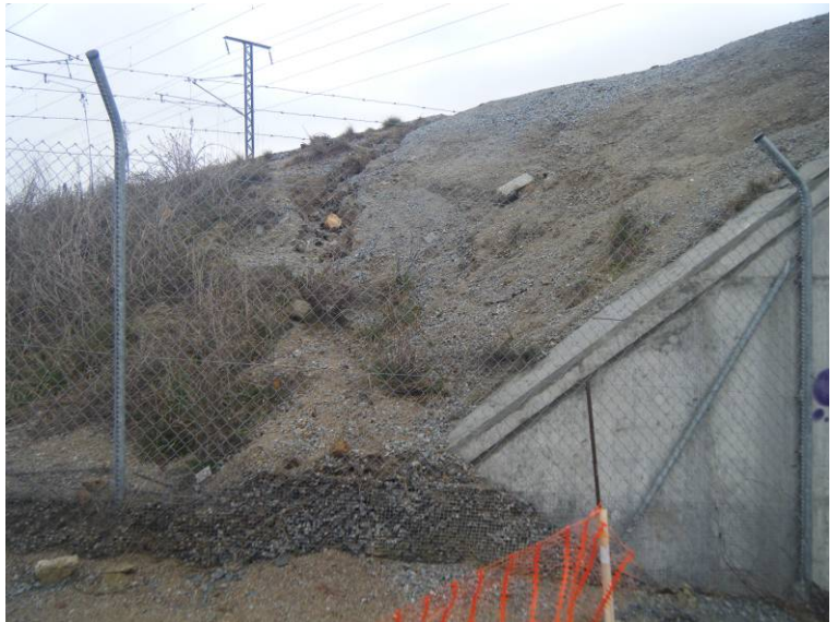
Fotografía N°13: Erosión en terraplén derecho estribo 1
