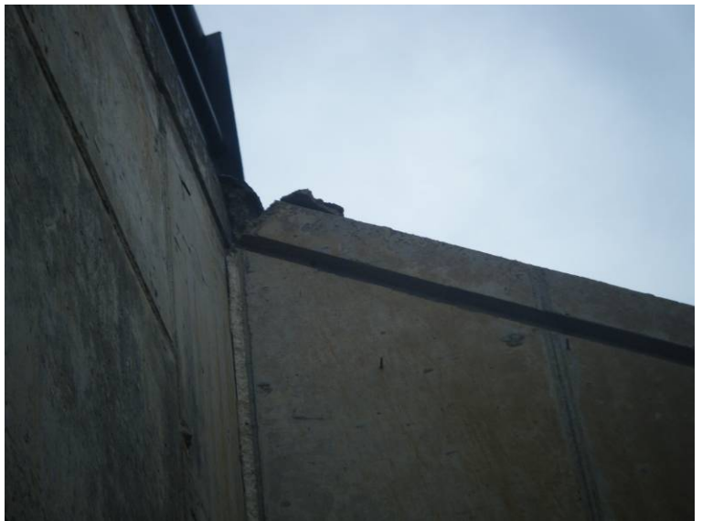
Fotografía N°14: Desconchón en aleta derecha estribo 2
