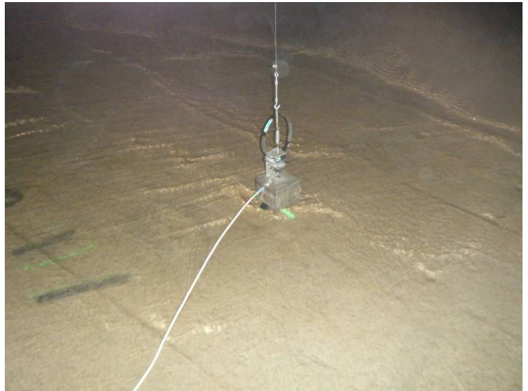
Fotografía N°4: Detalle de uno de los anillos dis- puestos
