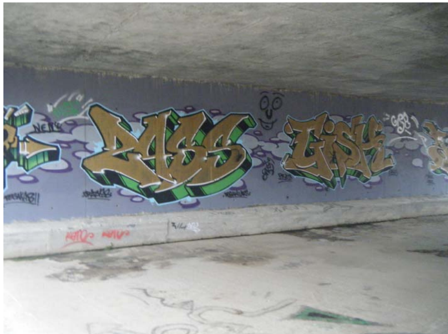
FOTOGRAFIA N° 14: Pintadas en el estribo de salida
