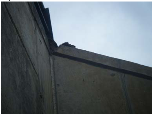
Fotografía nº 9. Desconchón en la aleta derecha del estribo de salida
