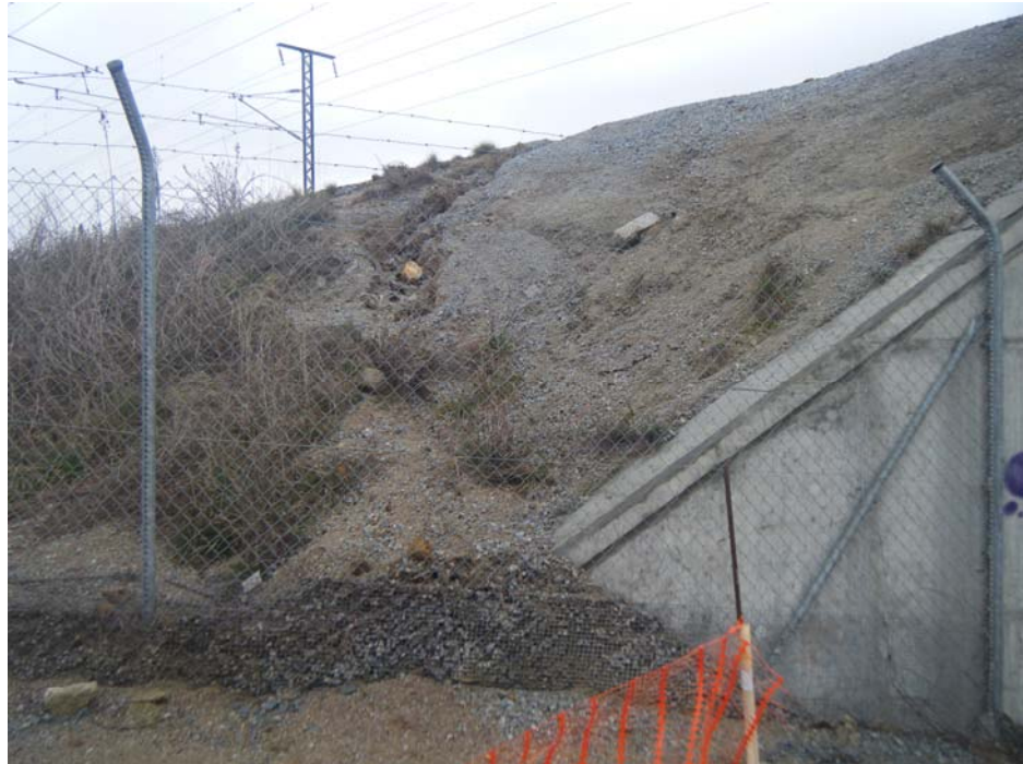
FOTOGRAFIA N° 15: Erosión en el terraplén derecho del estribo de entrada
