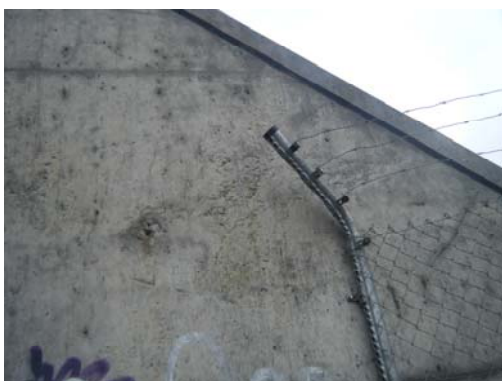
Fotografía nº 7. Nido de grava en la aleta izquierda del estribo E1
