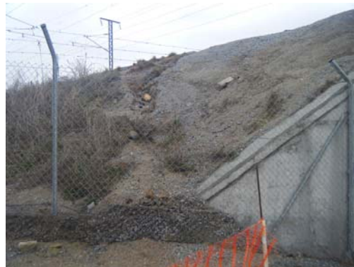
Fotografía nº 10. Erosión del terraplén derecho del estribo de entrada
