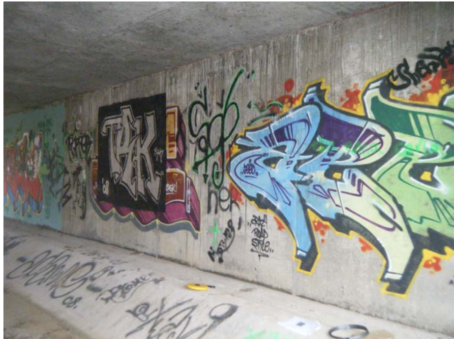
FOTOGRAFIA N° 13: Pintadas en el estribo 1
