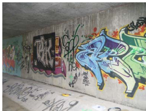
Fotografía nº 8. Pintadas en el estribo de entrada
