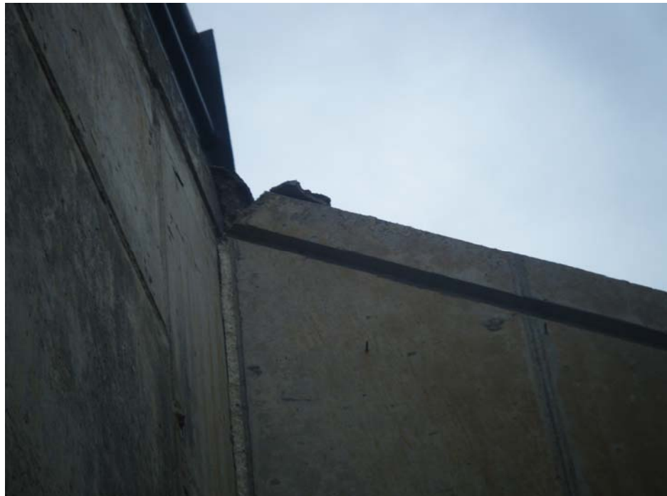
FOTOGRAFIA N° 16: Desconchón en la aleta derecha del estribo de salida
