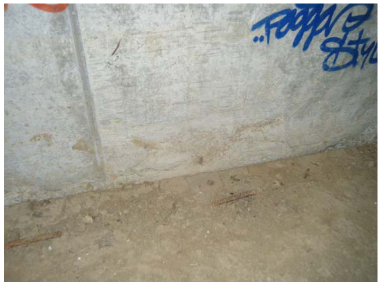
Fotografía N°12: Nidos de grava hastial de estribo 1
