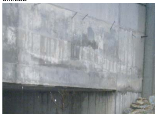
Fotografía nº 9. Ferralla auxiliar sin recubrimiento
