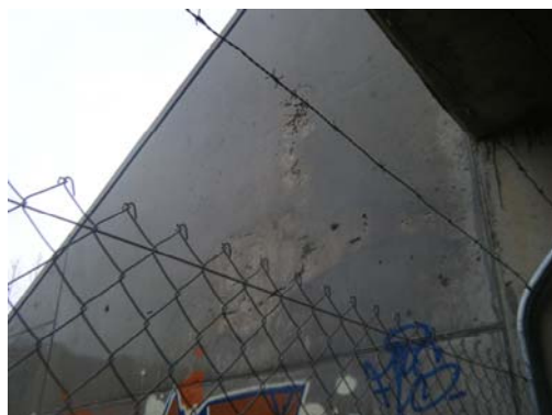
Fotografía nº 7. Nido de grava en la aleta derecha del estribo E1
