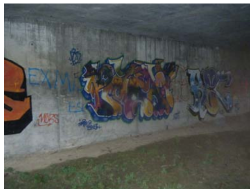
Fotografía nº 8. Pintadas en el estribo de entrada
