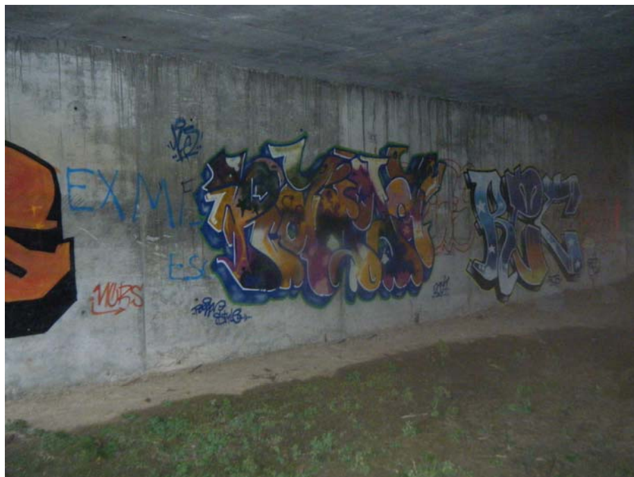
FOTOGRAFIA N° 13: Pintadas en el estribo 1
