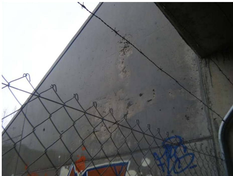
FOTOGRAFIA N° 12: Nido de grava en la aleta derecha de E 1
