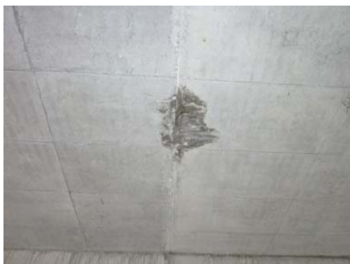
Fotografía nº 11. Humedades en el paramento inferior de la losa superior
