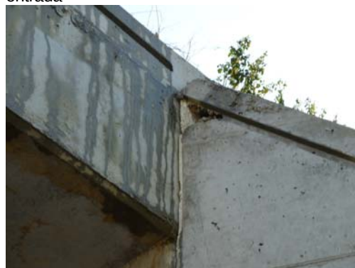
Fotografía nº 10. Coquera en la aleta izquierda del estribo de entrada
