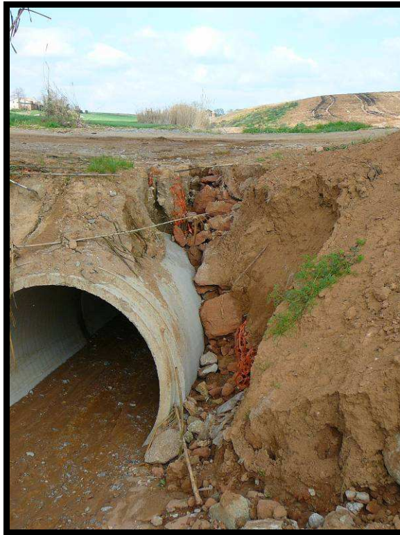
19. Erosión en boca de drenaje, aguas abajo del camino
