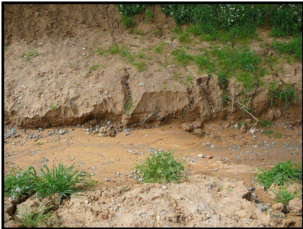
20. Erosión en margen izquierda, aguas abajo.
