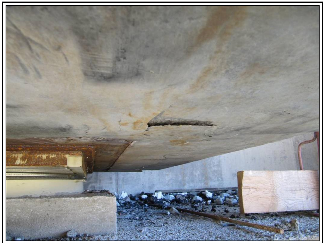
Desconchón en sobre apoyo izquierdo del estribo uno.
