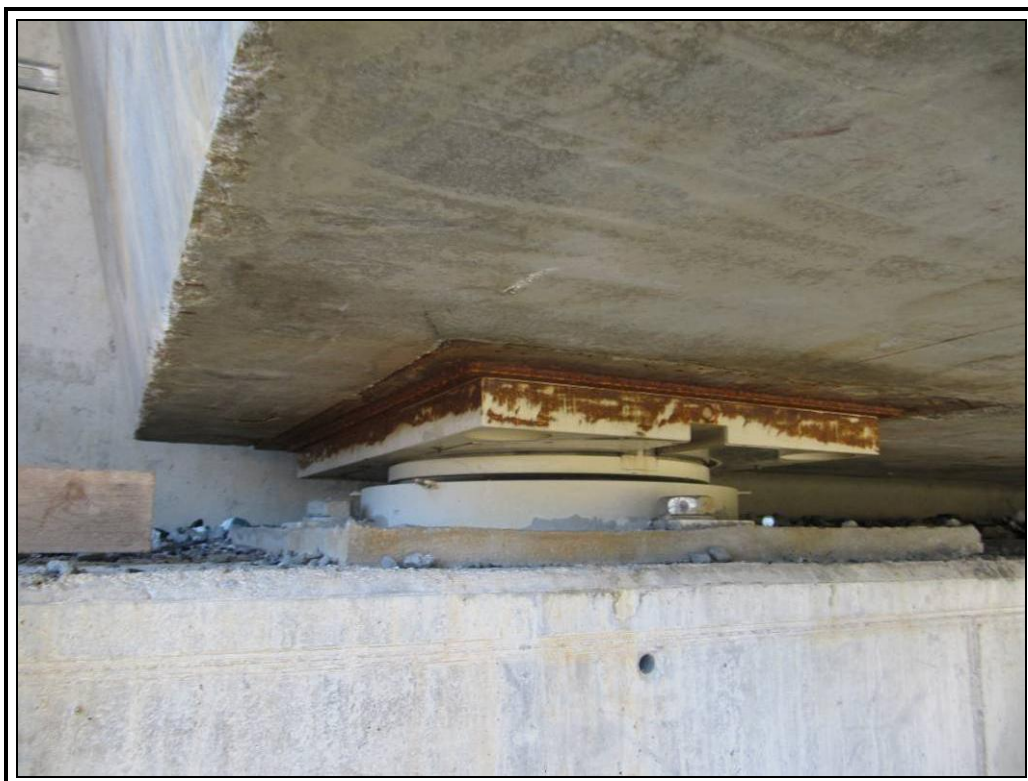
Corrosión en plato superior del apoyo derecho de estribo uno
