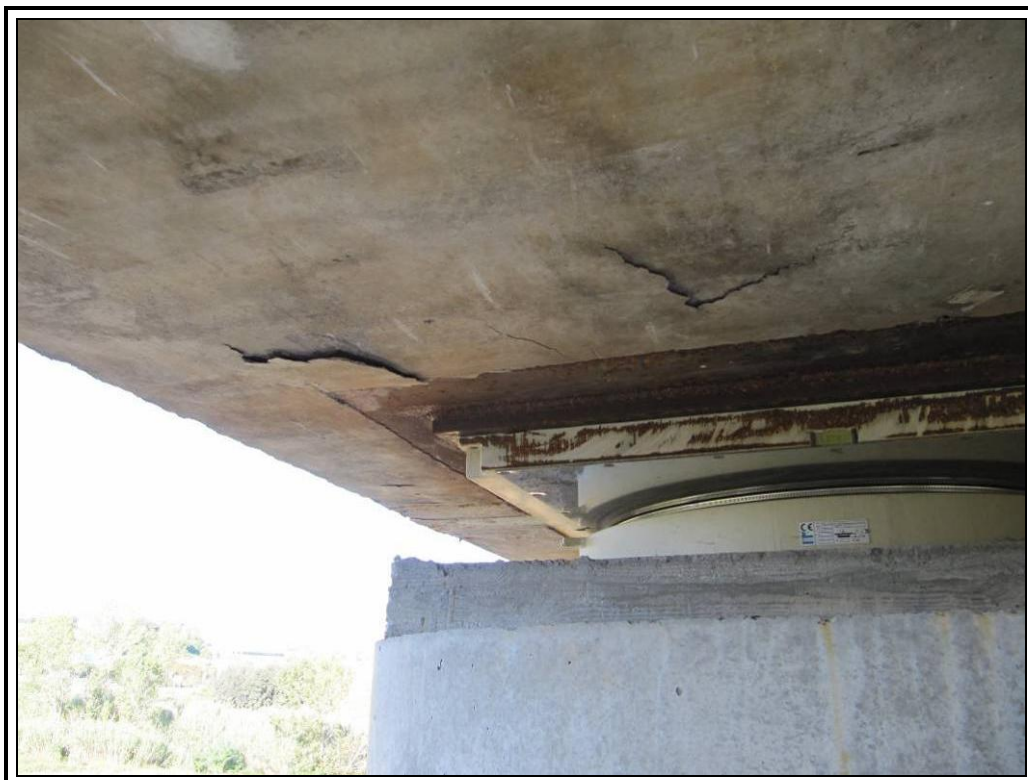
Desconchón en sobre apoyo izquierdo de la pila uno.
