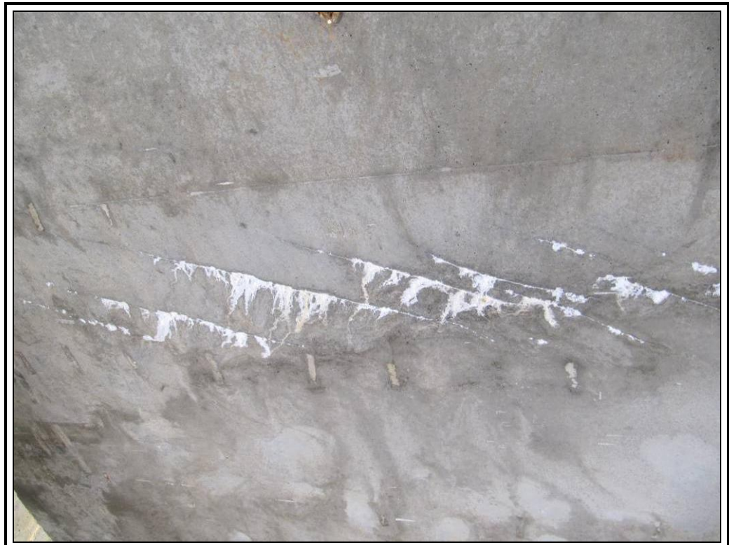
Fisuras oblicuas en vano 4 cerca de pila 3
