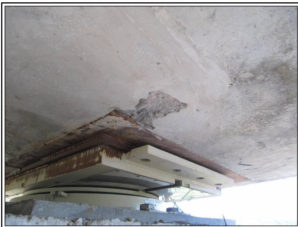
Desconchón en sobre apoyo derecho de la pila dos sobre reparación.
