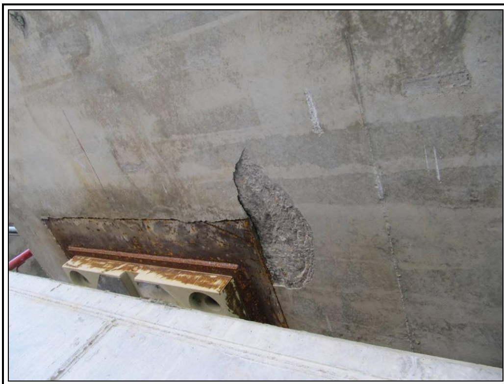
Desconchón en sobre apoyo derecho del estribo uno.
