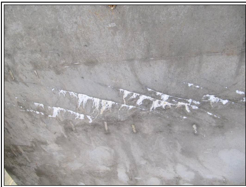
Fisuras oblicuas en vano 4 cerca de pila 3
