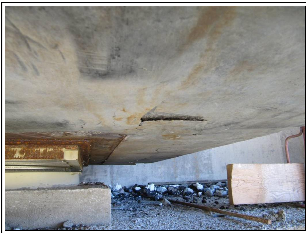
Desconchón en sobre apoyo izquierdo del estribo uno.
