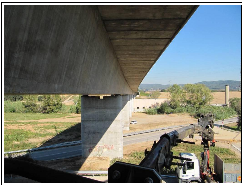
Ausencia de gárgolas bajo los sumideros
