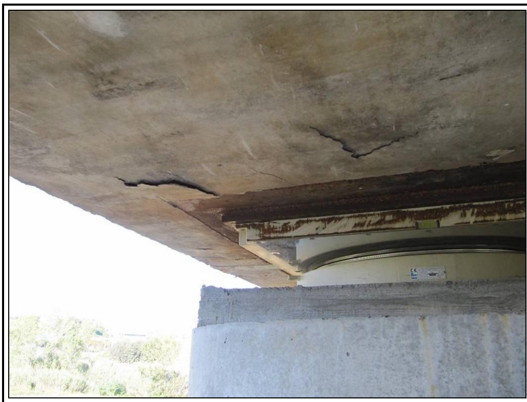
Desconchón en sobre apoyo izquierdo de la pila uno.
