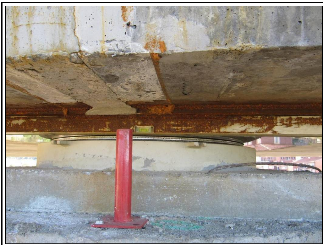
Corrosión en plato superior de apoyo izquierdo de la pila 2
