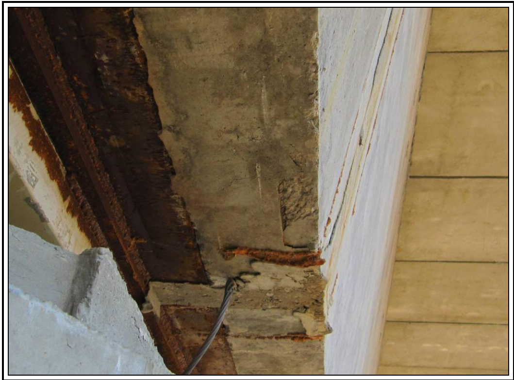
Armadura vista sobre pila uno lado derecho
