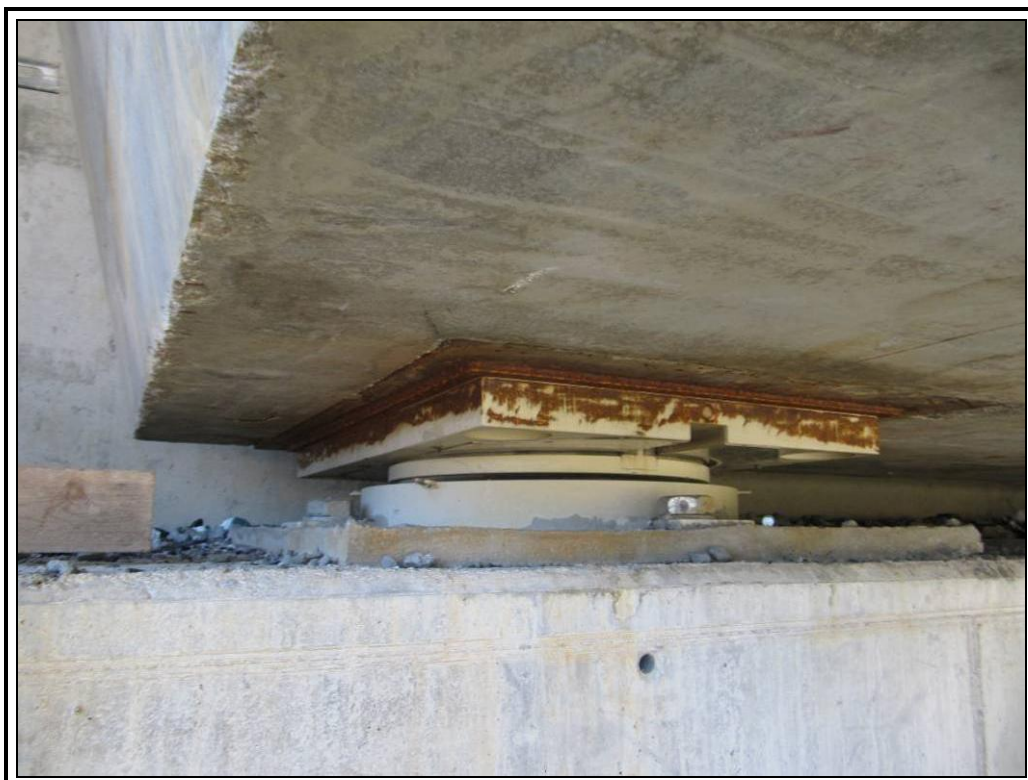
Corrosión en plato superior del apoyo derecho de estribo uno
