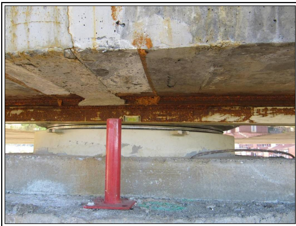
Corrosión en plato superior de apoyo izquierdo de la pila 2
