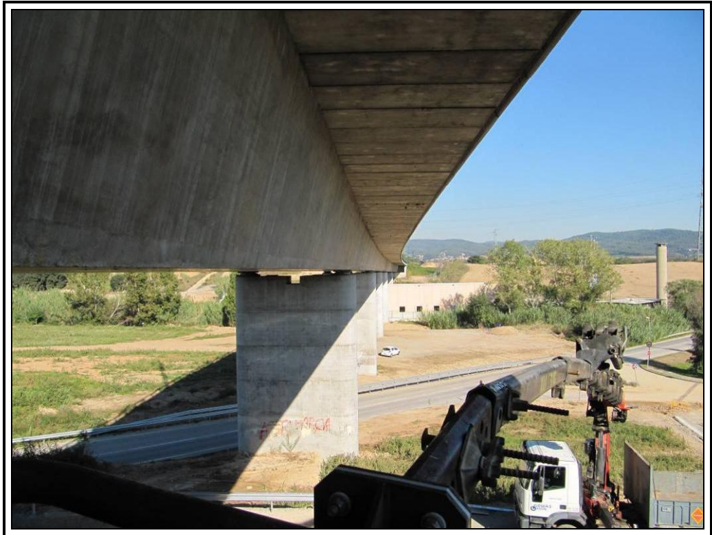
Ausencia de gárgolas bajo los sumideros
