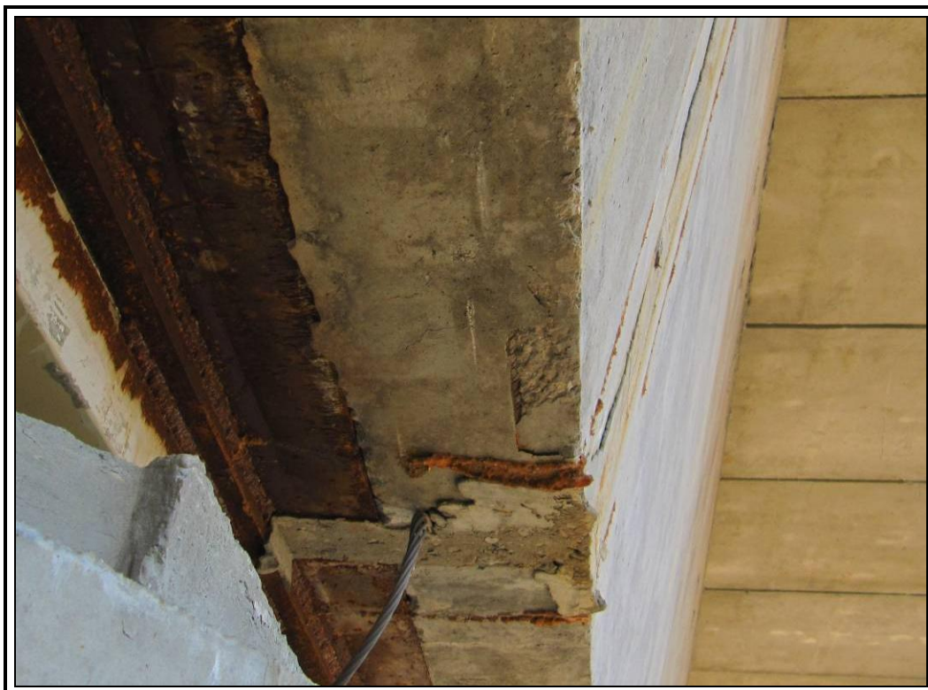
Armadura vista sobre pila uno lado derecho
