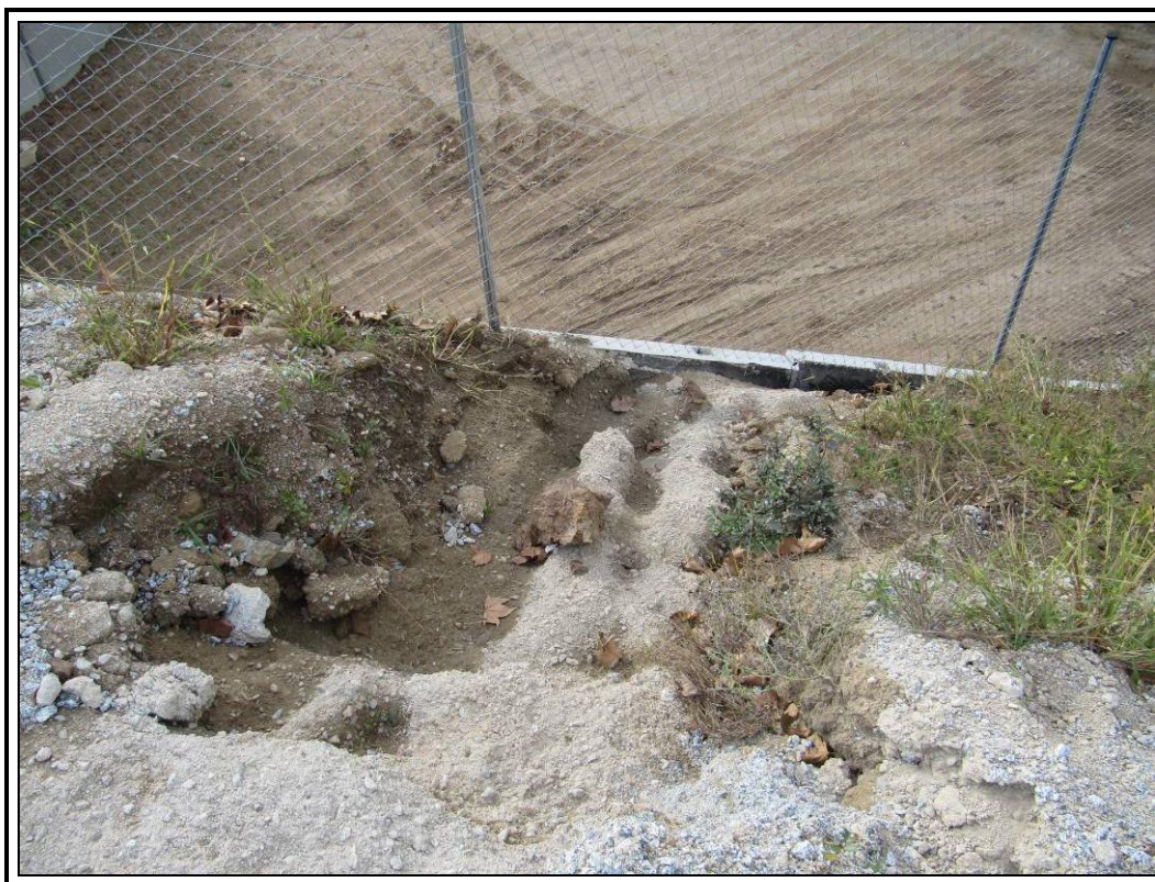
Erosión en el talud del terraplén izquierdo del estribo 1.
