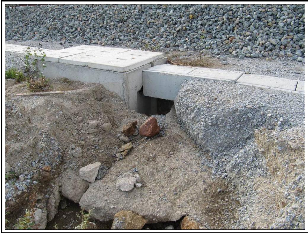
Erosión en el talud del terraplén derecho del estribo 2.
