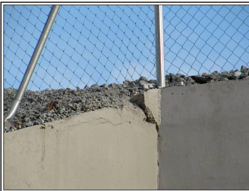
Desconchón en parte superior de elementos de aleta izquierda estribo 2.
