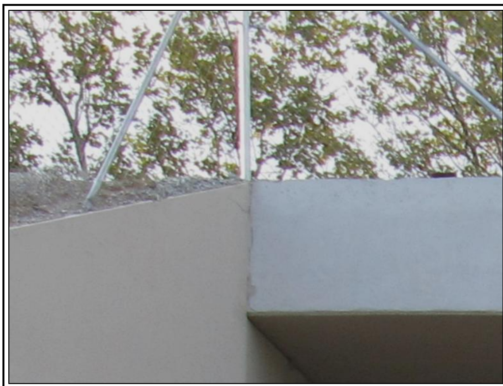
Fisura en elemento prefabricado de aleta izquierda estribo 2.
