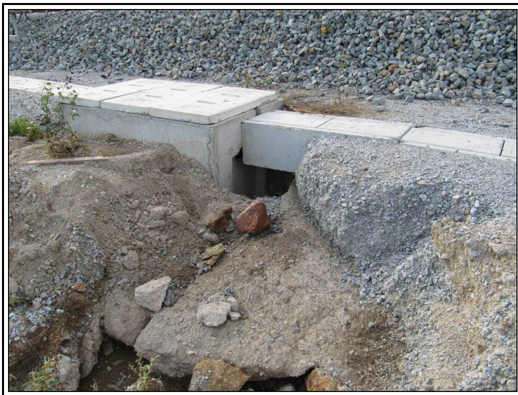
Erosión en el talud del terraplén derecho del estribo 2.
