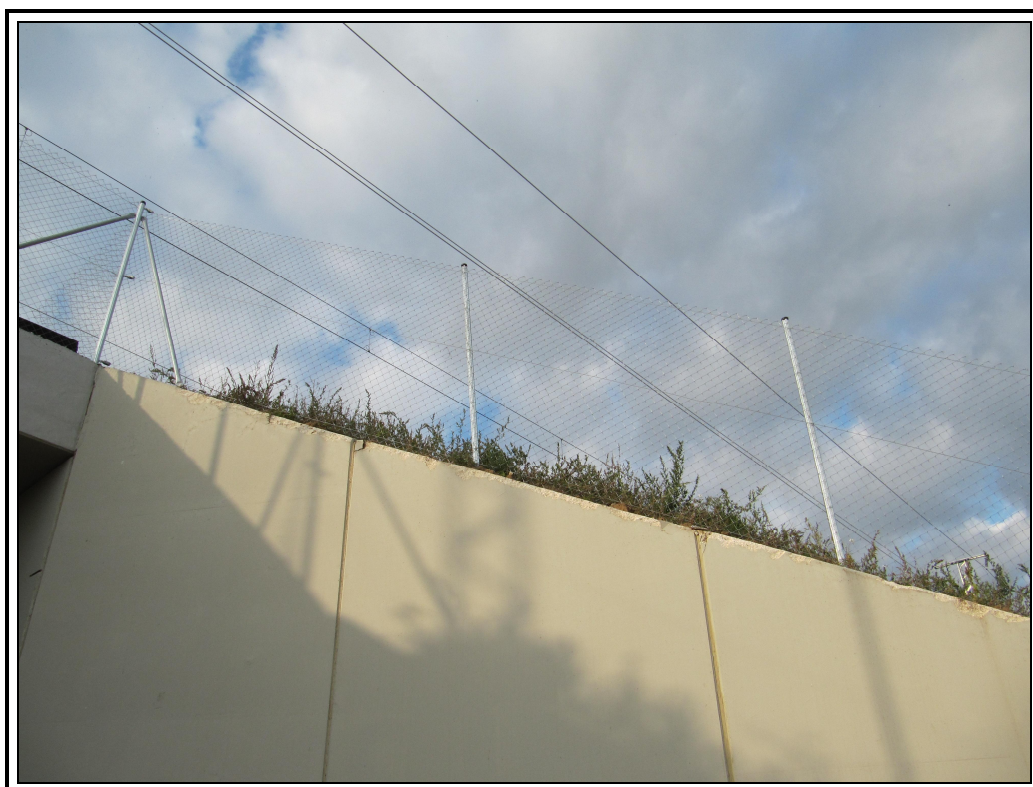
Desconchón en parte superior de elementos de aleta derecha estribo 2.
