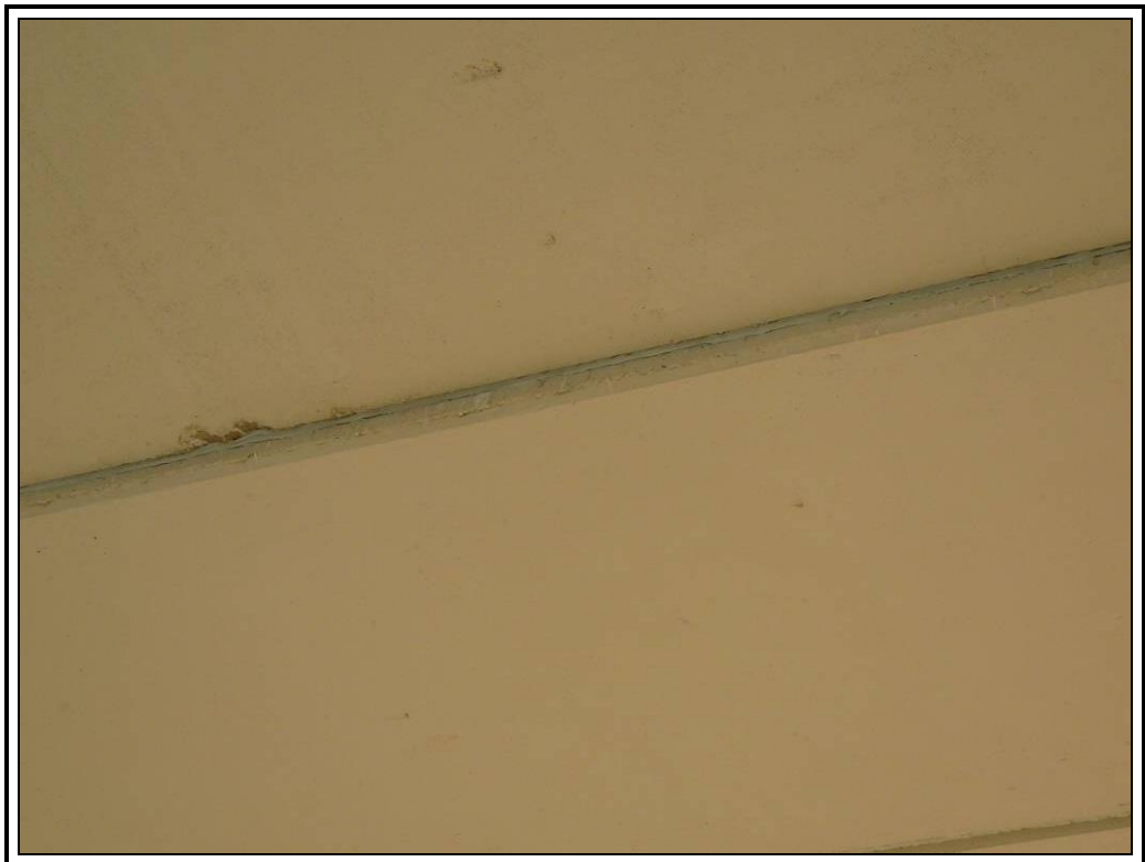
Detalle del deterioro anterior
