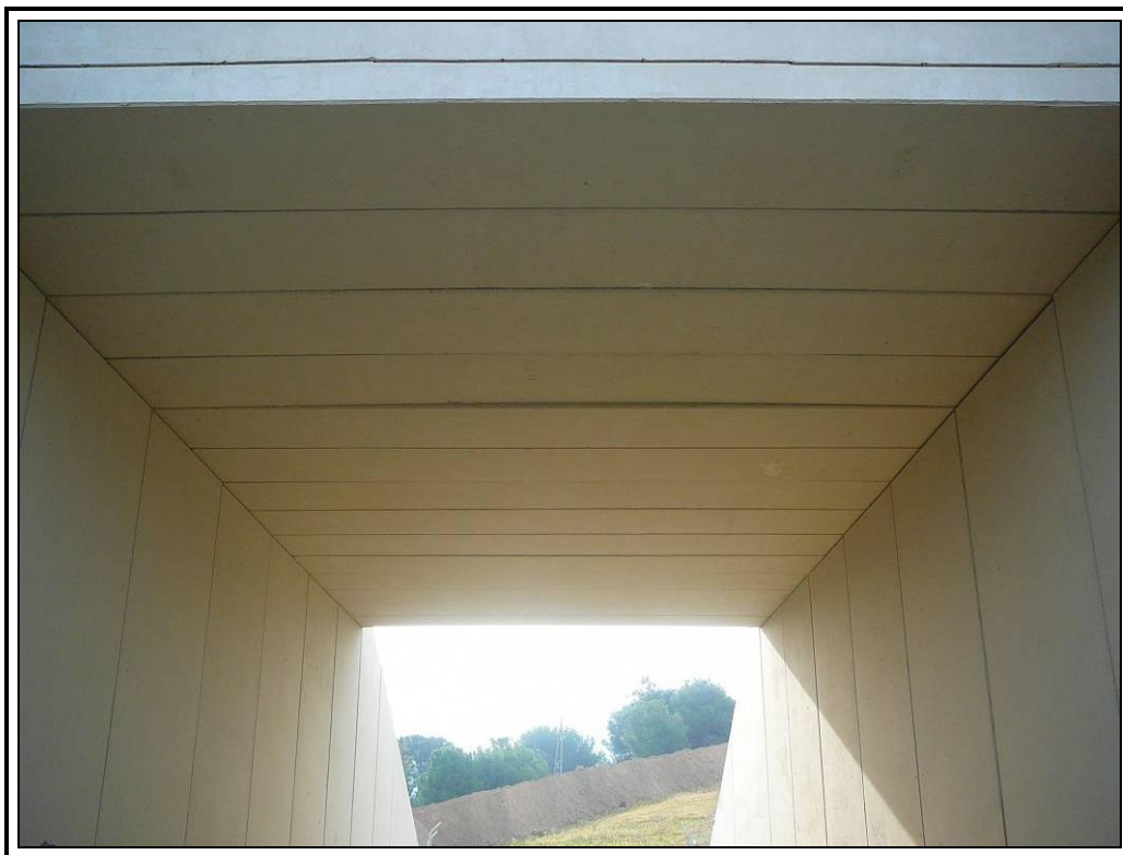
Falta de alineación entre elementos del dintel
