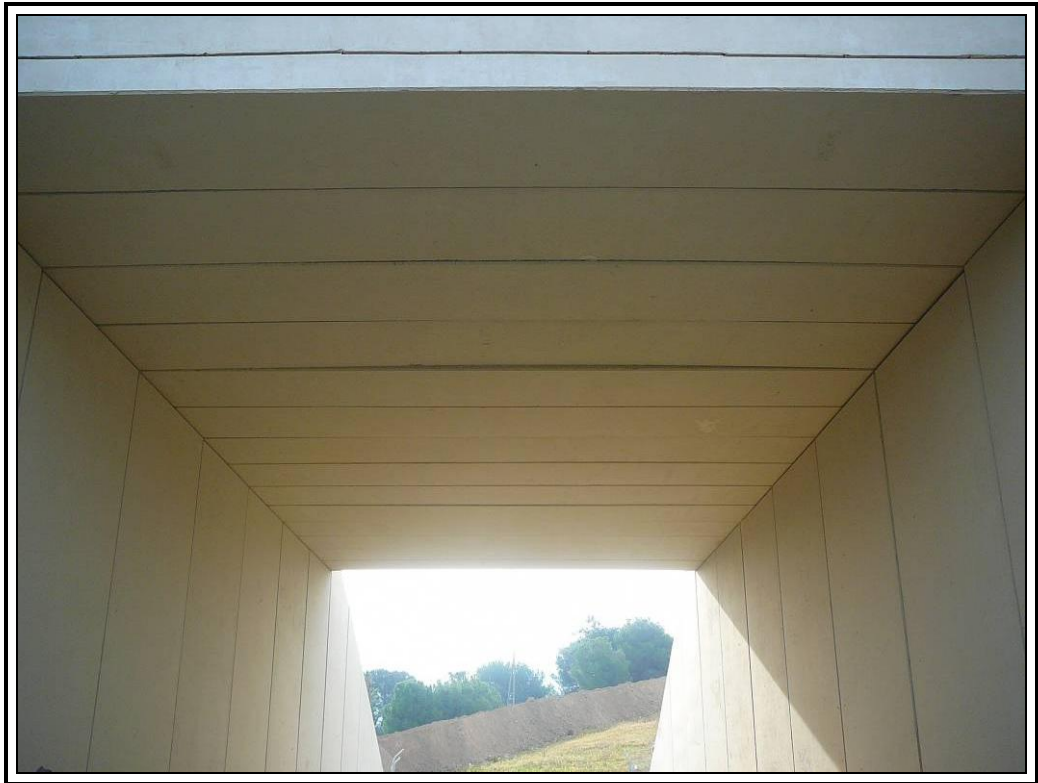
Falta de alineación entre elementos del dintel
