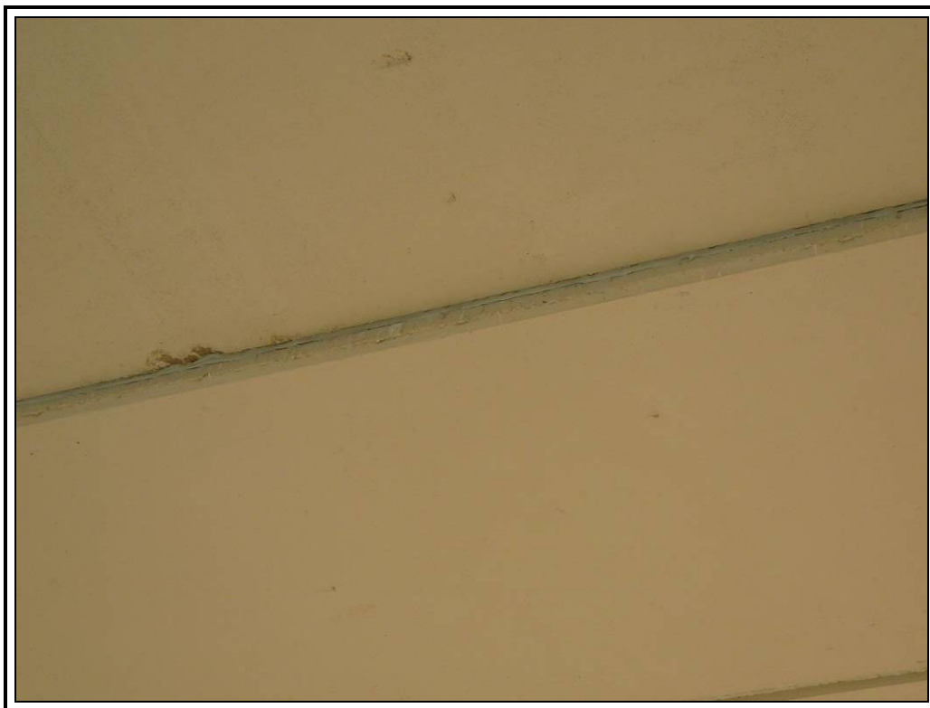
Detalle del deterioro anterior
