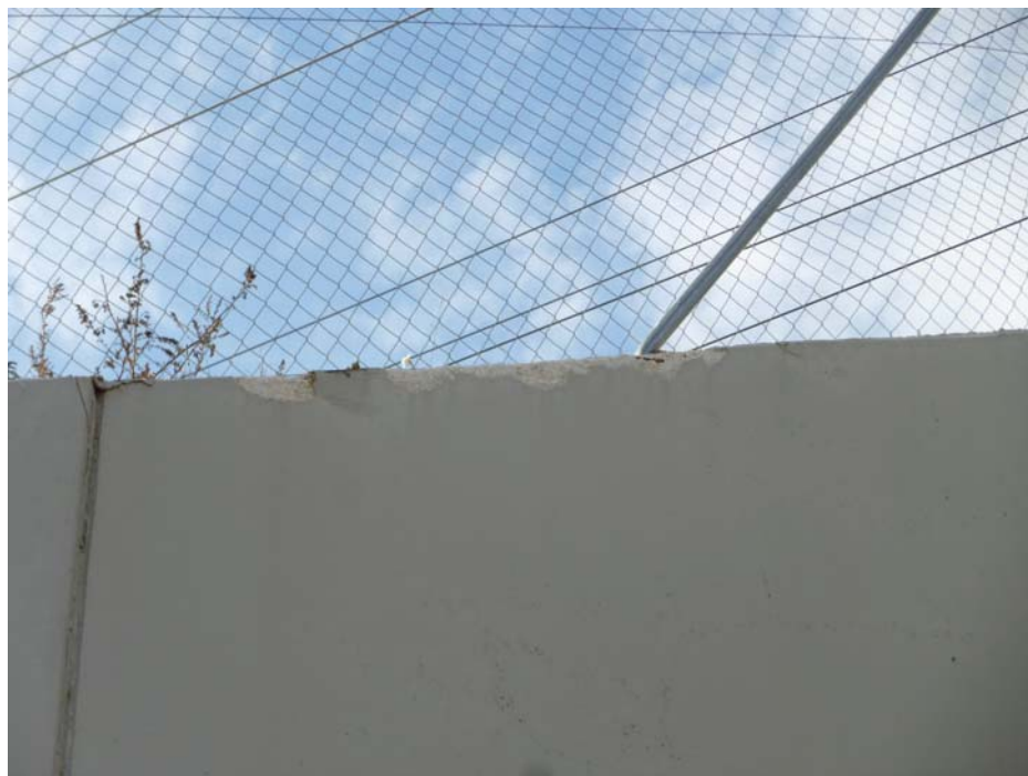
FOTOGRAFIA N° 12: Desconchones en la aleta derecha del estribo de entrada
