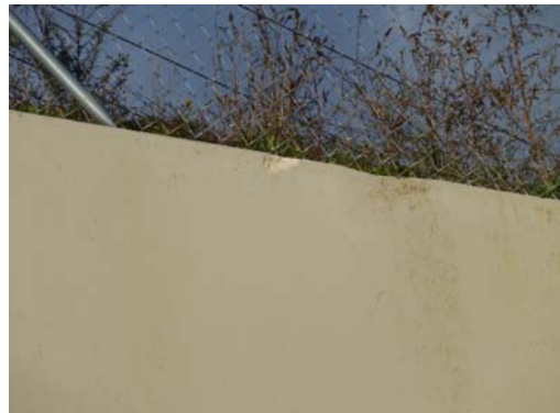
Fotografía nº 8. Desconchones en la aleta derecha del estribo de salida.
