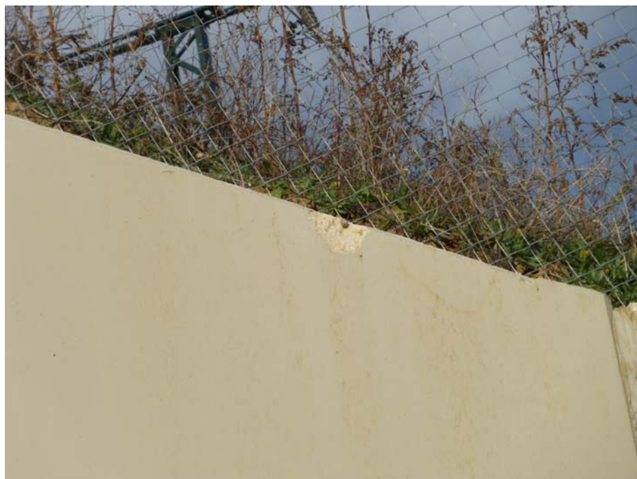
FOTOGRAFIA N° 11: Desconchones en la aleta derecha del estribo de salida
