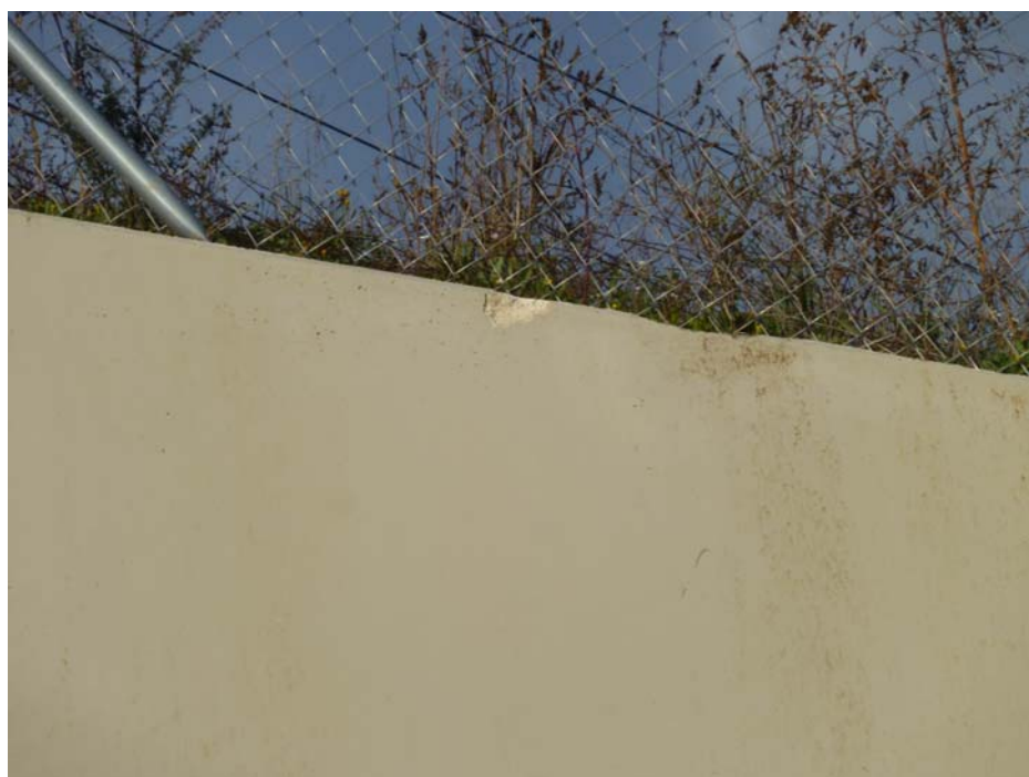
FOTOGRAFIA N° 12: Desconchones en la aleta derecha del estribo de salida
