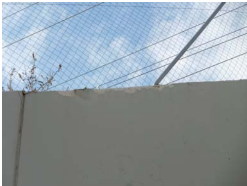
Fotografía nº 7. Desconchones en la aleta derecha del estribo de entrada.
