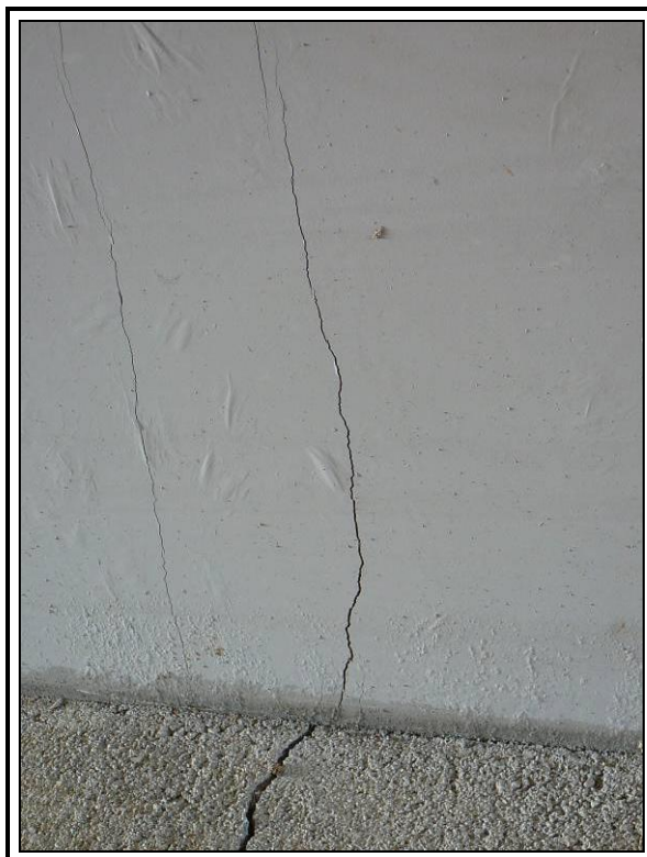
Detalle del deterioro anterior
