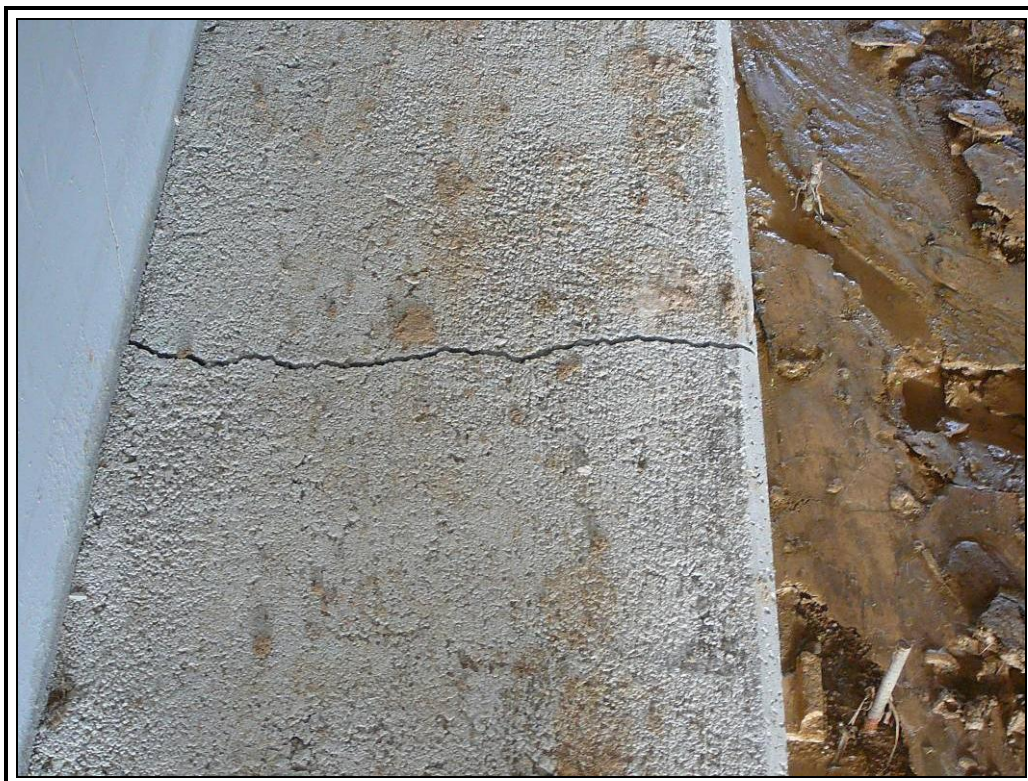
Fisura reproducida sobre el paso seco
