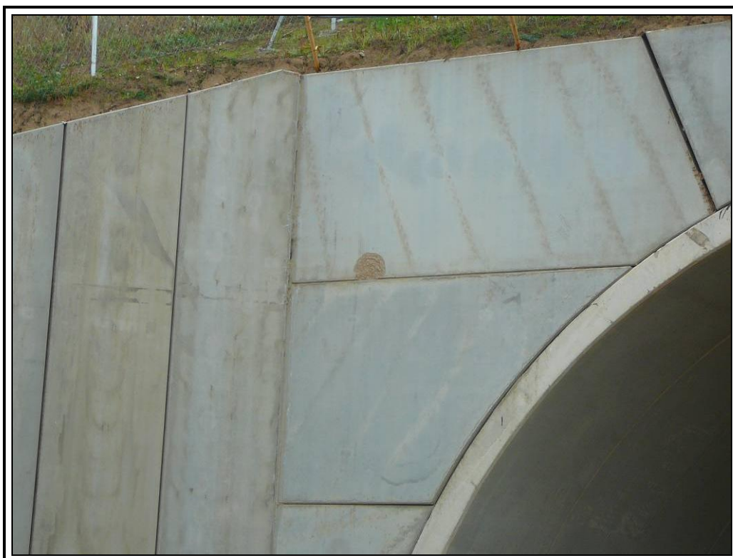
Desconchón en elemento del tímpano del acceso izquierdo
