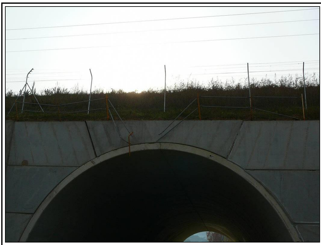
Barandilla provisional deteriorada sin retirar
