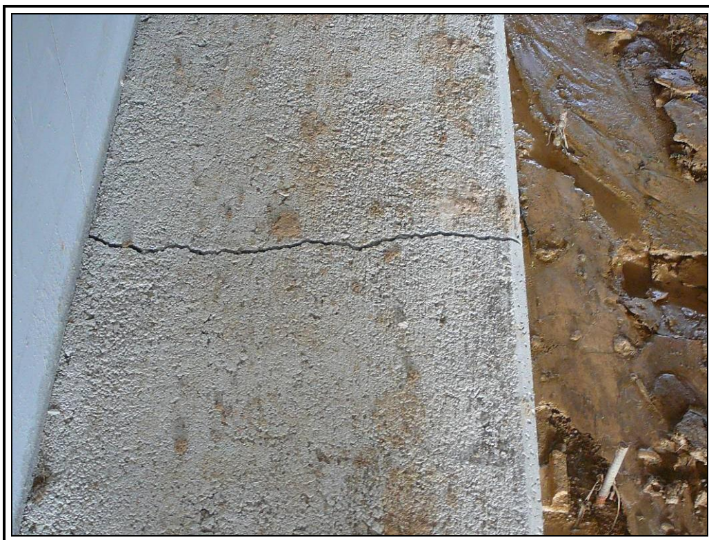
Fisura reproducida sobre el paso seco
