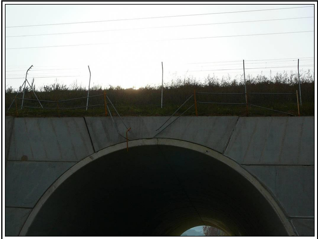
Barandilla provisional deteriorada sin retirar
