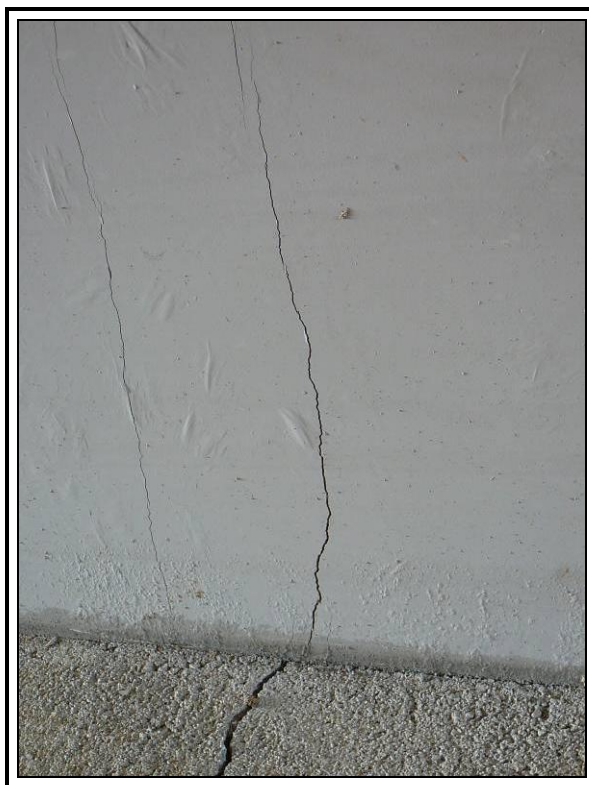
Detalle del deterioro anterior
