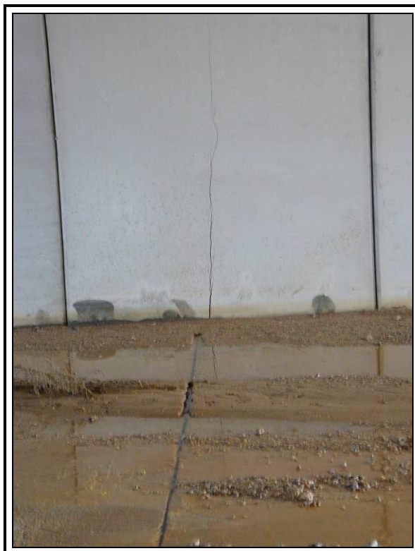
Junta y arranque de la fisura en el anillo central de la bóveda
