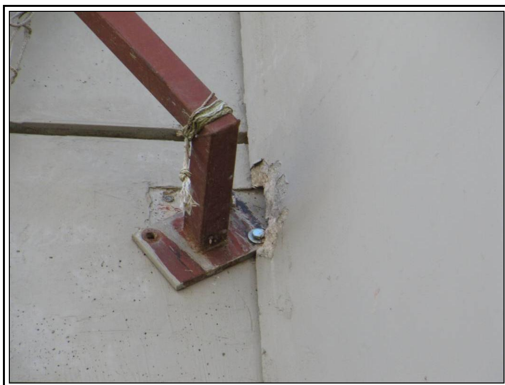
Desconchones en aleta izquierda de hastial uno y fijación deteriorada
