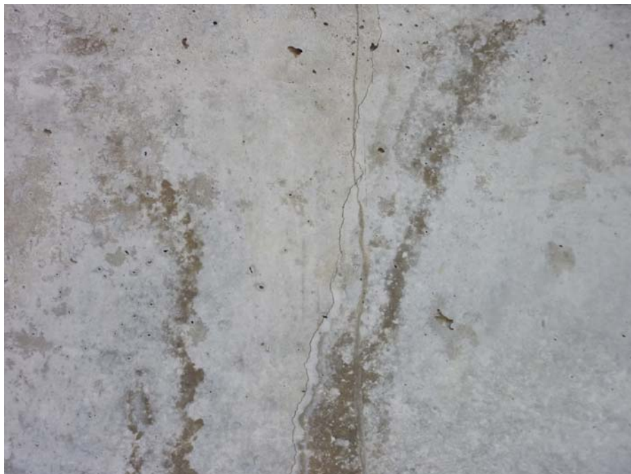
FOTOGRAFIA N° 22: Fisura en el hastial de salida
