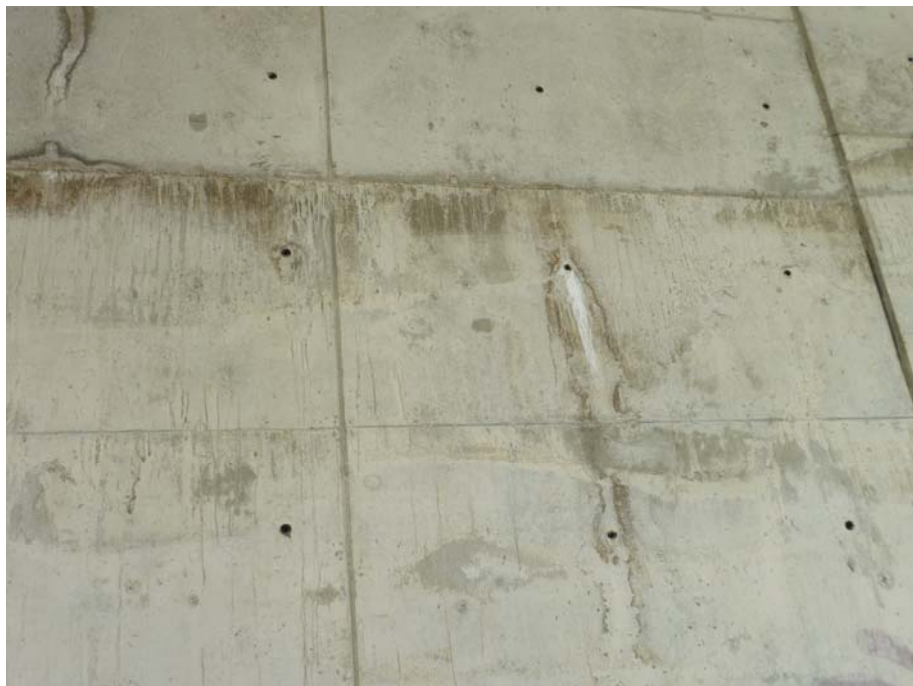
FOTOGRAFIA N° 16: Humedades y eflorescencias en el hastial de entrada
