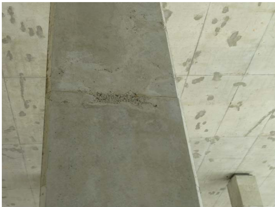
FOTOGRAFIA N° 39: Nido de grava en el fuste n° 2 de la alineación de pilas n° 1
