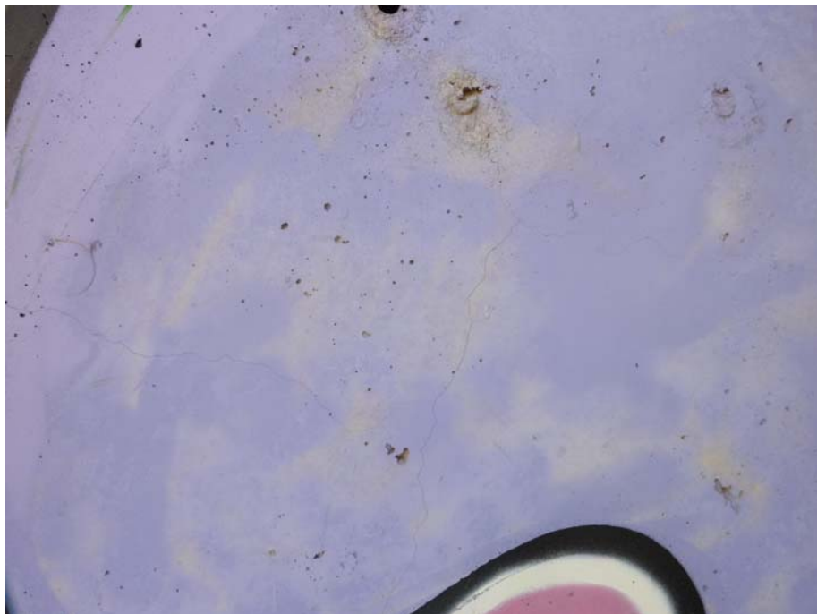
FOTOGRAFIA N° 14: Fisuras en mapa en el hastial de entrada
