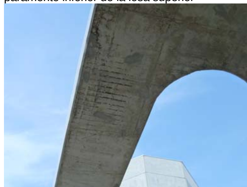
Fotografía nº 17. Armaduras vistas en el paramento inferior de la losa superior
