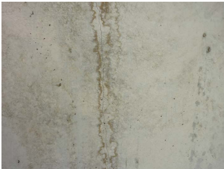
FOTOGRAFIA N° 23: Fisura en el hastial de salida
