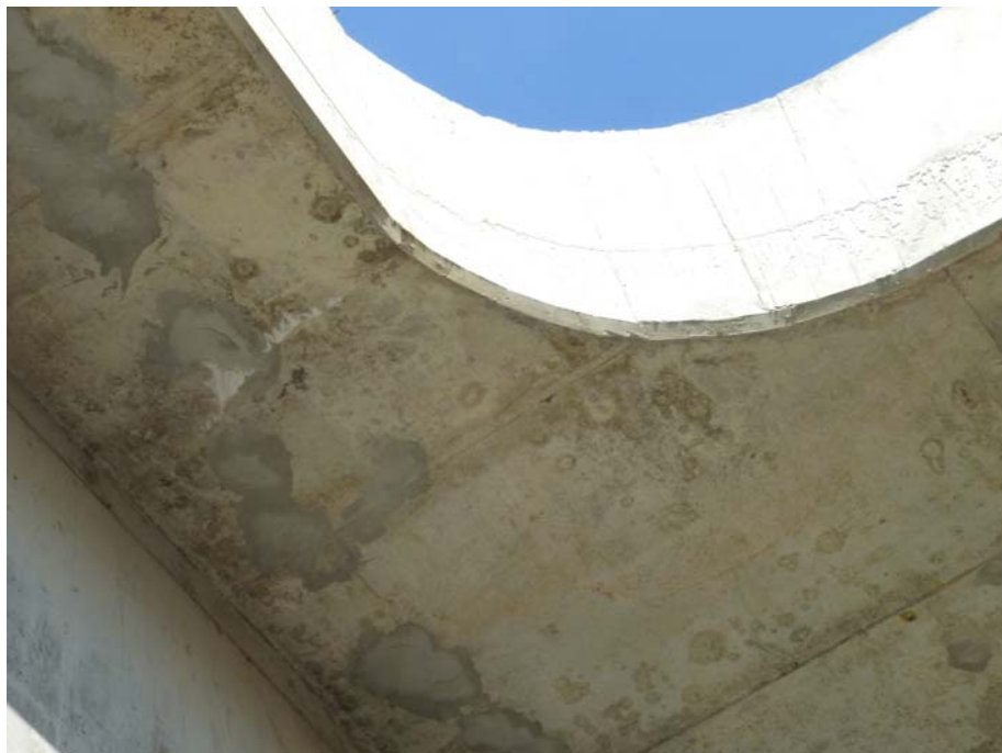
FOTOGRAFIA N° 28: Fisura y eflorescencia en el paramento inferior de la losa superior
