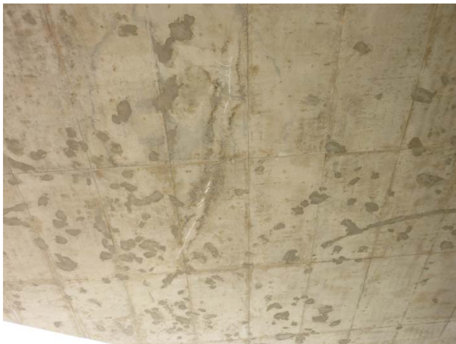
FOTOGRAFIA N° 27: Fisura y eflorescencia en el paramento inferior de la losa superior
