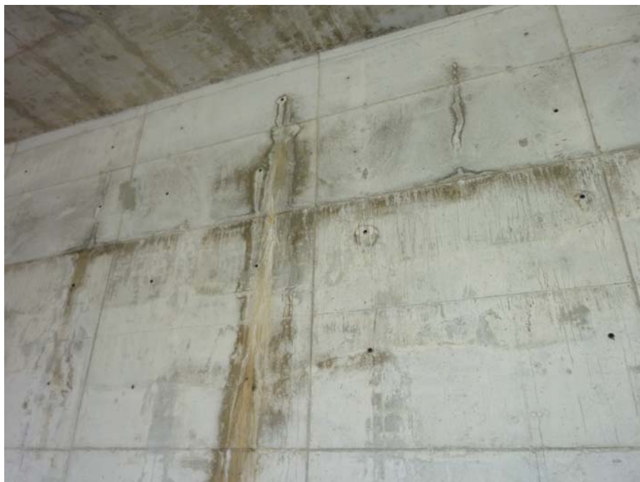
FOTOGRAFIA N° 15: Humedades y eflorescencias en el hastial de entrada
