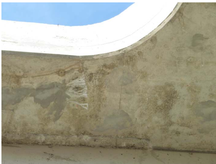
FOTOGRAFIA N° 29: Fisura y eflorescencia en el paramento inferior de la losa superior
