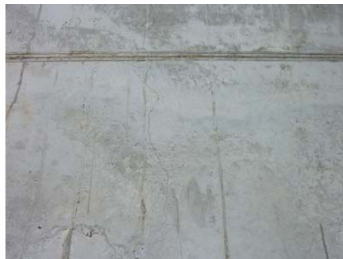
Fotografía nº 11. Fisura en el hastial de entrada
