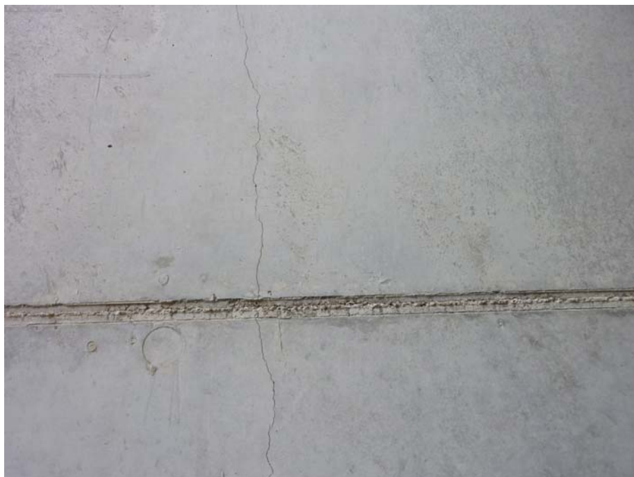
FOTOGRAFIA N° 21: Fisura en el hastial de salida
