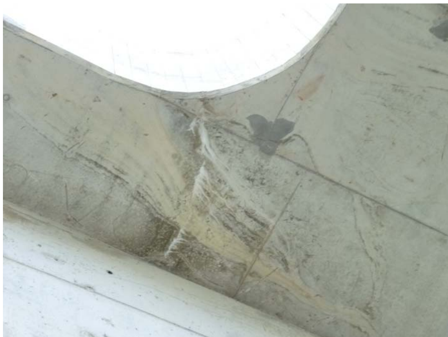
FOTOGRAFIA N° 30: Fisura y eflorescencia en el paramento inferior de la losa superior
