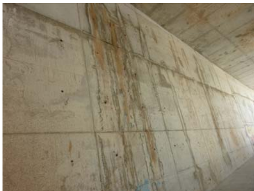
Fotografía nº 10. Humedades y eflorescencias en el hastial de entrada
