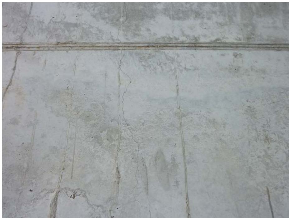
FOTOGRAFIA N° 12: Fisura en el hastial de entrada
