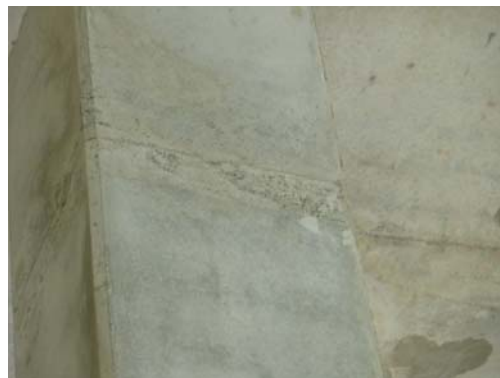
Fotografía nº 19. Nidos de grava en la pila nº 3. Alineación nº 1 de pilas.
