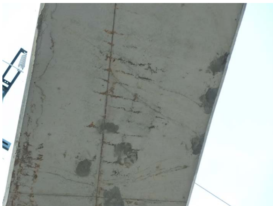
FOTOGRAFIA N° 31: Armaduras vistas en el paramento inferior de la losa superior
