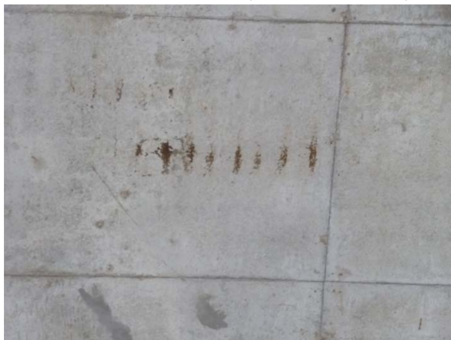
FOTOGRAFIA N° 32: Armaduras vistas en el paramento inferior de la losa superior
