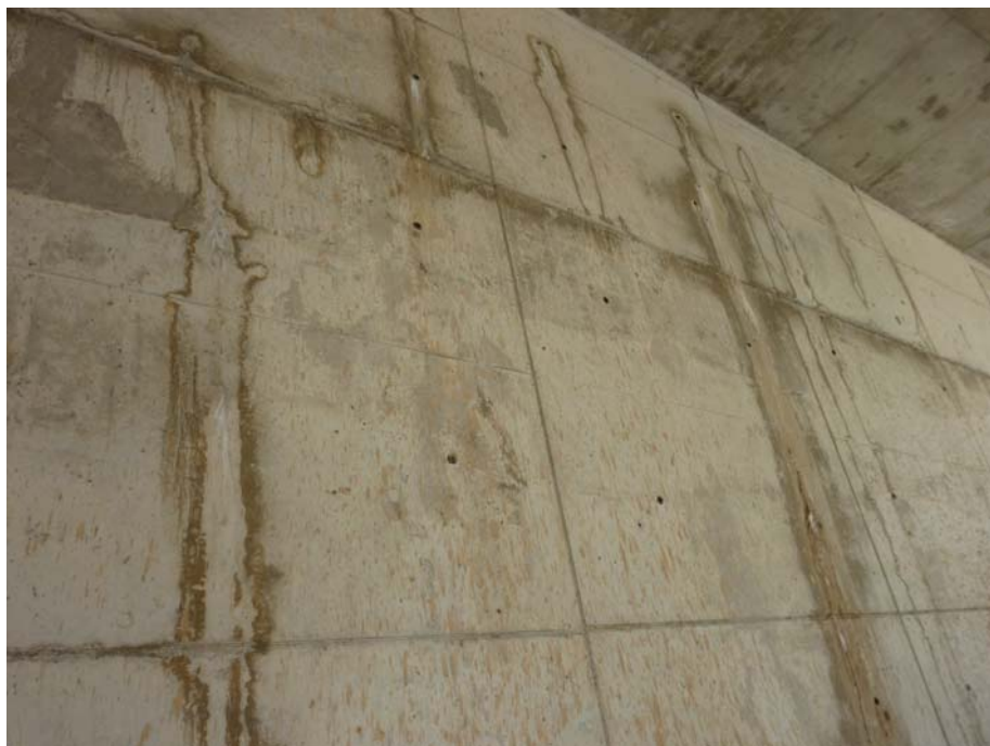
FOTOGRAFIA N° 17: Humedades y eflorescencias en el hastial de entrada
