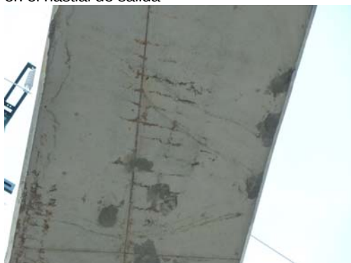
Fotografía nº 16. Armaduras vistas en el paramento inferior de la losa superior
