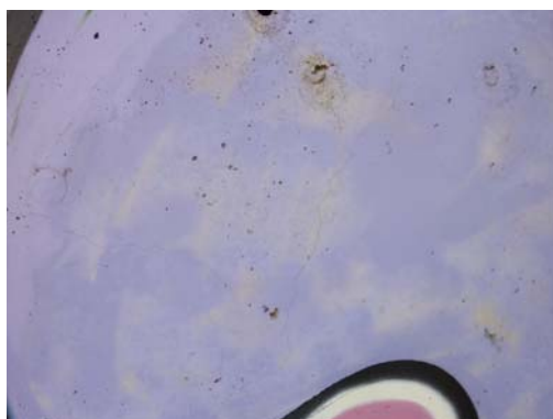
Fotografía nº 12. Fisuras en mapa en el hastial de entrada
