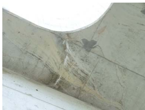
Fotografía nº 15. Fisura y eflorescencias en el paramento inferior de la losa superior
