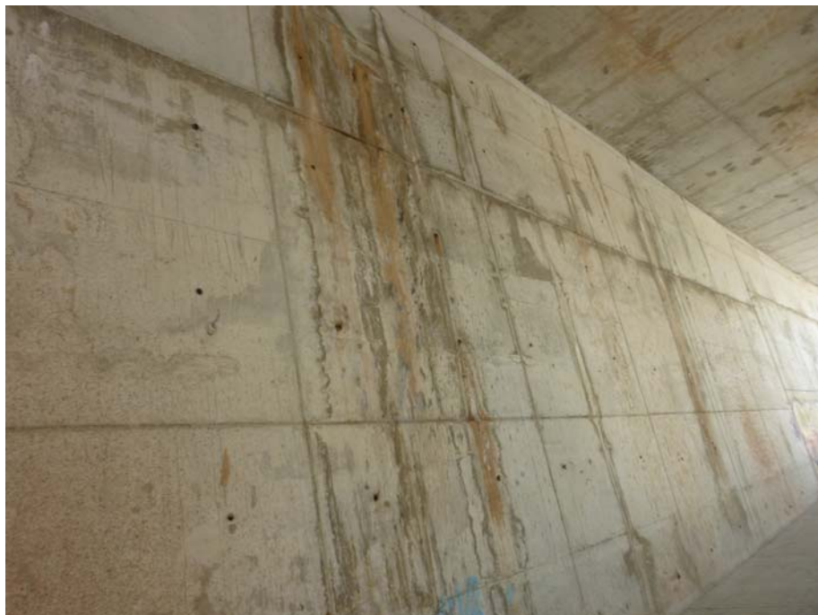
FOTOGRAFIA N° 18: Humedades y eflorescencias en el hastial de entrada
