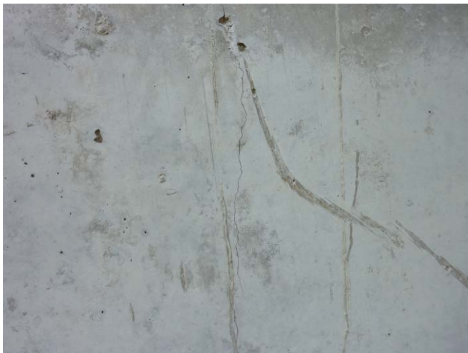
FOTOGRAFIA N° 13: Fisura en el hastial de entrada
