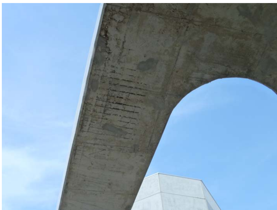
FOTOGRAFIA N° 33: Armaduras vistas en el paramento inferior de la losa superior
