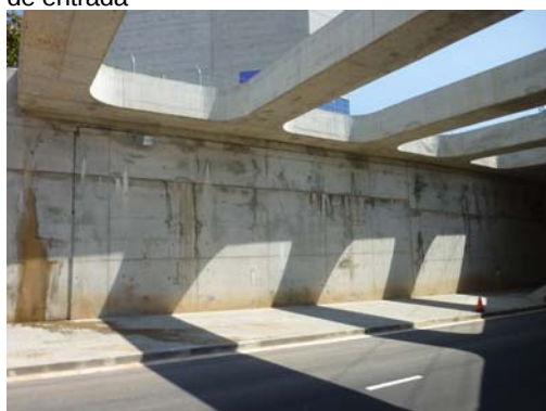
Fotografía nº 14. Humedades y eflorescencias en el hastial de salida
