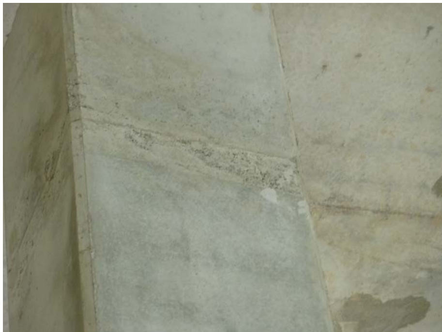
FOTOGRAFIA N° 40: Nido de grava en el fuste n° 3 de la alineación de pilas n° 1
