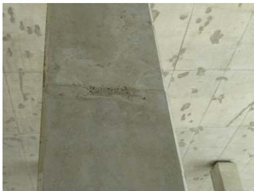
Fotografía nº 18. Nidos de grava en la pila nº 2. Alineación nº 1 de pilas.
