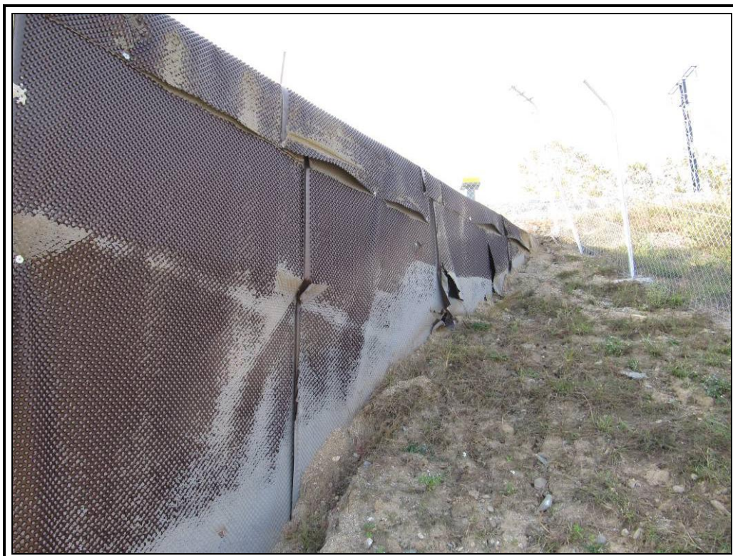
Deficiente ejecución de trasdosado en hastial uno cerca de embocadura izquierda
