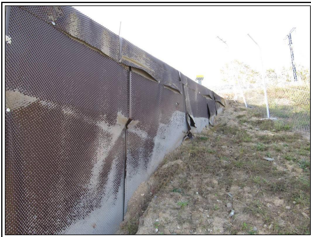
Deficiente ejecución de trasdosado en hastial uno cerca de embocadura izquierda
