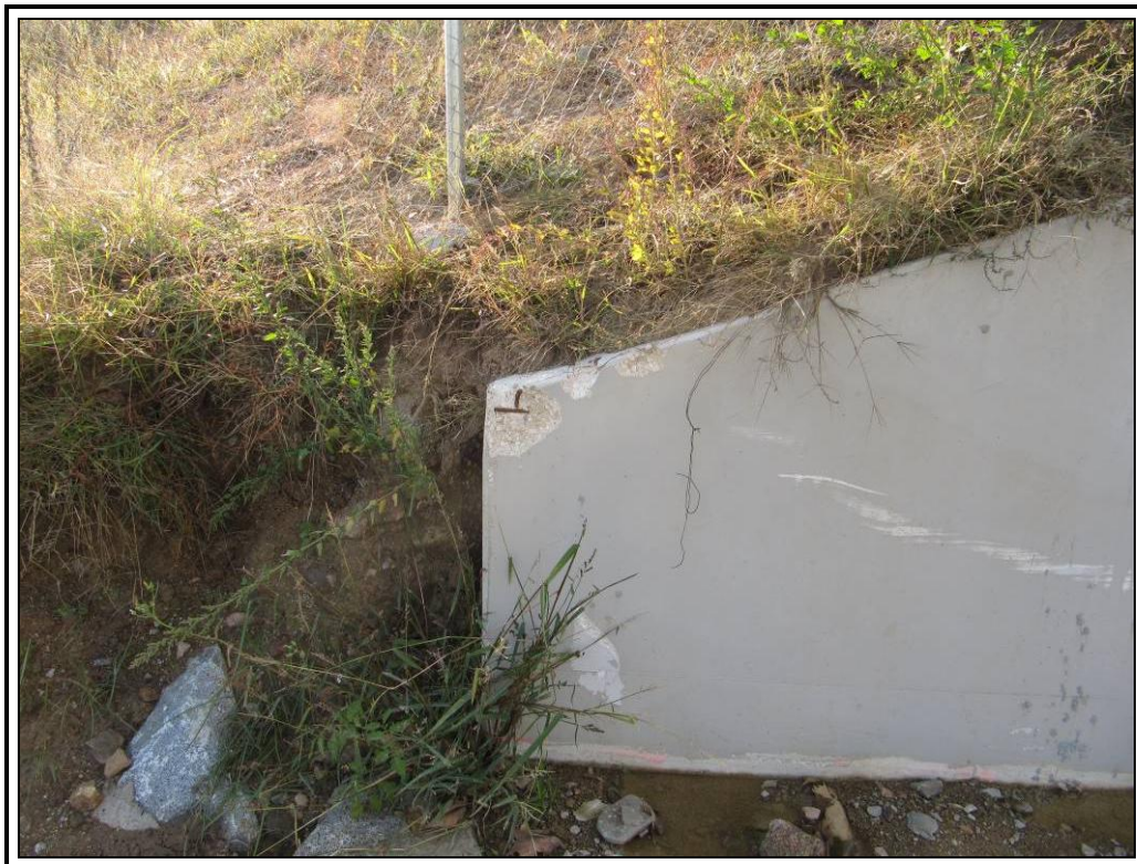
Desconchón con armadura implicada en extremos de aleta derecha de hastial uno
