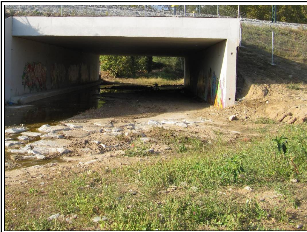
Erosión en trasdós del hastial dos en embocadura derecha
