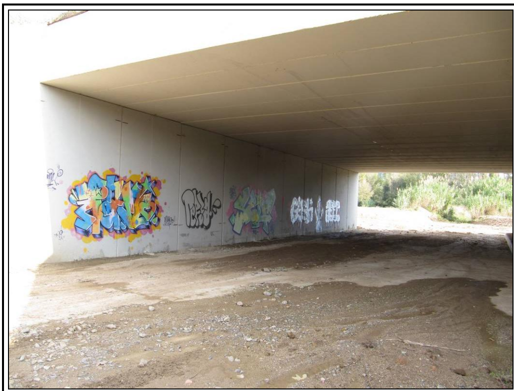
Acumulación de materiales sobre la solera y pintadas en paramentos de hastial dos
