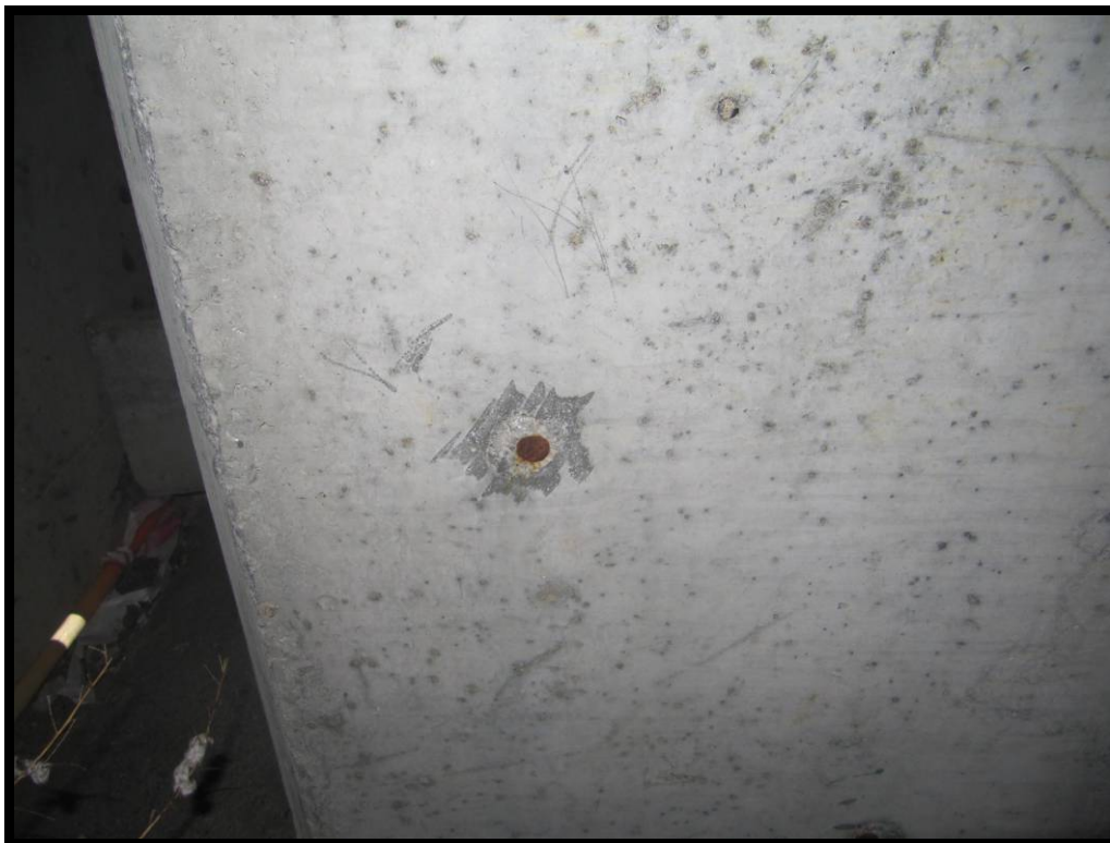
Armadura vista, plataforma, viga derecha vano 5.
