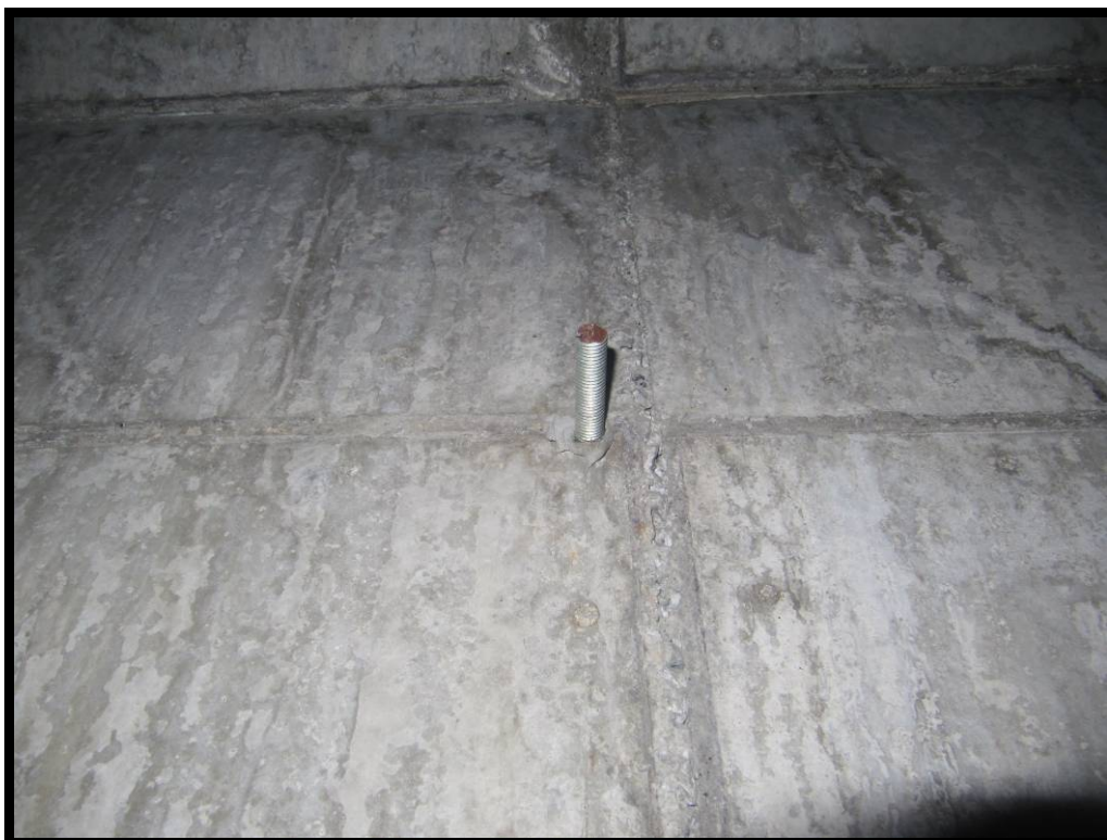
Barra en paramento, plataforma, vano 3 viga izquierda.
