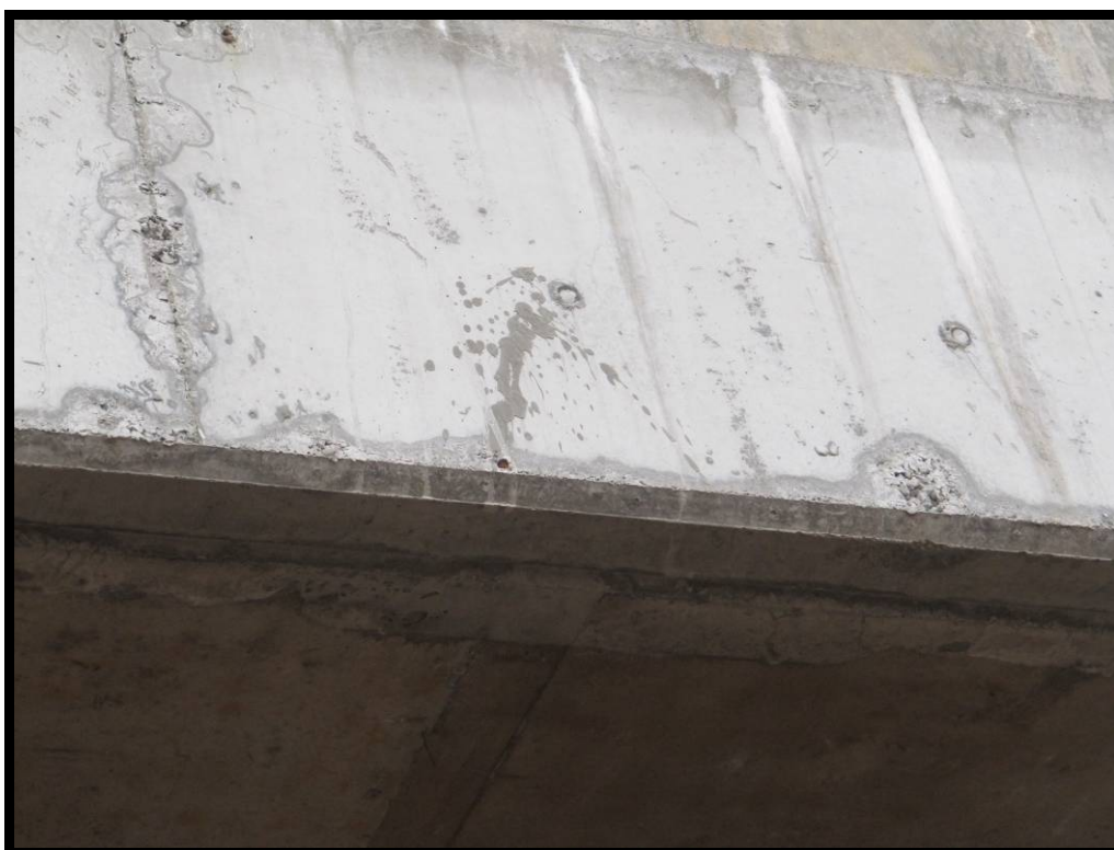
Nidos de grava/Coqueras, viga izquierda del vano 5.
