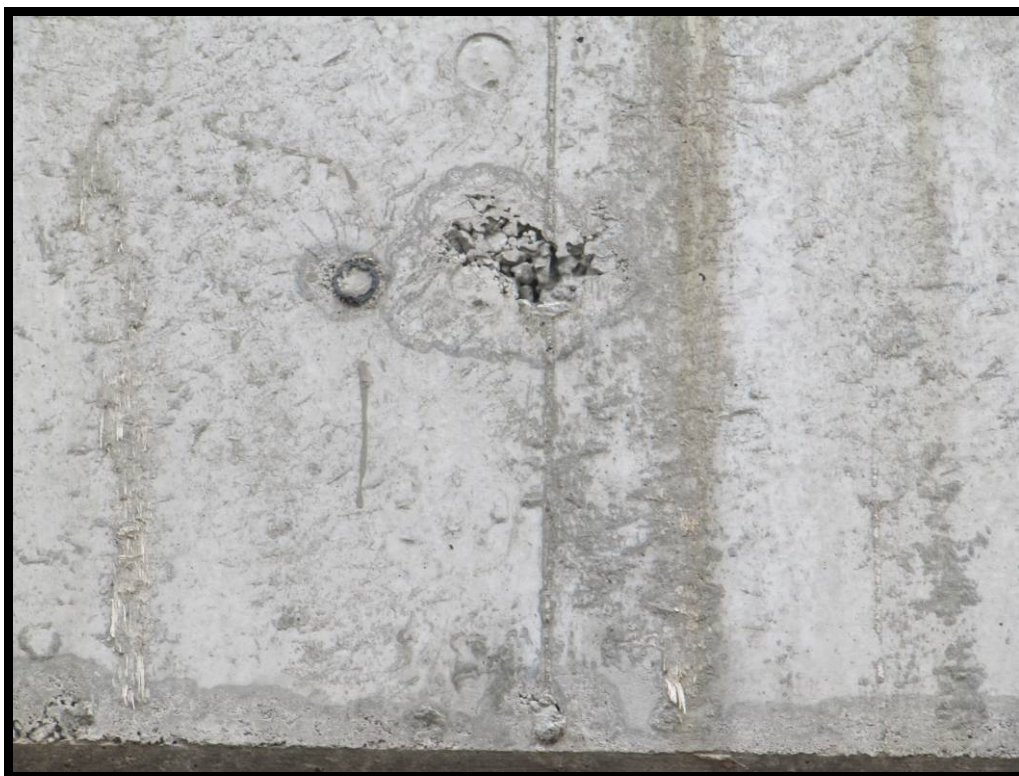
Nidos de grava/coqueras, viga izquierda del vano 1.
