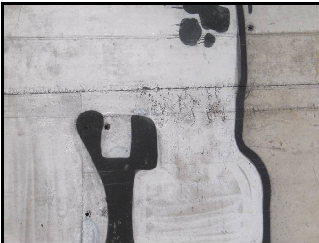
Nidos de grava/coqueras, muro lateral derecho estribo 1.
