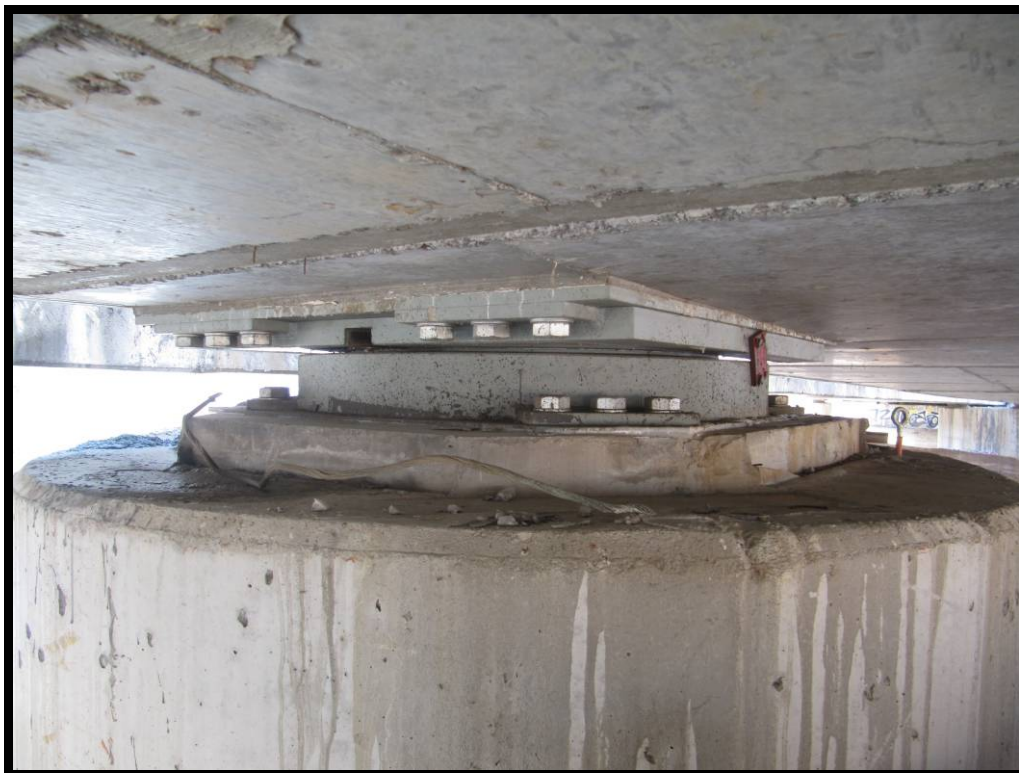
Desconchón en cama de nivelación, fuste derecho de la pila 1.
