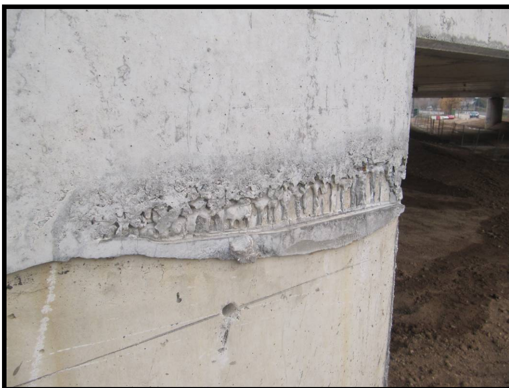
Nidos de grava y escurrimientos de hormigón, muro lateral izquierdo del estribo2.
