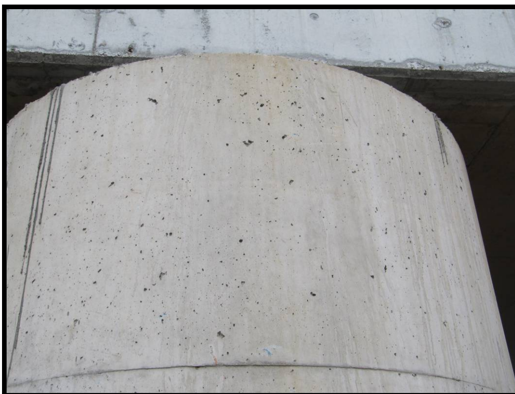
Coqueras, fuste izquierdo de la pila 4.
