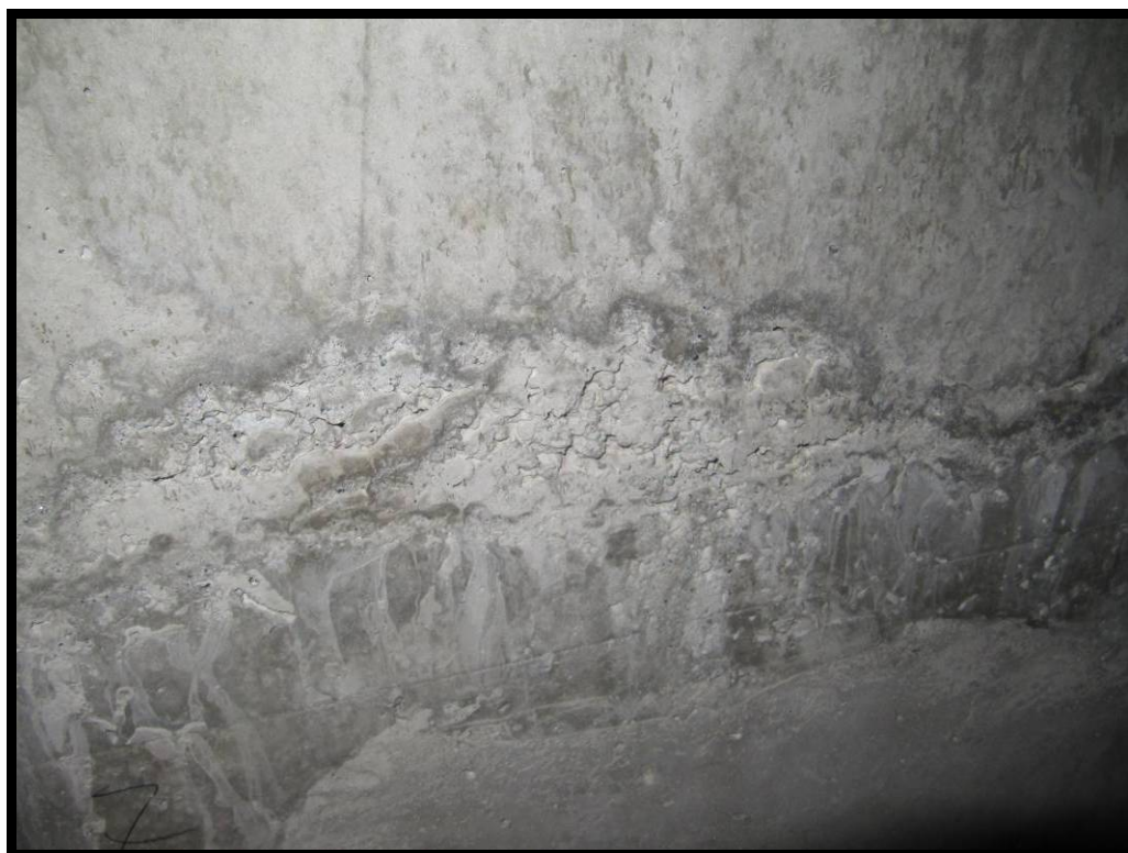
Nidos de grava/Coqueras, plataforma, viga derecha vano 4
