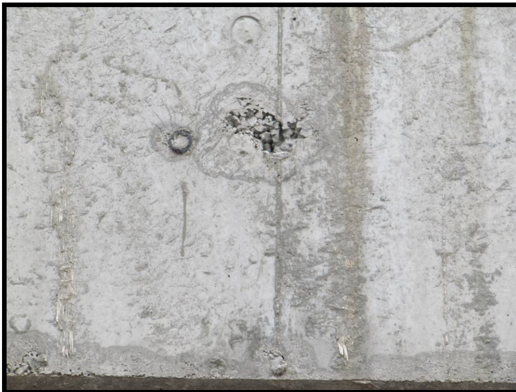
Nidos de grava/coqueras, viga izquierda del vano 1.
