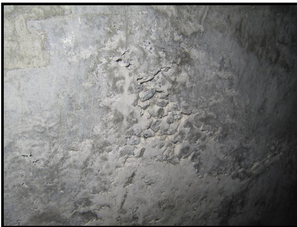
Nidos de grava/Coqueras, plataforma, viga derecha vano 1.
