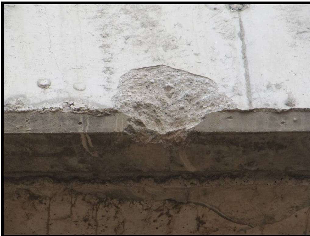
Desconchón, viga izquierda del vano 2.
