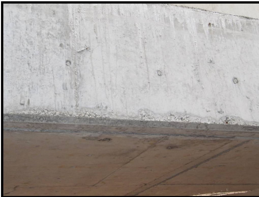
Nidos de grava/Coqueras, viga derecha del vano 5.
