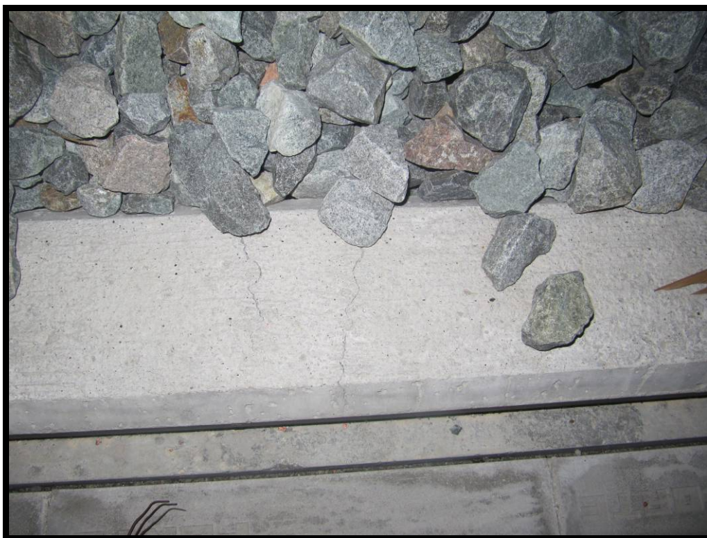
Fisuras, murete guarda balasto derecho del vano 5.
