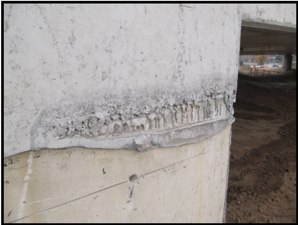
Nidos de grava y escurrimientos de hormigón, muro lateral izquierdo del estribo2.
