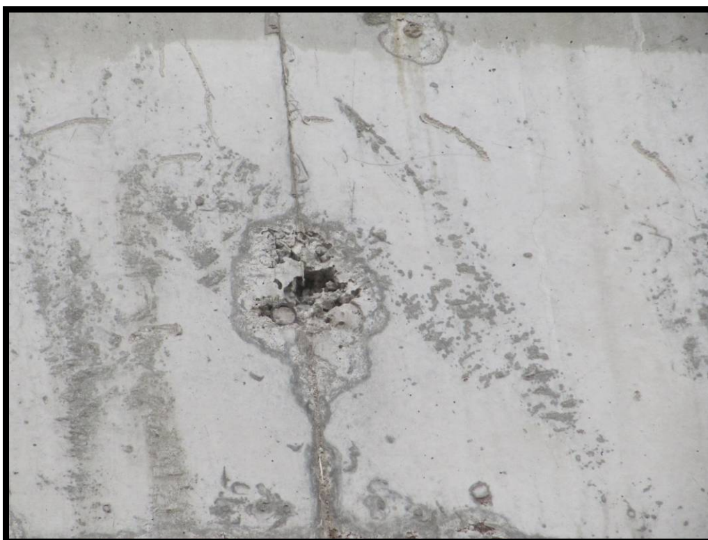
Nidos de grava/Coqueras, viga izquierda del vano 4.
