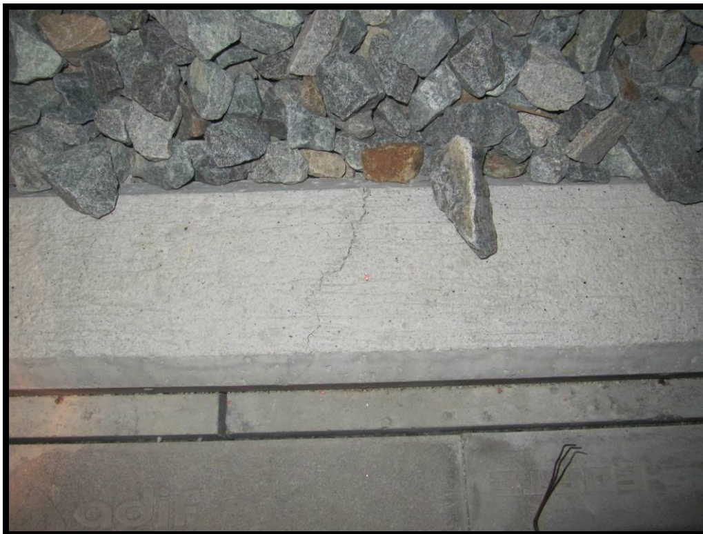
Fisuras, murete guarda balasto derecho del vano 5.
