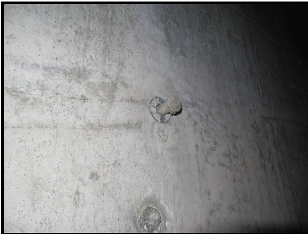
Perno de montaje sin quitar, plataforma, vano 3 viga izquierda.
