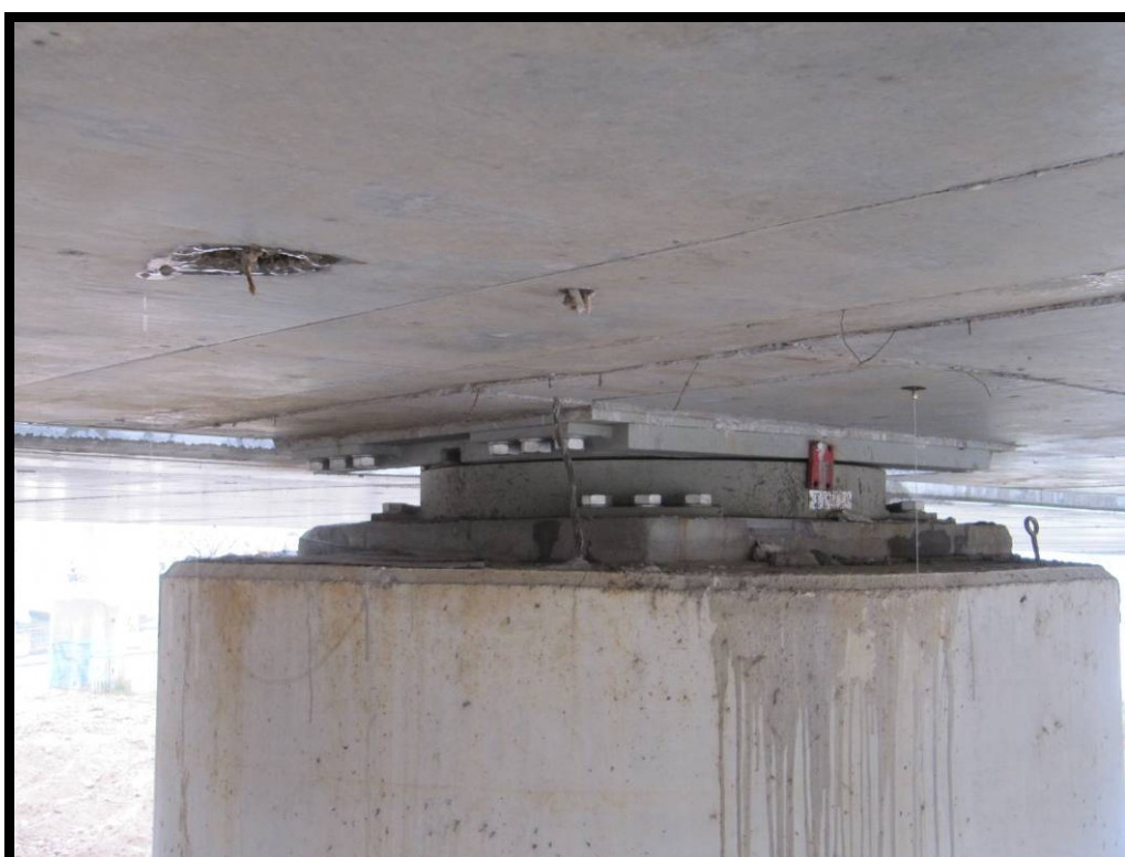
Desconchón en cama de nivelación, fuste derecho de la pila 3.
