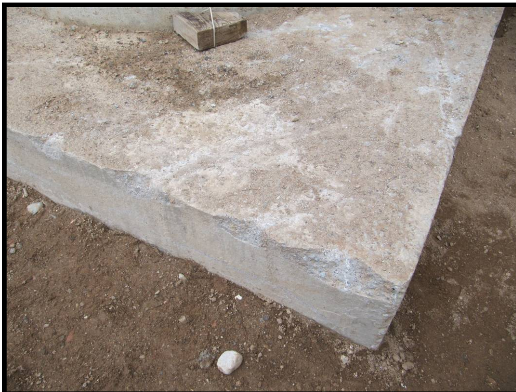
Desconchones, zapata del fuste izquierdo de la pila 2.
