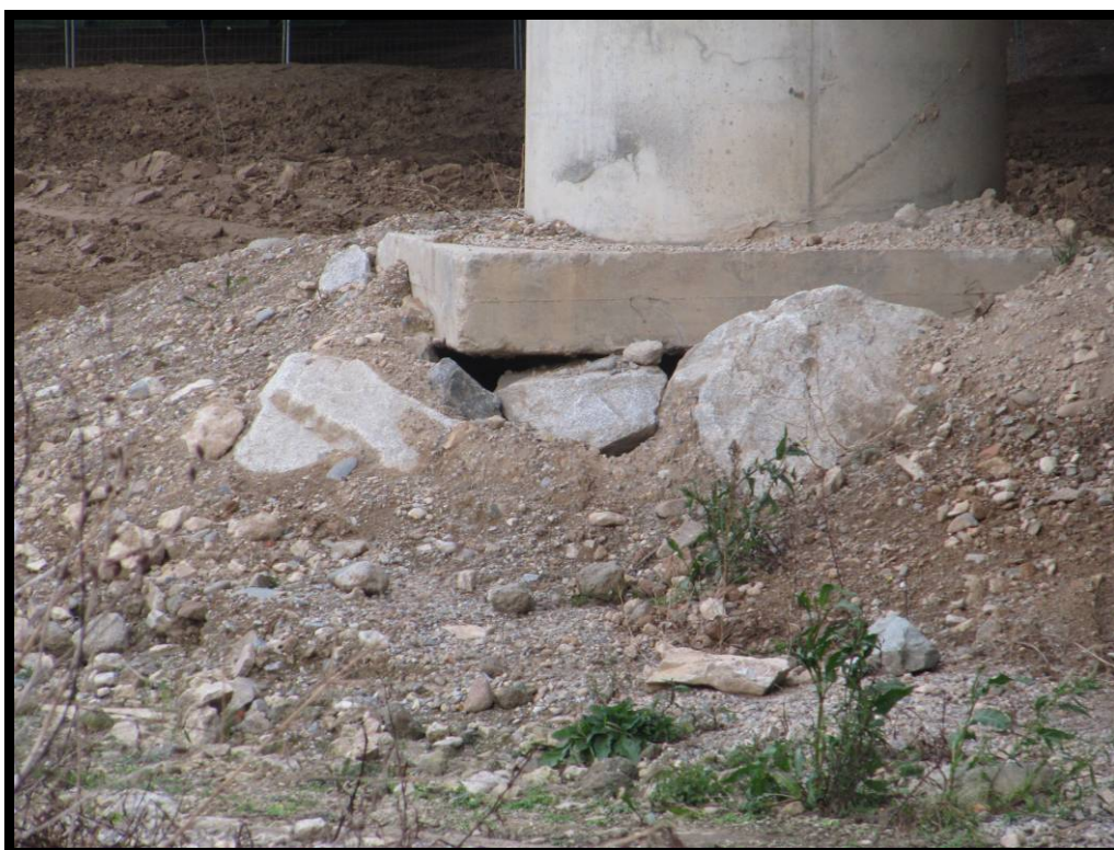
Pérdida de material de protección, fuste izquierdo pila 3.
