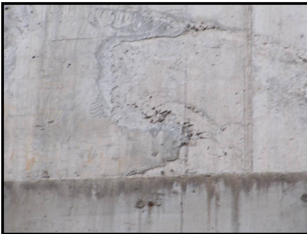
Nidos de grava/Coqueras, viga derecha del vano 3.
