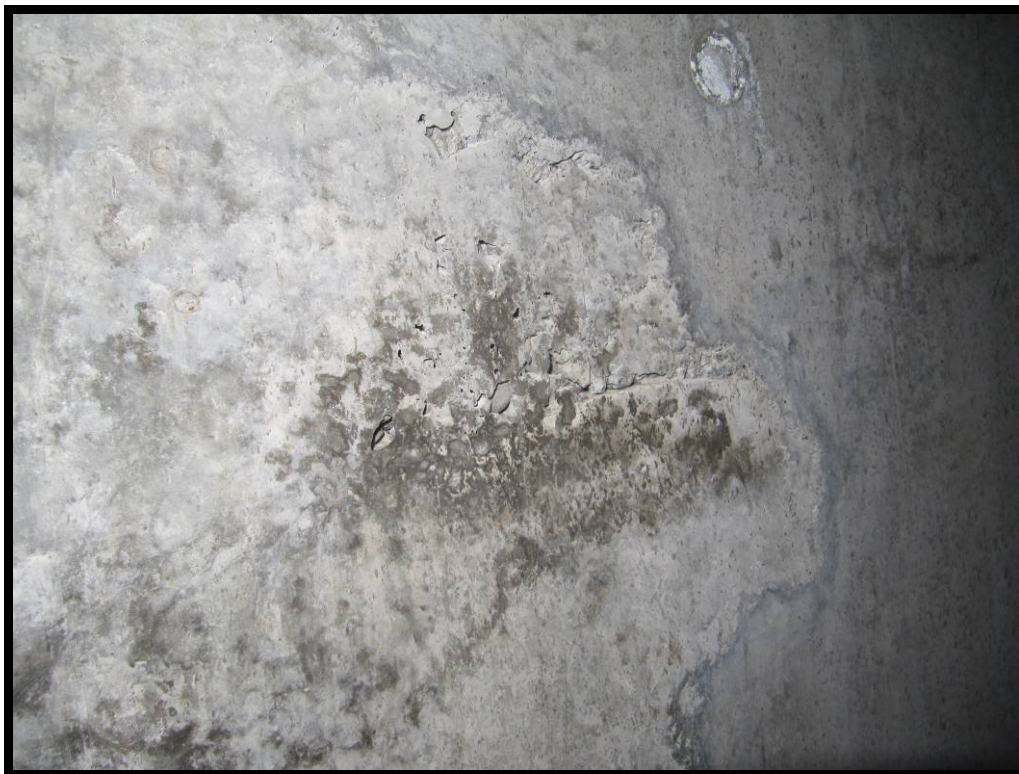
Nidos de grava/Coqueras, plataforma, viga derecha vano 2.
