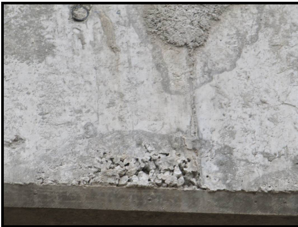
Nidos de grava/coqueras, viga izquierda del vano 1.
