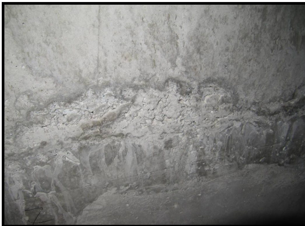
Nidos de grava/Coqueras, plataforma, viga derecha vano 4.
