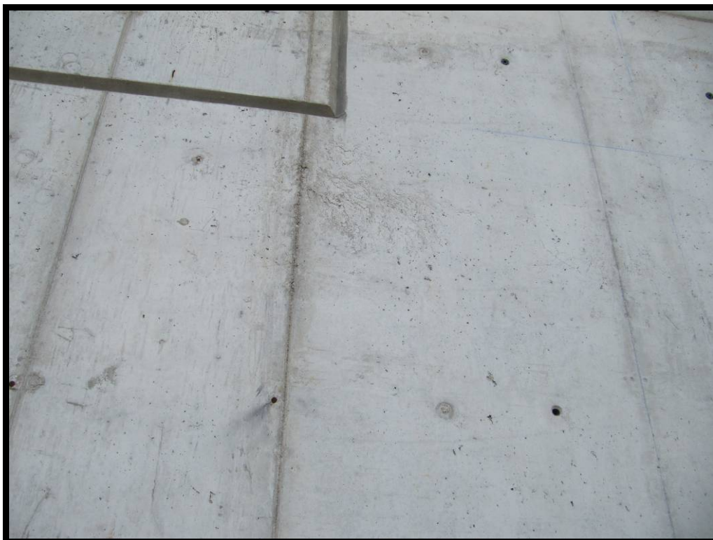
Nidos de grava/Coqueras, viga izquierda del vano 4.
