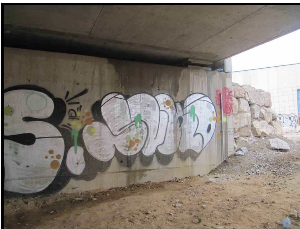
Humedades, muro frontal del estribo 1.
