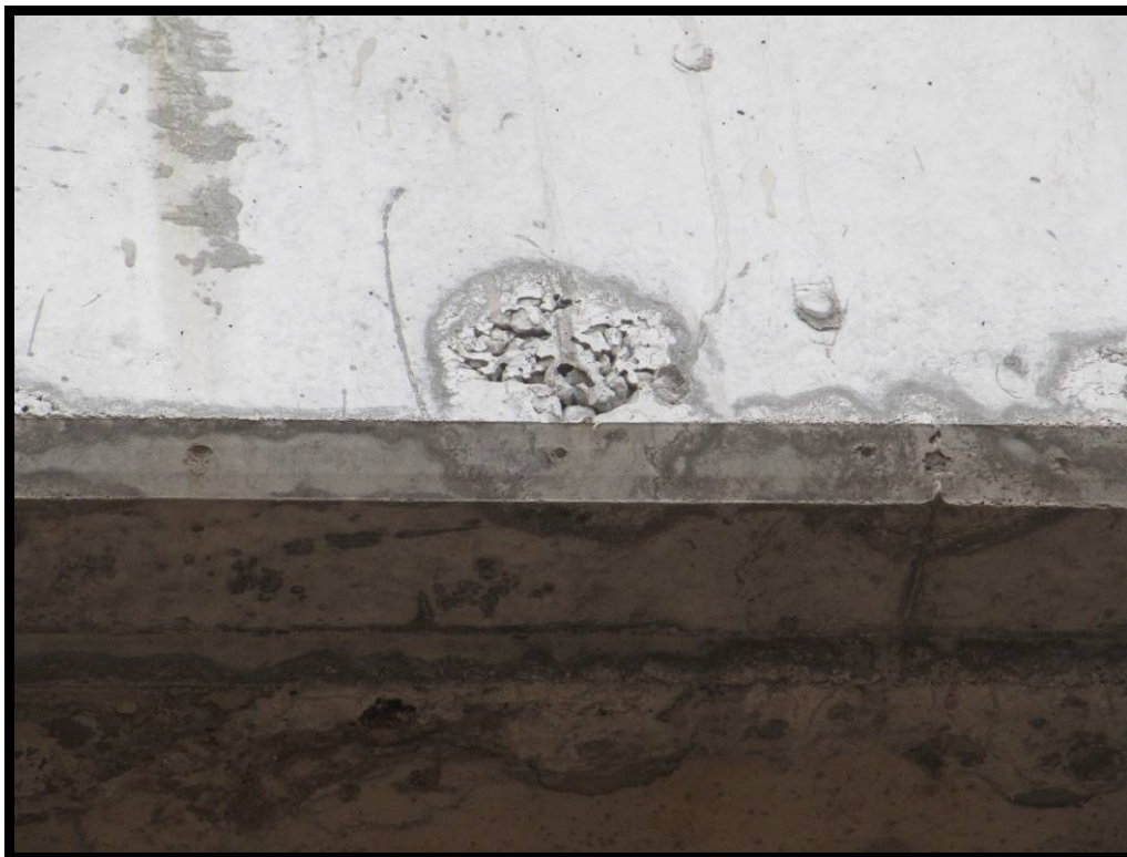
Nidos de grava/Coqueras, viga izquierda del vano 5.
