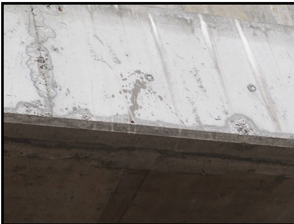
Nidos de grava/Coqueras, viga izquierda del vano 5.
