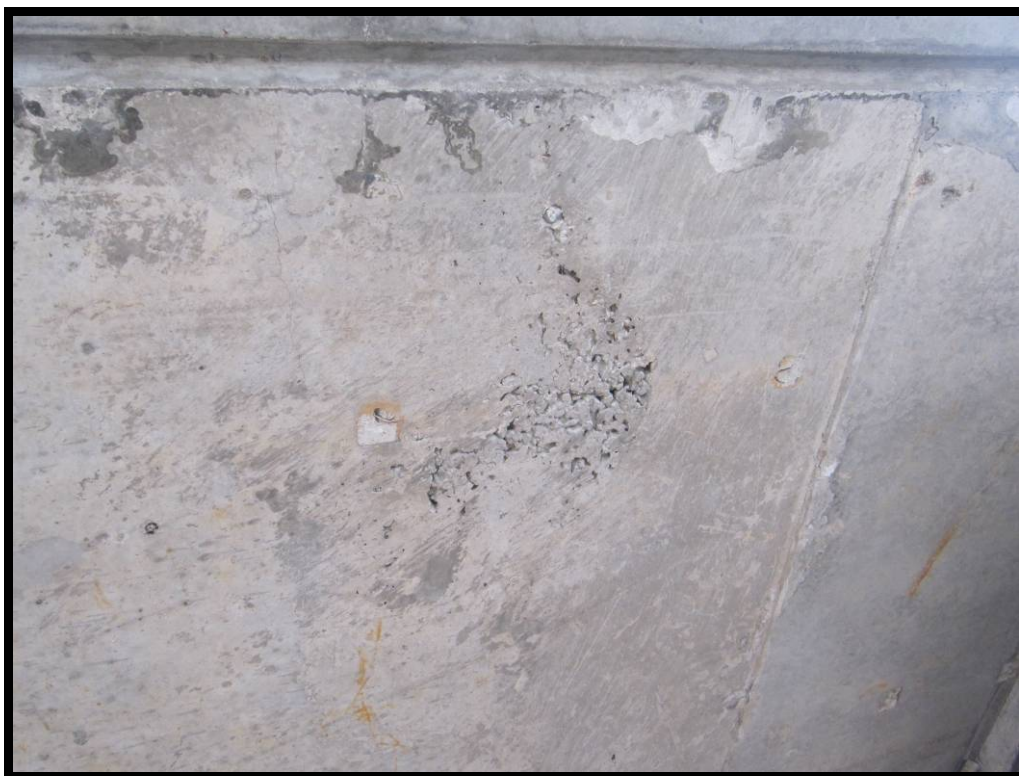
Nidos de grava/coqueras, vano 2.
