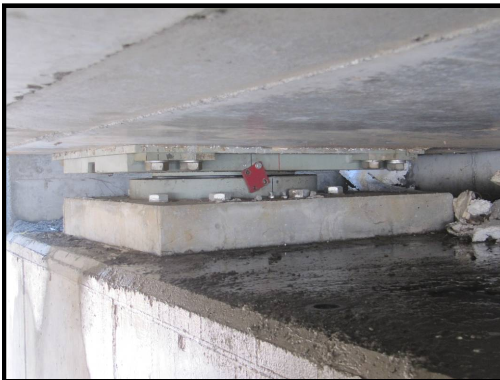
Placas de montaje de los apoyos sin quitar.
