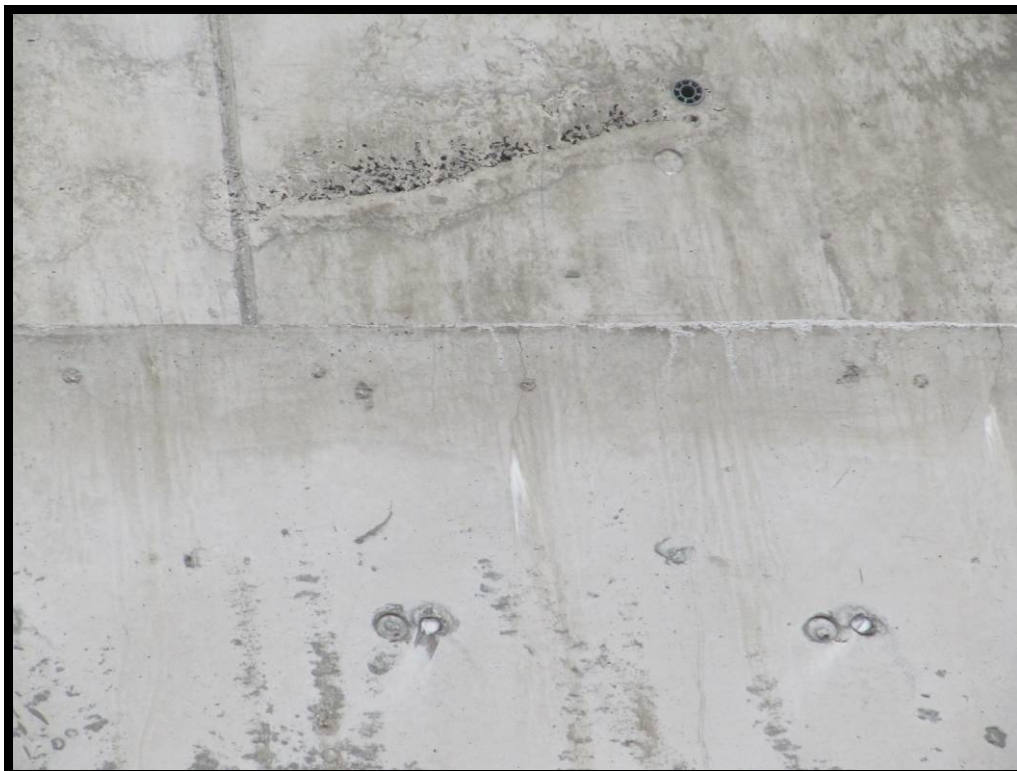
Nidos de grava/Coqueras, viga izquierda del vano 3.
