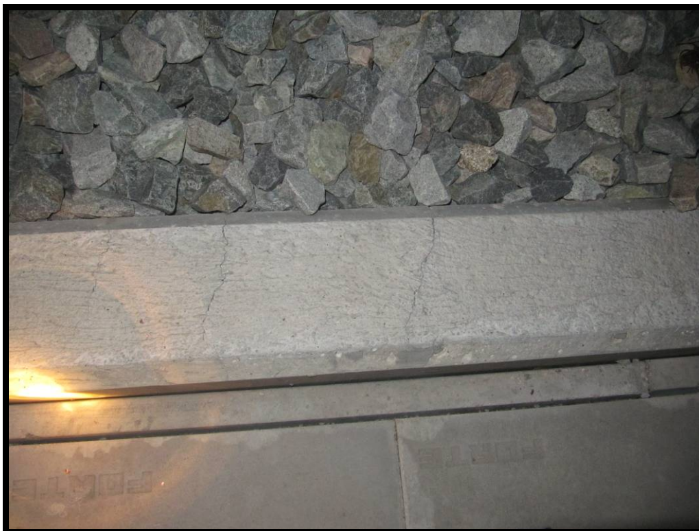
Fisuras, murete guarda balasto izquierdo del vano 4.
