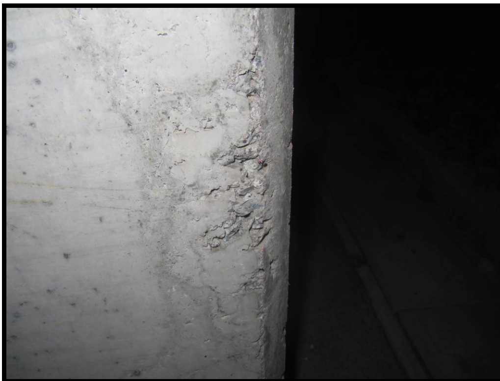
Nidos de grava/Coqueras, plataforma, viga derecha vano 5.
