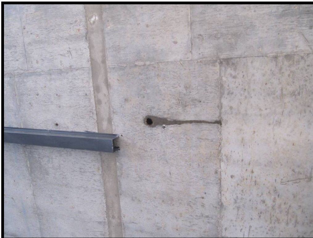
Falta de gárgolas en sumideros.
