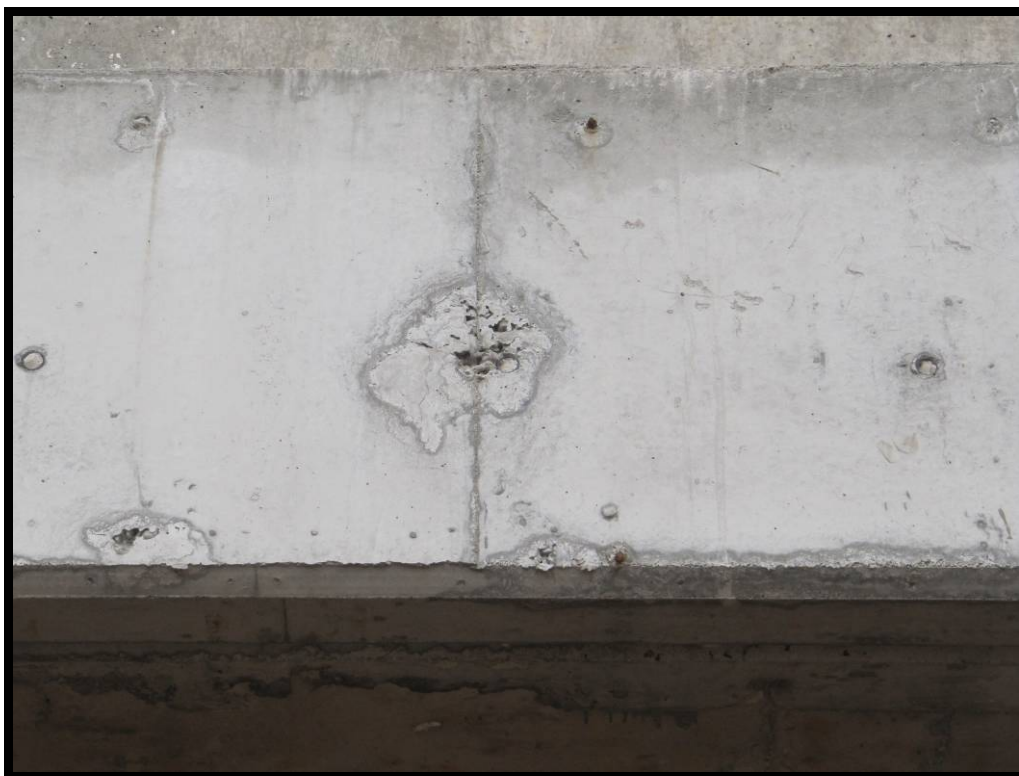
Nidos de grava/Coqueras, viga izquierda del vano 4.
