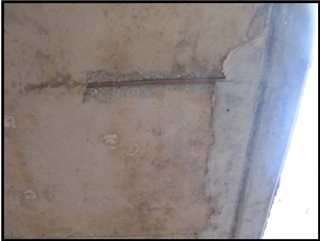
Desconchón con armadura vista, vano 5.
