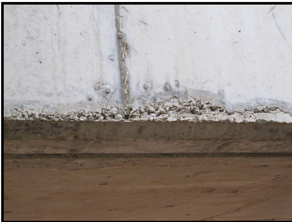
Nidos de grava/Coqueras, viga derecha del vano 5.
