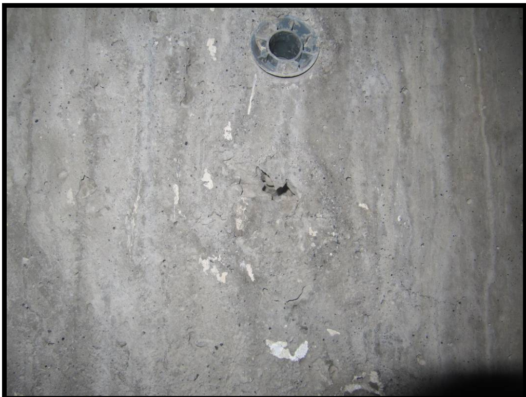
Coqueras, plataforma, viga derecha vano 4.
