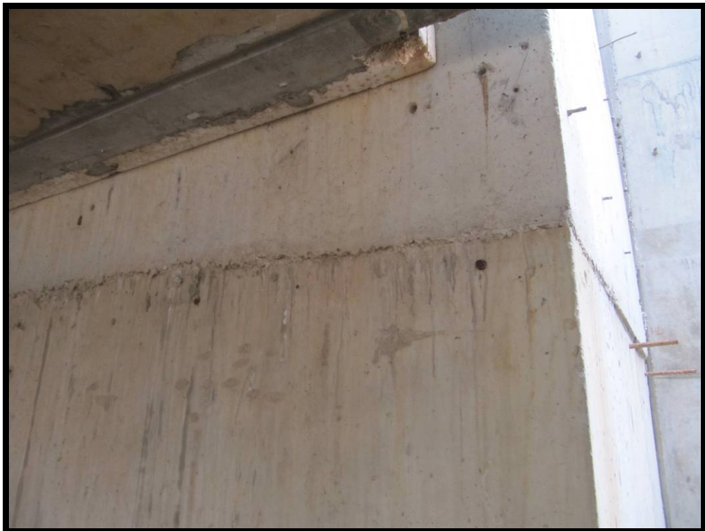
Barras corrugadas a la vista, estribo 2.
