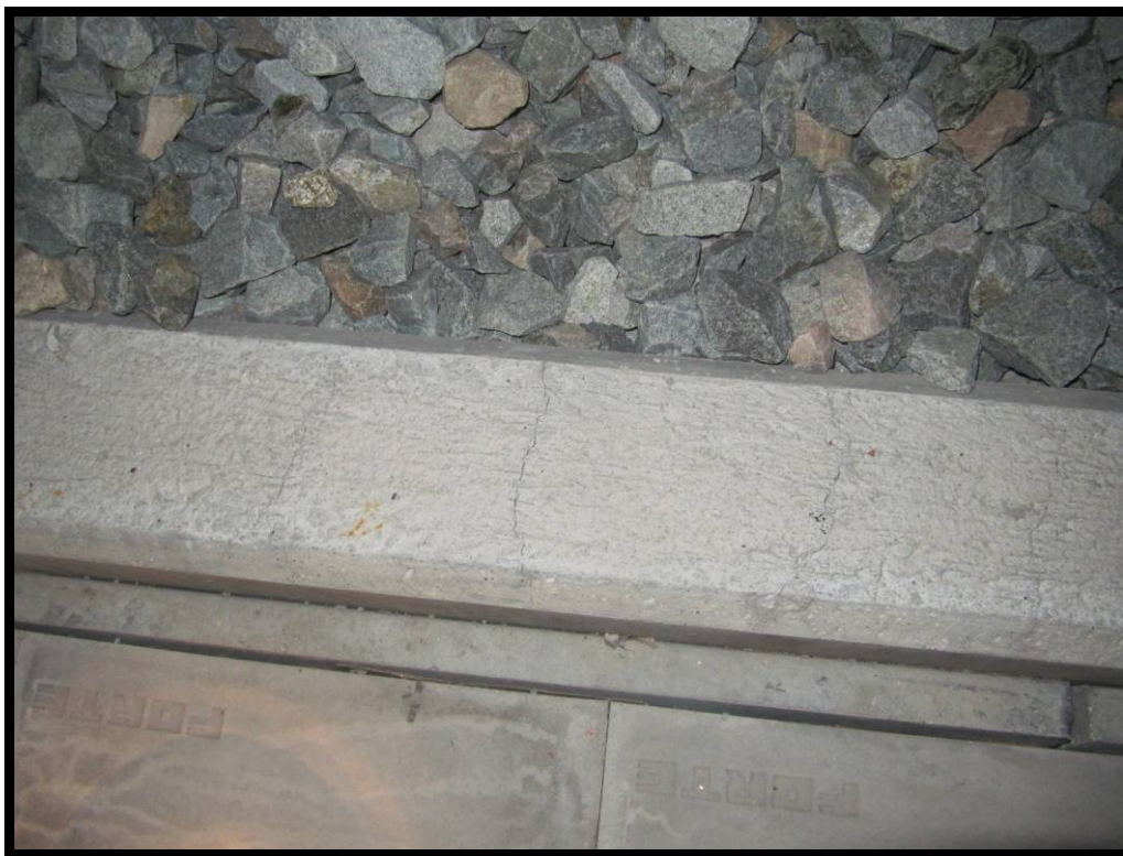
Fisuras, murete guarda balasto izquierdo del vano 4.
