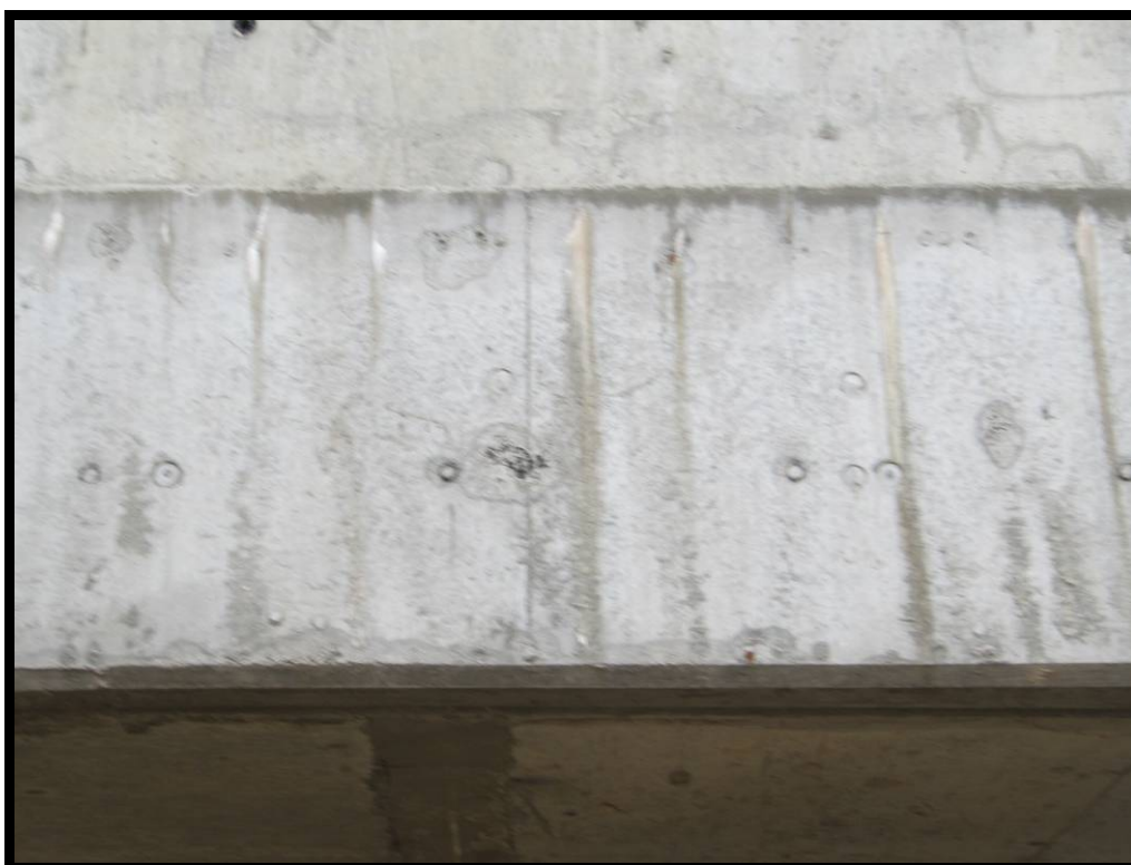
Nidos de grava/coqueras, viga izquierda del vano 1.
