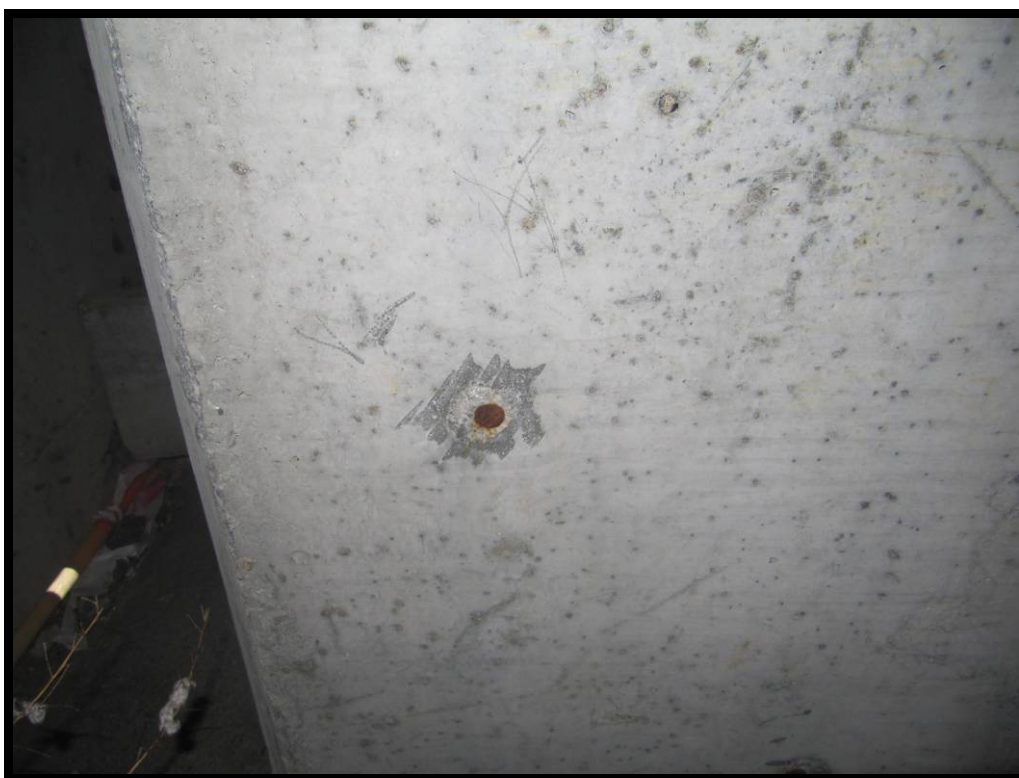
Armadura vista, plataforma, viga derecha vano 4.
