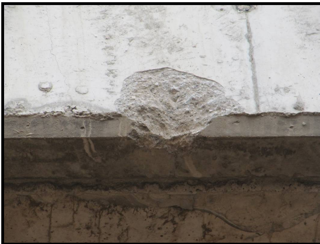
Desconchón, viga izquierda del vano 2.
