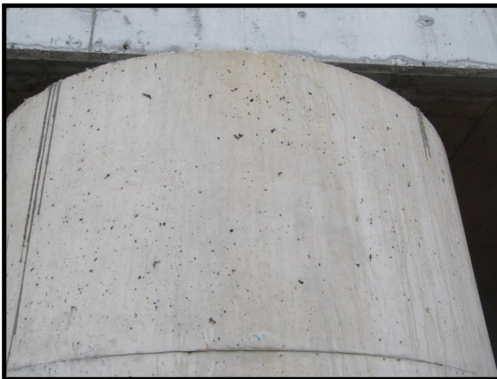
Coqueras, fuste izquierdo de la pila 4.
