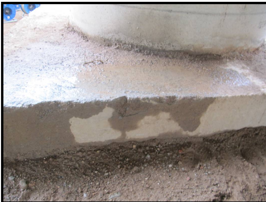
Desconchón, zapata del fuste izquierdo de la pila 2.
