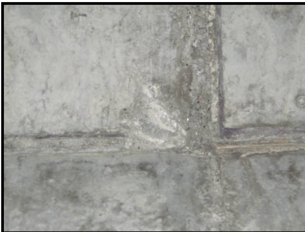
Desconchón, plataforma, viga izquierda vano 3
