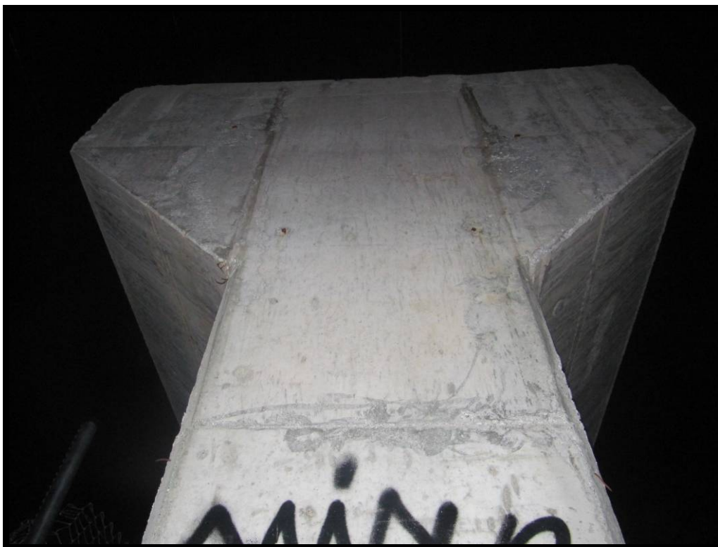
Armadura vista, plataforma, viga derecha vano 5.
