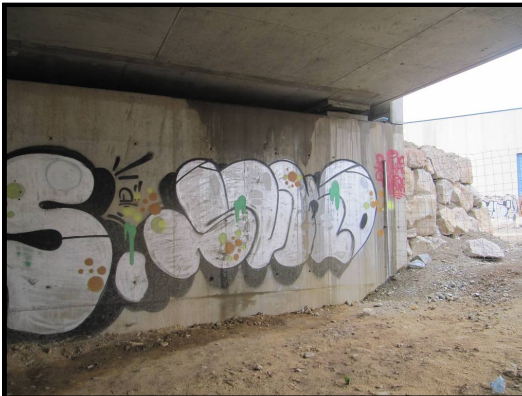
Humedades, muro frontal del estribo 1.
