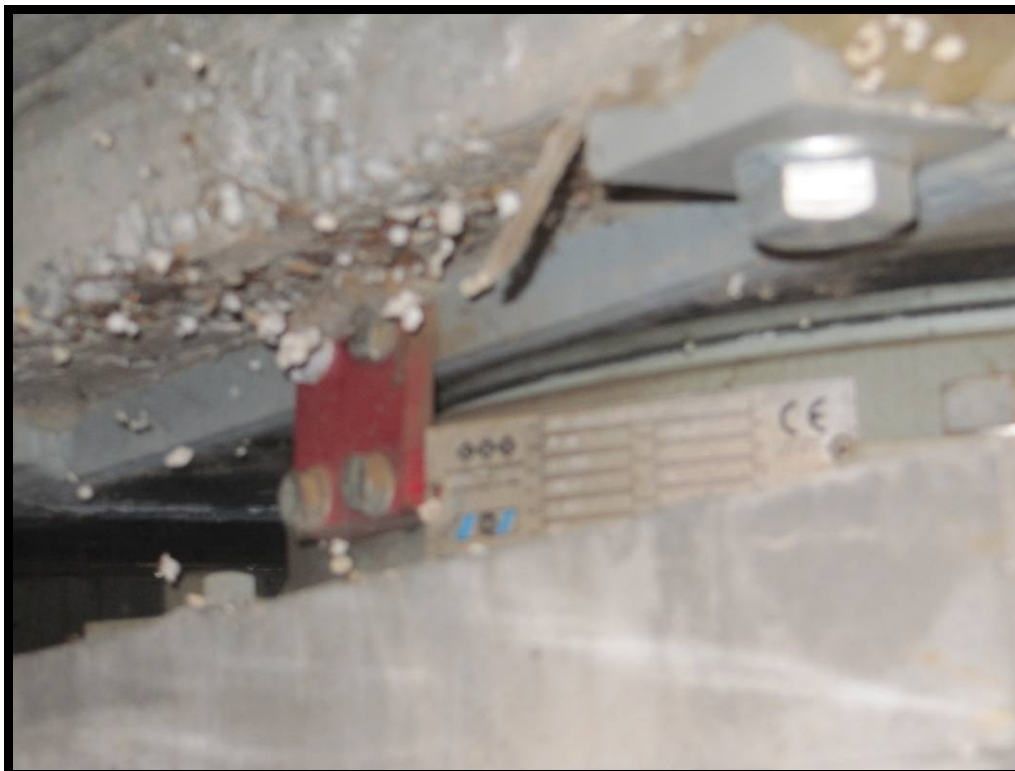
Placas de montaje de los apoyos sin quitar.
