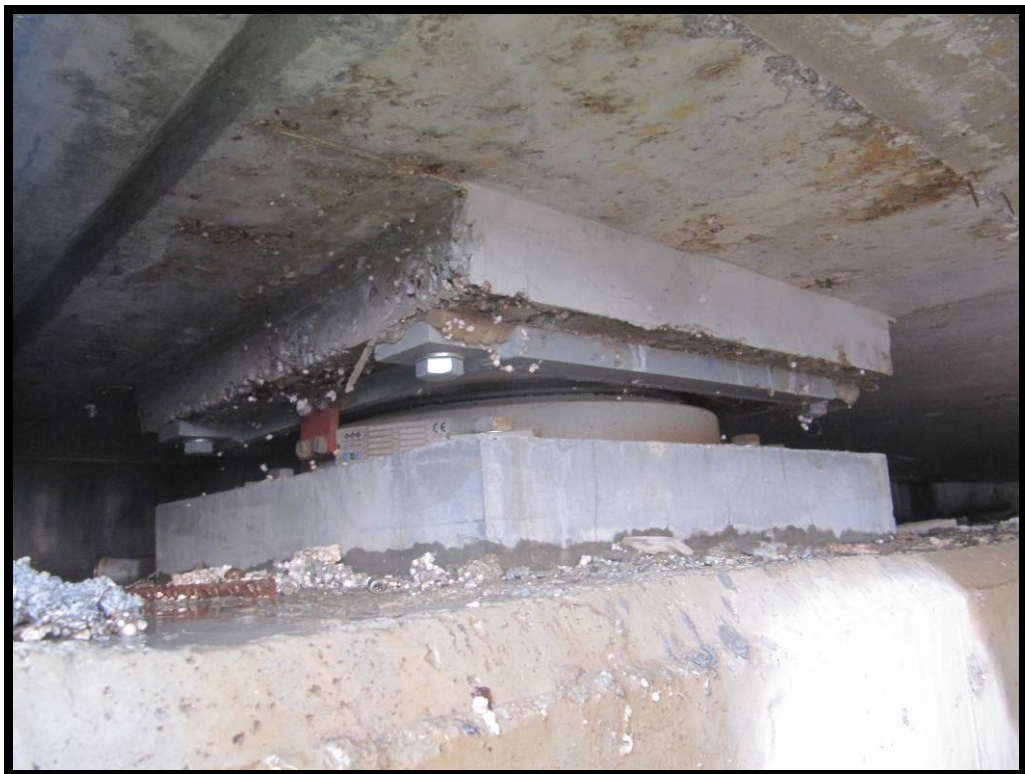
Nidos de grava/Coqueras, cama de nivelación superior derecha del estribo 2.
