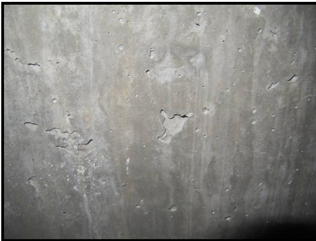
Coqueras, plataforma, viga derecha vano 4.
