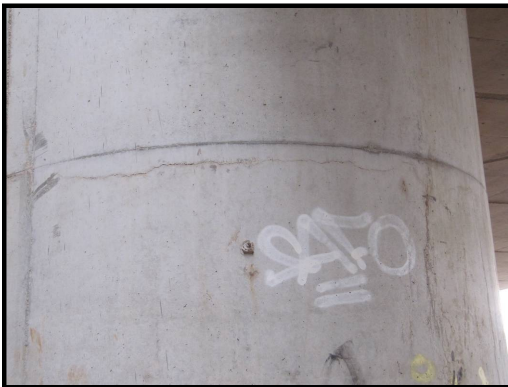
Fisura, fuste derecho pila 4.
