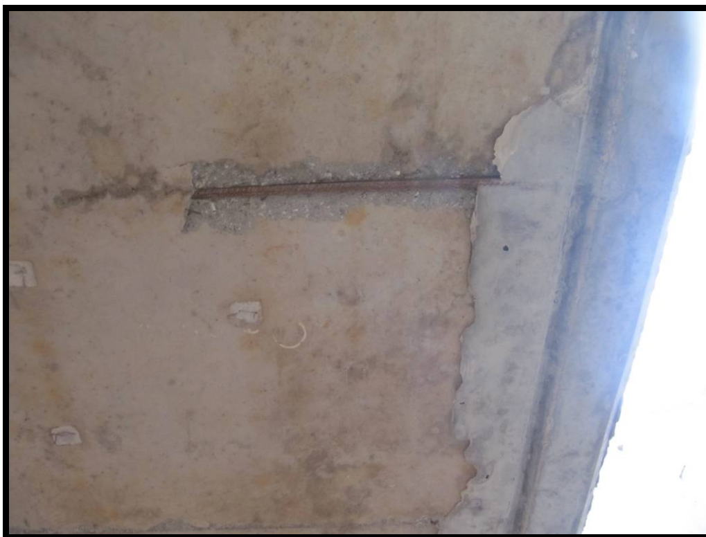
Desconchón con armadura vista, vano 5.
