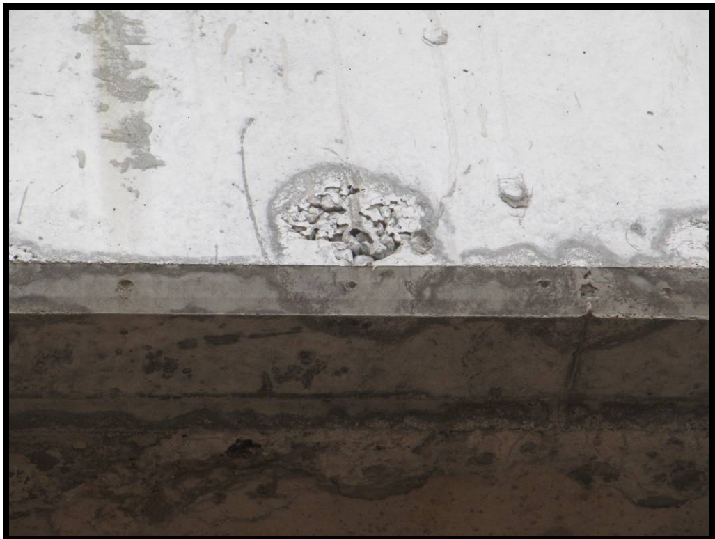
Nidos de grava/Coqueras, viga izquierda del vano 5.
