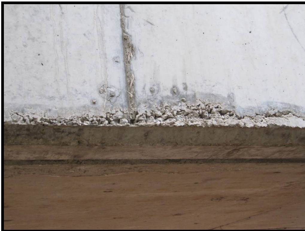
Nidos de grava/Coqueras, viga derecha del vano 5.
