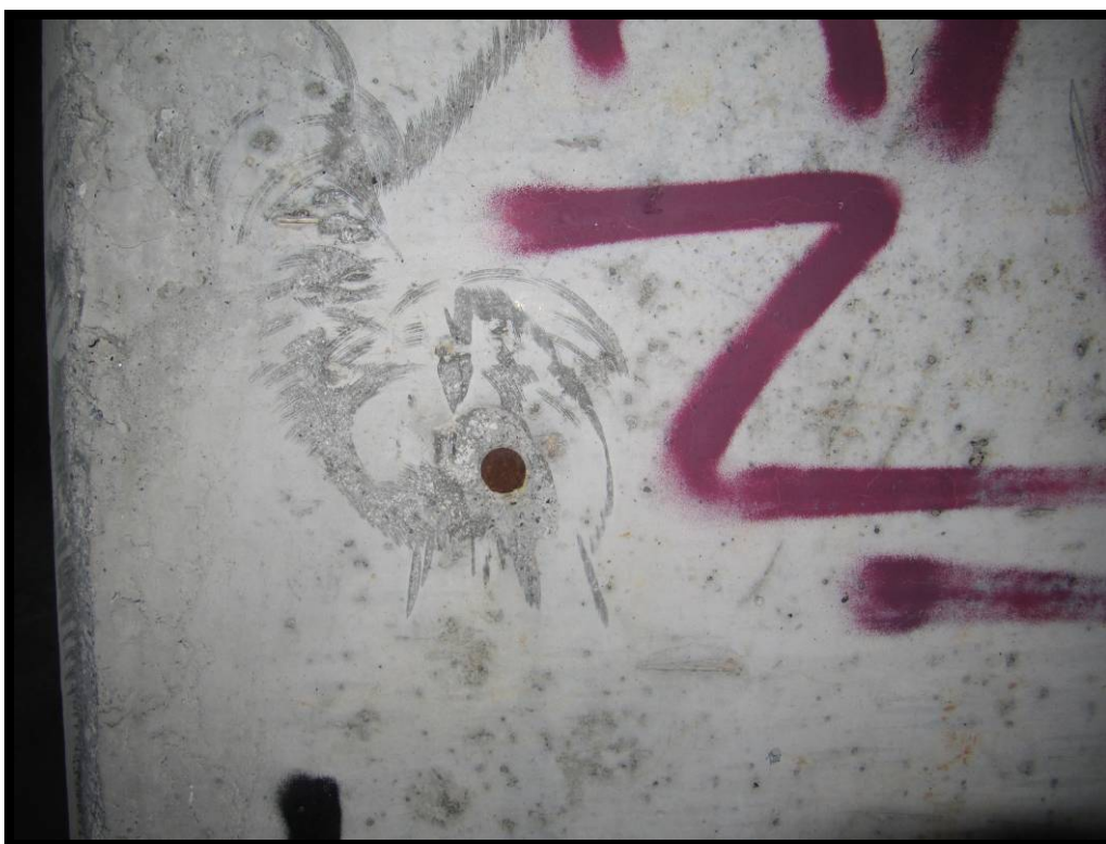
Armadura vista, plataforma, viga derecha vano 5.
