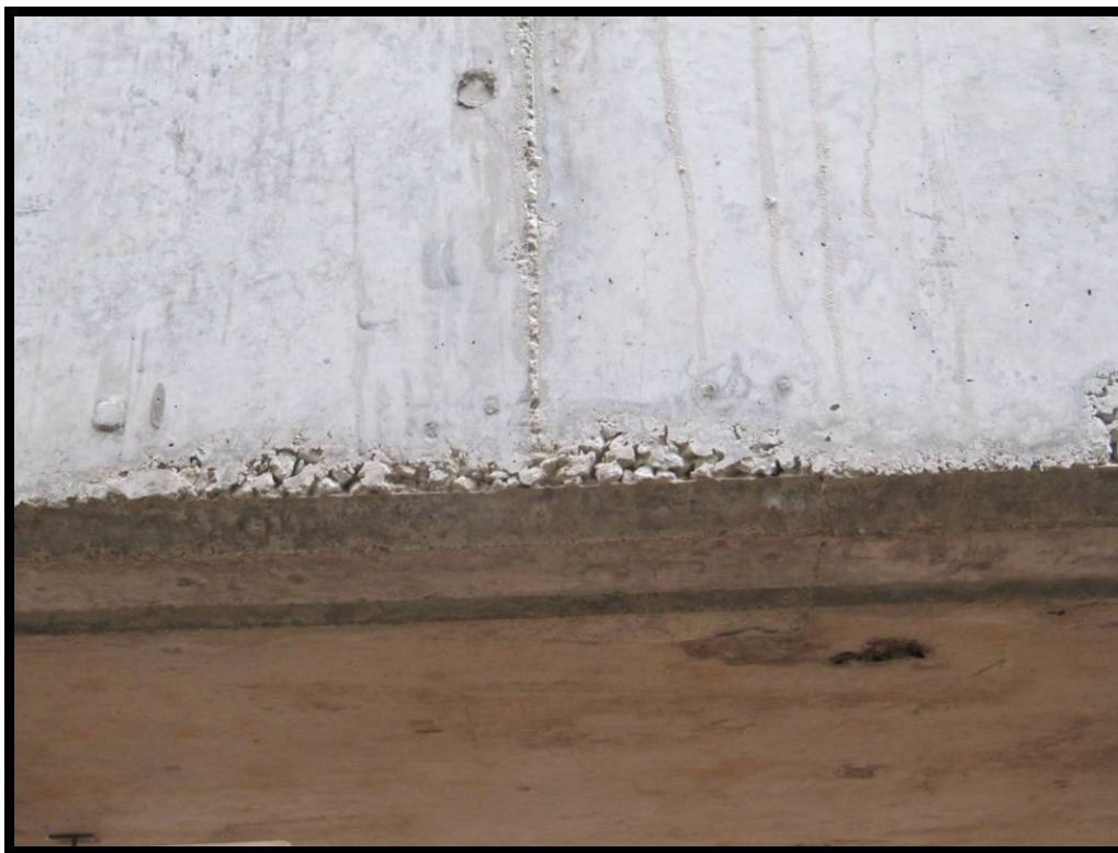
Nidos de grava/Coqueras, viga derecha del vano 5.
