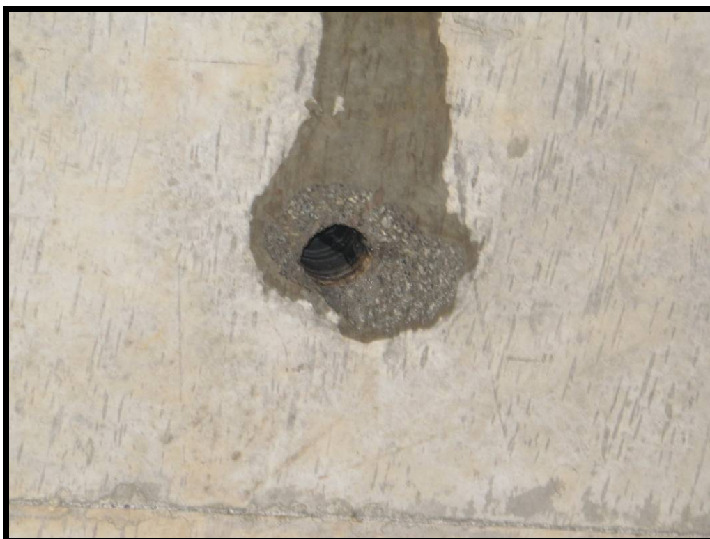
Desconchón en sumidero, lado izquierdo del vano 2.
