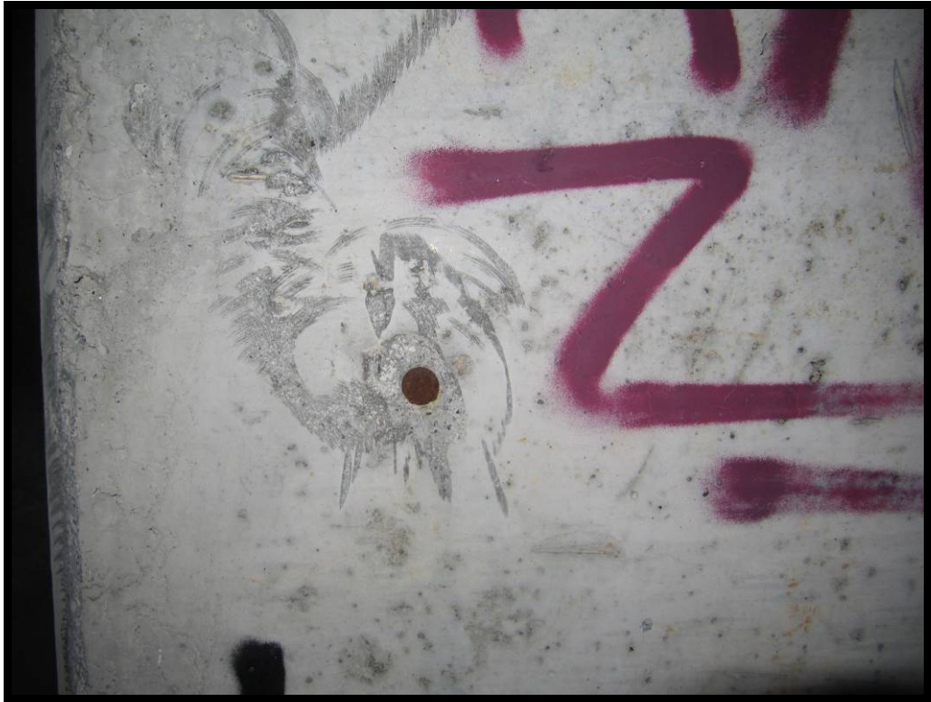
Armadura vista, plataforma, viga derecha vano 5.
