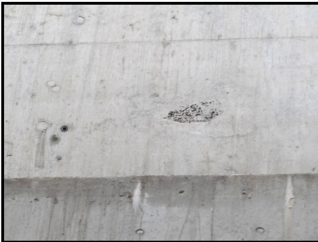
Nidos de grava/coqueras, viga derecha del vano 1.
