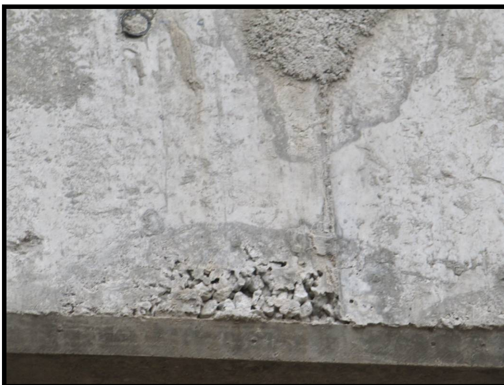
Nidos de grava/coqueras, viga izquierda del vano 1.
