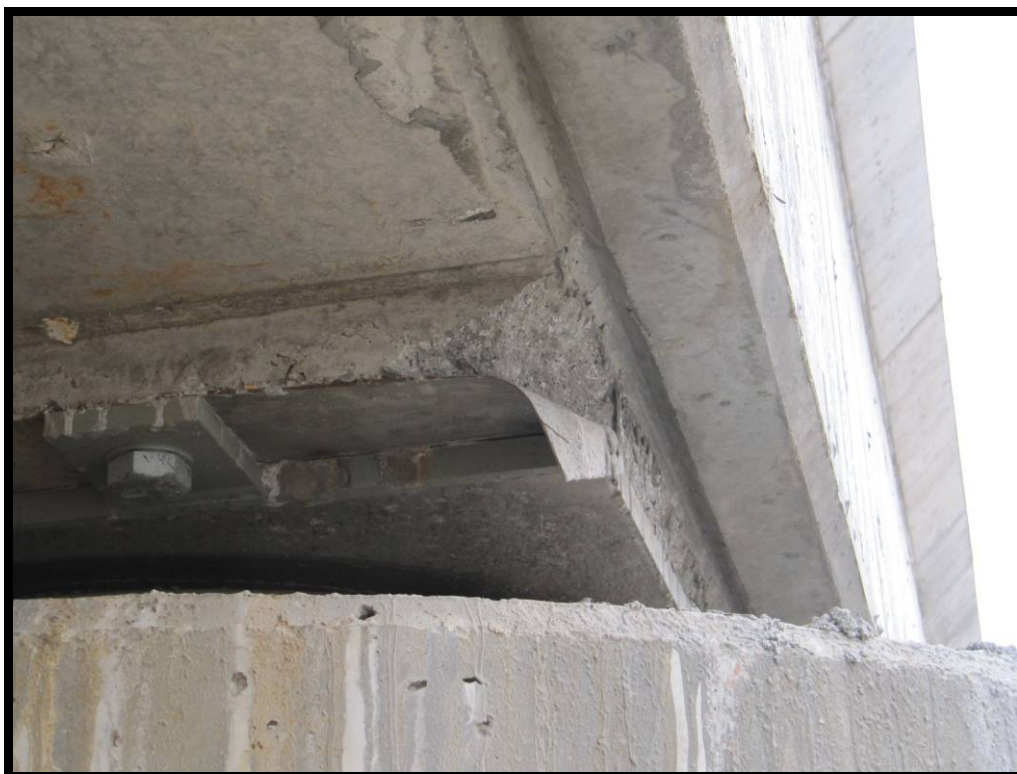
Desconchón, cama de nivelación superior del apoyo izquierdo de la pila 1.
