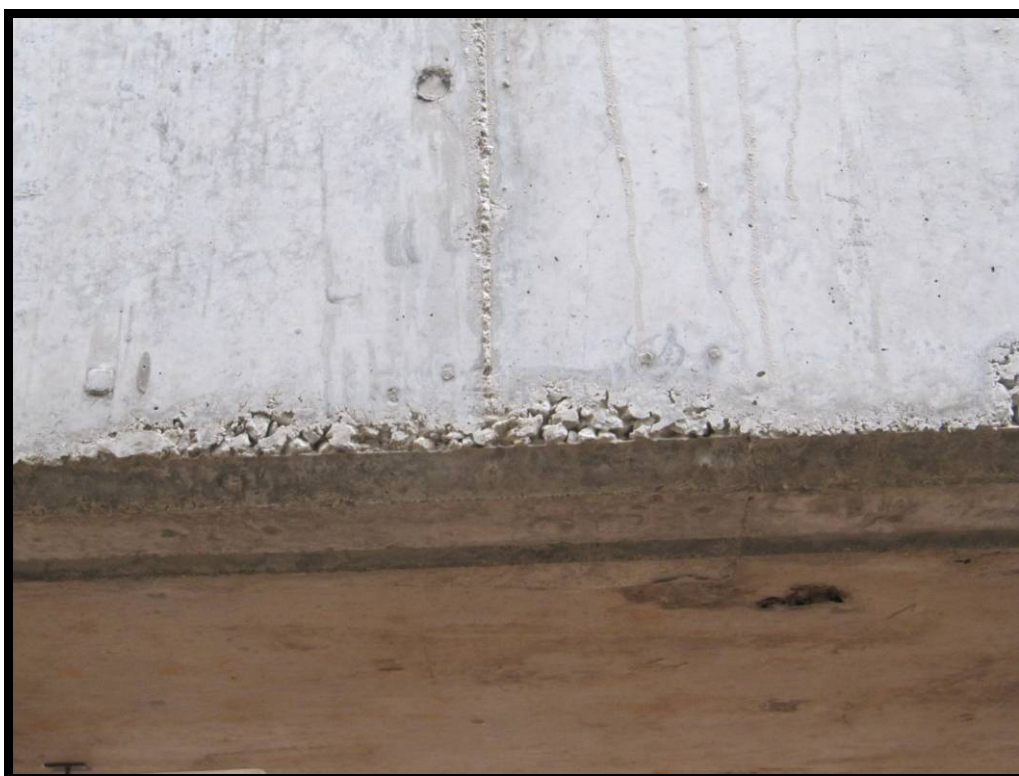
Nidos de grava/Coqueras, viga derecha del vano 5.
