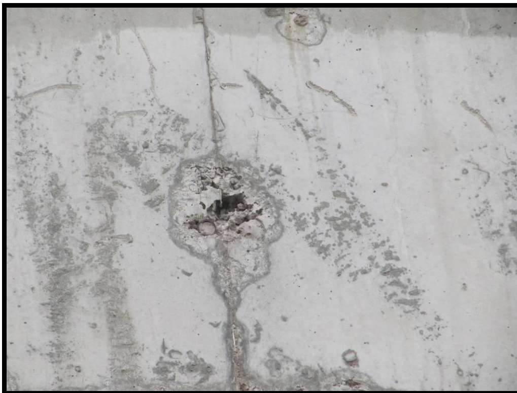
Nidos de grava/Coqueras, viga izquierda del vano 4.
