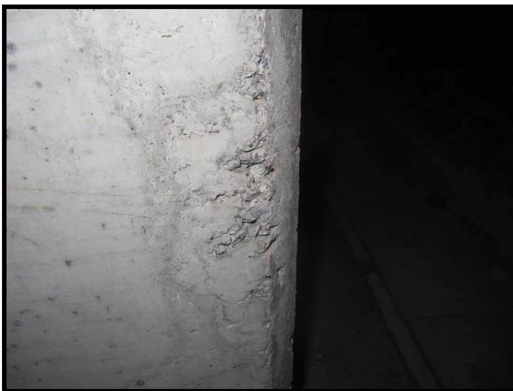
Nidos de grava/Coqueras, plataforma, viga derecha vano 5.
