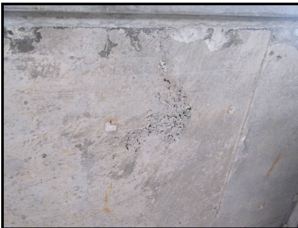
Nidos de grava/coqueras, vano 2.
