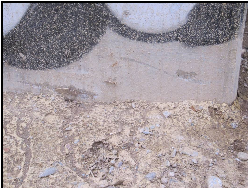
Desconchón, muro lateral derecho del estribo 1.
