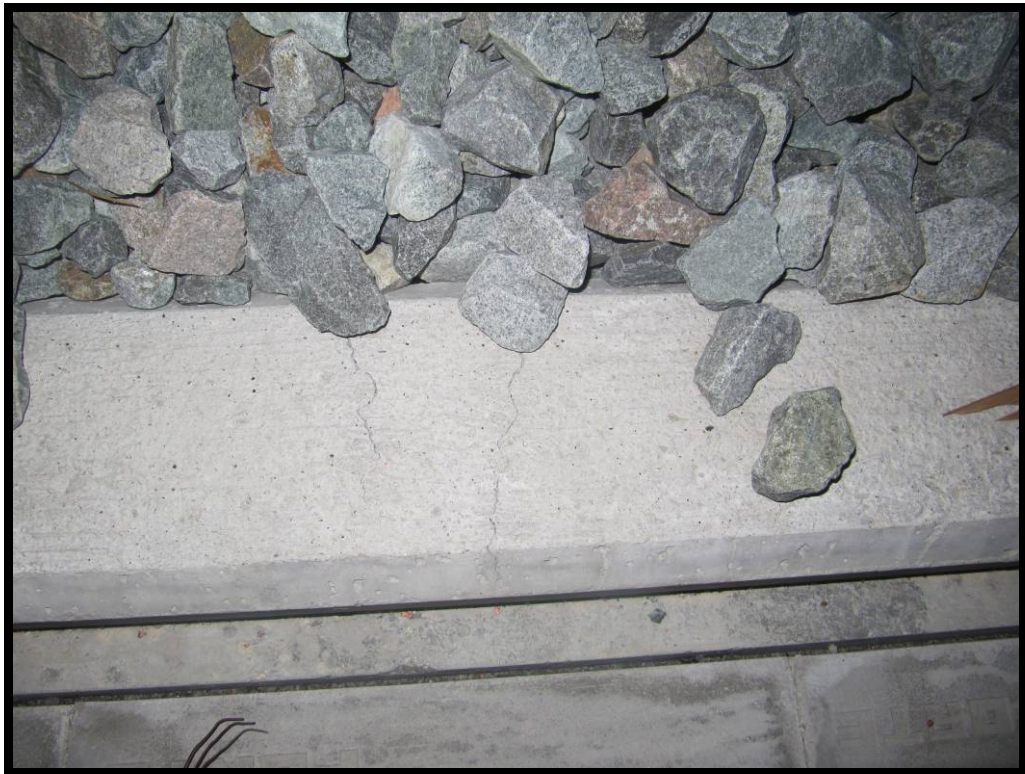
Fisuras, murete guarda balasto derecho del vano 5.
