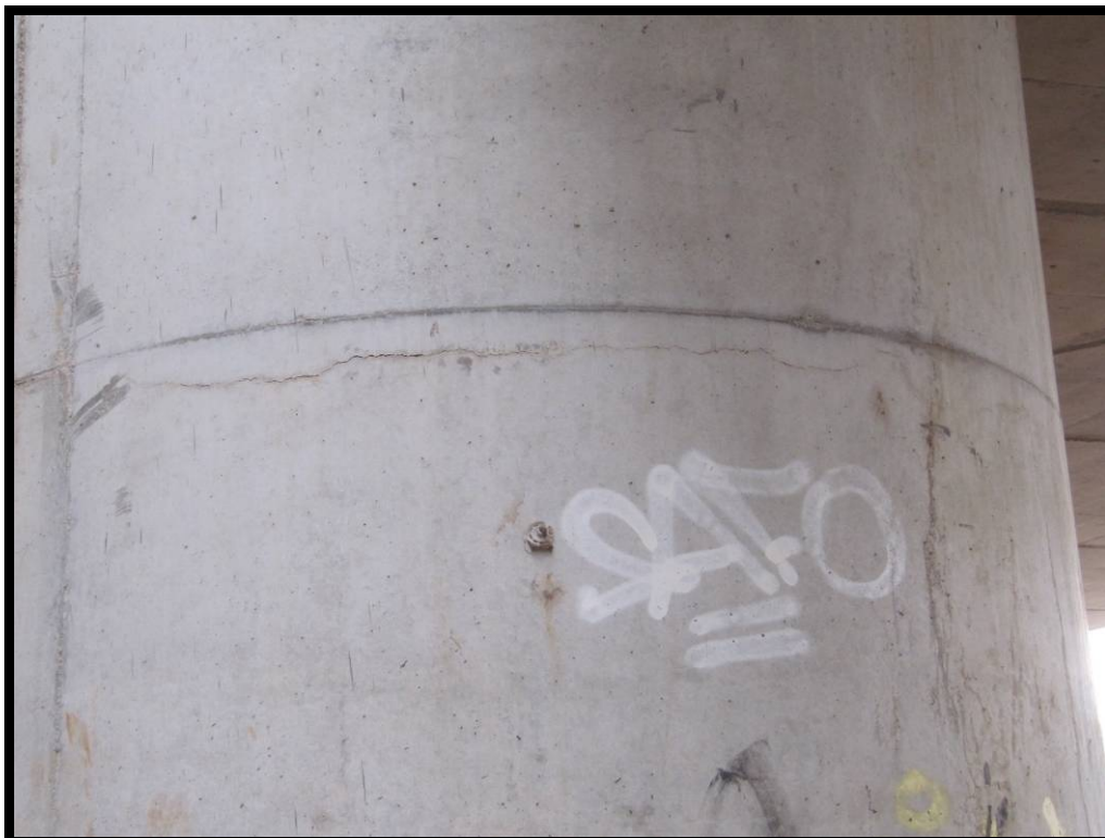
Fisura, fuste derecho pila 4.
