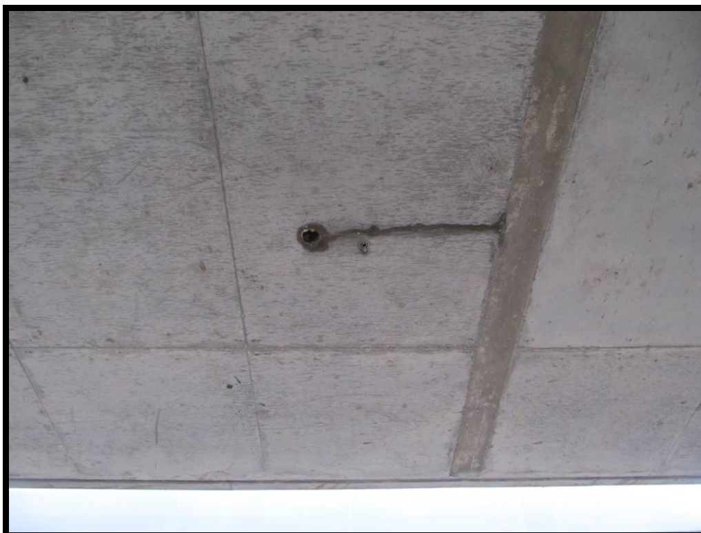
Falta de gárgolas en sumideros.
