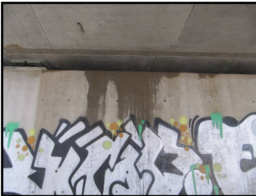
Humedades, muro frontal del estribo 1.
