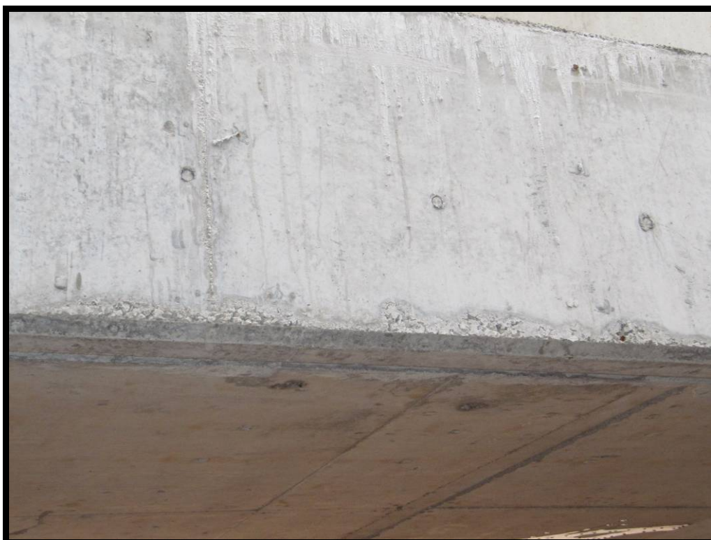
Nidos de grava/Coqueras, viga derecha del vano 5.
