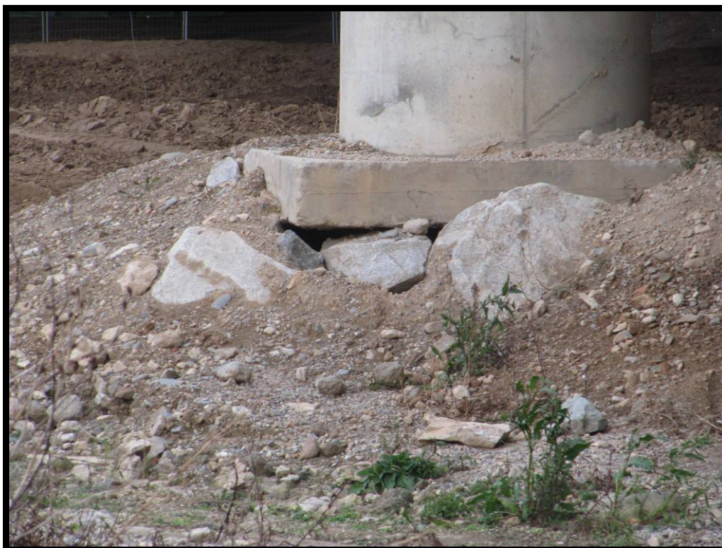
Pérdida de material de protección, fuste izquierdo pila 3.
