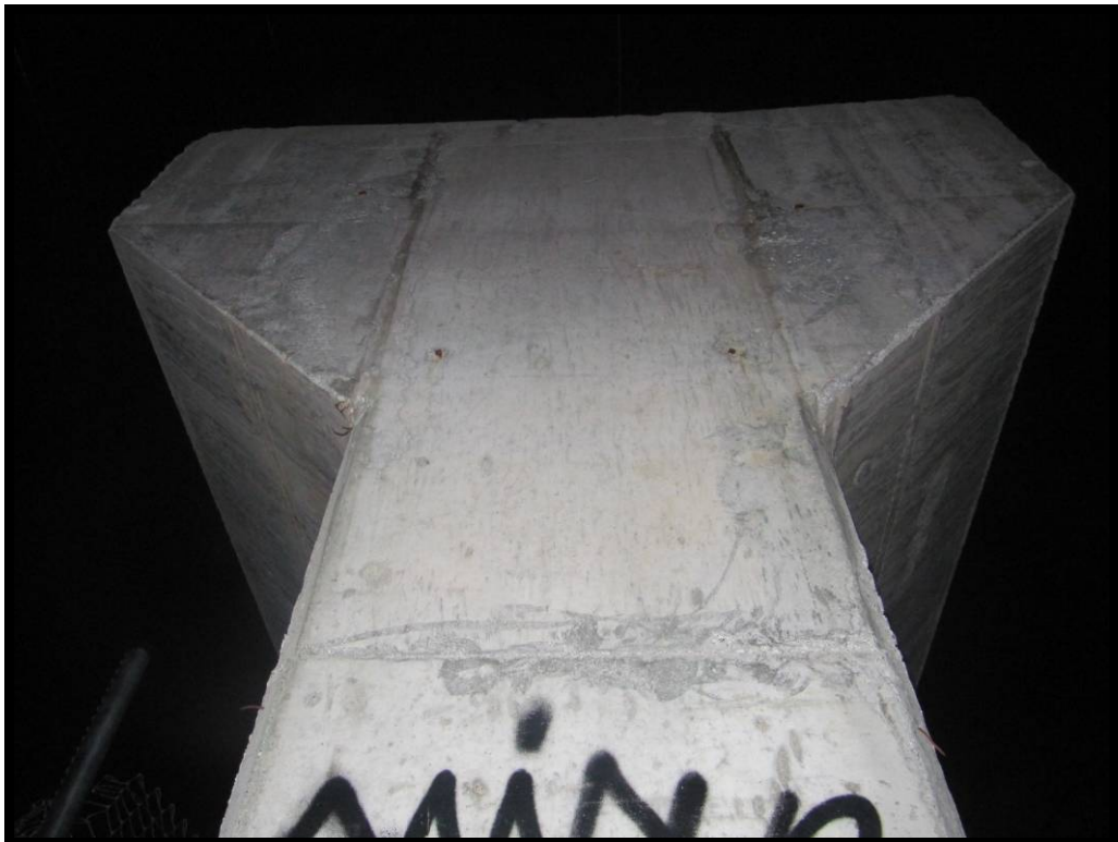
Armadura vista, plataforma, viga derecha vano 5.
