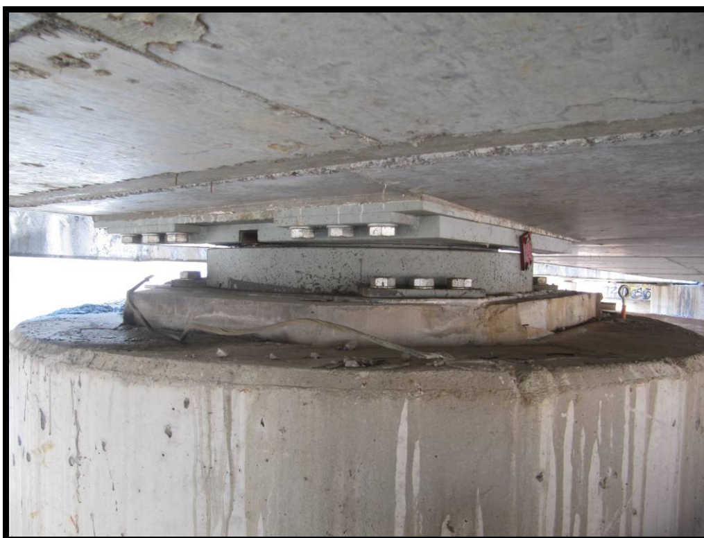
Desconchón en cama de nivelación, fuste derecho de la pila 1.
