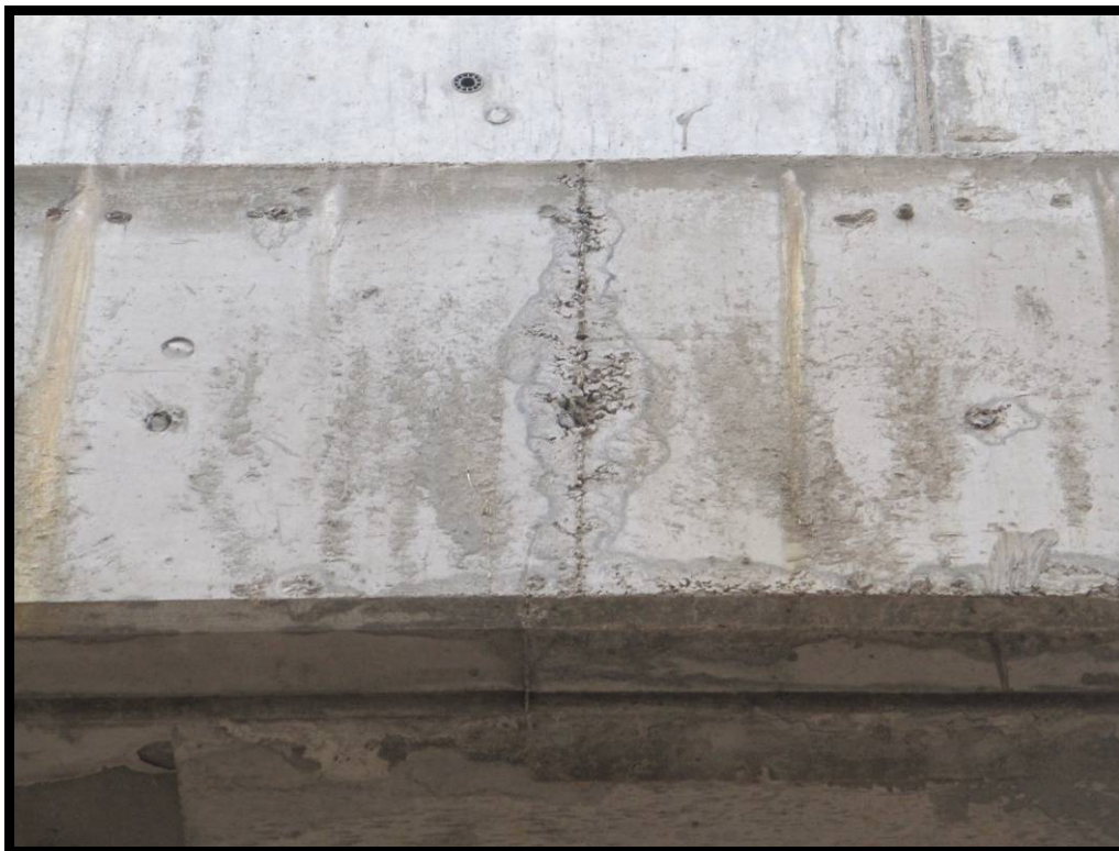
Nidos de grava/coqueras, viga derecha del vano 1.
