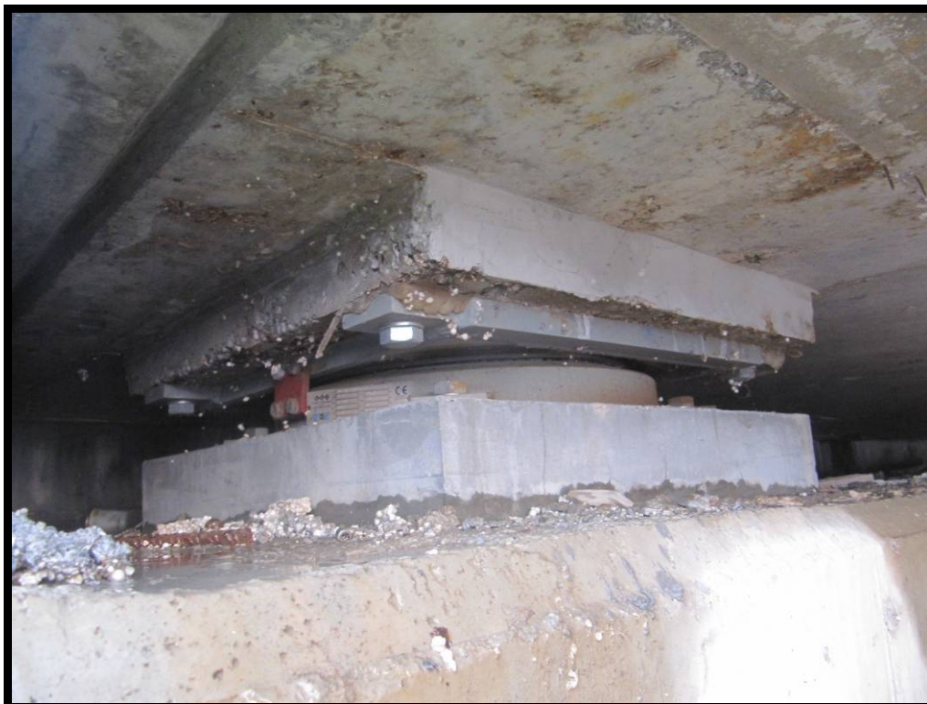
Nidos de grava/Coqueras, cama de nivelación superior derecha del estribo 2.
