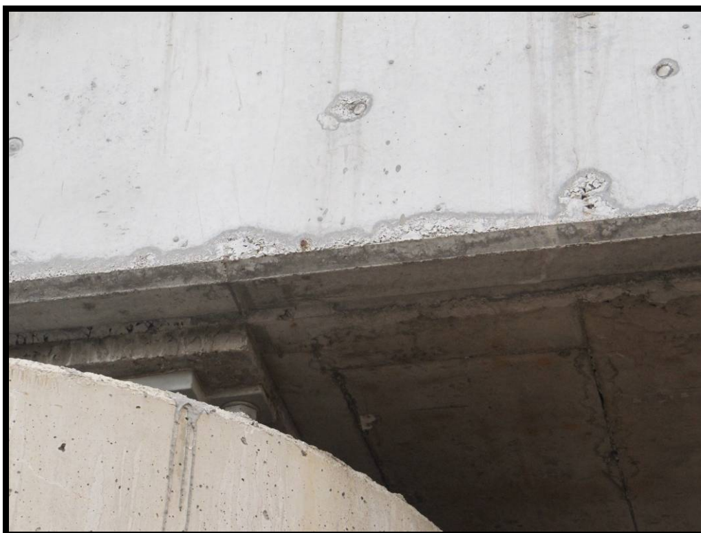
Nidos de grava/Coqueras, viga izquierda del vano 4.
