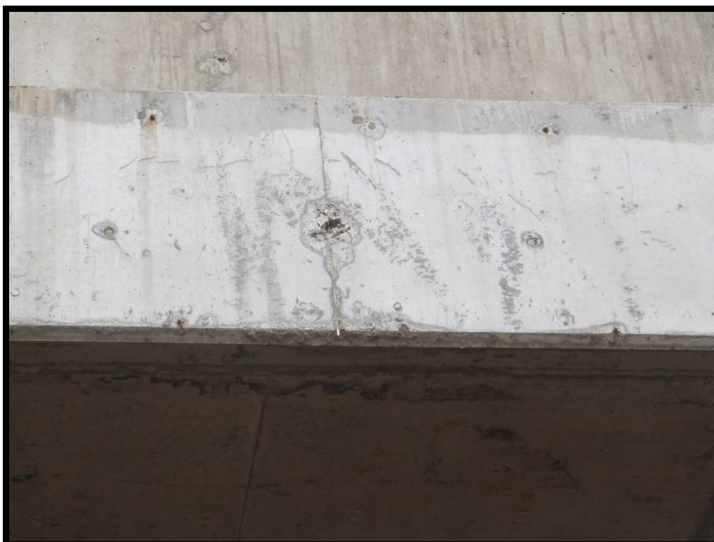
Nidos de grava/Coqueras, viga izquierda del vano 4.
