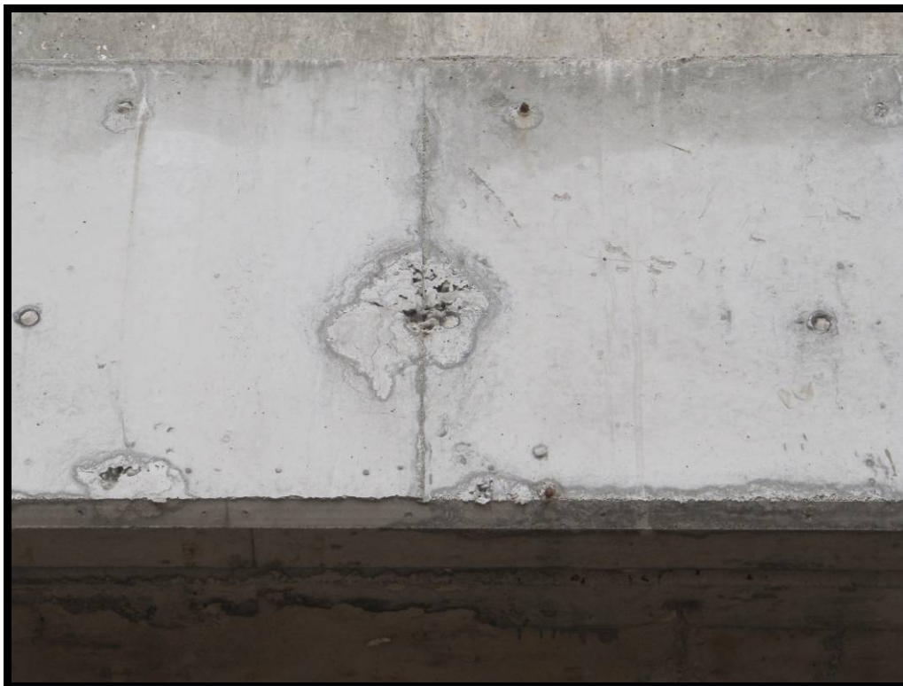
Nidos de grava/Coqueras, viga izquierda del vano 4.
