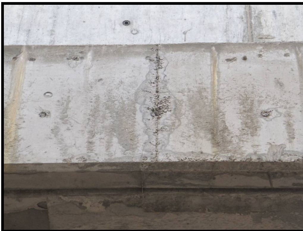
Nidos de grava/coqueras, viga derecha del vano 1.
