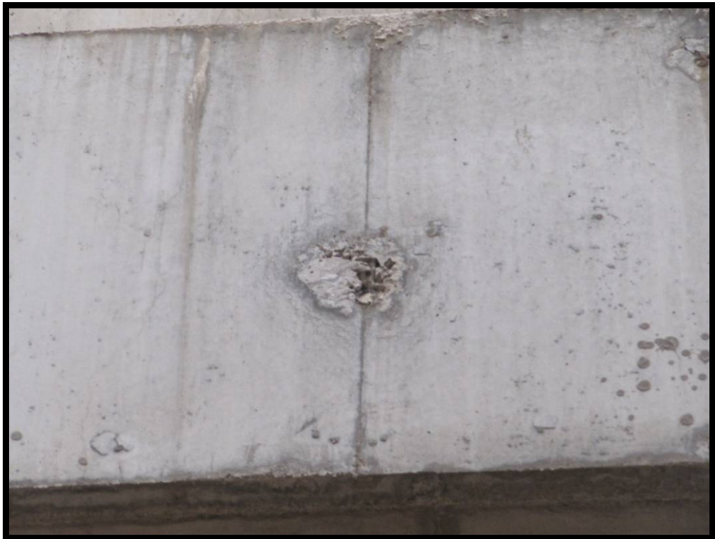
Nidos de grava/Coqueras, viga derecha del vano 5.
