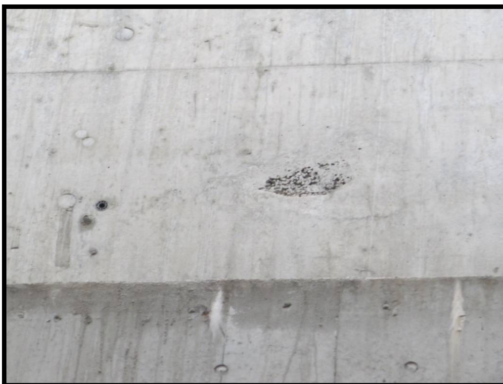
Nidos de grava/coqueras, viga derecha del vano 1.
