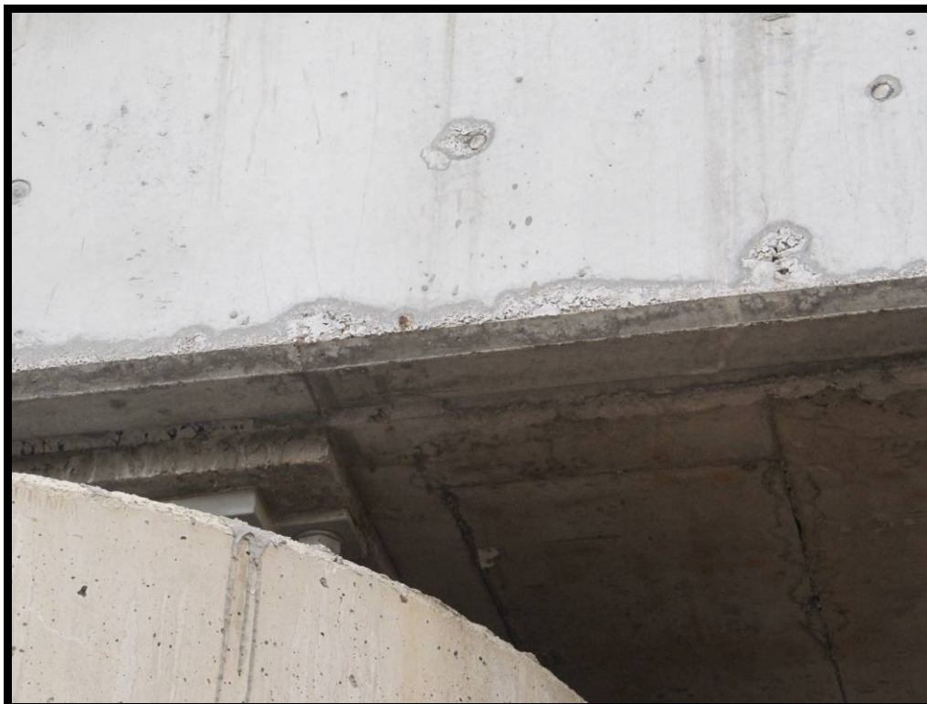
Nidos de grava/Coqueras, viga izquierda del vano 4.
