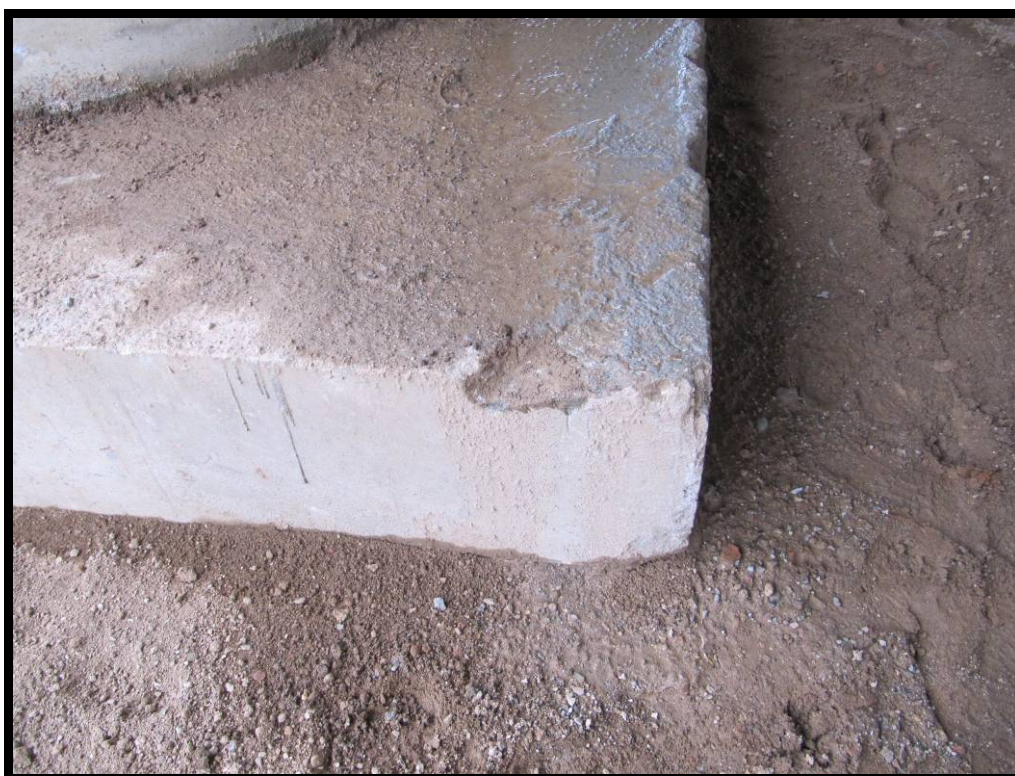
Desconchón, zapata del fuste izquierdo de la pila 2.
