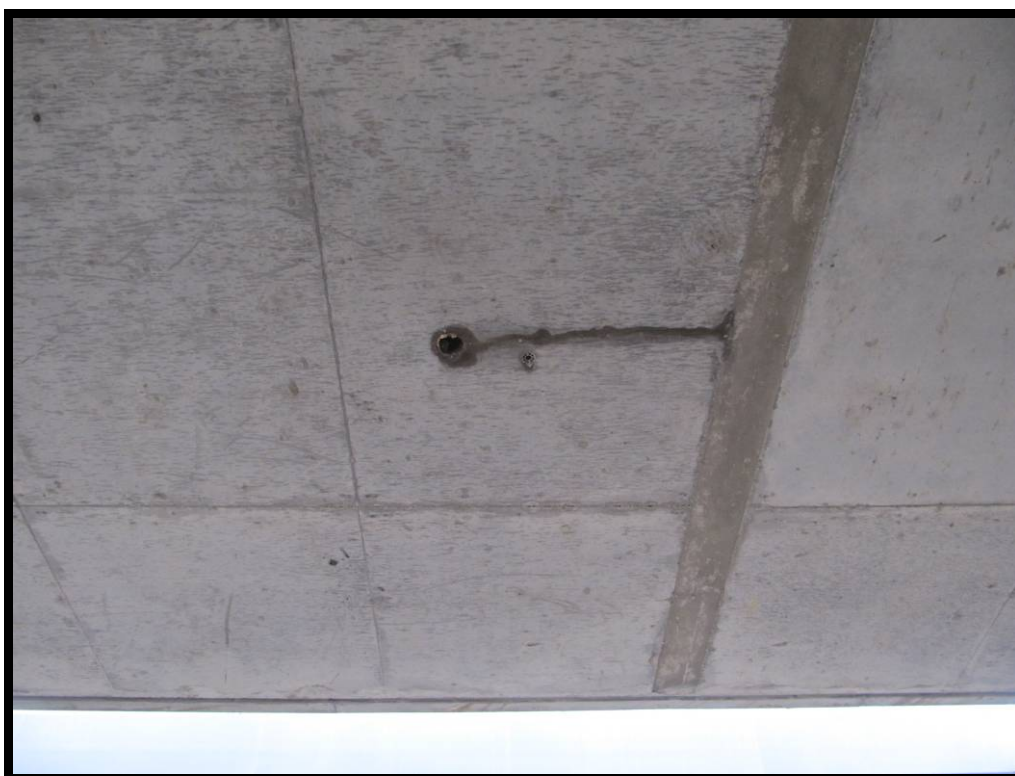
Falta de gárgolas en sumideros.
