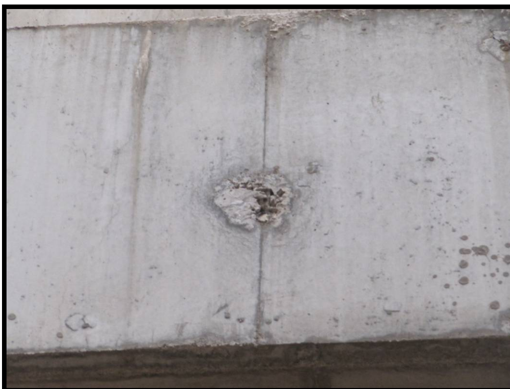
Nidos de grava/Coqueras, viga derecha del vano 5.
