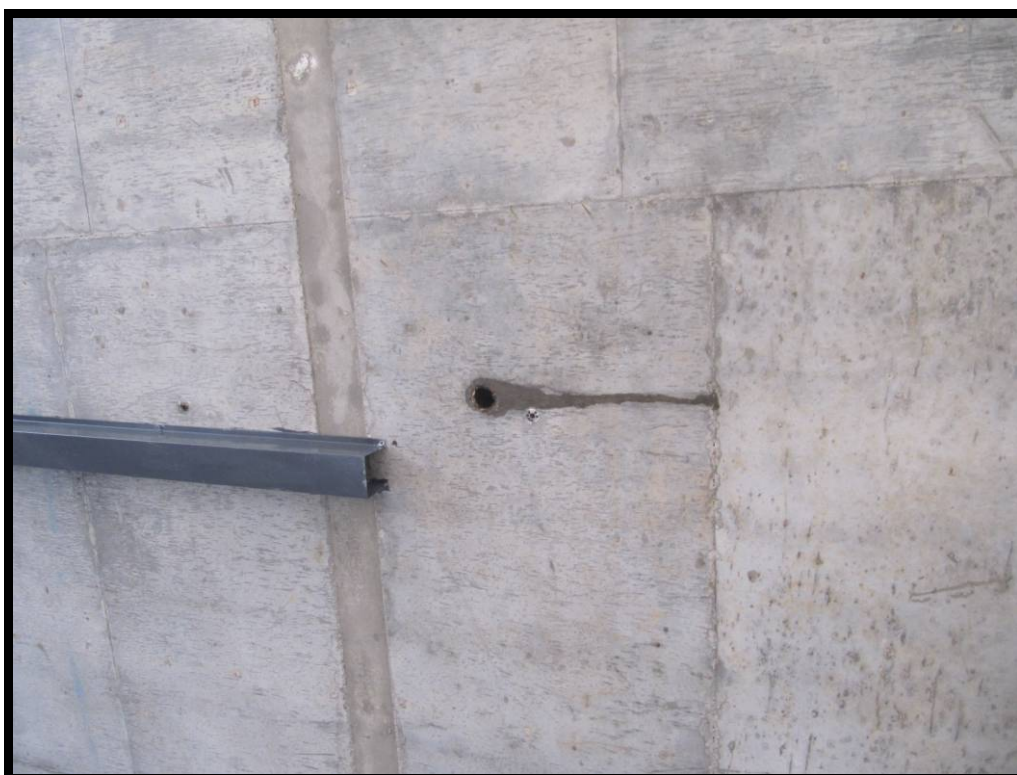
Falta de gárgolas en sumideros.
