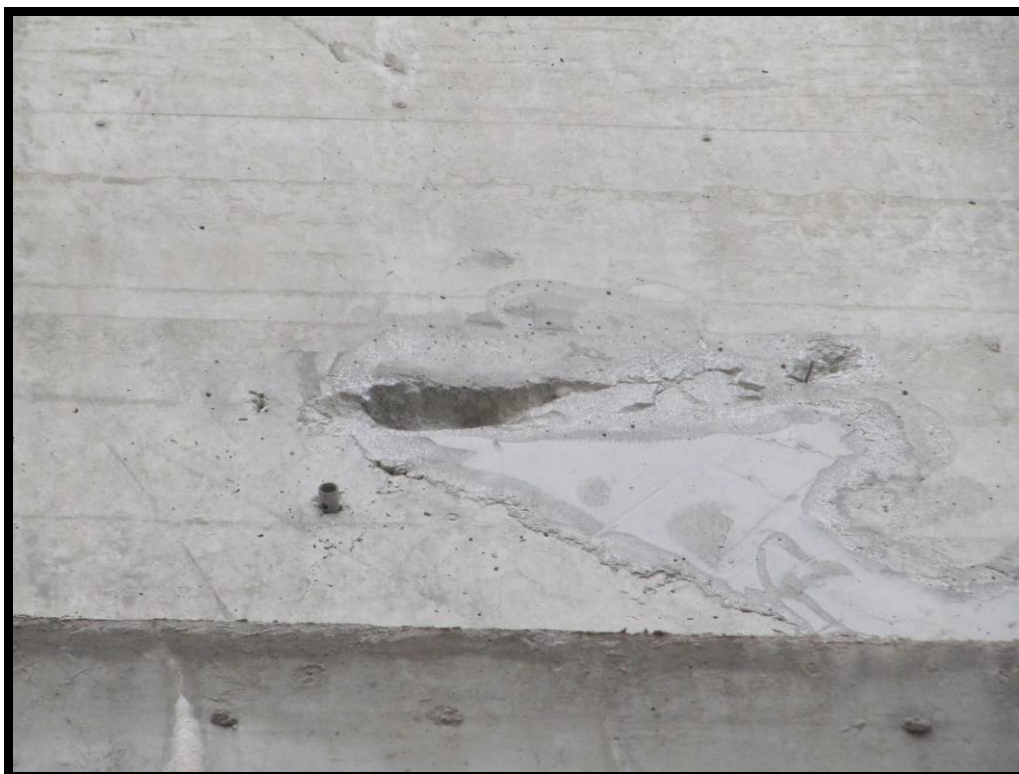
Coquera, viga derecha vano 2.
