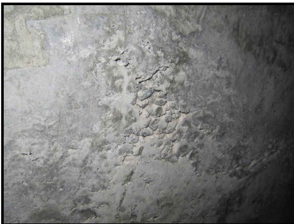
Nidos de grava/Coqueras, plataforma, viga derecha vano 1.
