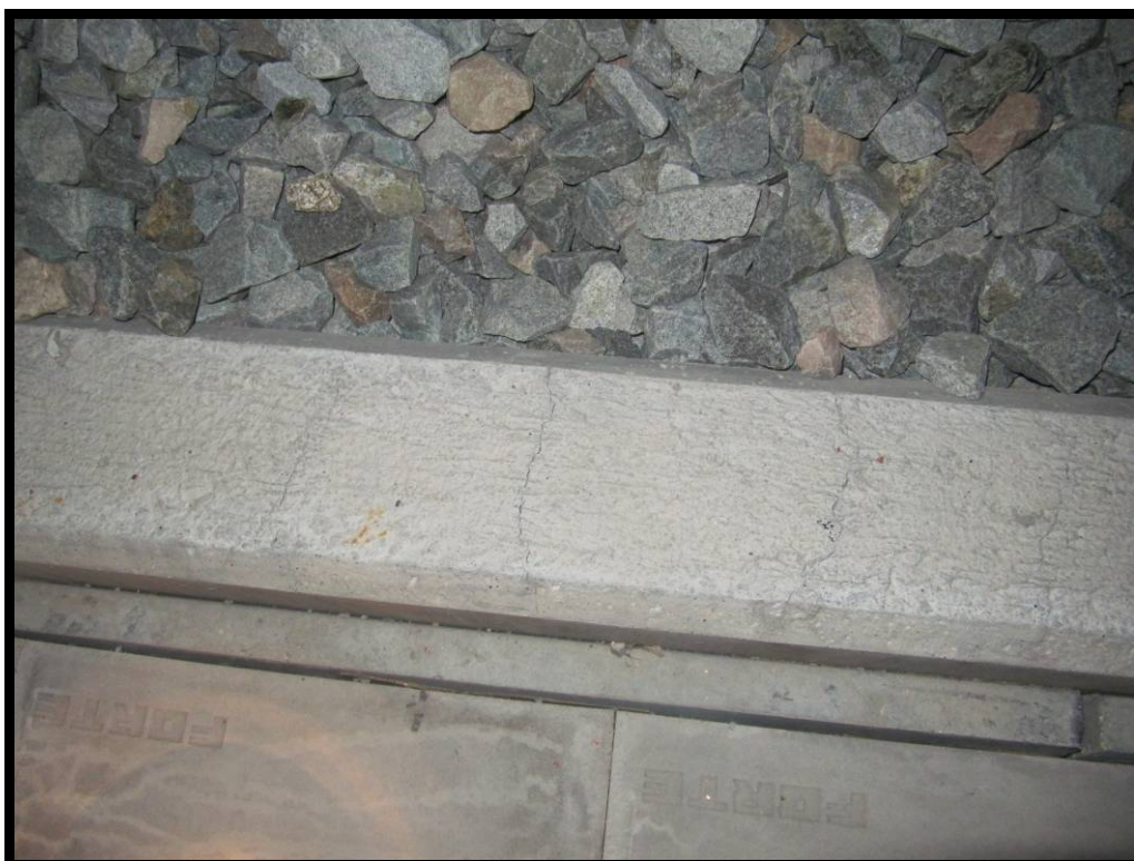
Fisuras, murete guarda balasto izquierdo del vano 5.
