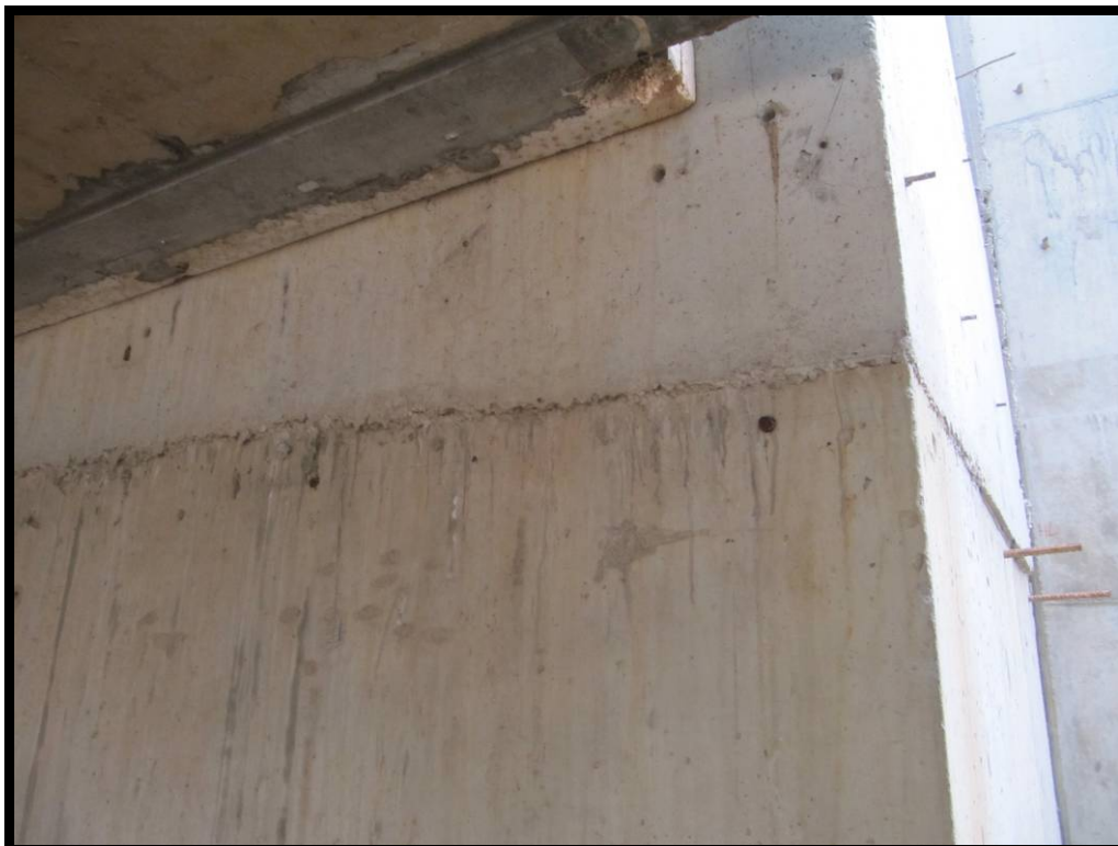
Barras corrugadas a la vista, estribo 2.
