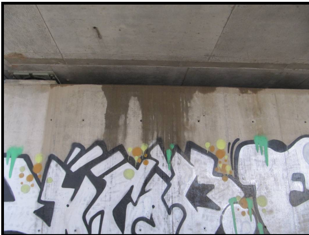
Humedades, muro frontal del estribo 1.
