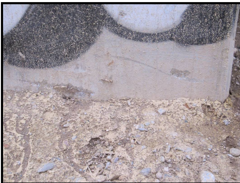
Desconchón, muro lateral derecho del estribo 1.
