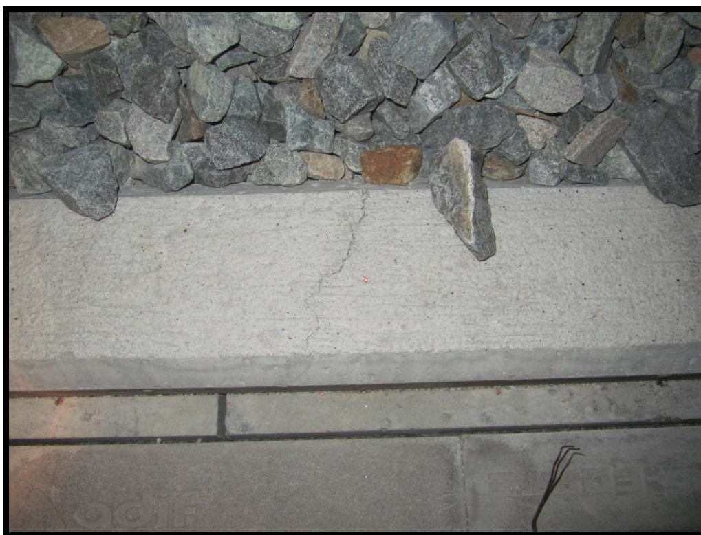
Fisuras, murete guarda balasto derecho del vano 5.
