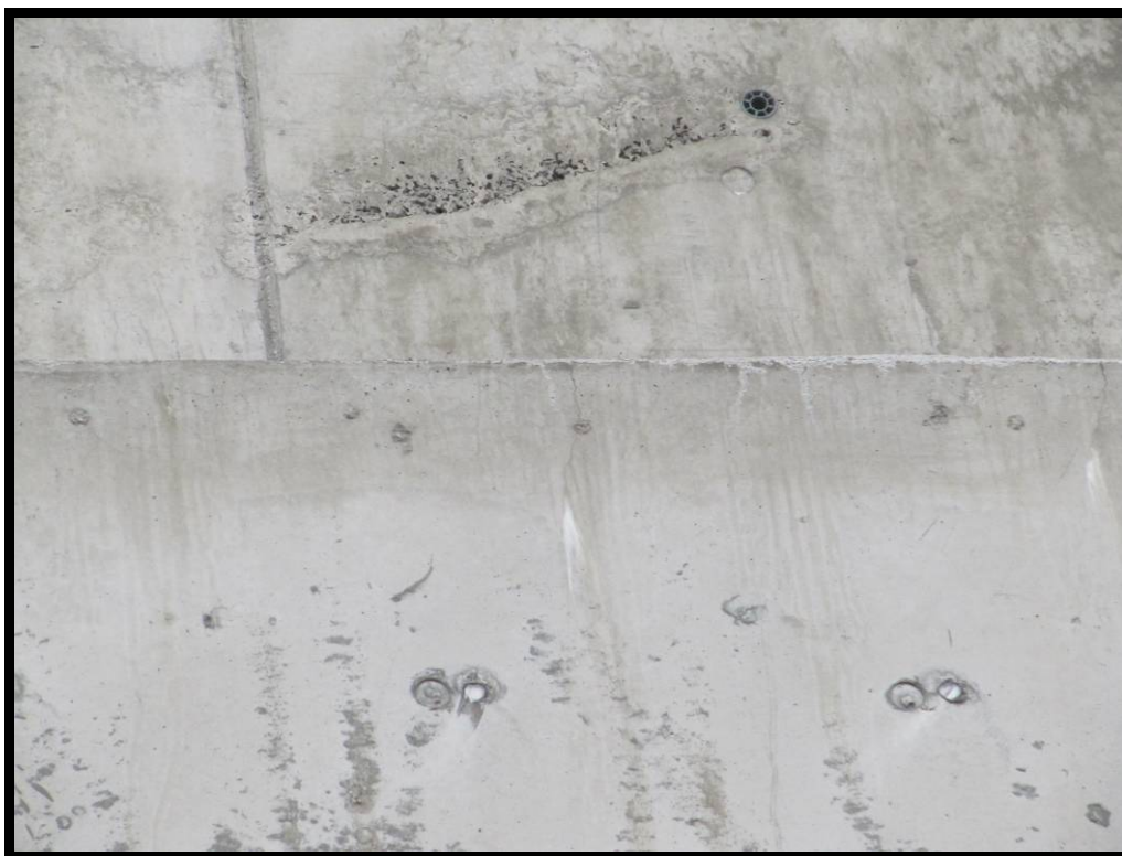
Nidos de grava/Coqueras, viga izquierda del vano 3.
