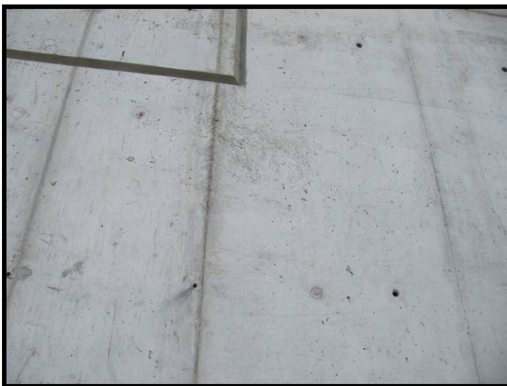
Nidos de grava/Coqueras, viga izquierda del vano 4.
