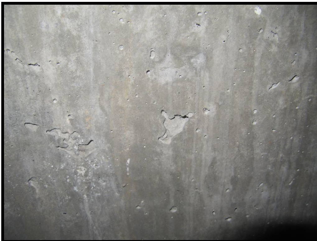
Coqueras, plataforma, viga derecha vano 4.
