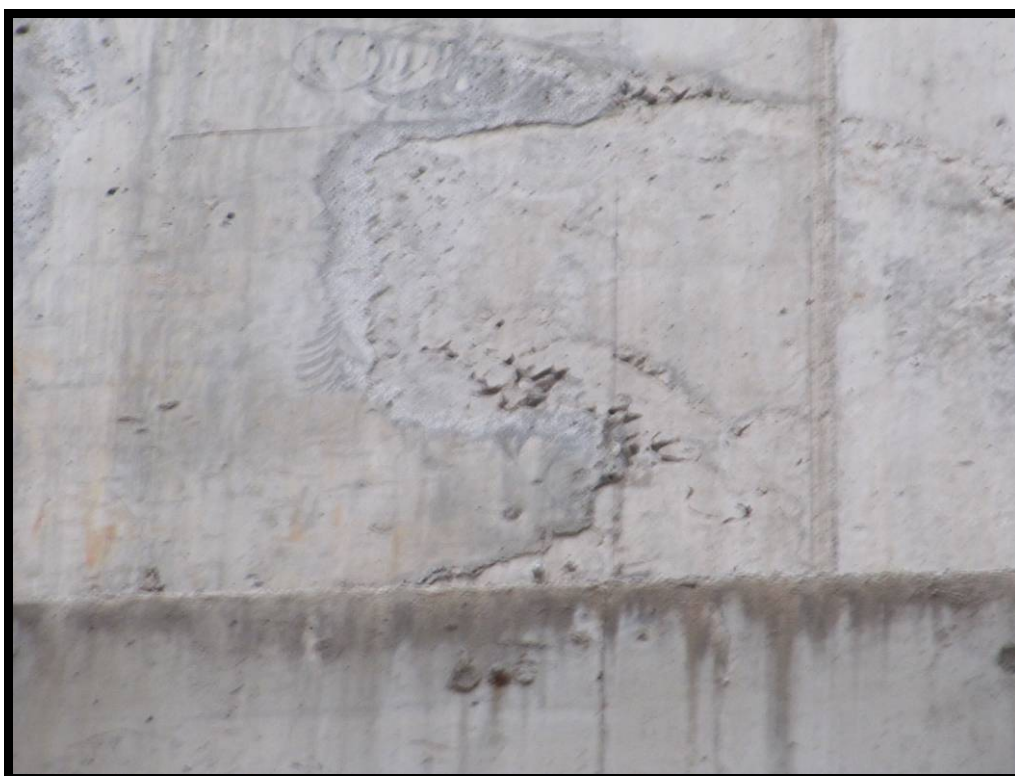
Nidos de grava/Coqueras, viga derecha del vano 3.
