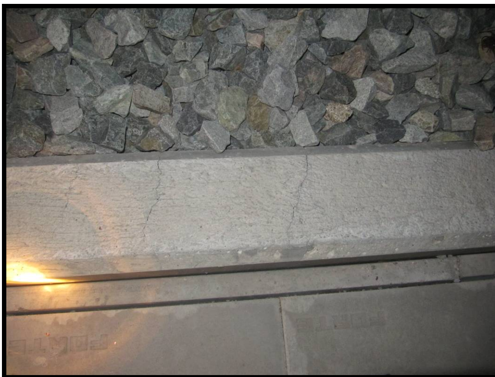
Fisuras, murete guarda balasto izquierdo del vano 4.
