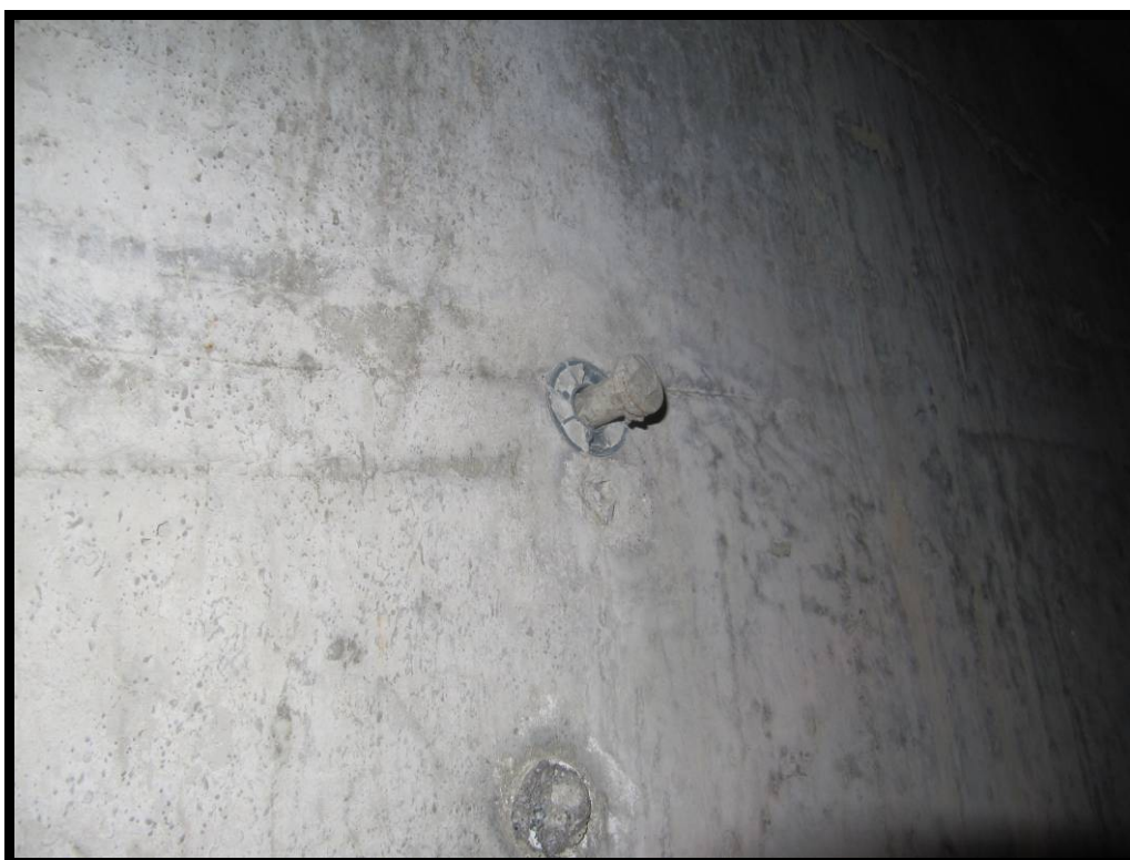
Perno de montaje sin quitar, plataforma, vano 3 viga izquierda.
