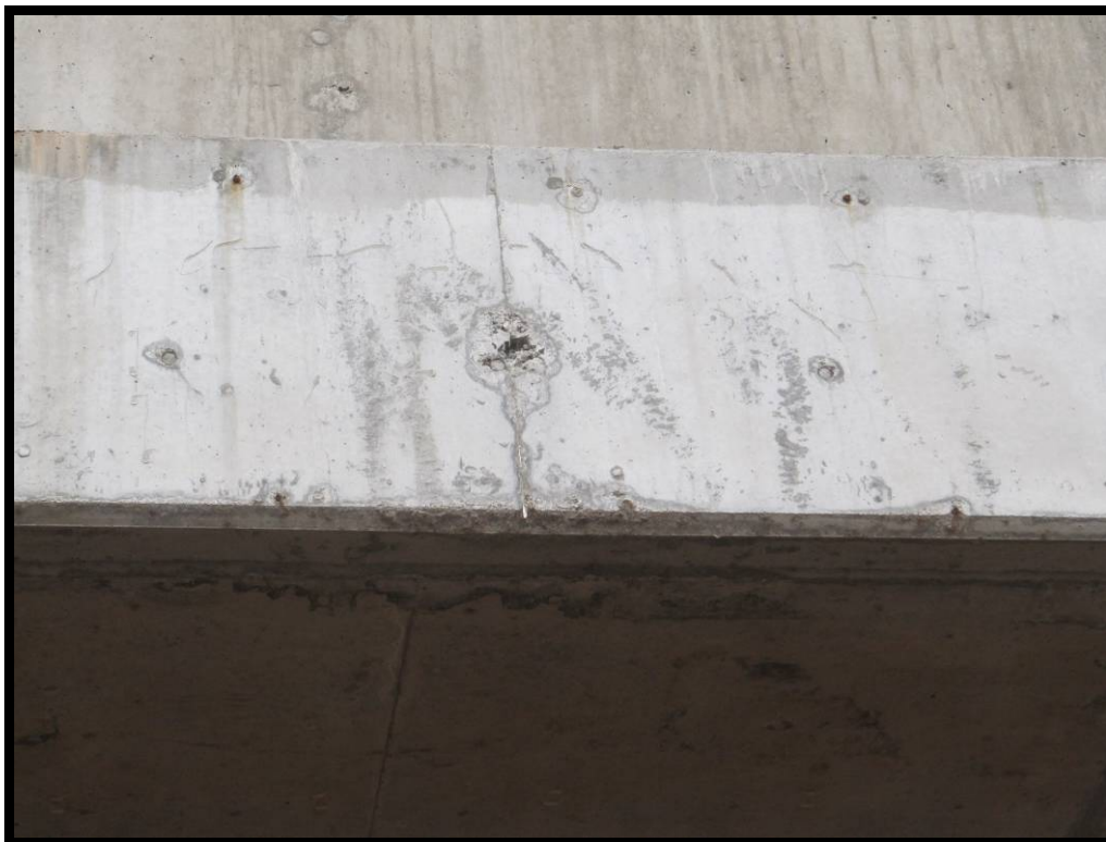
Nidos de grava/Coqueras, viga izquierda del vano 4.
