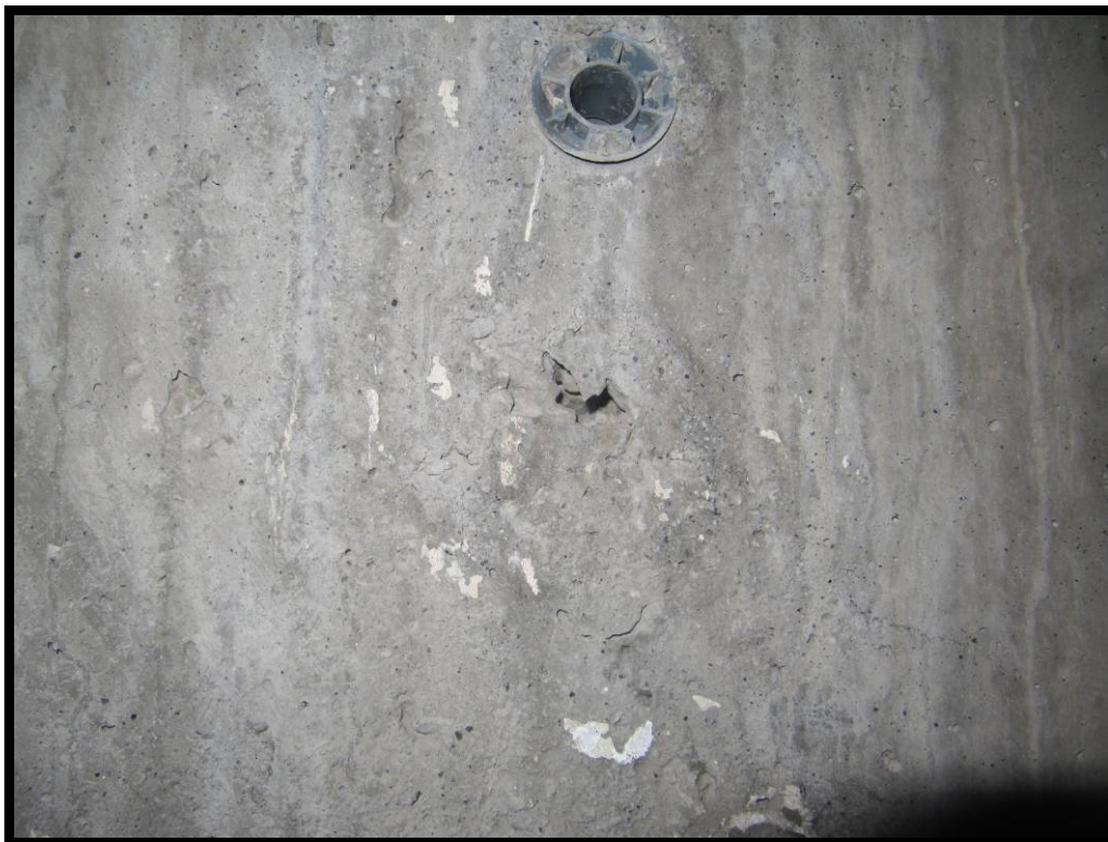
Coqueras, plataforma, viga derecha vano 4.
