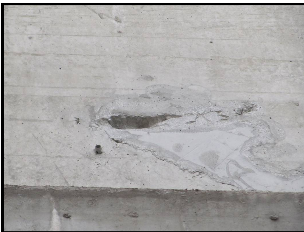
Coquera, viga derecha vano 2.
