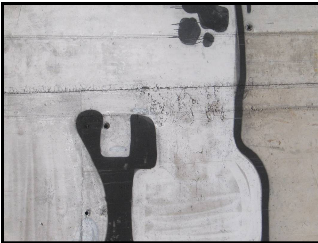
Nidos de grava/coqueras, muro lateral derecho estribo 1.
