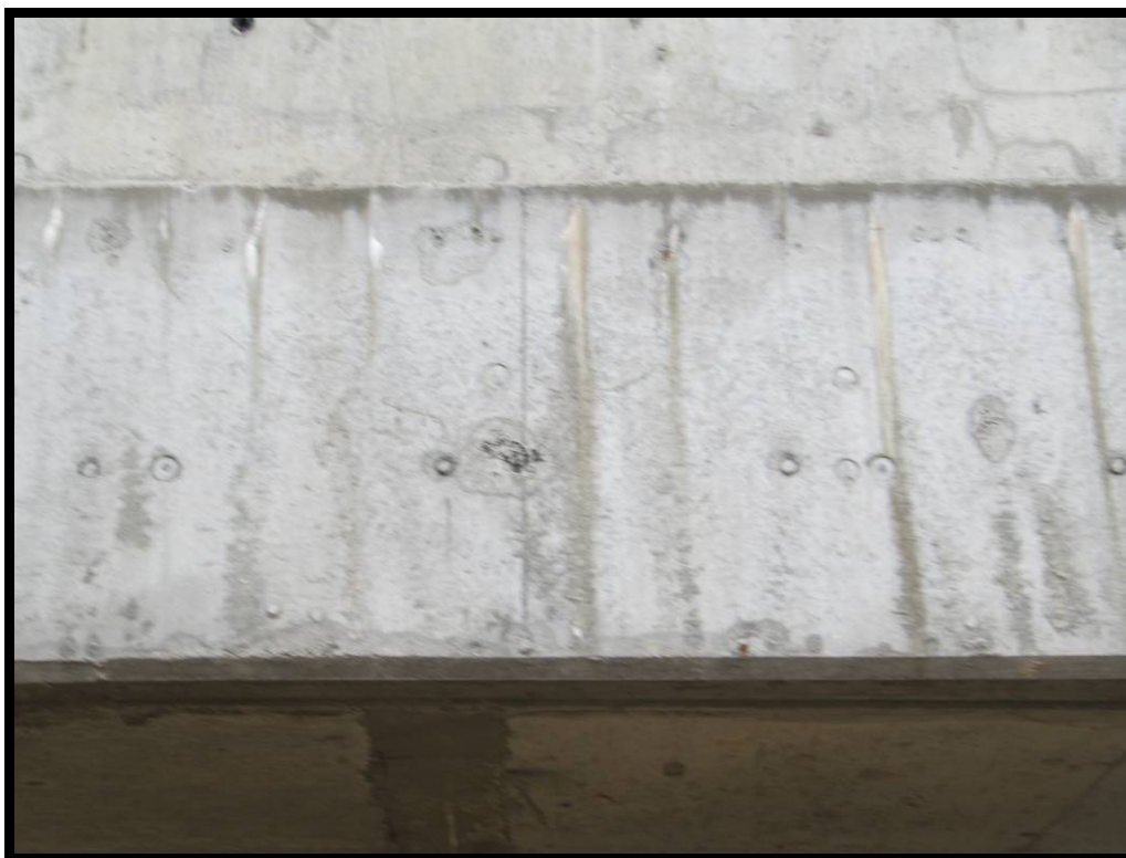
Nidos de grava/coqueras, viga izquierda del vano 1.
