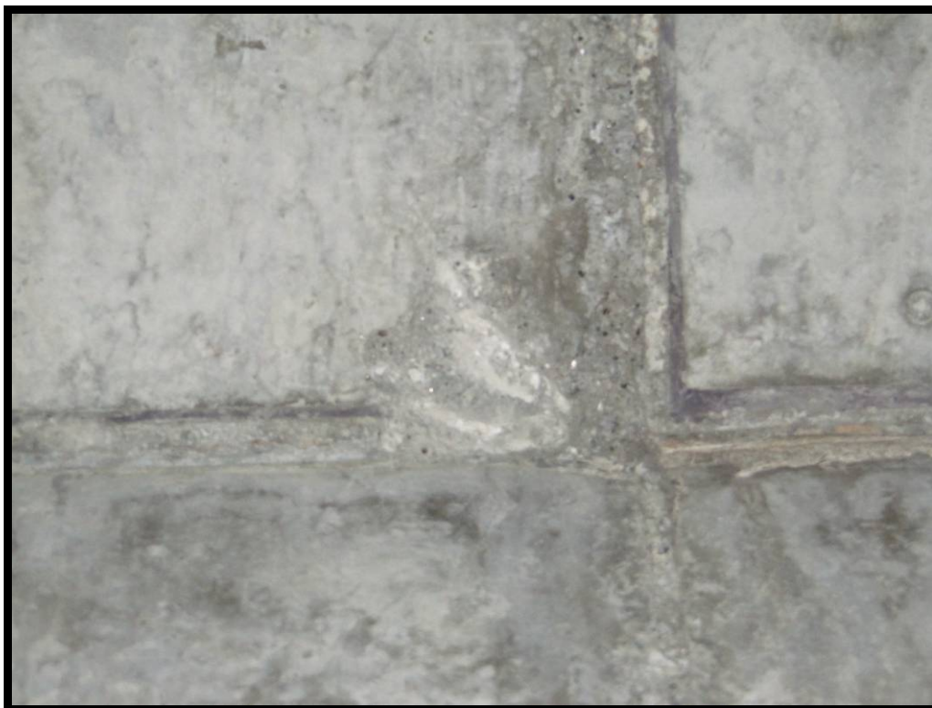
Desconchón, plataforma, viga izquierda vano 3
