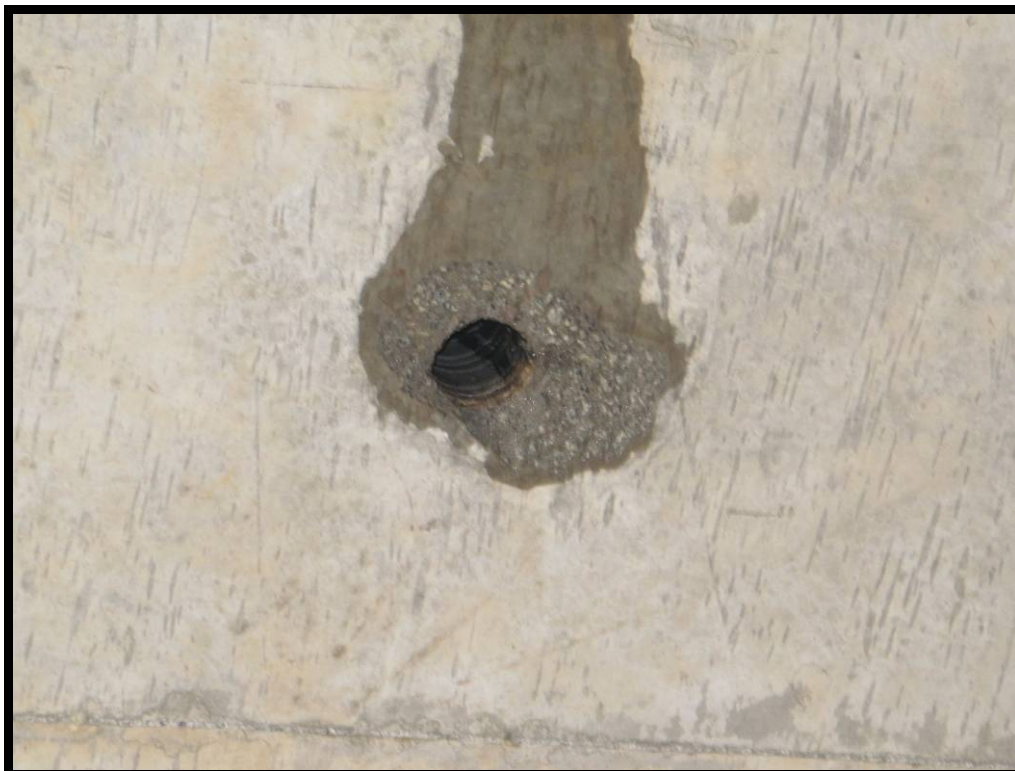
Desconchón en sumidero, lado izquierdo del vano 2.
