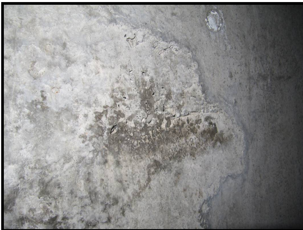
Nidos de grava/Coqueras, plataforma, viga derecha vano 2.
