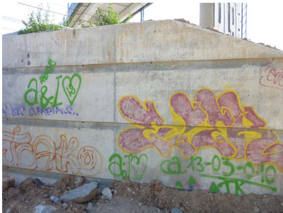
FOTOGRAFIA N° 12: Pintadas en la aleta izquierda del estribo de entrada
