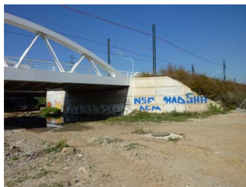
Fotografía nº 10. Pintadas en la aleta derecha del estribo de salida.
