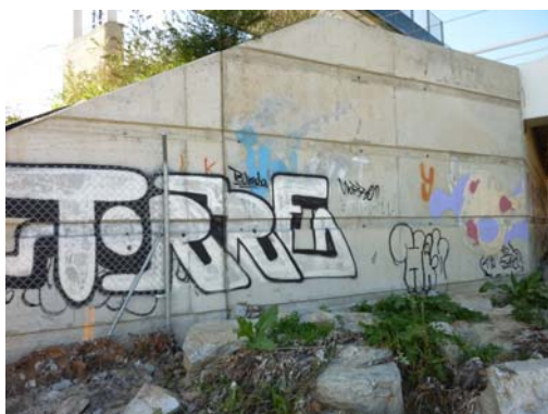
Fotografía nº 9. Pintadas en la aleta derecha del estribo de entrada.
