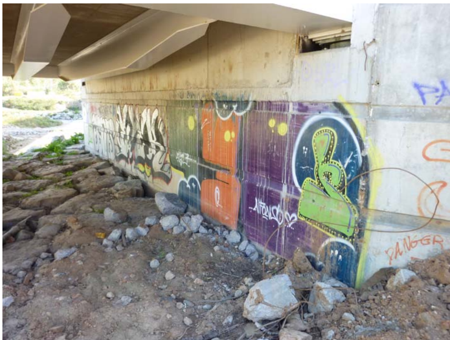
FOTOGRAFIA N° 12: Pintadas en el muro de frente del estribo de entrada
