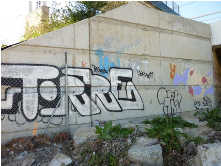
FOTOGRAFIA N° 11: Pintadas en la aleta derecha del estribo de entrada
