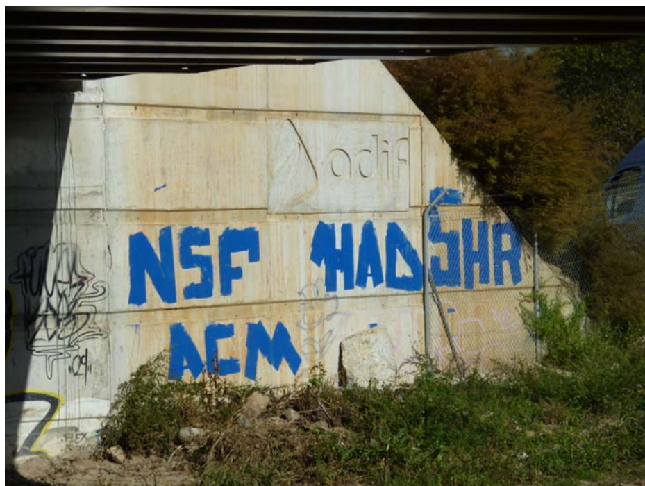
FOTOGRAFIA N° 11: Pintadas en la aleta derecha del estribo de salida
