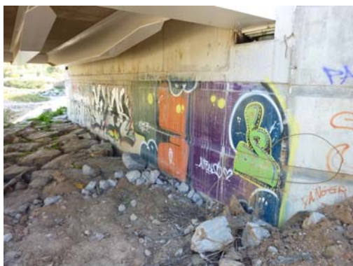
Fotografía nº 7. Pintadas en el muro de frente del estribo de entrada.
