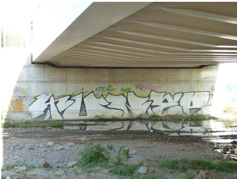
FOTOGRAFIA N° 12: Pintadas en el muro de frente de estribo de salida
