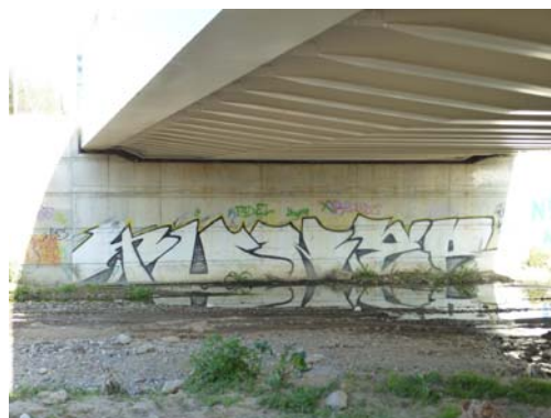
Fotografía nº 8. Pintadas en el muro de frente del estribo de entrada.
