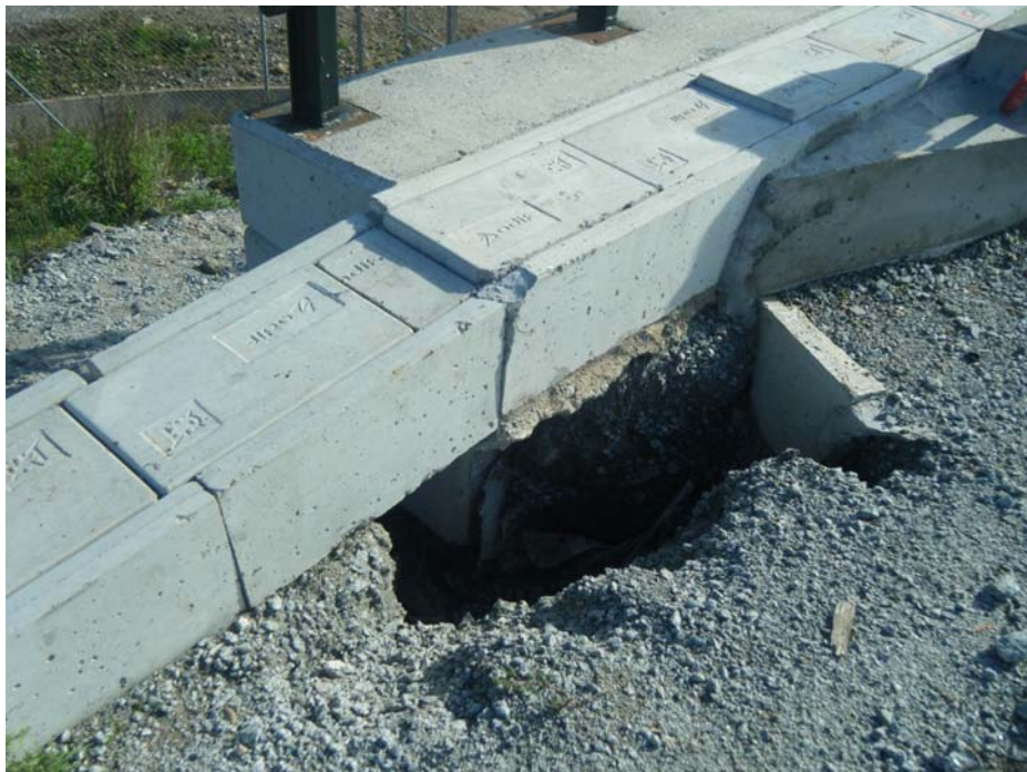
FOTOGRAFIA N° 29: Erosión en el terraplén derecho del estribo de salida
