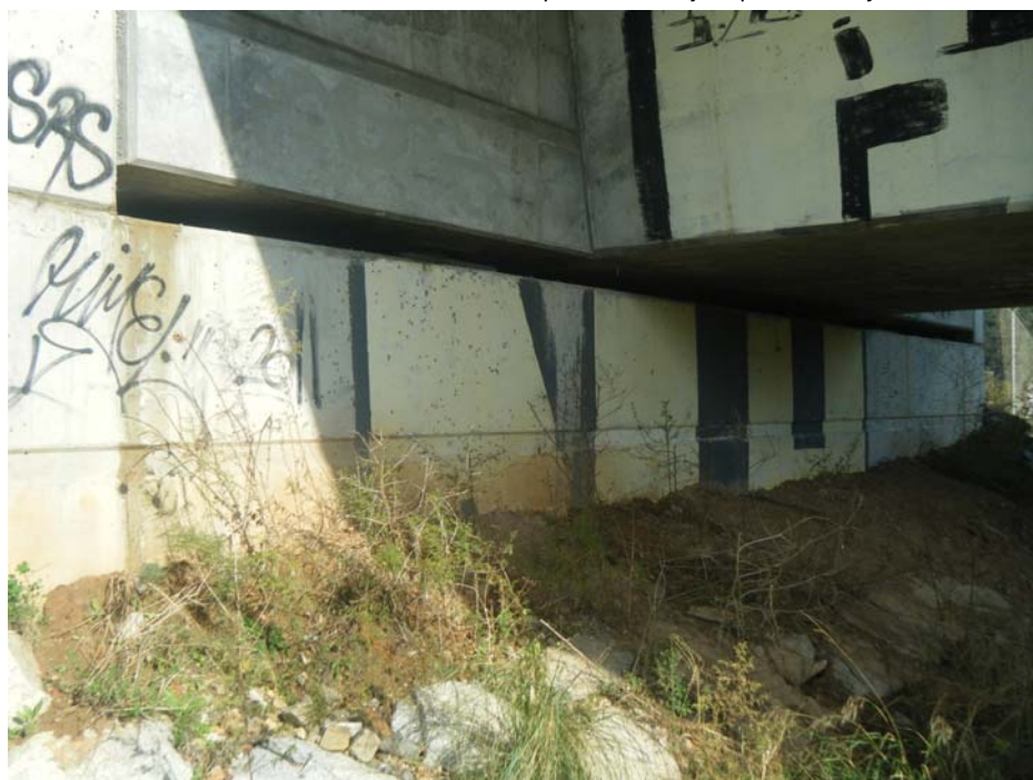
FOTOGRAFIA N° 24: Pintadas en el muro de frente del estribo de salida
