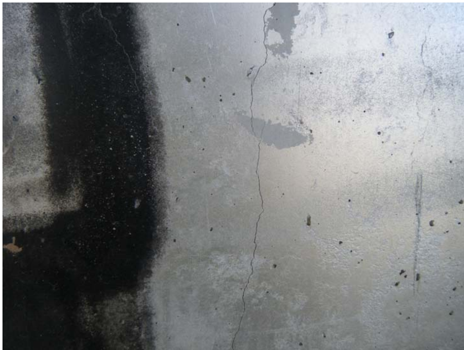
FOTOGRAFIA N° 17: Fisura en el muro de frente estribo de entrada
