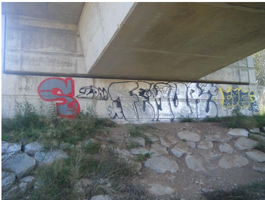
FOTOGRAFIA N° 18: Pintadas en el muro de frente estribo de entrada
