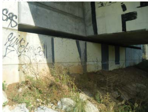
Fotografía nº 11. Pintadas en el muro de frente del estribo de salida
