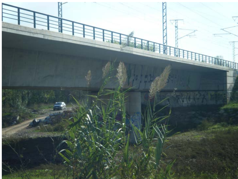
FOTOGRAFIA N° 23: Pintadas en el alma izquierda del cajón que constituye el tablero
