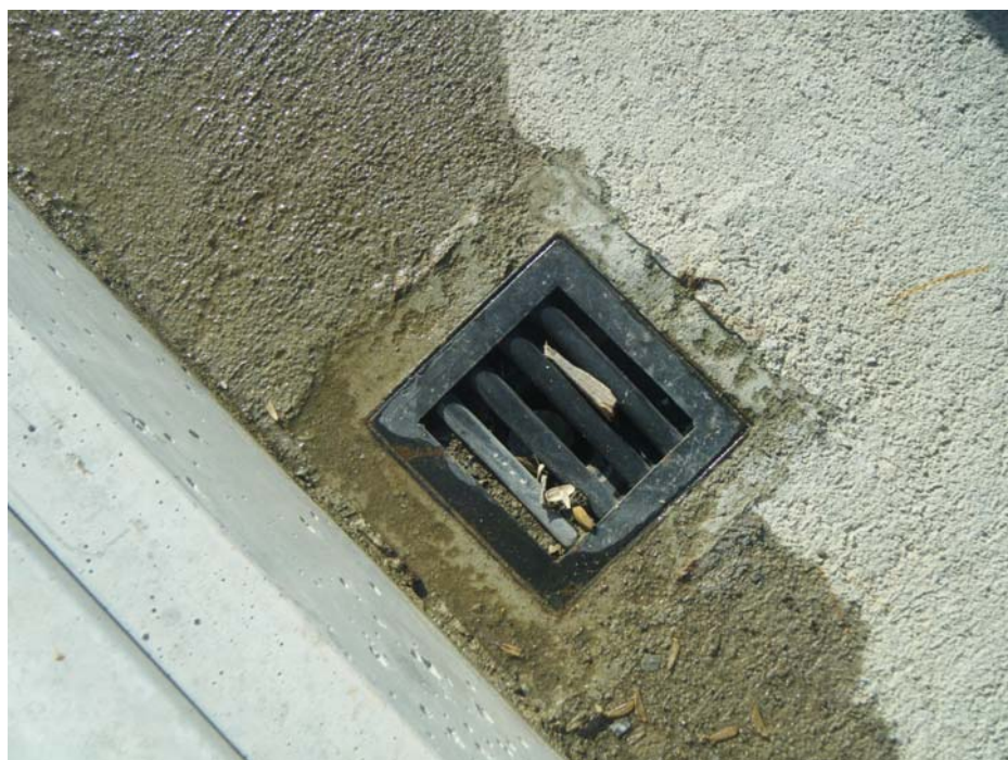
FOTOGRAFIA N° 14: Rejilla de protección empleada en los imbornales
