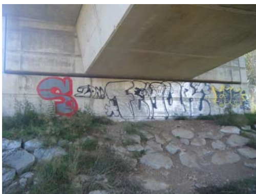
Fotografía nº 8. Pintadas en el muro de frente del estribo de entrada
