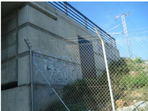
Fotografía nº 12. Pintadas en la aleta derecha del estribo de salida
