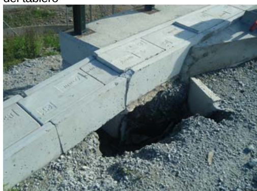
Fotografía nº 16. Erosión en el terraplén derecho del estribo de salida bajo la aleta dcha.
