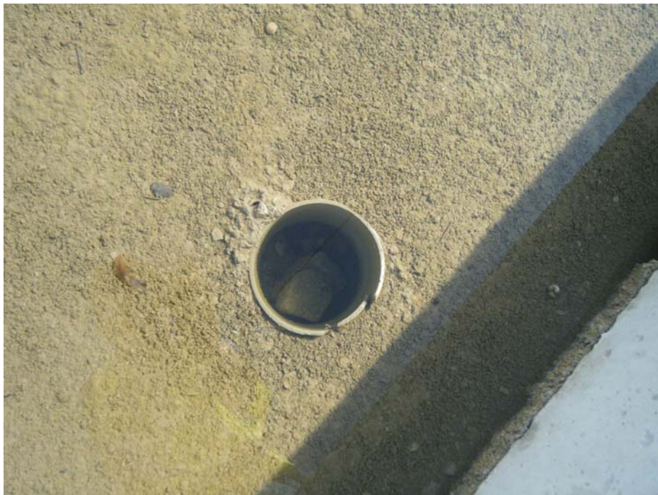
FOTOGRAFIA N° 27: Obstrucción y ausencia de rejilla de protección en el imbornal izquierdo sobre el vano n° 1
