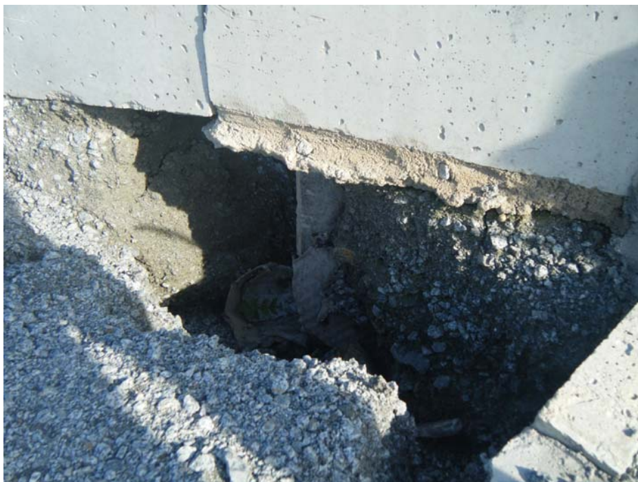
FOTOGRAFIA N° 30: Erosión en el terraplén derecho del estribo de salida
