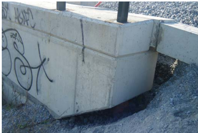
Fotografía nº 6: Erosión en el talud del estribo de salida
