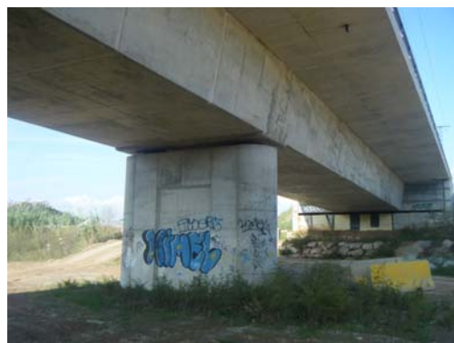
Fotografía nº 19. Pintadas en la pila nº 2
