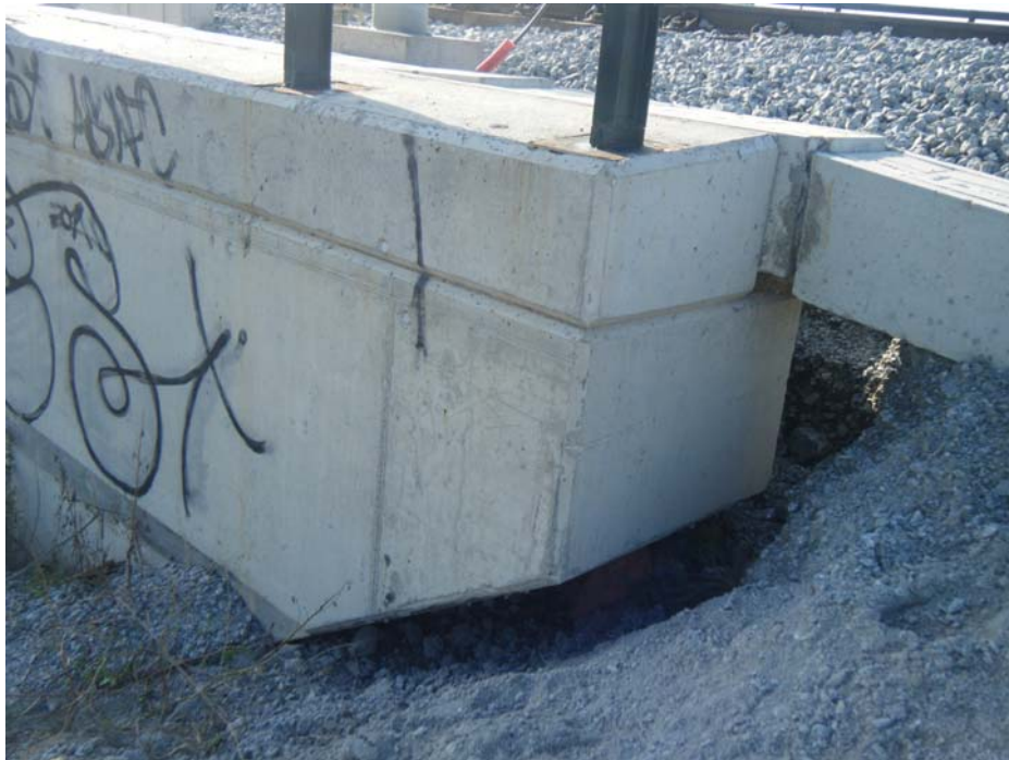
FOTOGRAFIA N° 28: Erosión en el terraplén derecho del estribo de salida
