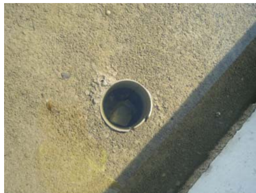
Fotografía nº 15. Obstrucción del imbornal izquierdo situado sobre el tablero del vano nº 1
