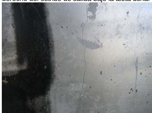
Fotografía nº 18. Fisura existente en el muro de frente del estribo de entrada.
