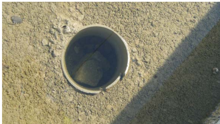
Fotografía nº 7: Obstrucción del imbornal izquierdo sobre el vano nº 1
