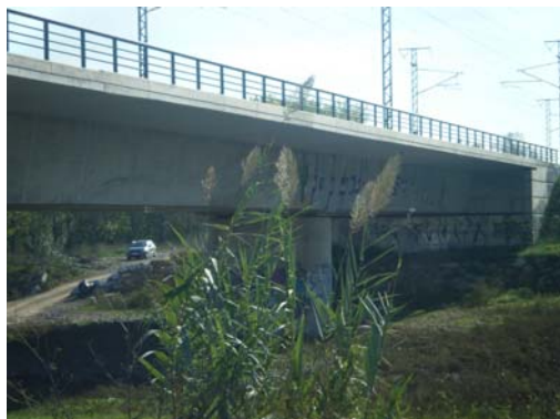
Fotografía nº 14. Pintadas en el alma izquierda del tablero
