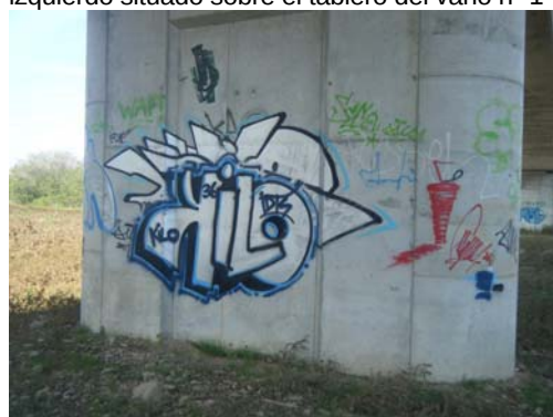
Fotografía nº 17. Pintadas en la pila nº 1
