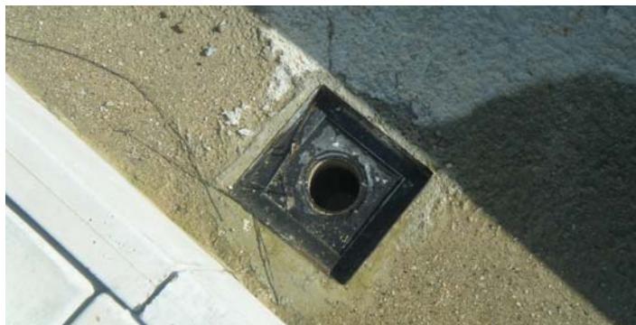
Fotografía nº 7: Ausencia de rejilla en uno de los imbornales
