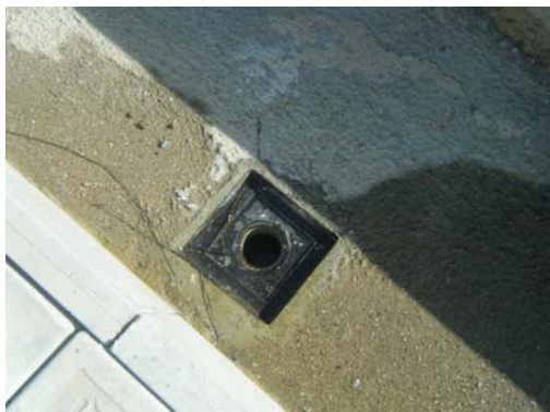
Fotografía nº 18. Ausencia de rejilla de protección en imbornal (Lado izquierdo)
