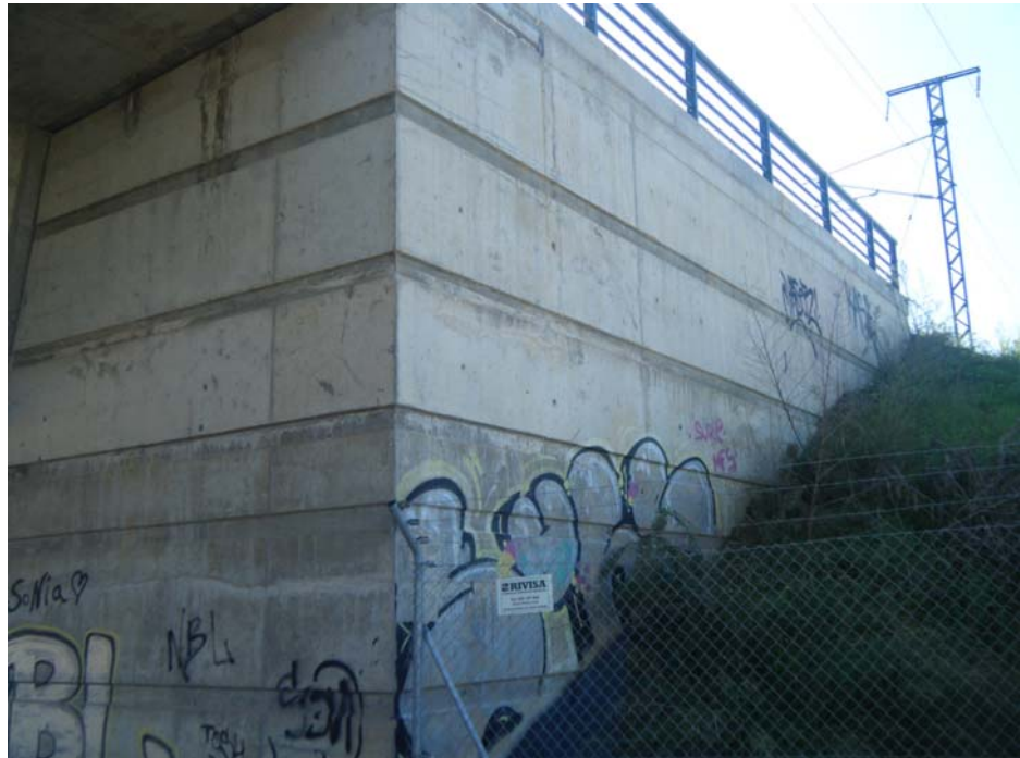
FOTOGRAFIA N° 19: Pintadas la aleta izquierda del estribo de entrada
