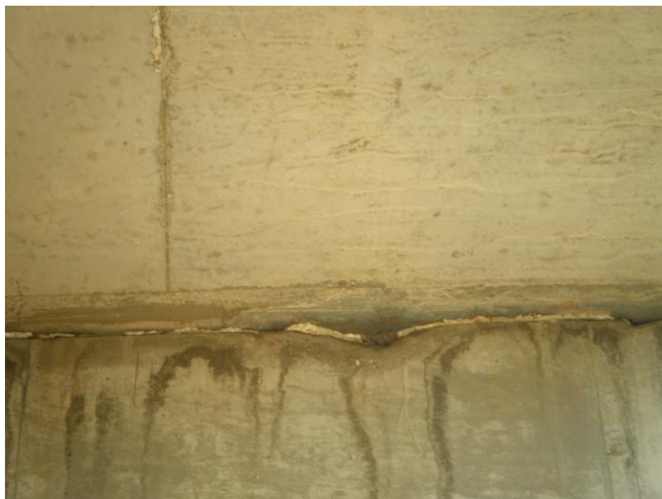
FOTOGRAFIA N° 29: Desconchón en el muro de frente del estribo de salida (Lado derecho)
