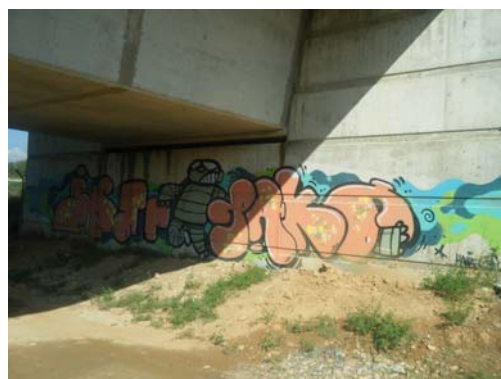
Fotografía nº 13. Humedades en el muro de frente del estribo de salida
