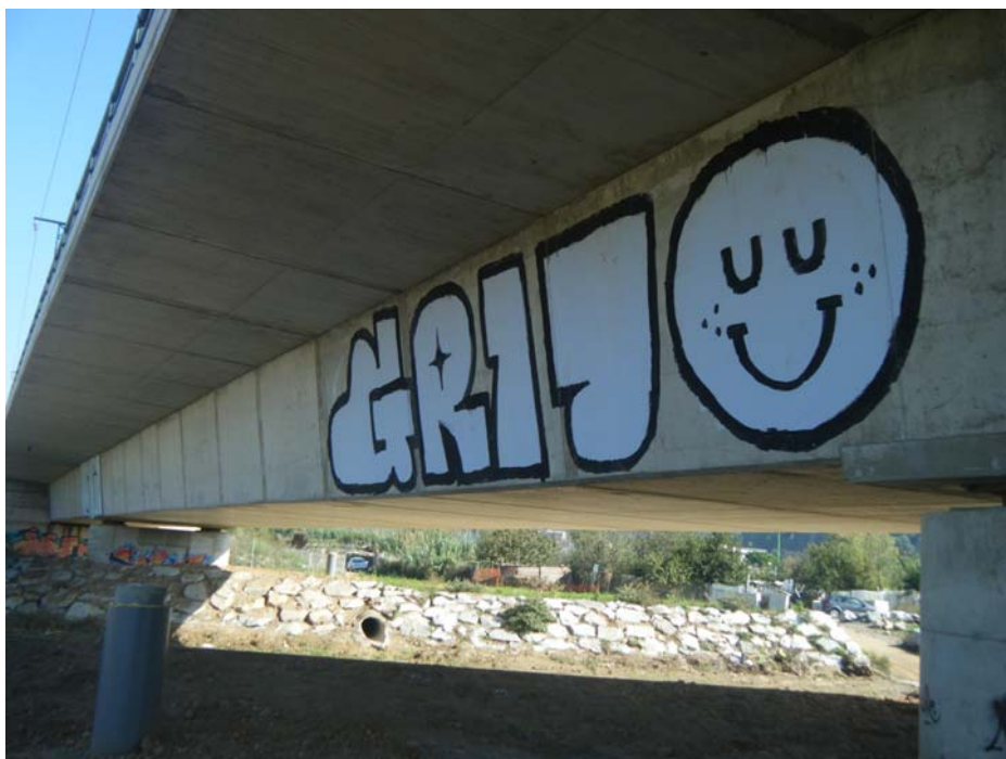
FOTOGRAFIA N° 23: Pintadas en el alma izquierda del cajón en los vanos n° 2 y n° 3
