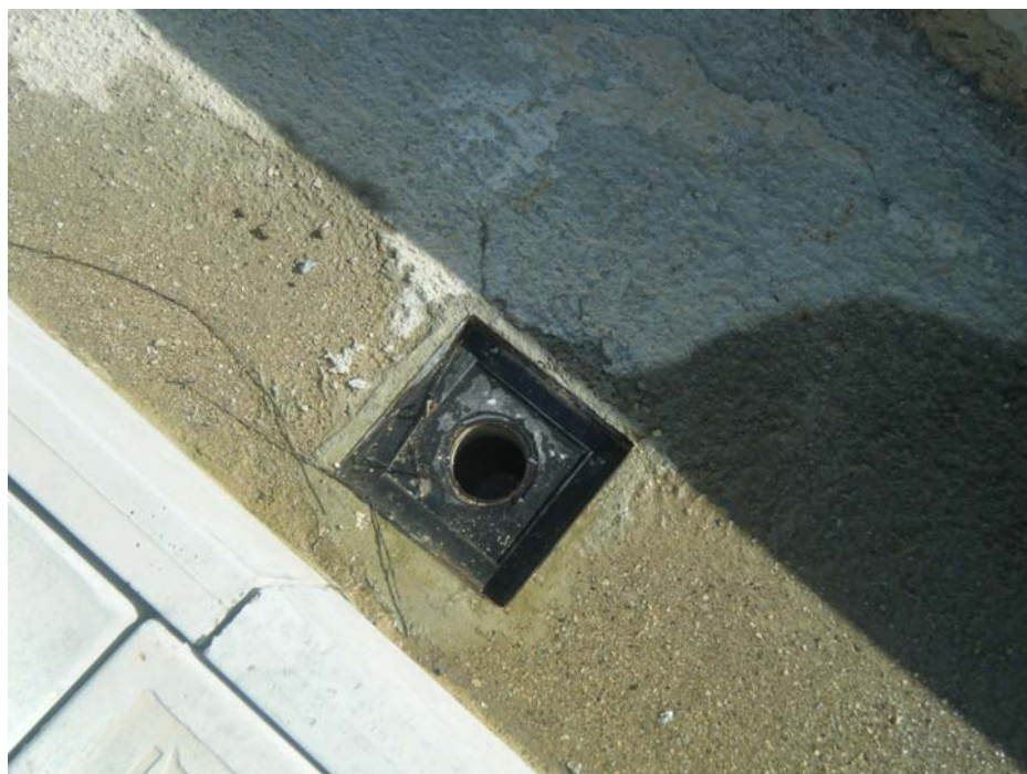
FOTOGRAFIA N° 31: Ausencia de rejilla en uno de los imbornales (lado izquierdo)
