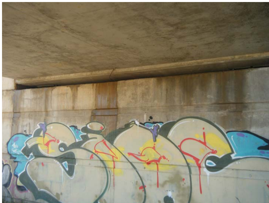
FOTOGRAFIA N° 16: Humedades en el muro de frente estribo de entrada
