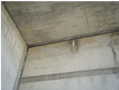
Fotografía nº 10. Eflorescencia en el muro de frente del estribo de entrada
