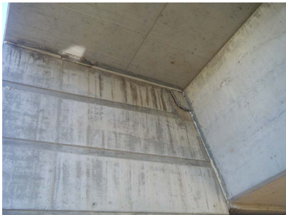
FOTOGRAFIA N° 27: Desconchón en el muro de frente del estribo de salida (Lado izquierdo)
