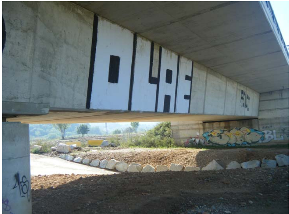
FOTOGRAFIA Nº 22: Pintadas en el alma izquierda del cajón del vano nº 1
