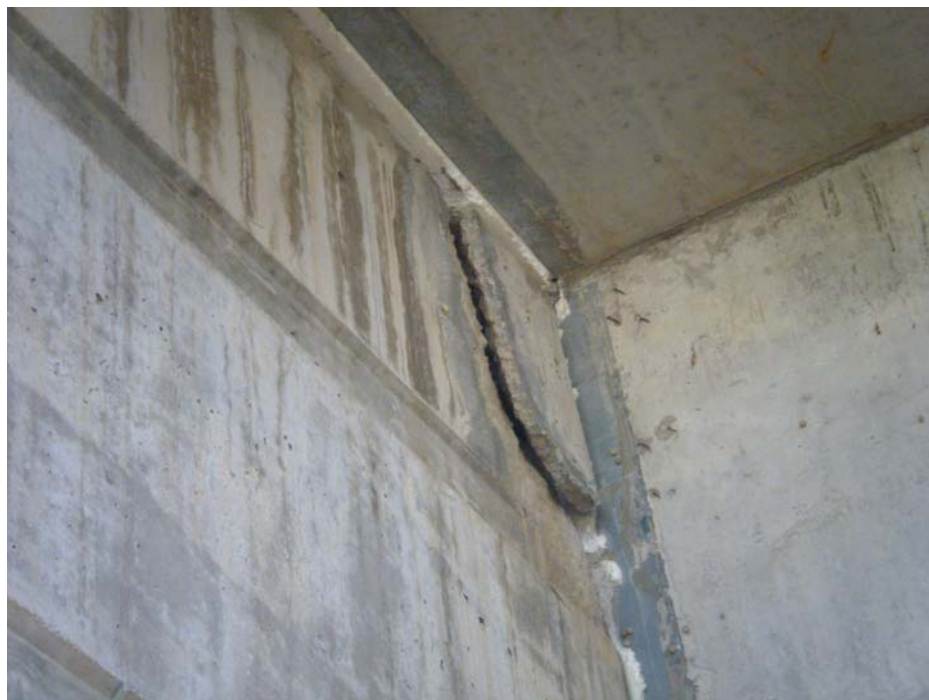
FOTOGRAFIA N° 28: Desconchón en el muro de frente del estribo de salida (Lado izquierdo)
