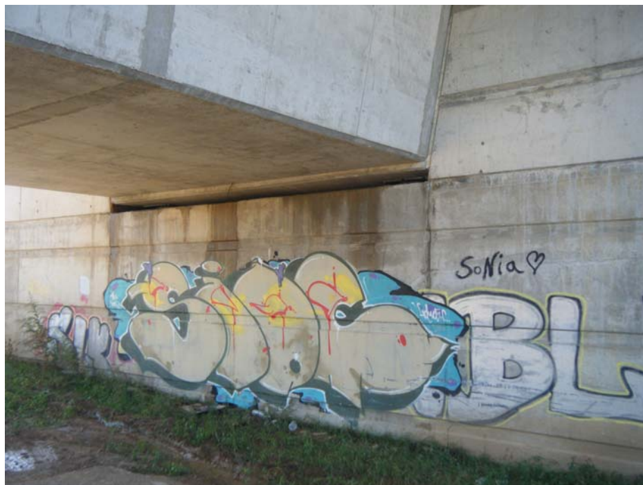
FOTOGRAFIA N° 15: Pintadas en el muro de frente estribo de entrada
