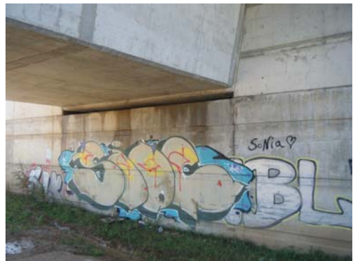
Fotografía nº 9. Pintadas en el muro de frente del estribo de entrada
