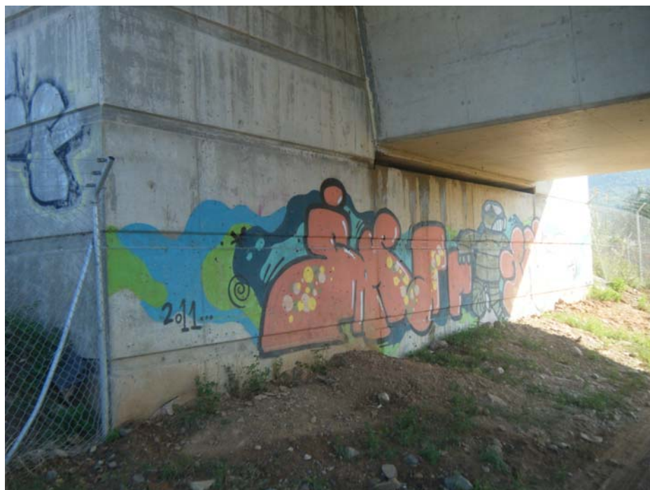
FOTOGRAFIA N° 25: Pintadas en el muro de frente del estribo de salida
