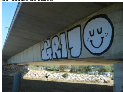
Fotografía nº 17. Pintadas el alma izquierda del cajón
