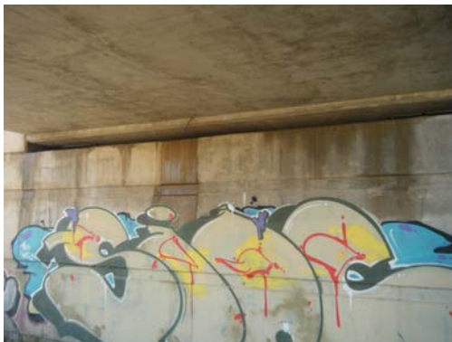
Fotografía nº 8. Humedades en el muro de frente del estribo de entrada
