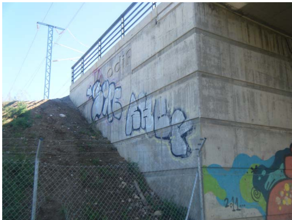
FOTOGRAFIA N° 30: Pintadas en la aleta izquierda del estribo de salida
