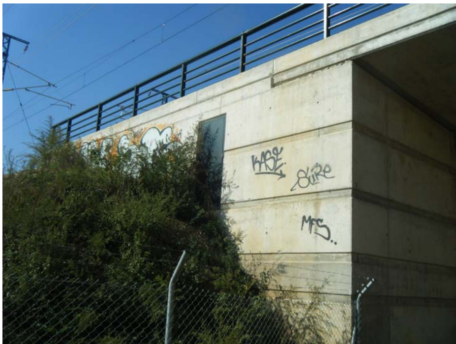
FOTOGRAFIA N° 18: Pintadas en la aleta derecha del estribo de entrada
