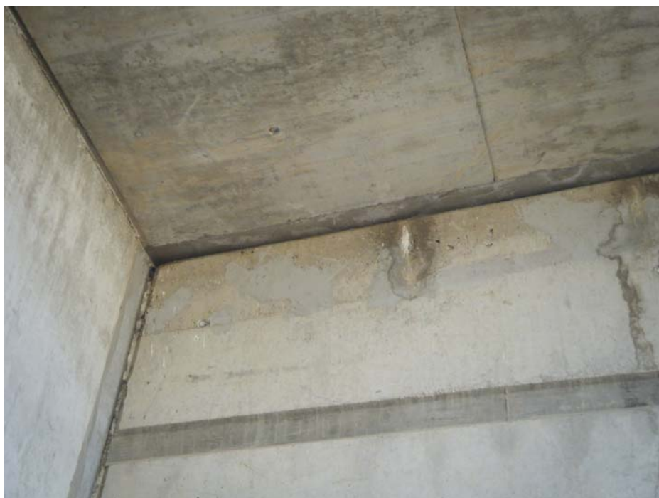
FOTOGRAFIA N° 17: Eflorescencias en el muro de frente estribo de entrada
