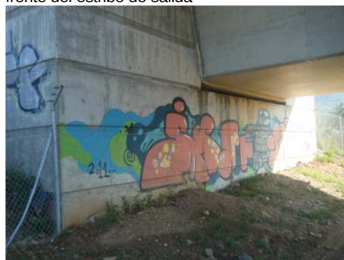
Fotografía nº 15. Pintadas en el muro de frente del estribo de salida
