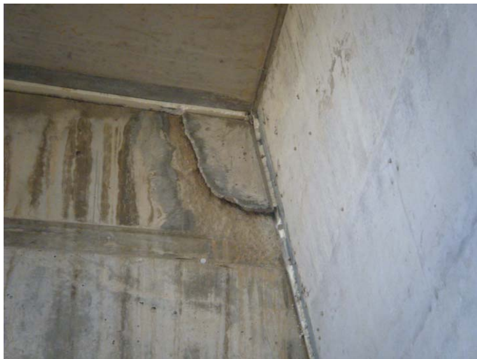
FOTOGRAFIA N° 26: Desconchón en el muro de frente del estribo de salida (Lado izquierdo)
