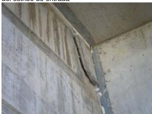
Fotografía nº 14. Desconchón en el muro de frente del estribo de salida
