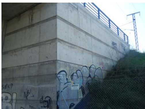
Fotografía nº 12. Pintadas en la aleta izquierda del estribo de entrada
