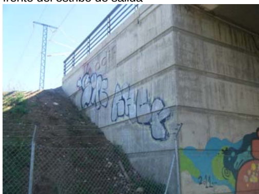
Fotografía nº 16. Pintadas en la aleta izquierda del estribo de salida
