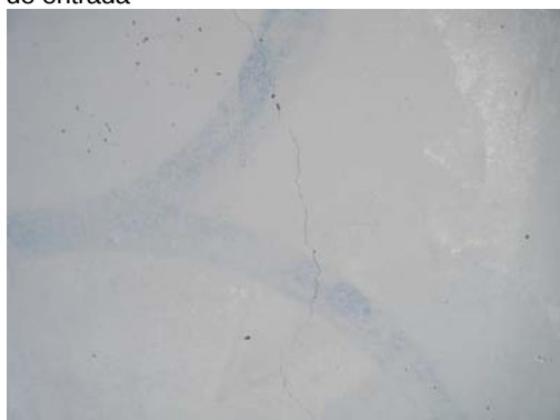
Fotografía nº 9. Fisura en el hastial del estribo de salida
