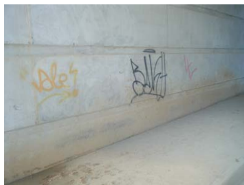
Fotografía nº 8. Pintadas en el hastial del estribo de entrada
