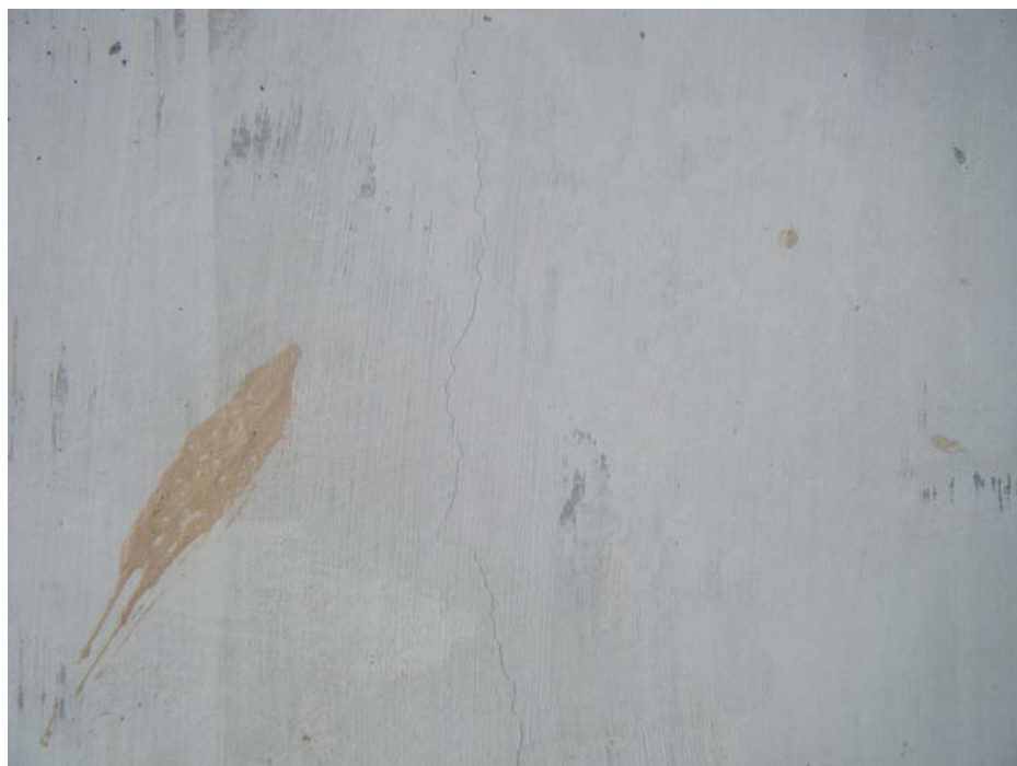
FOTOGRAFIA N° 13: Fisura con trazado vertical en el hastial del estribo de entrada
