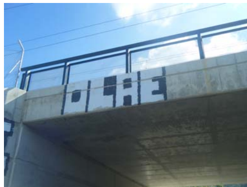
Fotografía nº 14. Pintadas en el canto izquierdo de la losa superior
