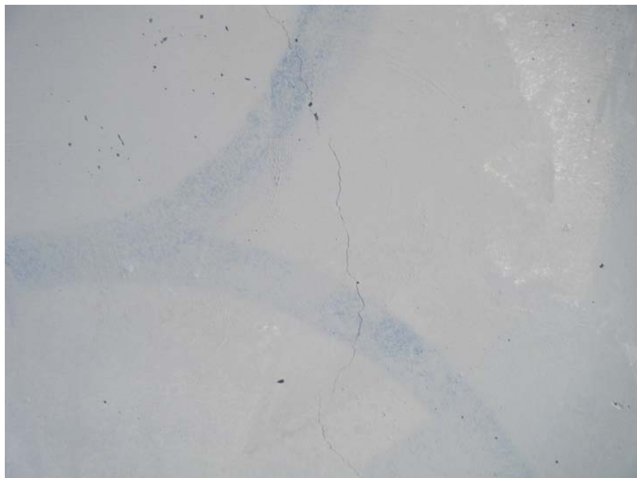
FOTOGRAFIA N° 16: Fisura con trazado vertical en el hastial del estribo de salida
