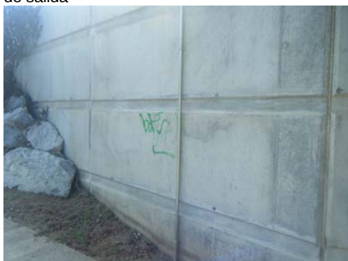
Fotografía nº 11. Pintadas en la aleta derecha del estribo de entrada
