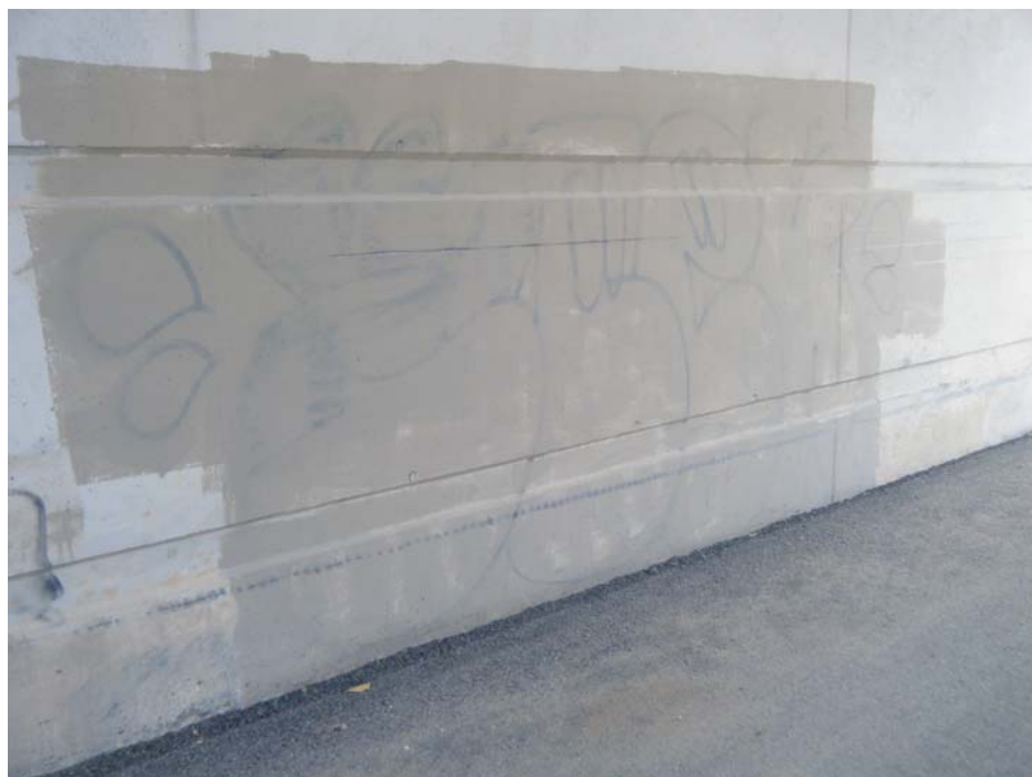
FOTOGRAFIA N° 17: Pintadas en el hastial del estribo de salida
