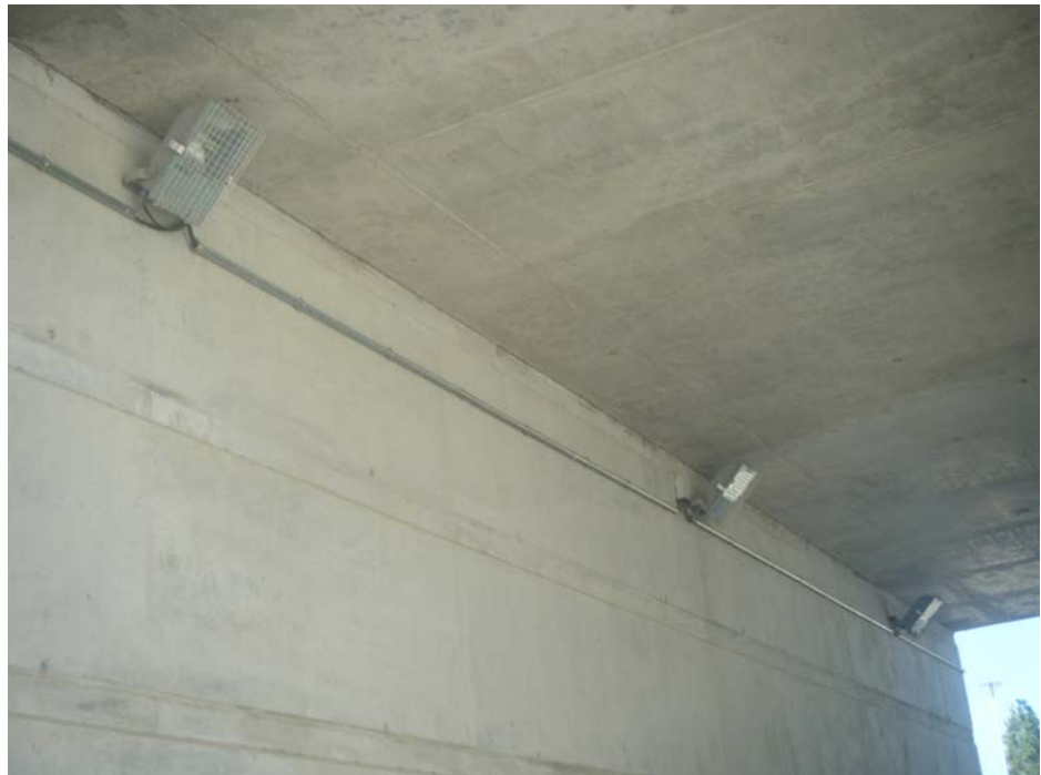
FOTOGRAFIA N° 20: Vista de los eltos de iluminación dispuestos en el hastial de entrada
