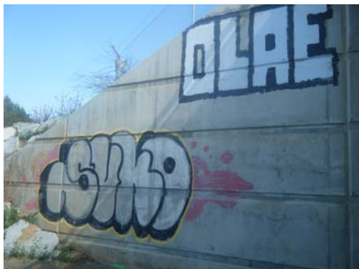
Fotografía nº 13. Pintadas en la aleta izquierda del estribo de salida
