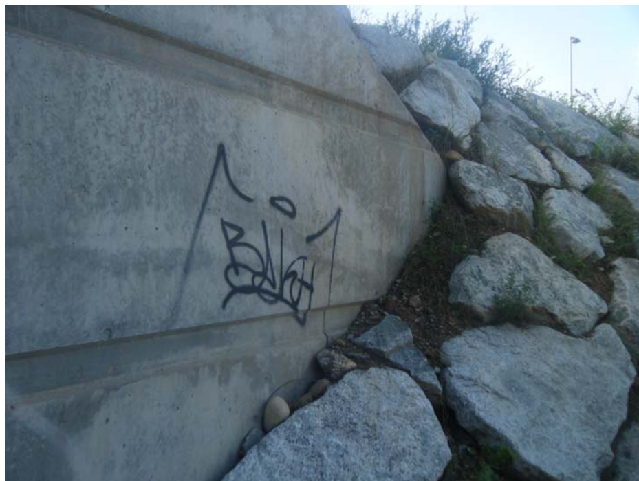
FOTOGRAFIA N° 15: Pintadas en la aleta izquierda del estribo de entrada
