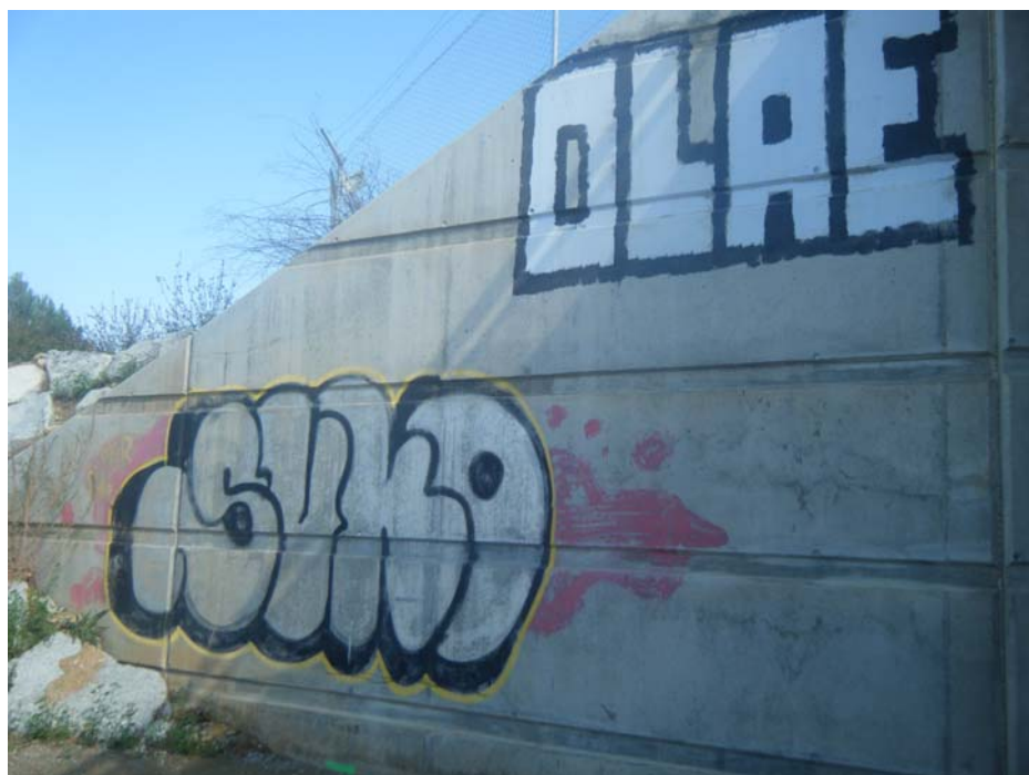
FOTOGRAFIA N° 18: Pintadas en la aleta izquierda del estribo de salida
