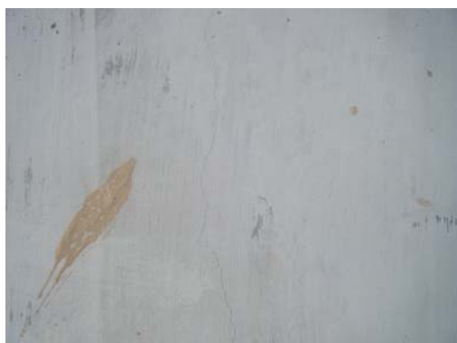
Fotografía nº 7. Fisura en el hastial del estribo de entrada
