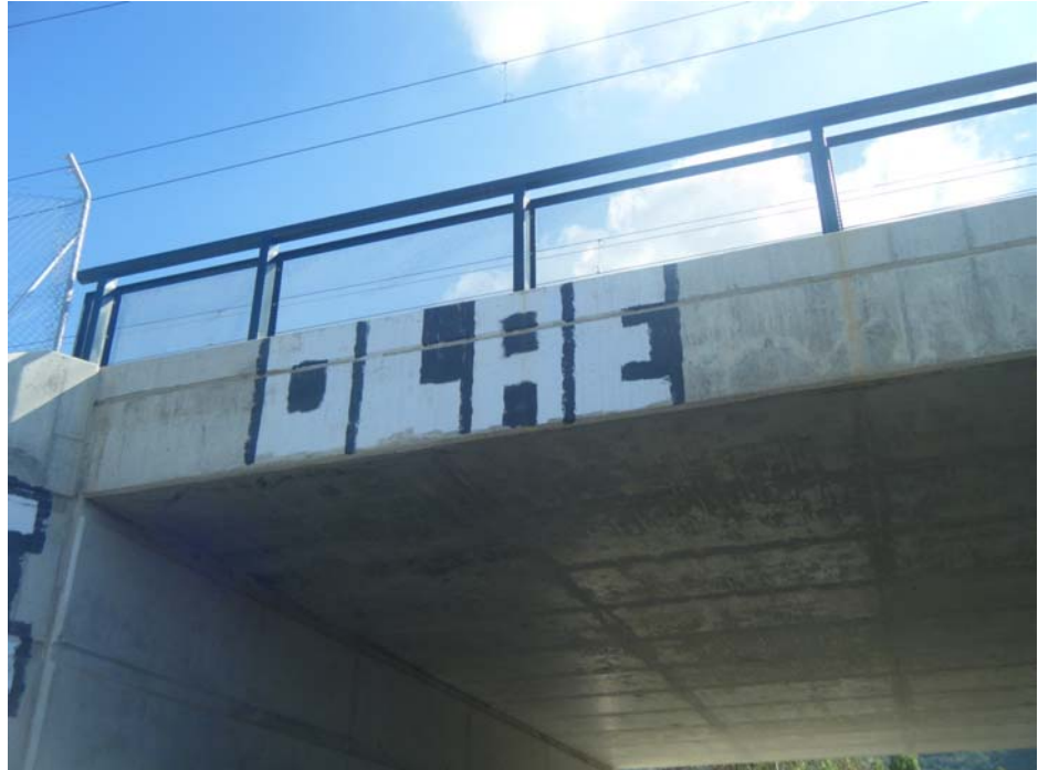
FOTOGRAFIA N° 19: Pintadas en el canto izquierdo de la losa superior
