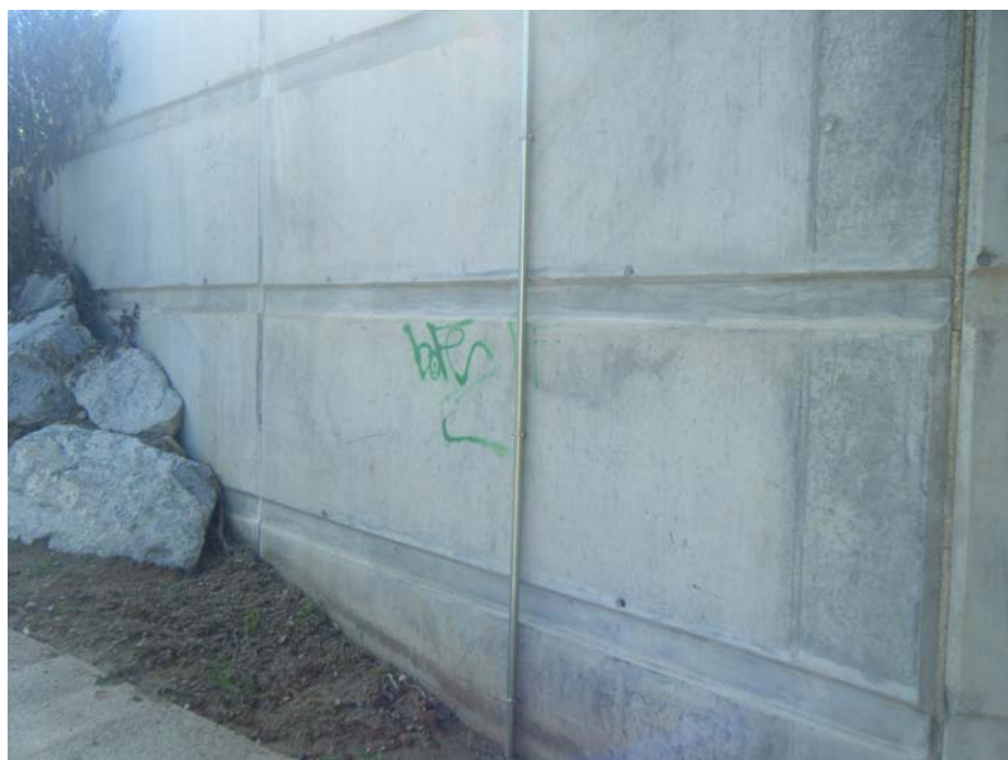
FOTOGRAFIA N° 14: Pintadas en la aleta derecha del estribo de entrada
