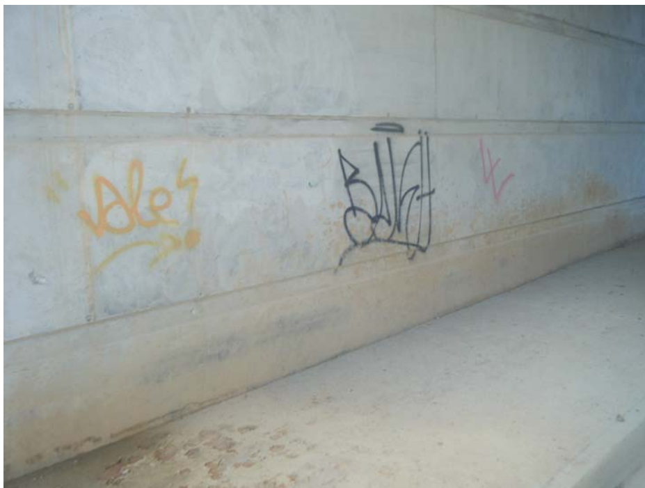
FOTOGRAFIA N° 12: Pintadas en el hastial del estribo de entrada
