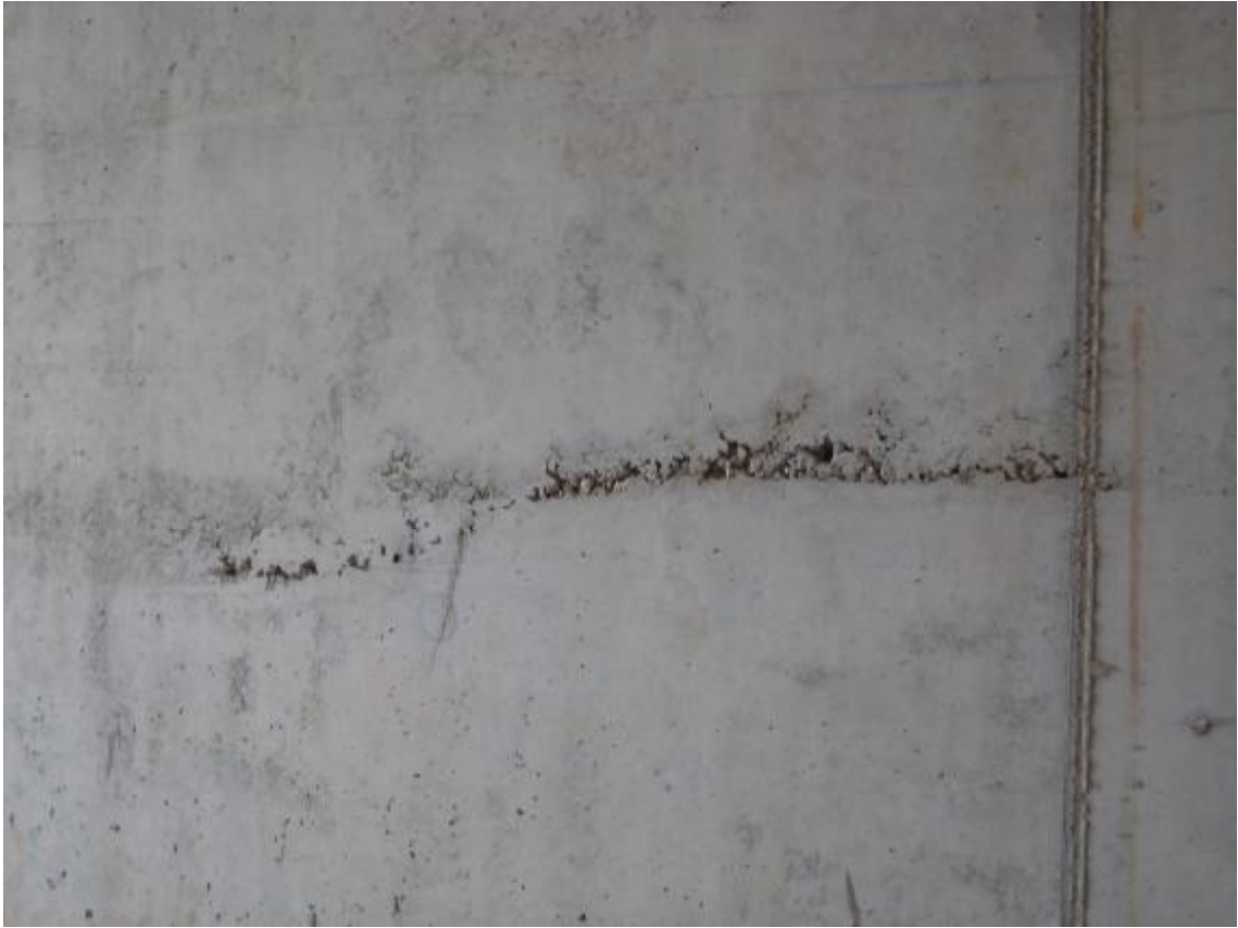
FOTOGRAFIA N°13: Detalle de nido de grava en una de las paredes.
