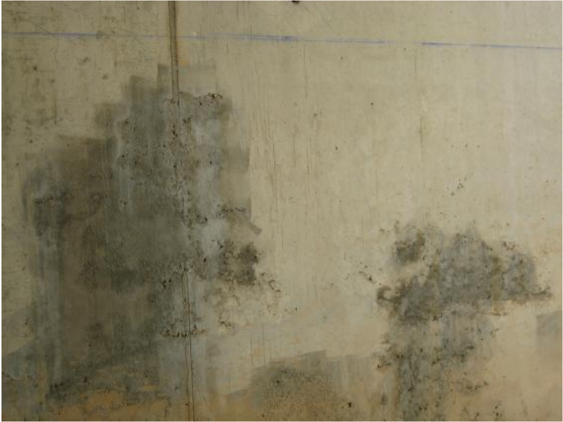
FOTOGRAFIA N°11: Detalle de humedad en una de las paredes.
