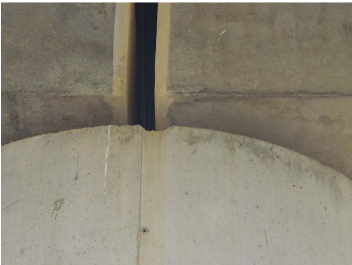
FOTOGRAFIA N°9: Detalle golpe en pila.
