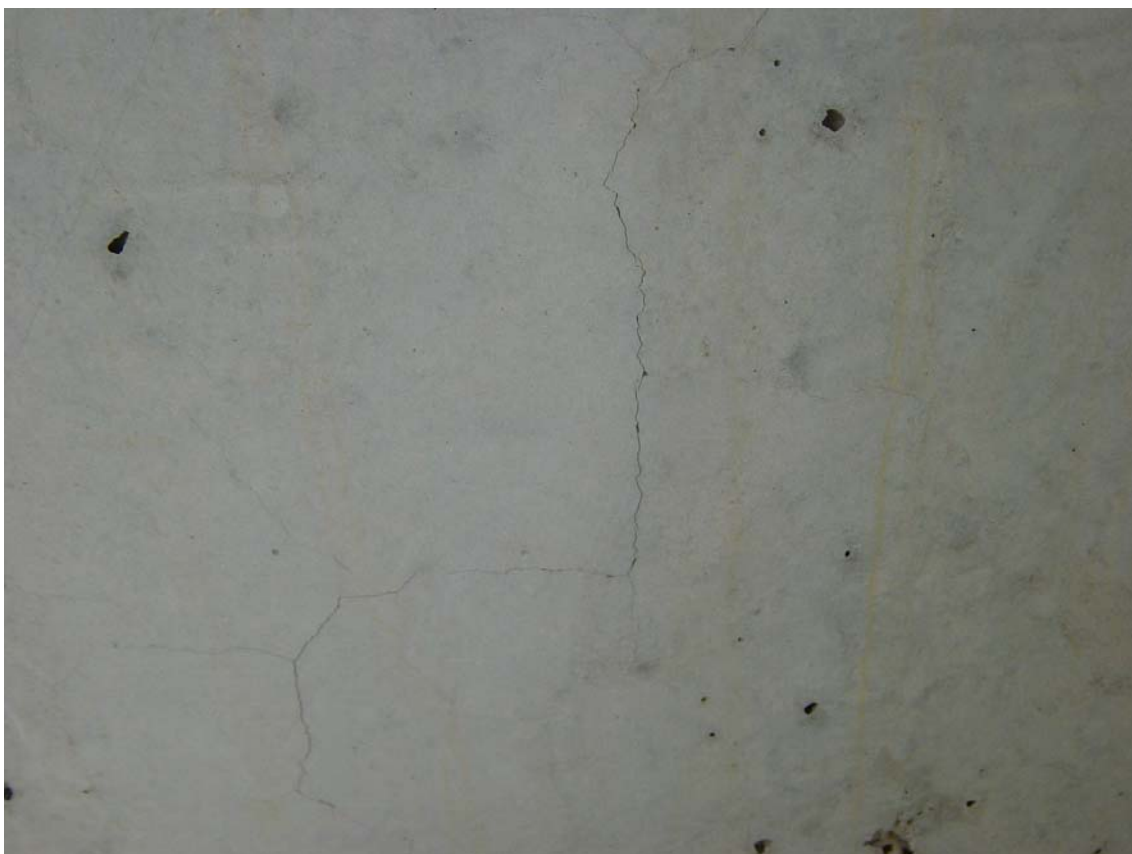
FOTOGRAFIA N°11: Detalle fisura longitudinal al fuste en pila.
