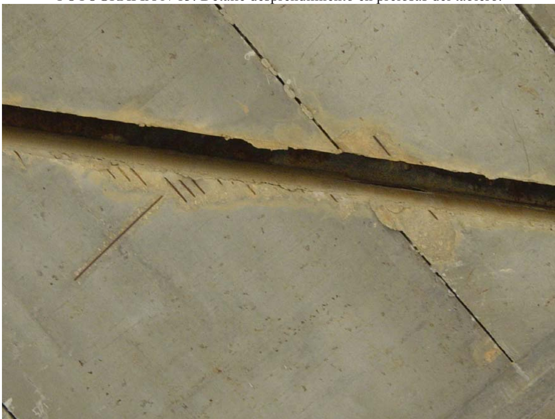
FOTOGRAFIA N°14: Detalle armaduras someras en prelosas del tablero.
