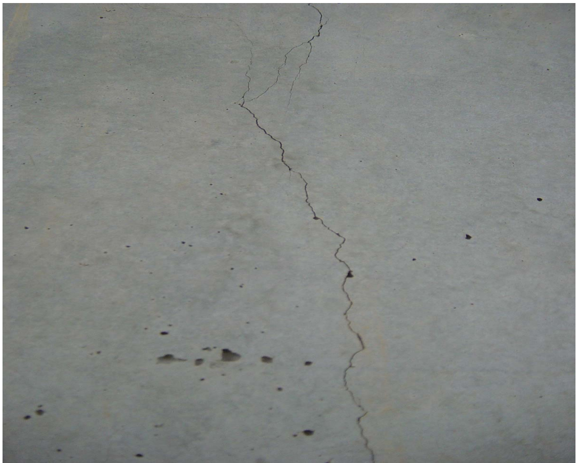
FOTOGRAFIA N°8: Detalle fisura en estribo.
