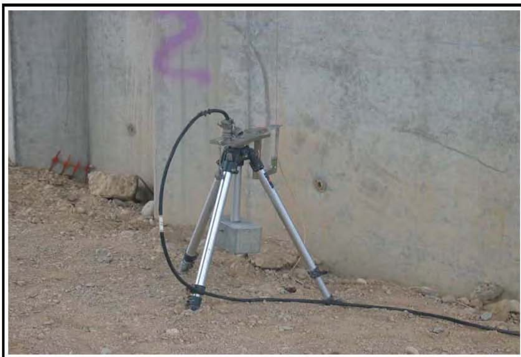
Foto 7: Ménsula para la medida de desplazamientos verticales
