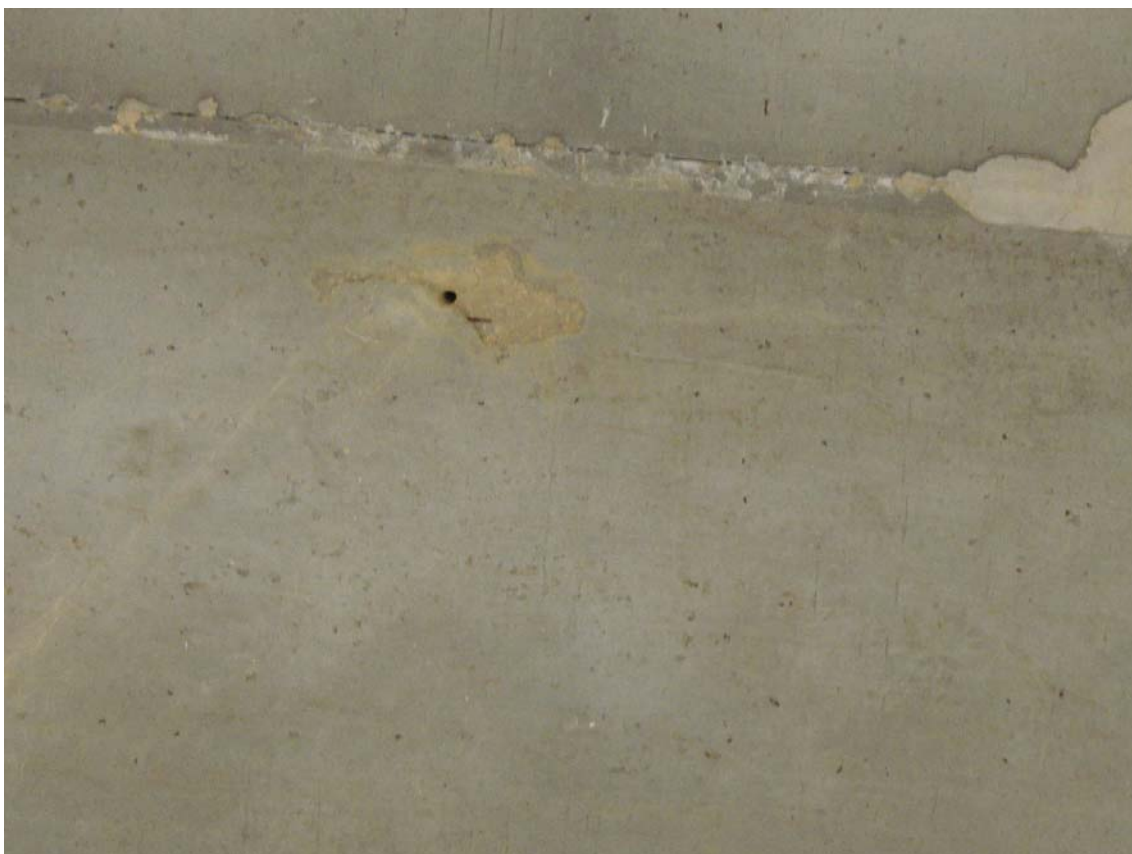
FOTOGRAFIA N°13: Detalle desprendimiento en prelosas del tablero.
