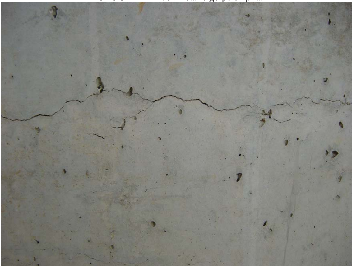
FOTOGRAFIA N°10: Detalle fisura transversal al fuste en pila.
