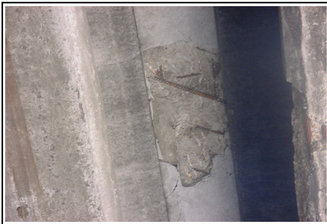
Foto 6: Desconchón con armadura vista en encofrado perdido
