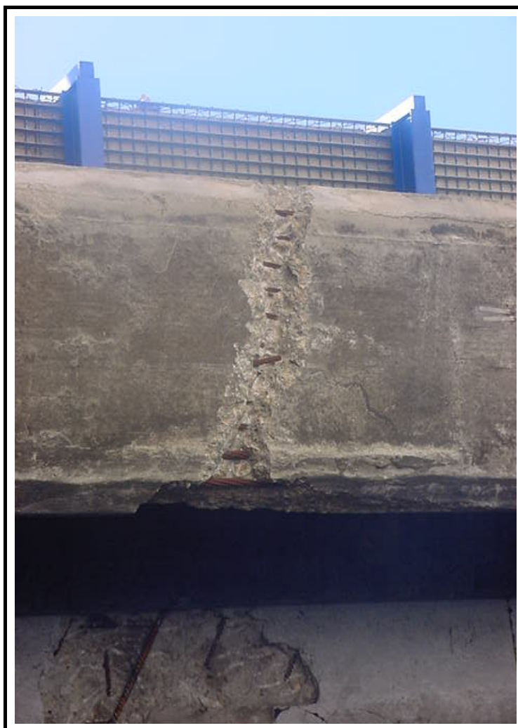
Foto 5: Golpe con armadura vista en viga 1
