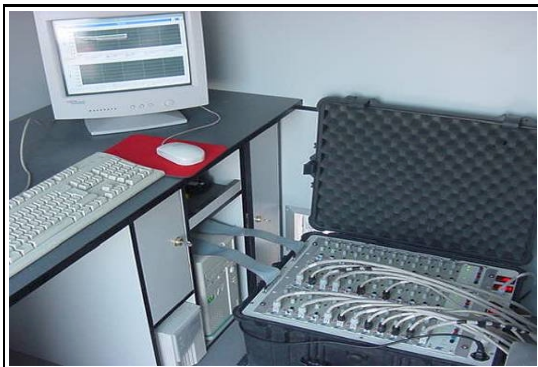
Foto 12: Vista general de acondicionadores de señal y equipo de adquisición
