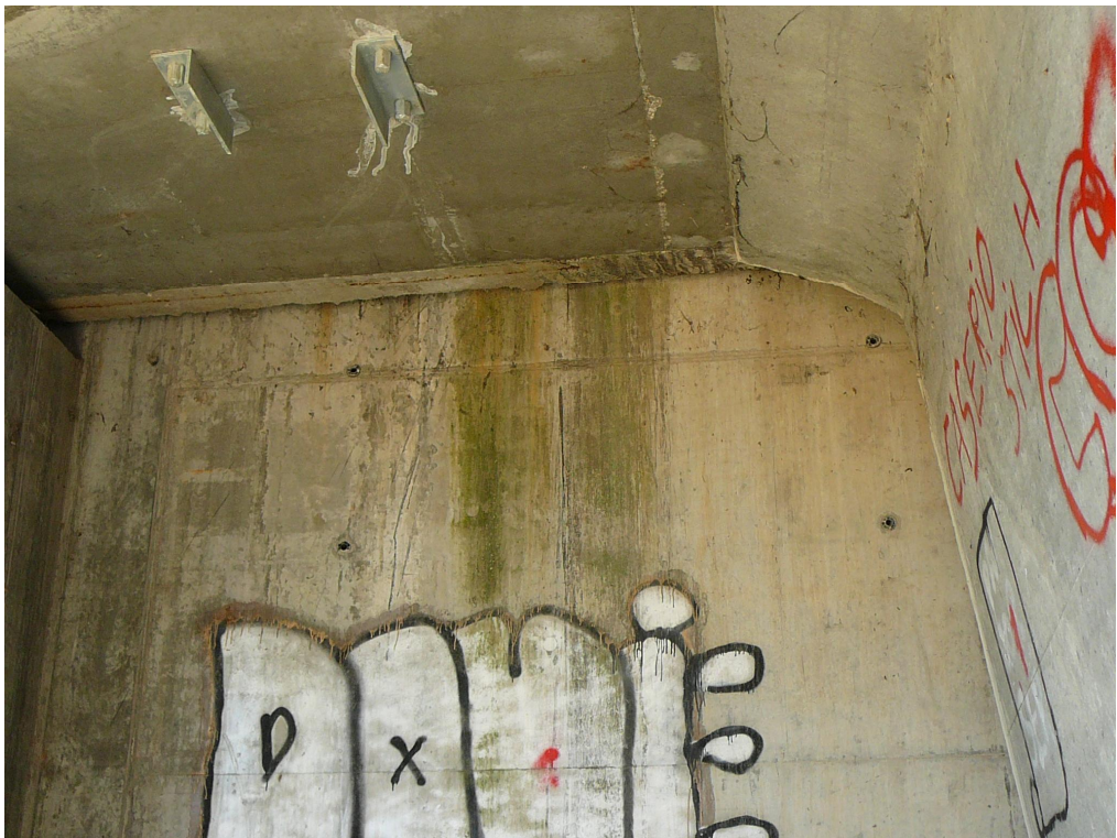
Nº4 Humedades en estribo
