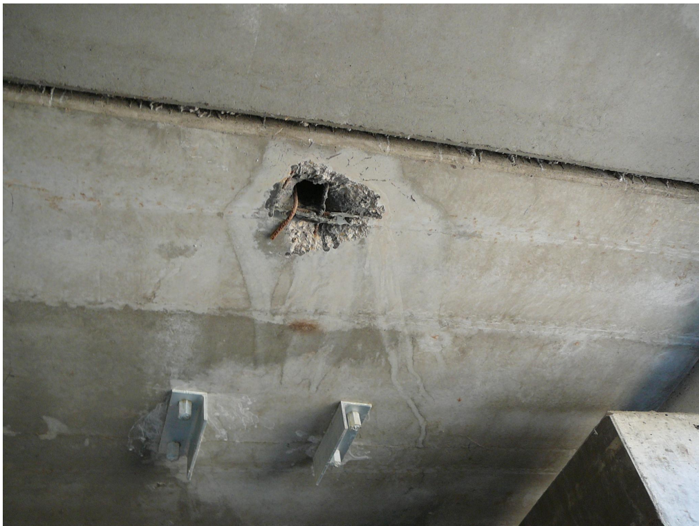
Nº2 Desagüe mal ejecutado
