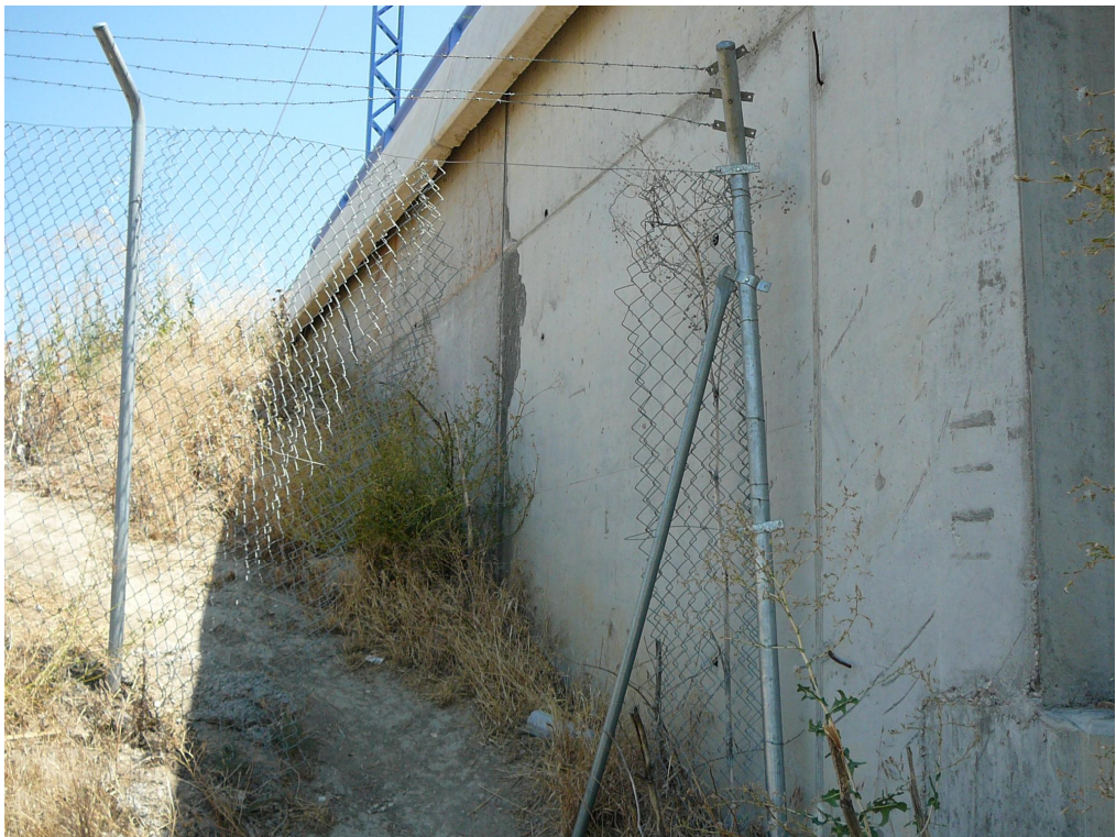
Nº14 Cerramiento en mal estado
