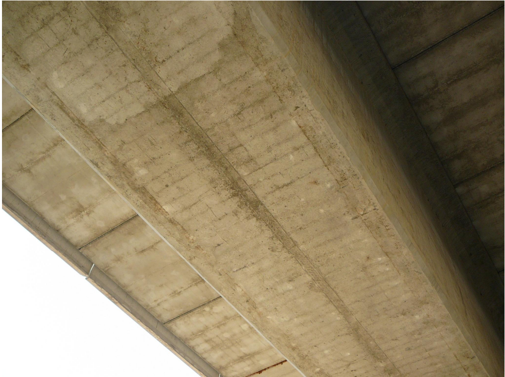
Nº13 Falta de recubrimiento en viga
