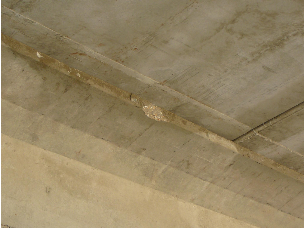
Nº1 Desconchón en viga
