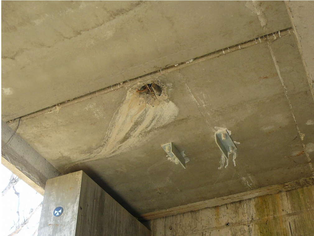
Nº5 Desagüe mal ejecutado cerca del estribo
