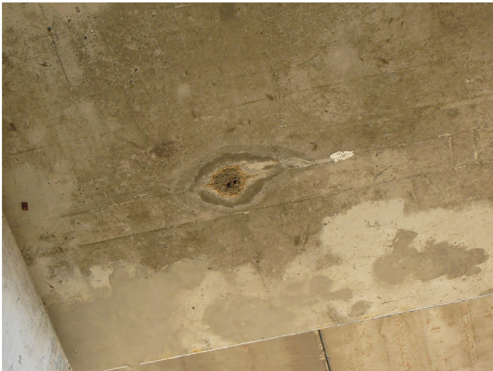
Nº12 Humedad en viga
