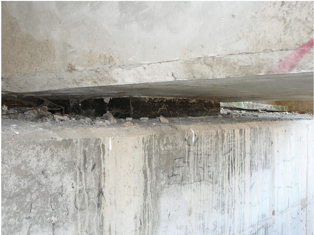
Nº3 Acumulación de materiales en estribo
