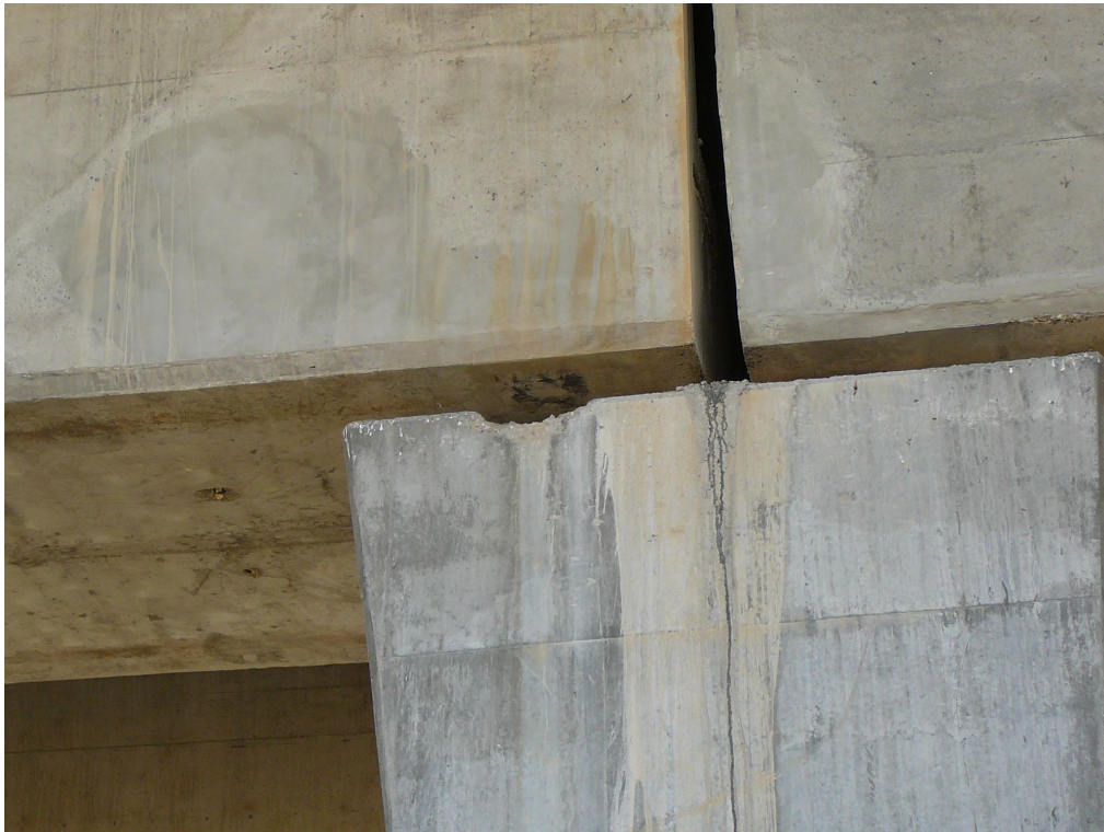
Nº11 Desconchón en capitel de la pila
