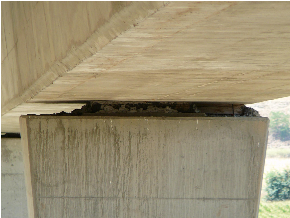
Nº15 Acumulación de materiales en apoyo de pila
