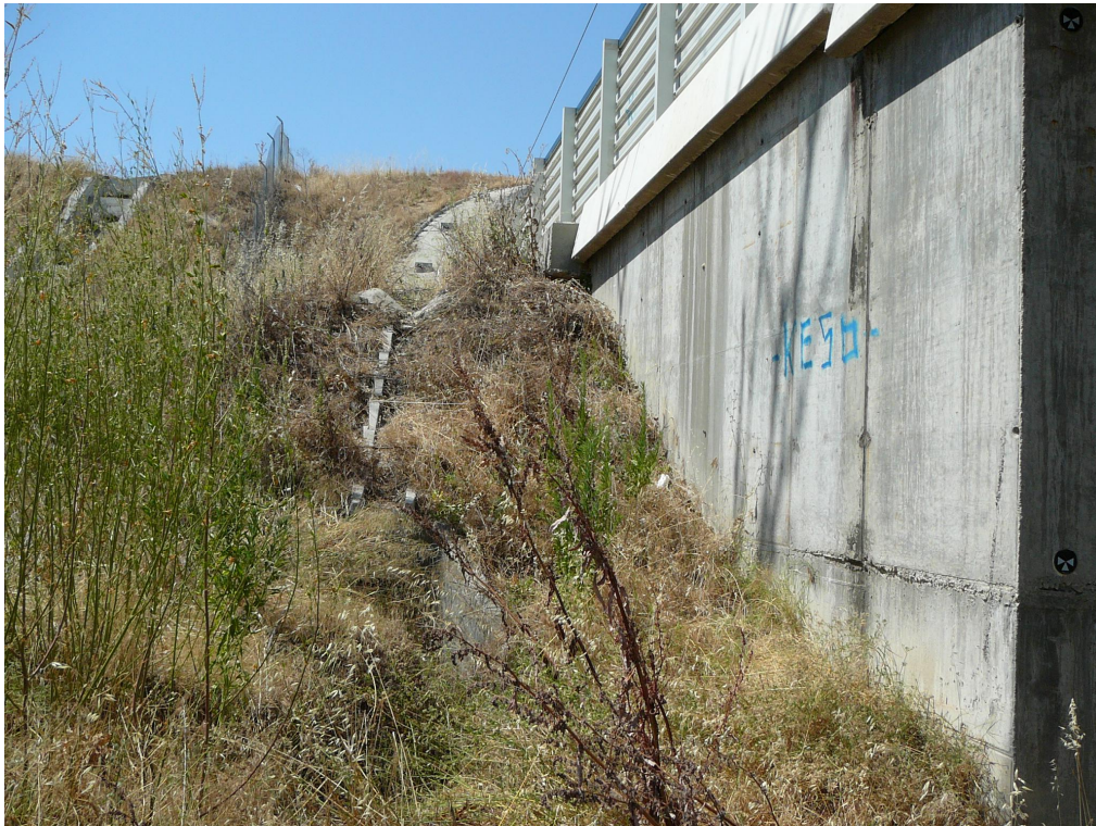
Nº7 Bajante de terraplén en mal estado
