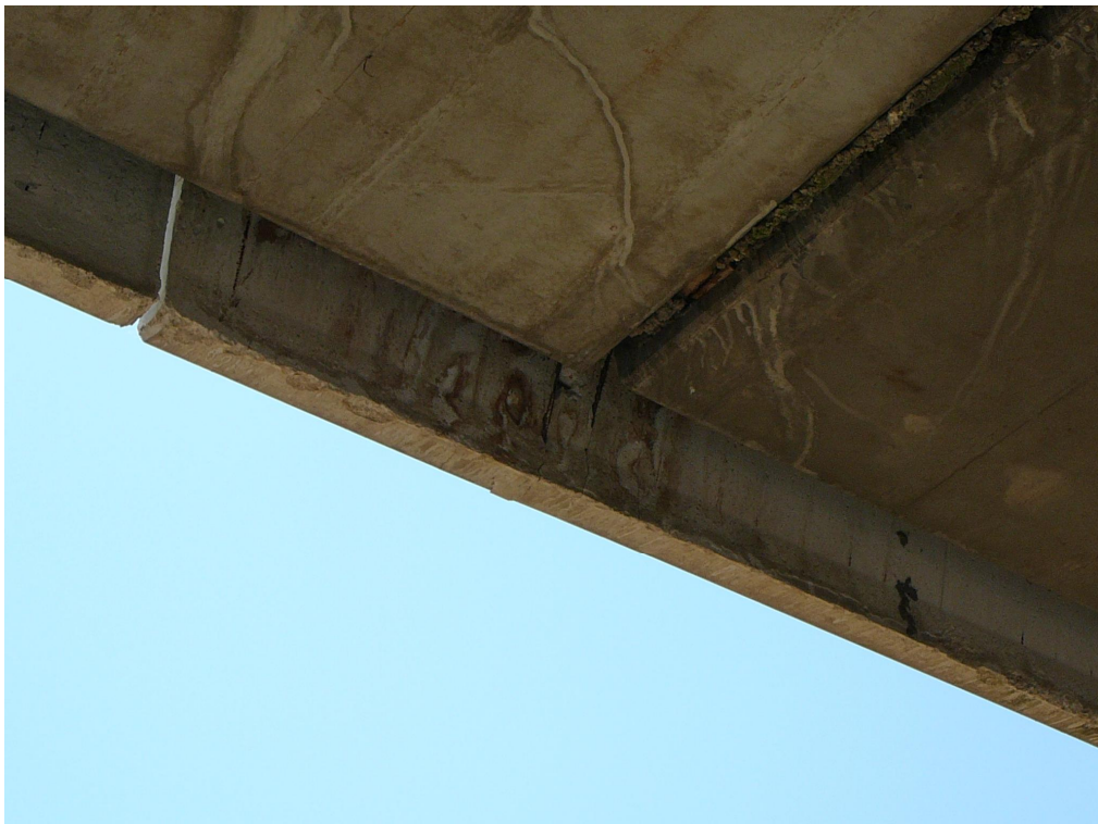
Nº8 Desconchón con armadura vista en pretil
