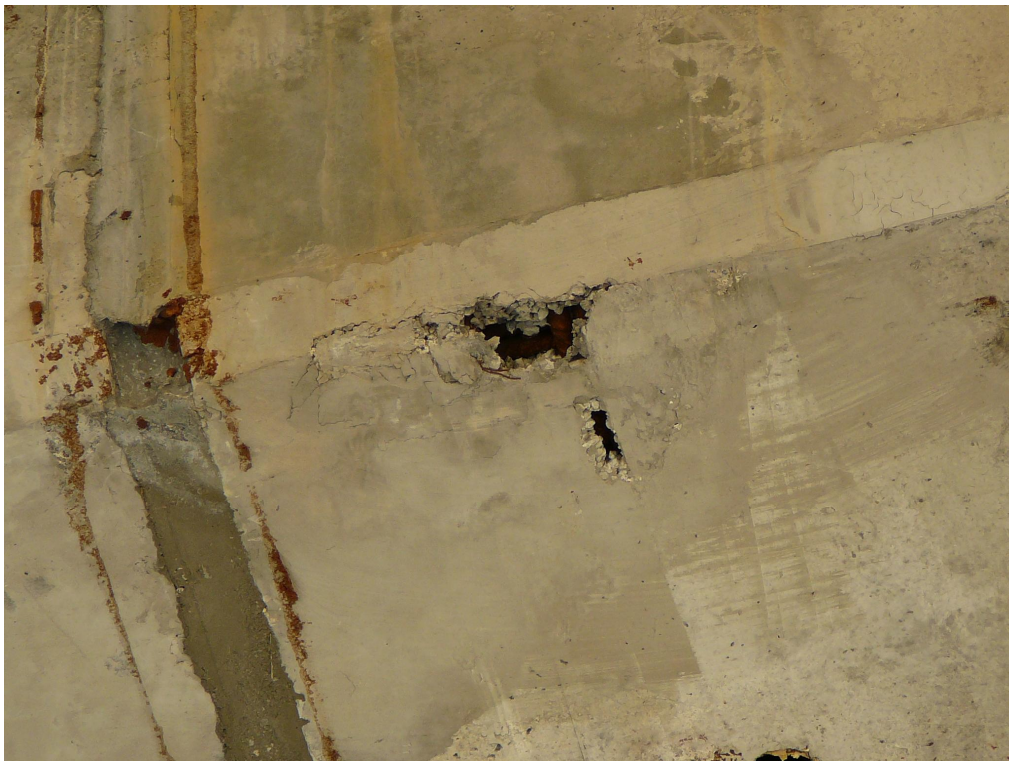
Nº16 Coquera en viga
