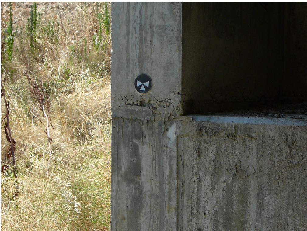
Nº6 Nido de grava en estribo
