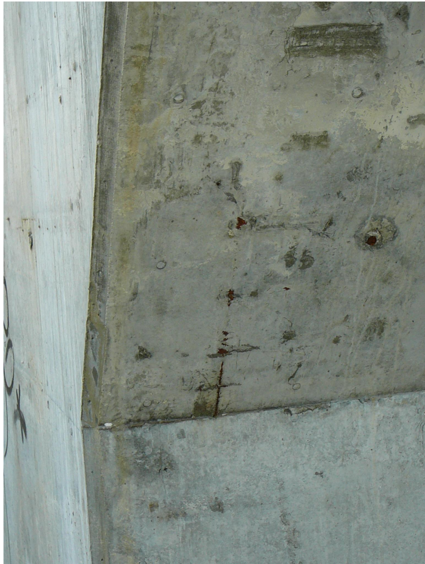
Nº17 Armadura vista en pila
